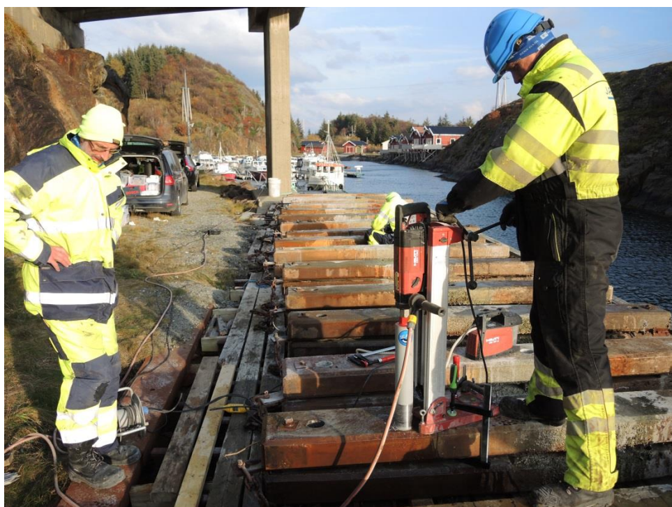
Bildet viser utboring av kjerne med riss.
