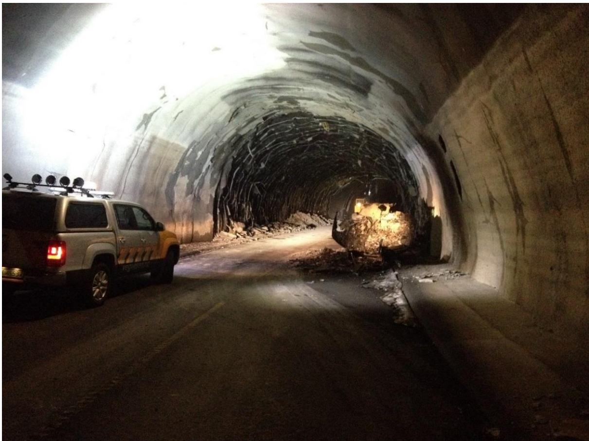
Bilde 8 Utbrent tankbiltilhenger i Skatestrømstunnelen, Foto: Petter Hole, Statens vegvesen
