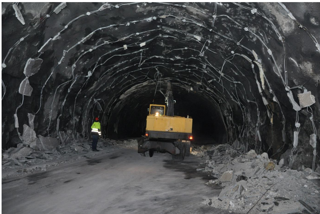
Bilde 9 Bildet viser at sprøytebetongen i tunnelen ble fjernet pga. store sprekker og løse flak i Skatestrømtunnelen. Foto: Petter Hole, Statens vegvesen
