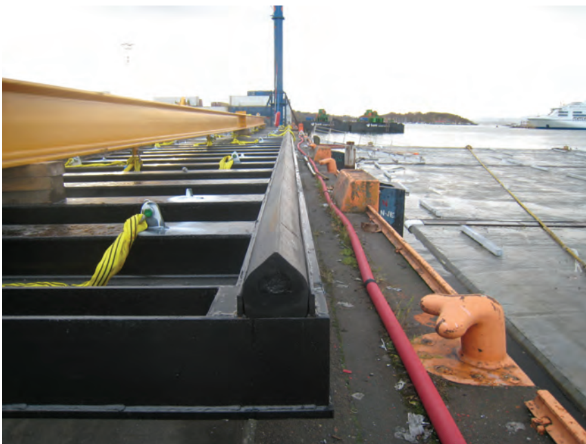
Figur 9.2.5- Panel for lukkeskjøt.
