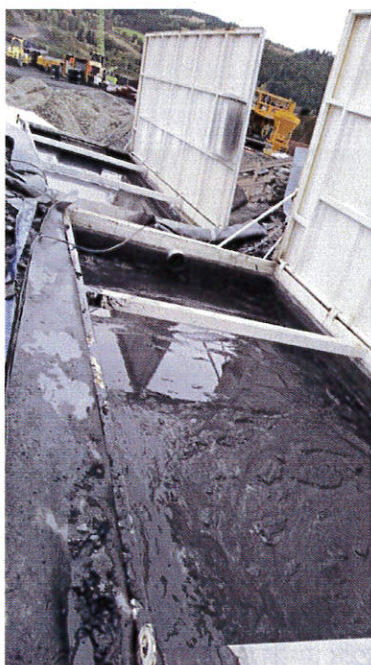
Figur 12. Bilde tatt under slamsuging 26/9 etter lenger periode med høye turbiditetsverdier i rensert vann. Metode for slam-måling var ikke god nok da slammivå slik bilde viser ikke ble registrert, og tiltak med visuell inspeksjon i tillegg ble påkrevd av SVV.
