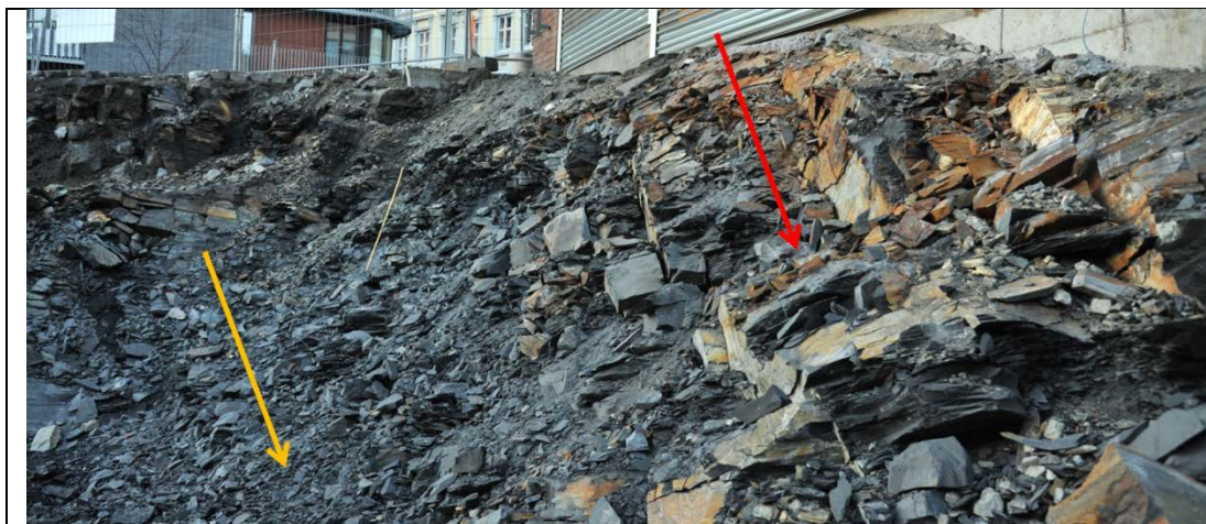
Figur 36: Galgebergledet ved Sofienberg i Oslo. Tilsynelatende grov oppsprekking (rød pil), men her kom skiferen ut nesten av seg selv og kunne krafises med skuffe på gravemaskin (gul pil).
