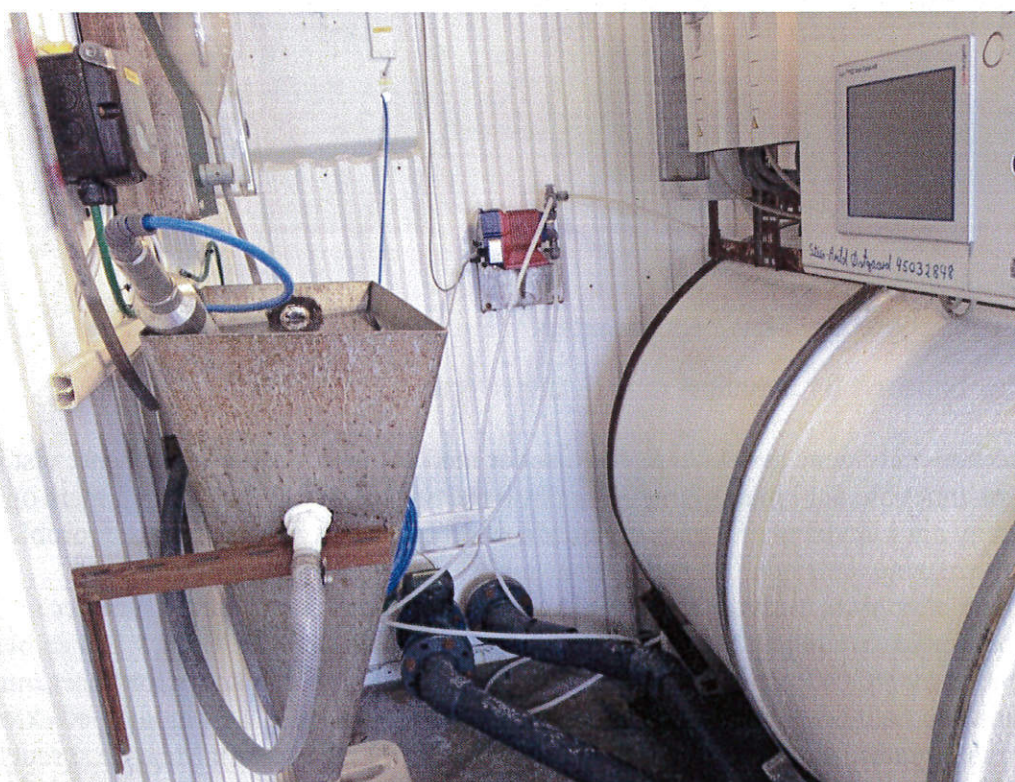
Figur 8. Bilde tatt 24/6 2014 etter hendelse med lekkasje i slange for syretilsetning. Man ser korrosjon som følge av syre i rommet, og deler av platingen der tilstrømningen har vært konsentrert er etset vekk. Årsaken var brudd på slange som mater syre til doseringstanken. Dette er av farene ved bruk av syre som pH-regulering. Statens vegvesen arbeider med å innføre krav om pH-regulering med bruk av CO 2 -gass da dette anses som mer stabilt og trygt, både mhp arbeidsmiljø og naturmiljø. I Norge i dag er det syre som er vanlig å benytte i slike anlegg.
