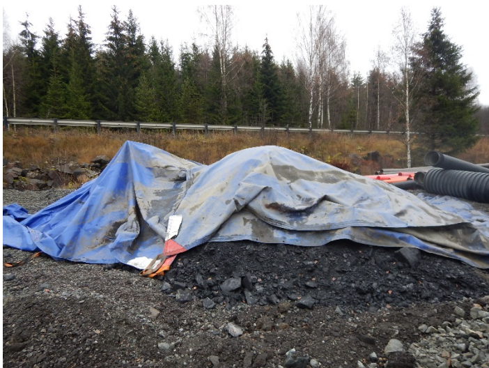
Figur 80. Mellomlagra alunskifermasser etter at masselageret var fylt opp. Desse massane blei sendt til godkjent mottak i Fredrikstad (Borge deponi) og utgjorde 30450 kg.
