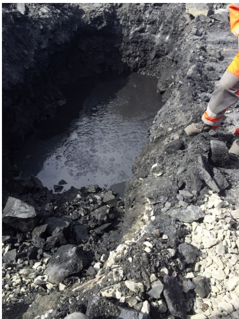
Figur 99 Graving av ei grøft for slangar for setningsmålingar. Biletet viser at noko av den fine nedknuste alunskiferen dannar eit belegg på toppen av vasspegelen og følgjer dette.
