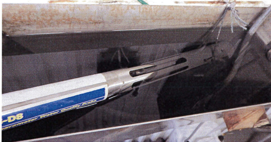
Figur 6. Målekaret med multiparametersonden for kontinuerlig overvåking av pH, turbiditet, ledningsevne og temperatur.
