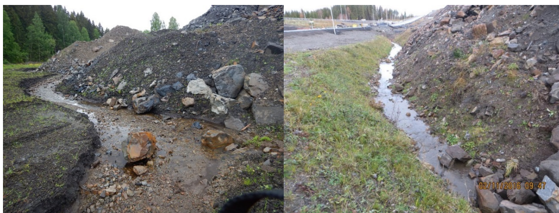
Figur 140. Nordtangenbekken. Til høgre: Bekken rett nedanfor oppstrams prøvetakingspunkt. Flaumperioden våren 2015 førte til mykje erosjon i jordmassane. Bekken blei seinare lagt om. Til venstre: Bekken er lagt om i grøft langs masselager. I november 2016 blei også denne bekken fylt igjen og flytta.
