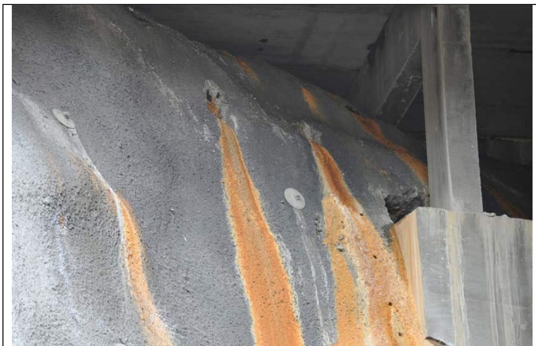
Figur 41: Lekkasje fra boltehull i sprøytebetonglag på alunskifer.
