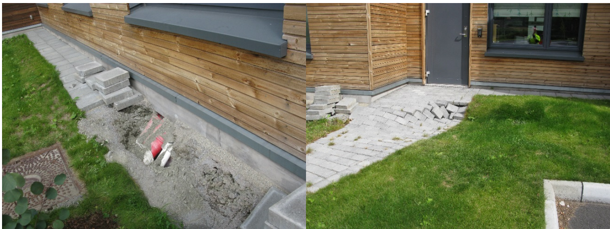
Figur 44. Synlege setningssskadar rundt nytt naudetatsbygg.
