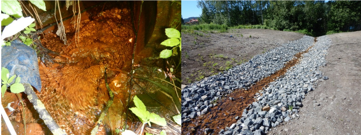
Figur 144. Horgenbekken oppstrøms (til høgre) og nedstrøms (til venstre) anleggsområdet for ny veg. Det er jernutfellingar i botnen på begge lokalitetane. Bilder er tatt 1. juli 2015.
