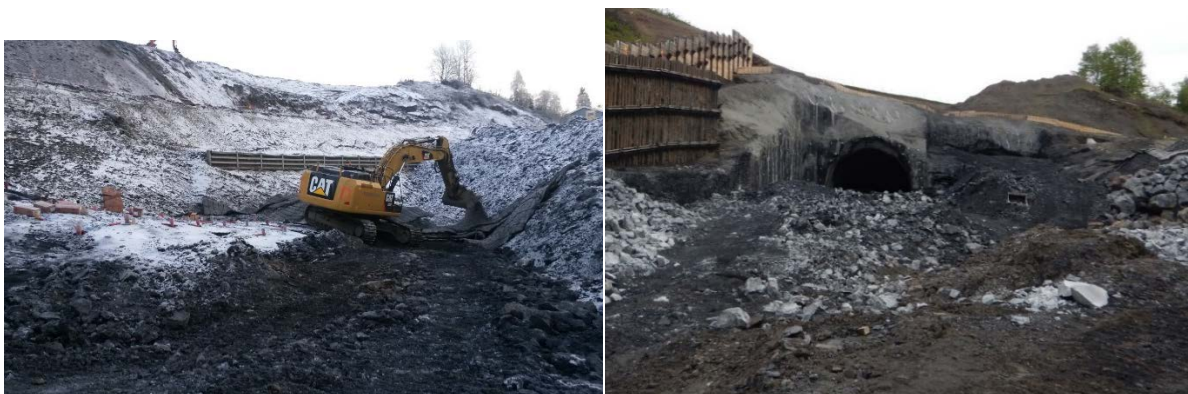
Figur 32. Sprengingsarbeid ved nordre tunnelpåhogg ved Horgenmoen 09.12.2014 (til venstre) og ved påhogget etter gjennomslaget i slutten av mai 2015 (til høgre).
