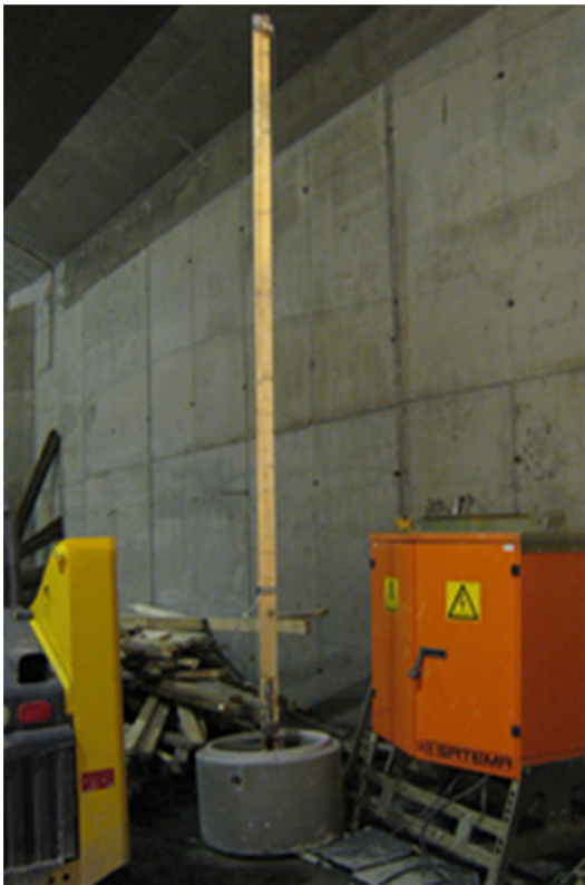
Figur 27: Vannstandsør i bunnplate
