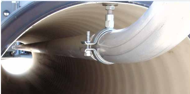
Figur 9-12 HeatWork. Tinerør montert inni stikkrenne (Foto: HeatWork)
