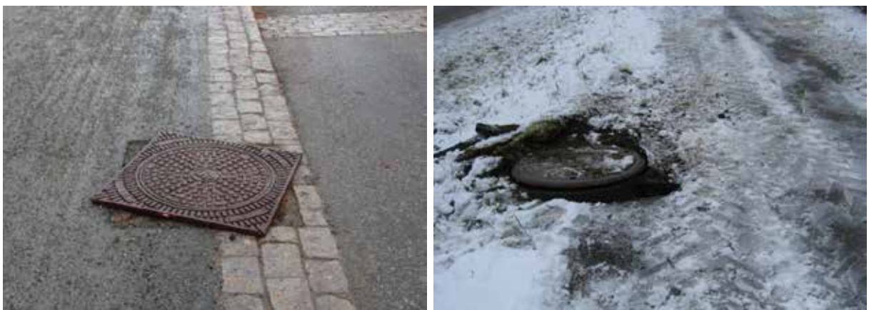
Figur 4-4 Kumlokkramme ute av stilling (t.v.), kum med overhøyde(t.h.). Fare for hekting
