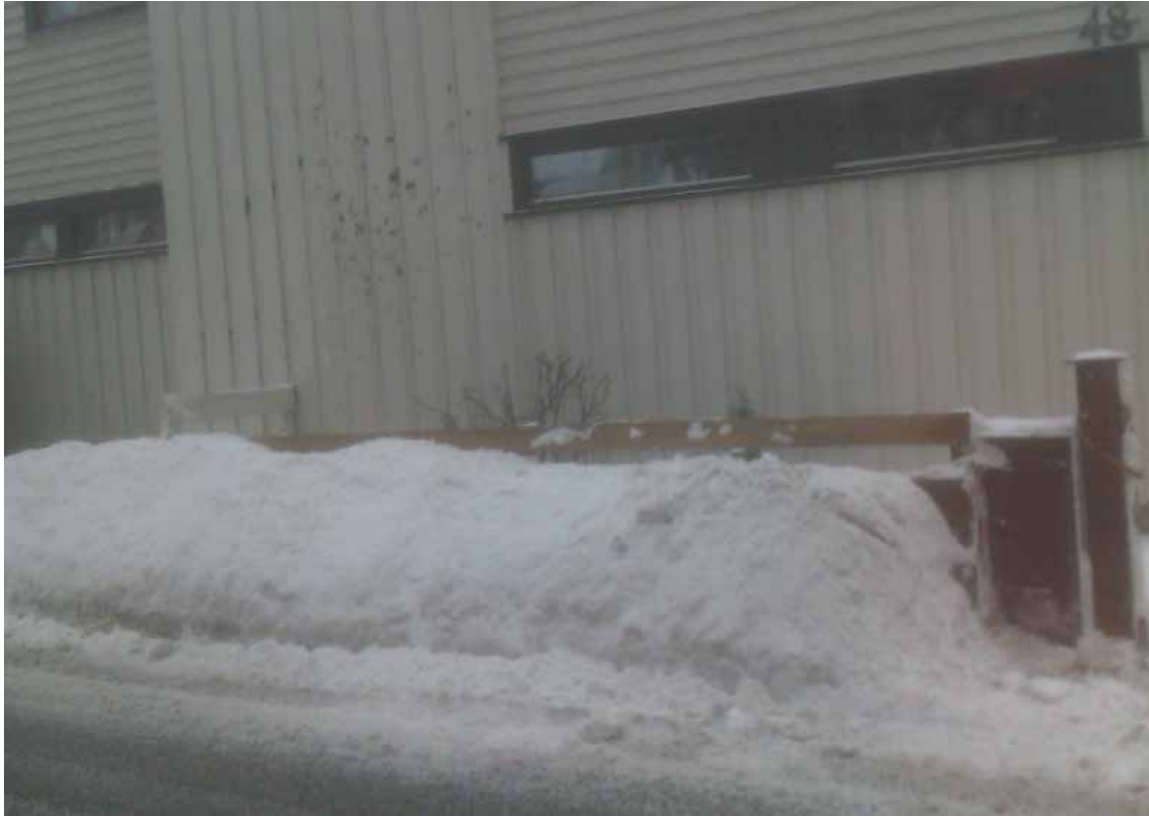
Figur 4-85 Uønsket sprut fra brøyting på fasade (Foto: Rudi Thomassen, Statens vegvesen)
