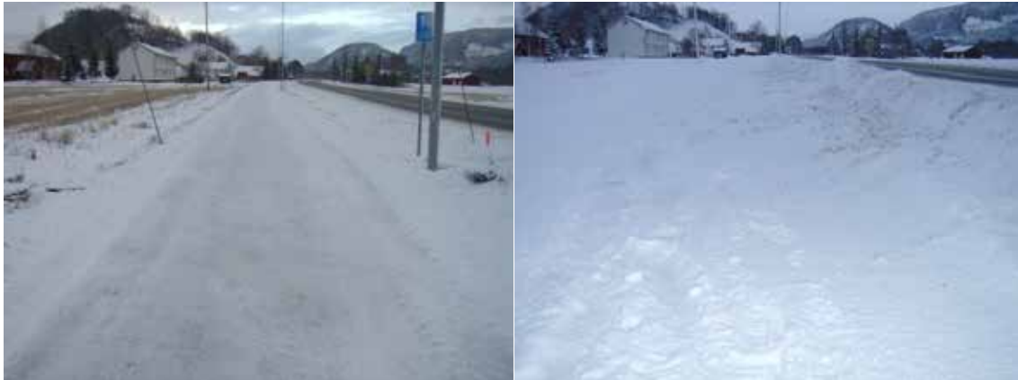
Figur 4-63 Eksempler på godt resultat (til venstre) og dårlig resultat (til høyre) etter brøyting av både hovedveg og g/s-veg
