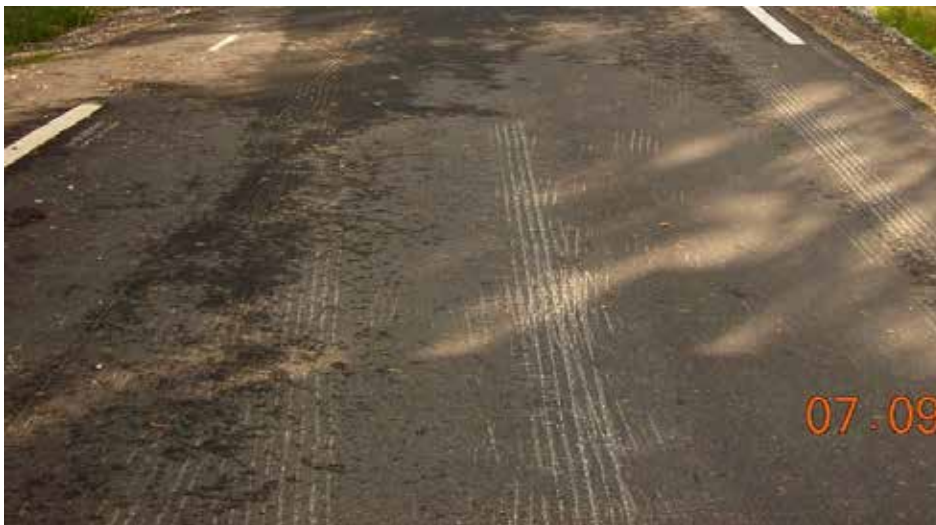
Figur 4-41 Skader på fast dekke (Foto: Statens vegvesen)
