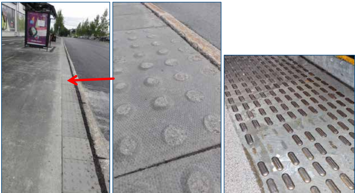
Figur 1-3 Indikatorer og taktile elementer (universell utforming) kan skades av brøyteutstyr. Her har brøyteutstyr brutt av markørene på taktile elementer (Foto, fra venstre: Torun Vikan, Mats Erik Vatne og Knut Opeide).
