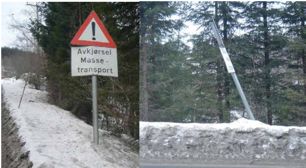
Figur 9-7 Skade på skilt
