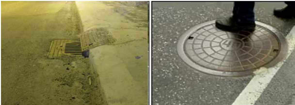
Figur 4-3 En bør stoppe opp å kontrollere sluk og kumlokk som ligger utsatt til
