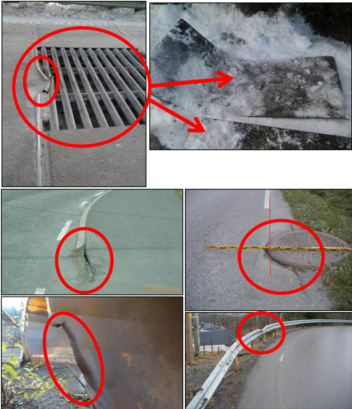
Figur 2-1 Eksempler på kritiske punkter og resultat av uønskede hendelser. Øverst: hekking/skade på ferist fra brøyting/høvling (venstre) og løsrevet dekkplater til ferist (høyre). Midten: Skade på kantstein fra brøyting (venstre) og oppstikkende kum, fare for hekking av plog/skjær (høyre). Nederst: Skade på plog etter påkjørsel (venstre) og skadet rekkverk (høyre). (Foto: Tom Roar Sveen og Statens vegvesen).
