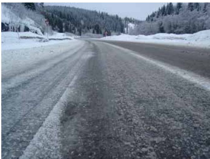
Figur 8-10 Dårlig brøyting vil gi dårlige kjøreforhold og høyt saltforbruk (Foto: Bård Nonstad, Statens vegvesen)
