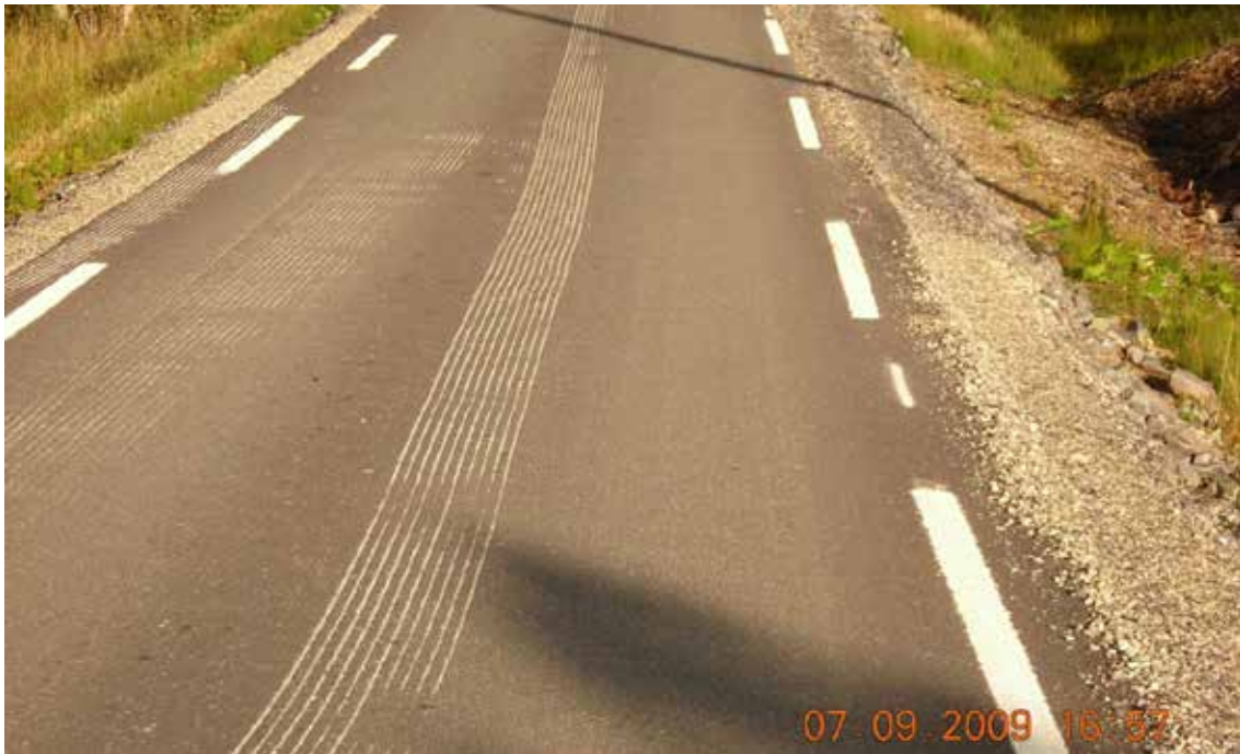
Figur 1-2 Skade på veg skal unngås
