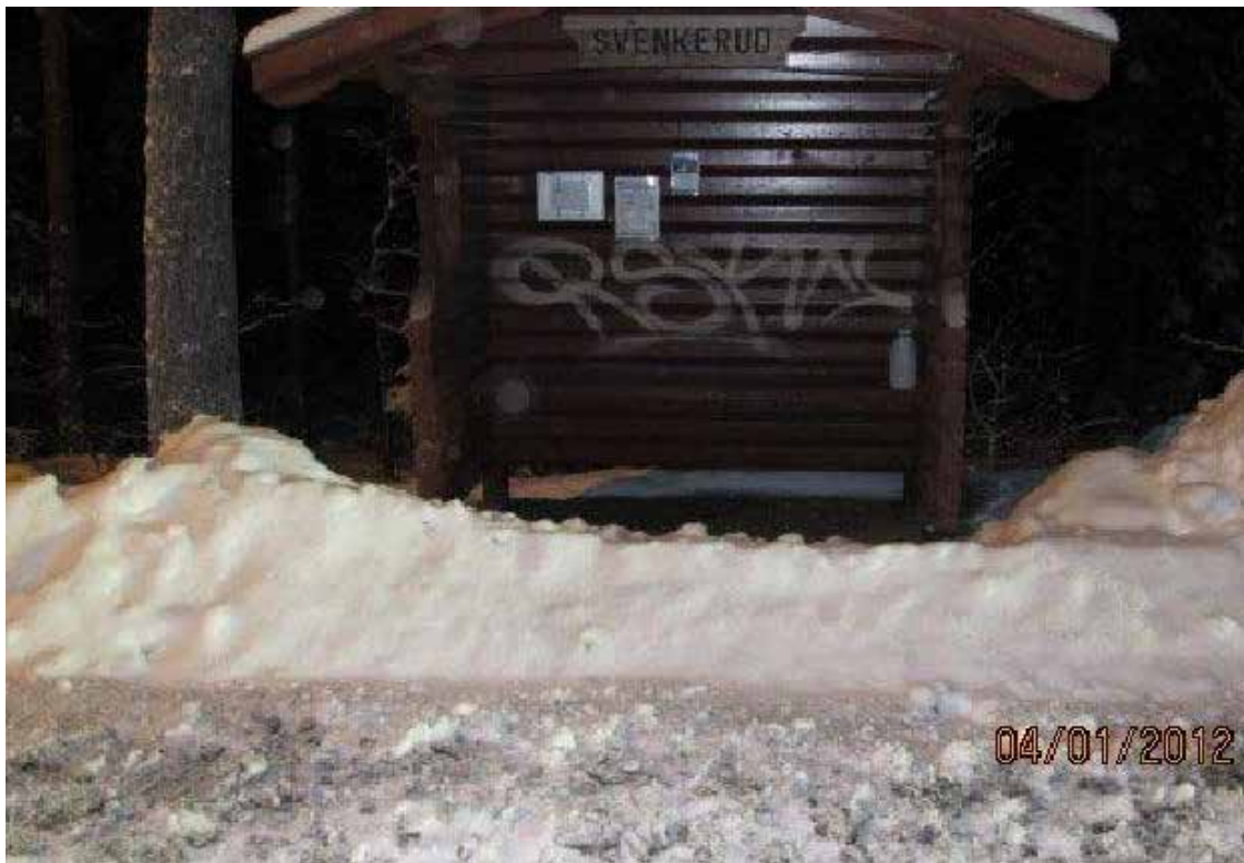
Figur 4-71 Mangelfull rydding foran leskur (Foto: Kjetil A. Bø, Statens vegvesen)
