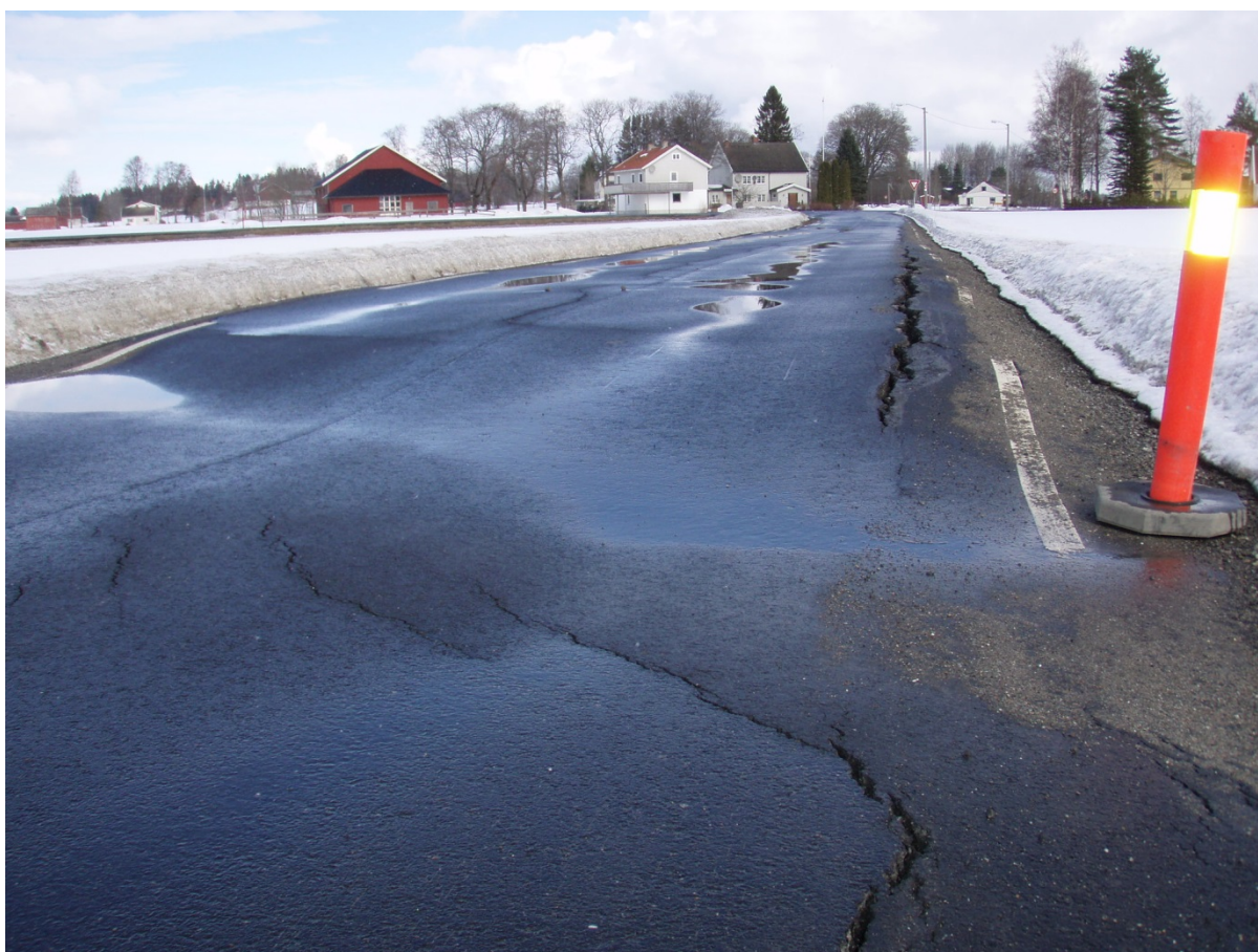
Figur 4-6 Telerelaterte lokale ujevnheter
