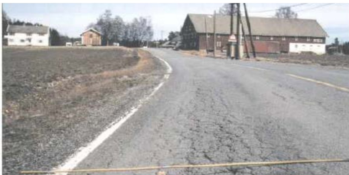
Figur 4-9 Spor på grunn av deformasjon
