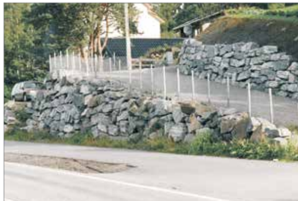
Små steiner og ujevn murkroner. Overflate og fuger gir et rotet inntrykk. Gjerdet på toppen forsterker det rotete inntrykket
