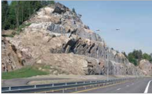
Fjellhyller med dårlig form
