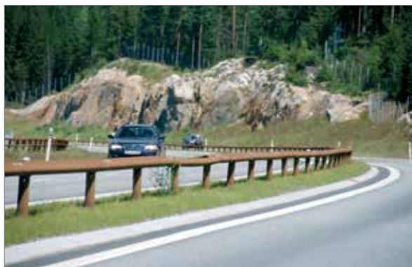
Rørrekkverk i rustet stål
