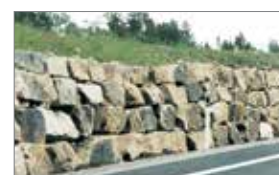
Dårlig håndverk, ujevn overflate
