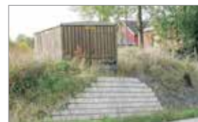
Betongelementer med dårlig tilpassing til terreng og bygning
