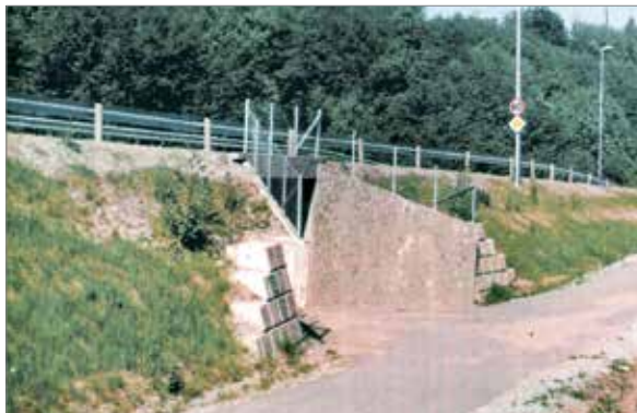
Kulvert med vingemurer og murer av prefabrickerte betongstein gir et dårlig inntrykk. Gjerdet på toppen forsterker det rotete inntrykket
