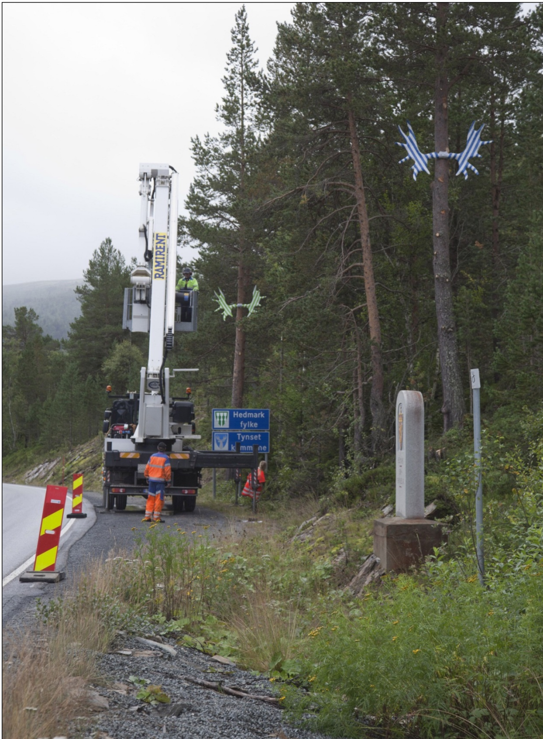
Figur 35 Montering av elggevir, Sør Trøndelag/Hedmark grense. Disse ble senere lyssatt. Foto: svv
