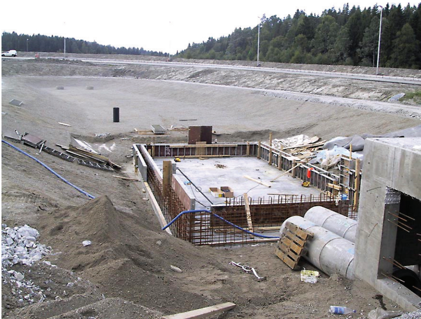
Figur 6.6. Vått overvannsbasseng under bygging i et kryssområde på E6 i Akershus. Slamdelen (forbehandlingen) er integrert i hovedbassenget og bygges med betongplate på bunnen for å lette slamfjerningen.
