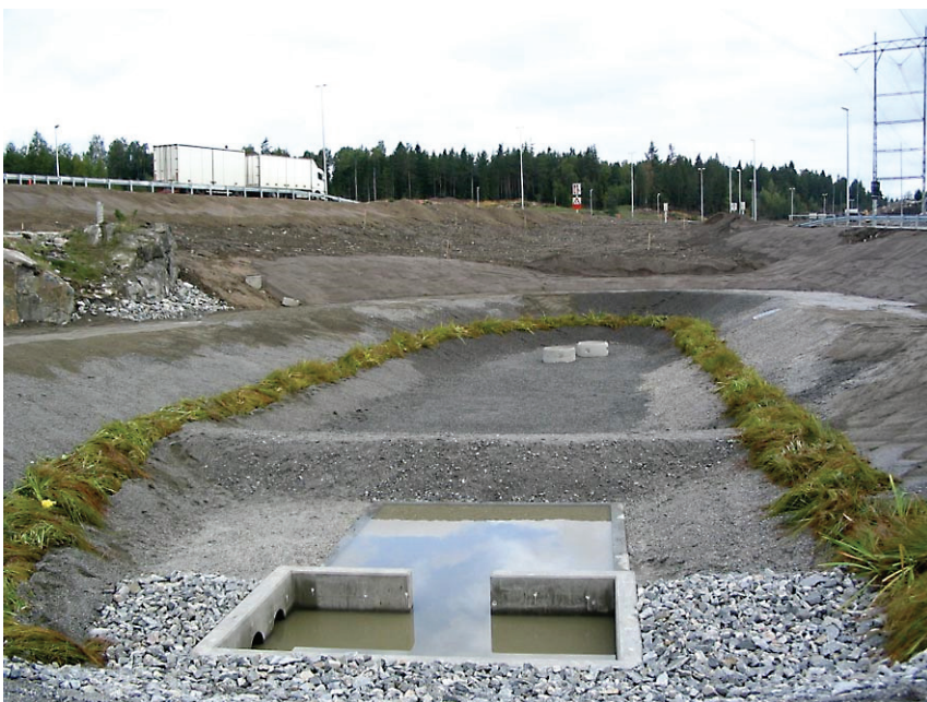
Figur 6.7. Vått overvannsbasseng under bygging i et kryssområde på E6 i Akershus. Slamdelen (forbehandlingen) er avgrenset fra hovedbassenget med en lav terskel/voll. Det er støpt betongplate på bunnen for å lette slamfjerningen. Energidreper er bygget rundt innløpet (til venstre). Vegetasjon er plantet i vannlinja.
