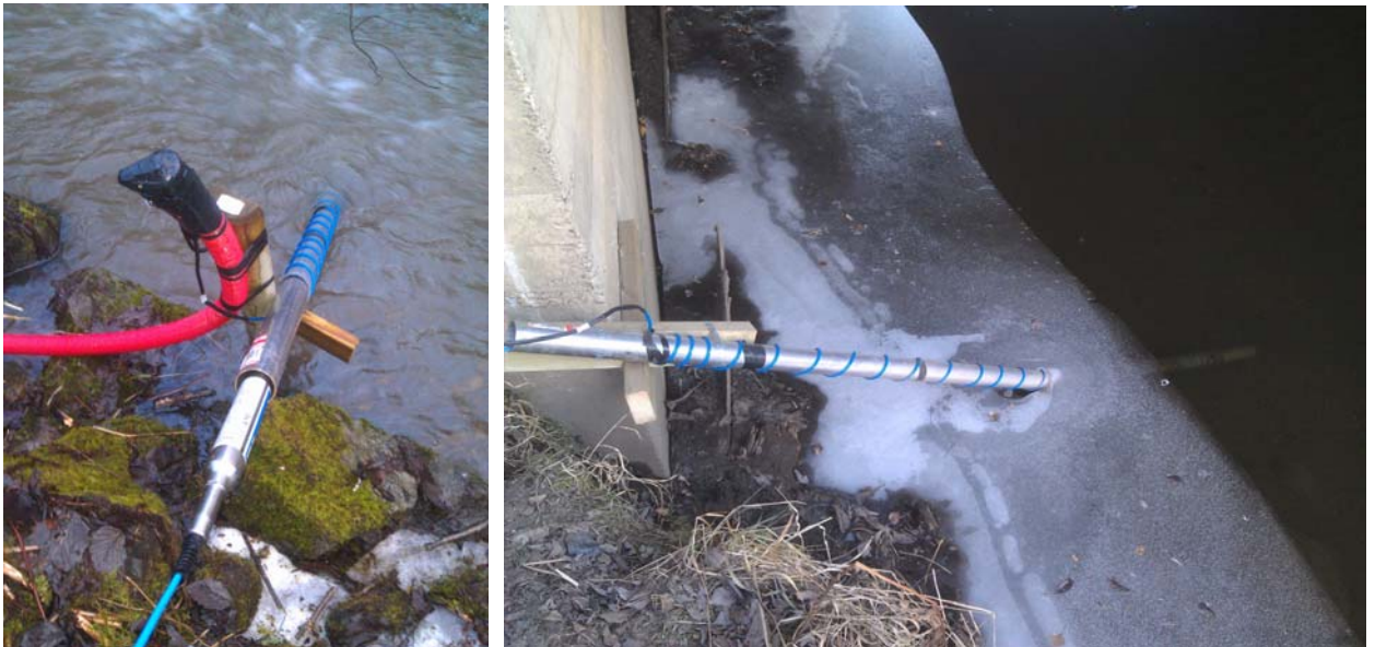
Figur 6. Vintersikring av MPS med slisset metallrør og varmekabel (Foto: Eirik Leikanger).
