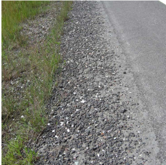
Figur 11. Steinslipp på skulder. Fv. 310, hp01, F1, m1400_Befaring 2.7.13.
