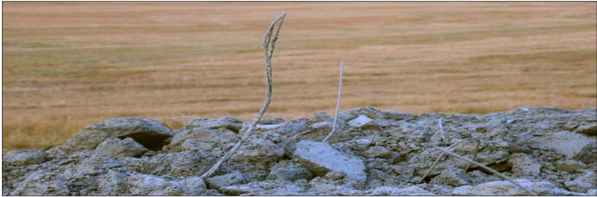
Figur 7.3 Oppstikkende spenntau. Fra E6 Melhus Foto: Dag Atle Tangen, Statens vegvesen
