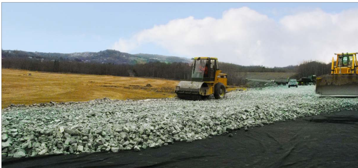
Figur 2.1 Knust betong i forsterkningslag. Fra E6 Melhus Foto: Dag Atle Tangen, Statens vegvesen
