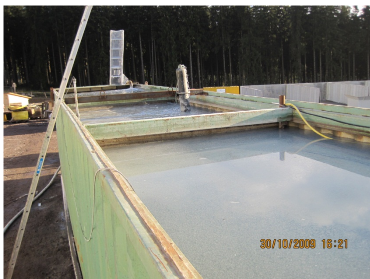
Figur 7: Eksempel på nøytralisasjonsanlegg bygget av entreprenør. Anlegget består av 3 deler. Innløpet er ved stigen i bakgrunnen. Agitator (rørverk med funksjon som virvler opp vannet/og eller lager strømning) med CO 2 -munnstykke ligger i andre seksjon av bassenget. Svart kabel på høyre side er strøm for agitator. Gul slange fører CO 2 til munnstykket. Første pH-måler er ved stigen på venstre side av bildet. Kabel i forgrunnen fører til andre pH-måler. (Foto: Carsten Rosskamp, Bilfinger)
