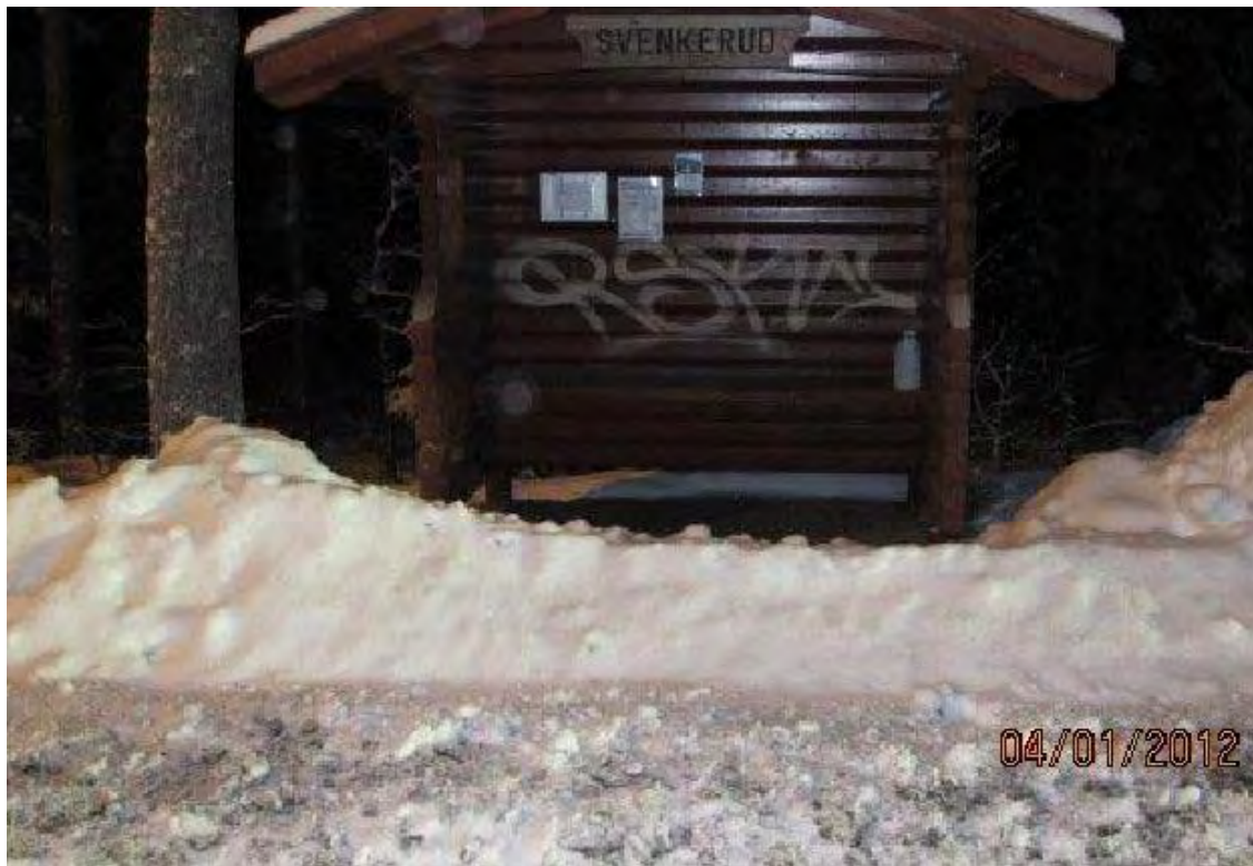
Figur 4-65 Mangelfull rydding foran leskur (Foto: Kjetil A. Bø, Statens vegvesen)
