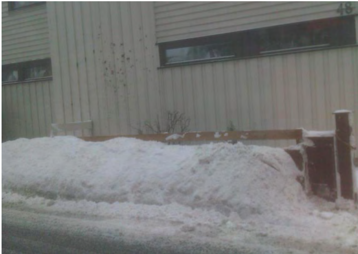
Figur 4-79 Uønsket sprut fra brøyting på fasade (Foto: Rudi Thomassen, Statens vegvesen)
