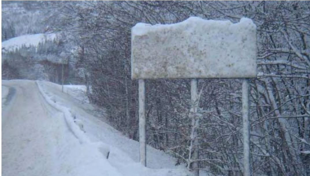
Figur 4-77 Nedsprutet trafikkskilt (Foto: SINTEF). Brøytefart over 40 km/t øker problemet med snø- og slapsesprut som dekker til skilt, og skader skilt, kantstolper, brøytestikk og andre installasjoner langs veien.
