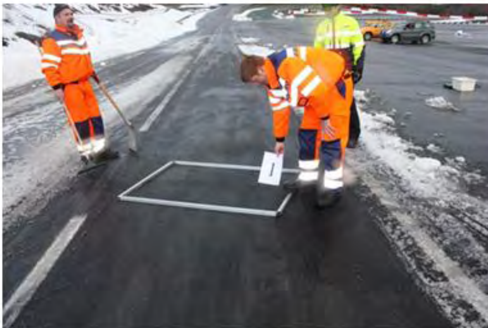
Figur 4-53 Mengde snø før og etter tiltak ved brøyting i 40 km/t. Det meste av snø/slaps er fjernet. (Foto: Statens vegvesen)
