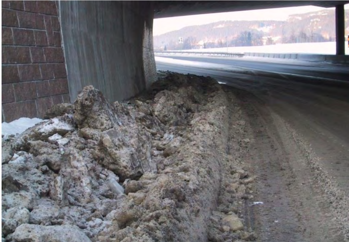
Figur 2-40 Ubrøytet fortau i undergang (Foto: Statens vegvesen)
