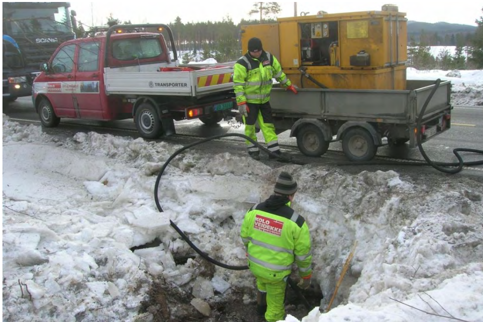
Figur 9-2 Tining av stikkrenne (Foto: Knut Magne Reitan)
