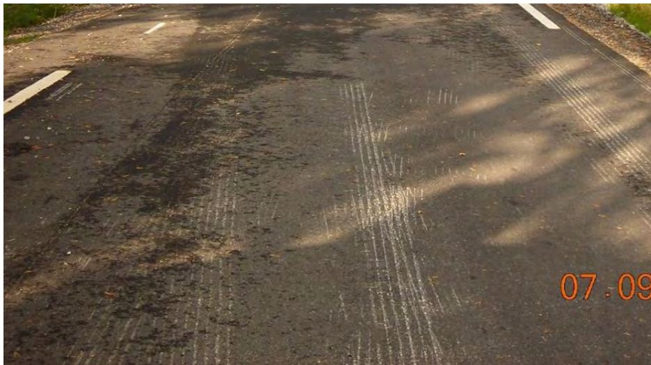
Figur 4-37 Skader på fast dekke (Foto: Statens vegvesen)
