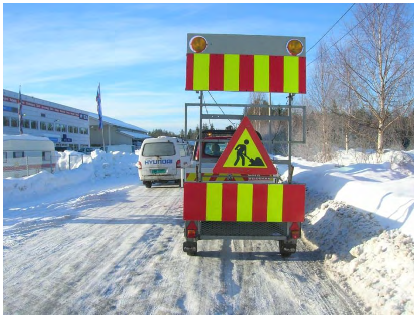
Figur 2-10 Arbeidsvarsling må gjennomføres etter retningslinjene
