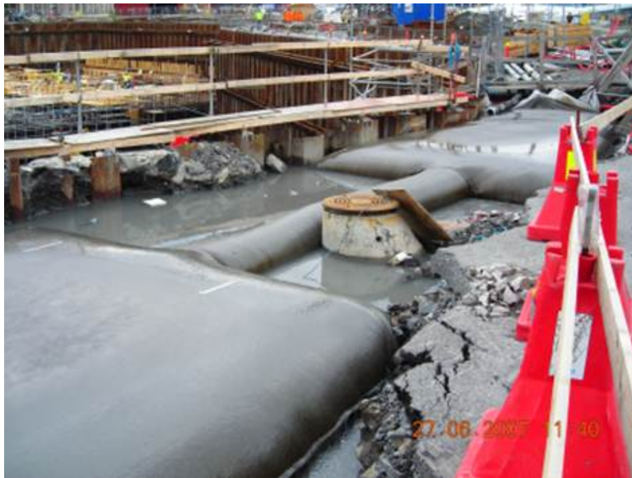
Figur 4: Siltpose som filterløsning etter vannbehandling i container. Fra NCC sitt vannrenseanlegg i E18 Bjørvika, Etappe 1, Havnelager-entreprisen. Foto: Rambøll. Bildet er tatt av Guro Thue Unsgård og gjengitt med tillatelse av Rambøll.
