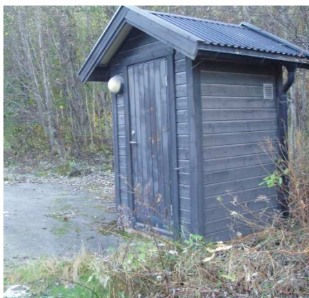
Figur 8. Pumpestasjon for vaskevann fra Nordbytunnelen.
