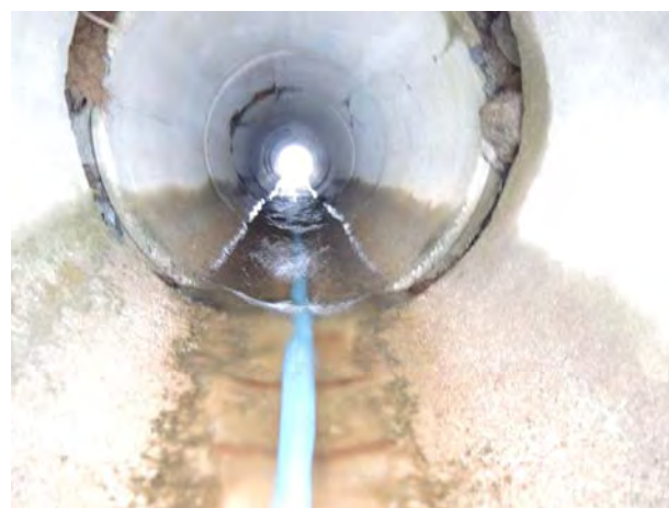
Figur 3. Ytterste rør er glidd ut, ellers god standard. Foto KM Reitan
