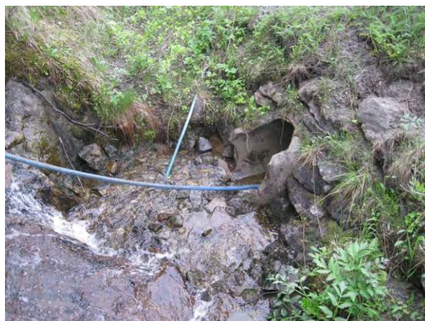
Figur 1. Innløp, rør ødelagt pga graving av is med gravemaskin. Foto KM Reitan
