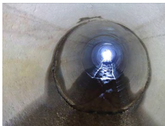
Figur 3. Dårlig skjøt mellom de øverste rørene, ellers god standard. Foto KM Reitan
