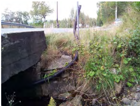
Figur 2. Rør som leder steamslangen inn i stikkrenna. Foto KM Reitan
