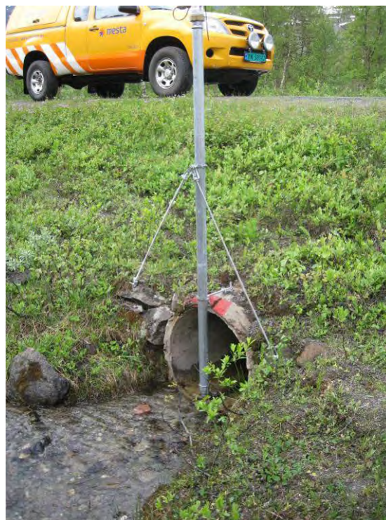
Figur 1. Innløp med oppstikk med adapter. Foto KM Reitan
