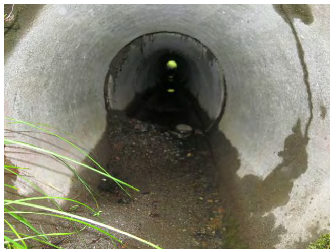
Figur 3. Dårlig skjøt av rørene i innløpet, ellers bra standard på renna. Mye grus i renna. Foto Øystein Larsen, Vegdirektoratet
