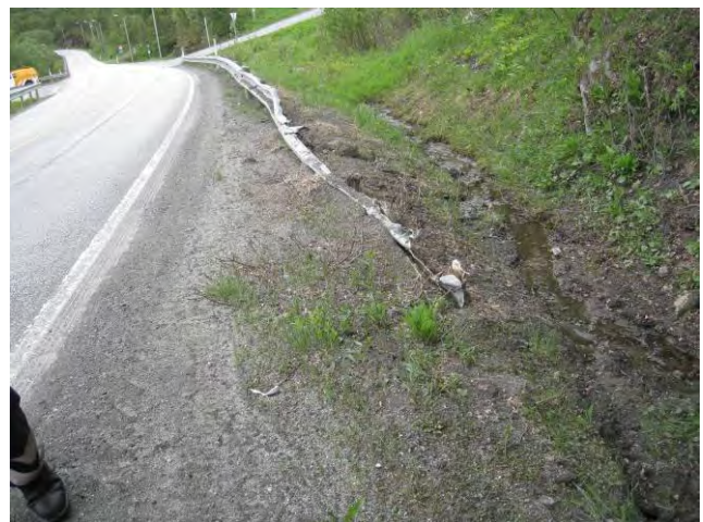
Figur 17 Rombaksvegen, GHW 3: Kantlinje, asfaltdekke og rekkverkt ødelagt under høvling av isgrøft Foto: Knut Magne Reitan, Siving. Reitan AS
