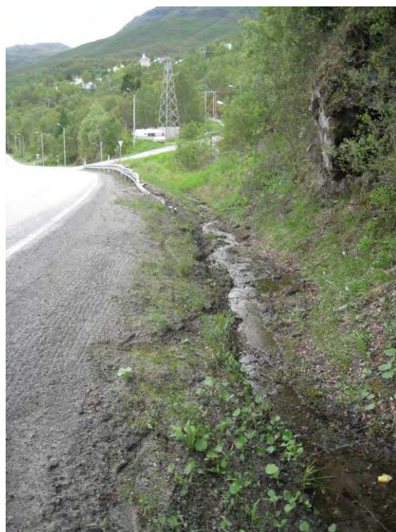
Figur 2. Grøfteprofil mot nord. Rekkverksavslutning ødelagt under høvling av isgrøft. Foto KM Reitan
