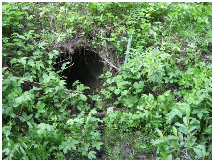
Figur 1. Innløp. Foto KM Reitan
