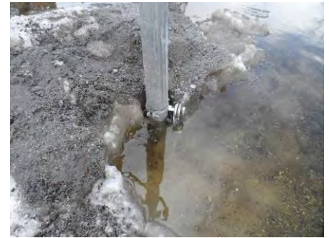
Figur 15. Normal åpning rundt innløpet av IGS-rør etter tining Foto Håkon Svendsen, Mesta
