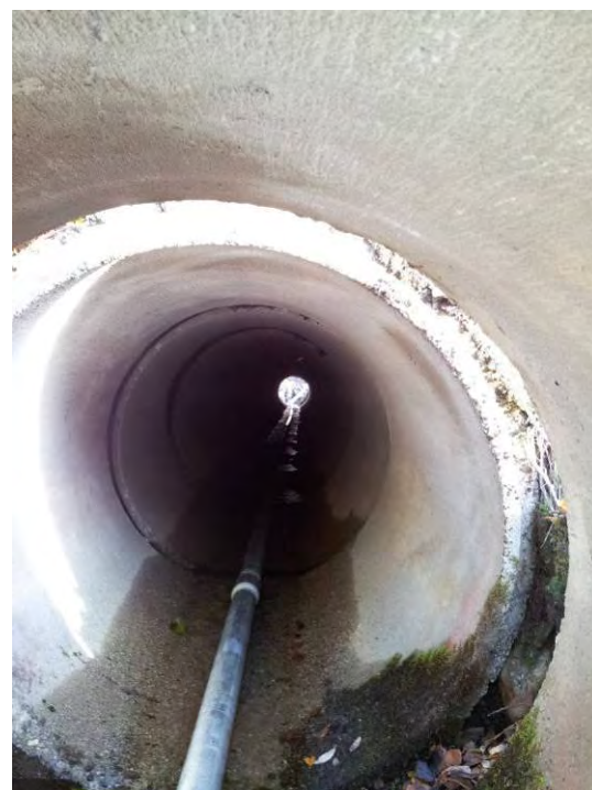
Figur 3. God standard på stikkrenna, men siste rør er glidd ut. Foto KM Reitan
