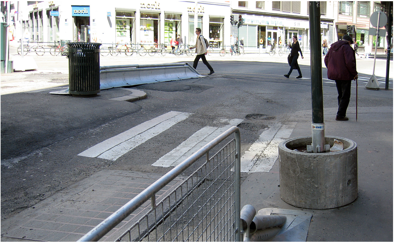
Å fotgjengere gjennom anleggsområdet fikk høy prioritet. Likevel var det noen mangler gjorde at folk gikk utenfor sikret GS-veg. Bildet viser lite informasjon og merking som kan virke villedende på fotgjengere.
