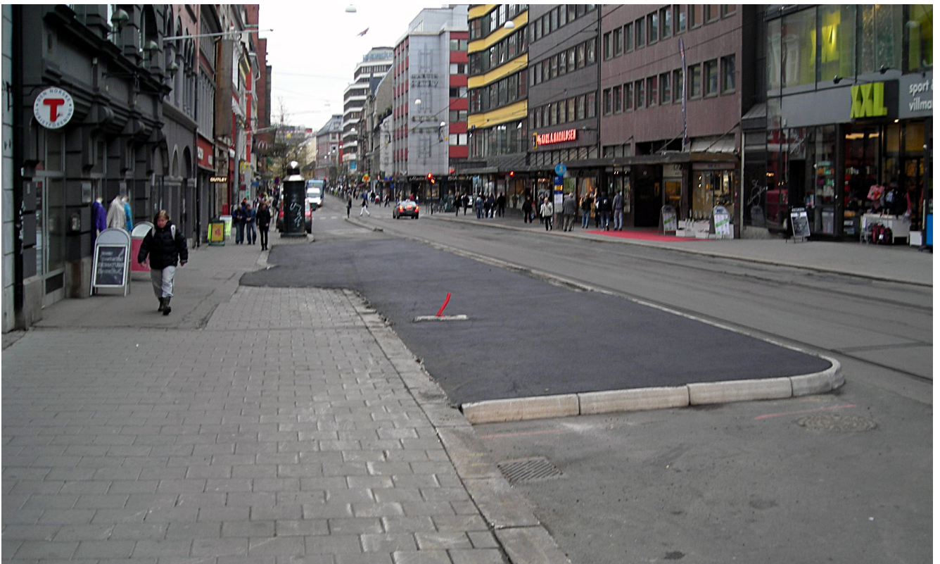
Midlertidige busstopp ble anlagt da rutene ble endret under anleggsarbeidet. Dekket var av asfalt og var lett å fjerne da anleggsarbeidet var ferdig.
