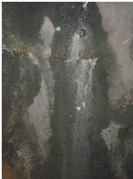
Foto nr. 4: Km 5310, venstre side. Kjerne k15. Betongen har god kontakt til fjell. Område med flere lekkasjer og mineralutfellinger. En horisontal sprekk med lekkasjer. Moderat kalkutfelling i lekkasjen. Alle lekkasjene er moderate. Svovulgule, hvite og svarte utfellinger.
