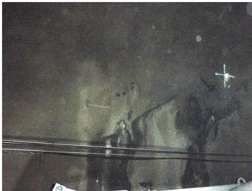
Foto nr. 2: Km 3790, høyre vederlag. Betongen har god kontakt til fjell, er flekkvis fuktig. En sprekk med lekkasjer i høyre vederlag. Moderat kalkutfelling i lekkasjen. Alle lekkasjene er moderate. Ingen synlig nedbrytning.
