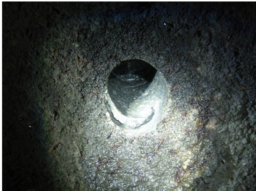
Foto nr. 6: Km 5450, venstre side. Kjerne k 17 boret i lekkasjen. Fiber som ligger i overflaten har korrodert. Fiberkorrosjon kun i overflaten. Utfellinger i overflaten.
