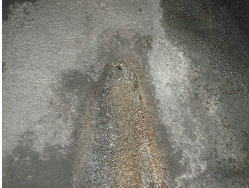
Foto nr. 3: Km 5310, venstre side. Kjerne k15. Betongen har god kontakt til fjell, er flekkvis fuktig. Den øverste lokaliteten hvor det ble boret i lekkasjen. Uten fiberkorrosjon i dybden.
