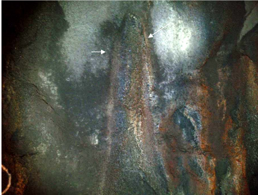
Foto nr. 5: Km 5450, venstre side. Kjerne k 17 boret i lekkasjen. Betongen har god kontakt til fjell. Parti med konsentrerte lekkasjer og hvite, brune og mørke utfellinger. Som fotoet antyder utfelles mineralene i utkanten av vannsaget slik at det dannes en opphoping langs vannstrømmen (pil). Fiberkorrosjon kun i overflaten.
