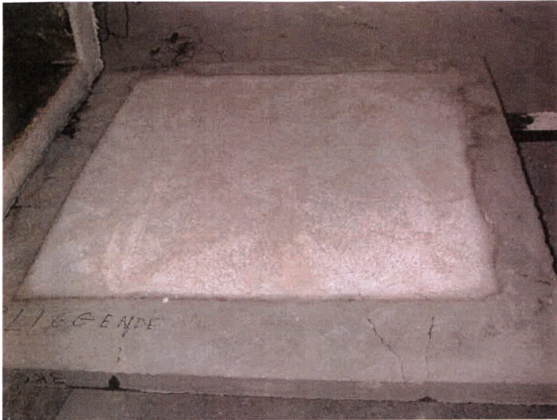
Foto 3: Eksponert side av prøvestykke C etter brann testen. Ingen avskalling.
