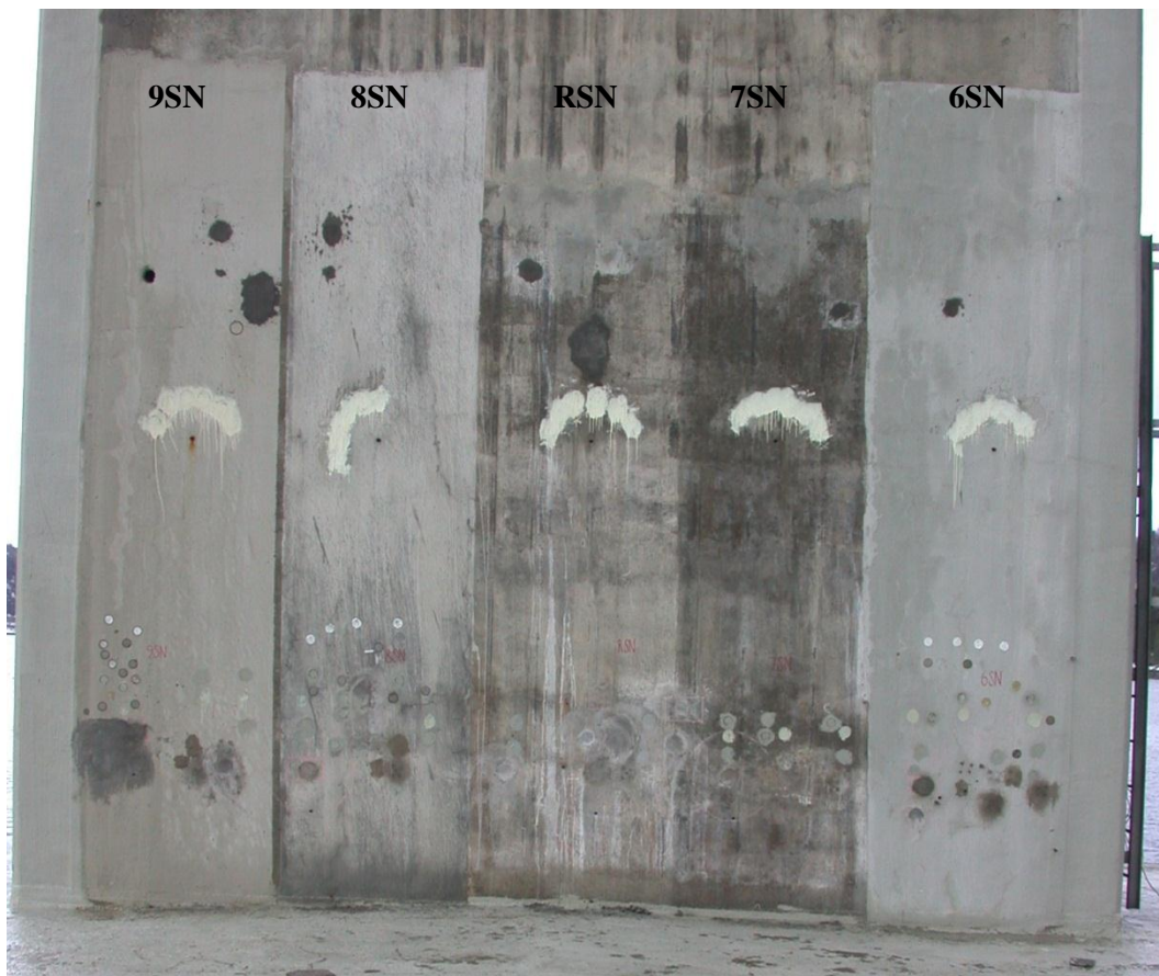
Figur 5 Søndre side av nordre søyle i 1994 øverst, 2005 nederst. Legg spesielt merke til forskjellene for produkt 7 til høyre for RSN (midt på bildet.)
