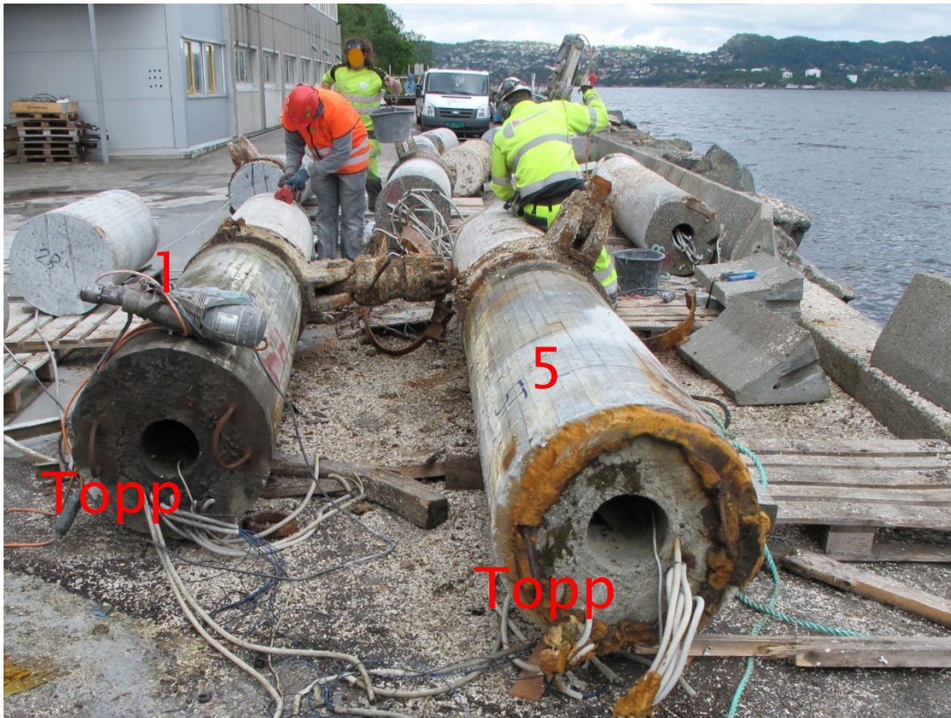
FIGUR 6: UTBORING AV KJERNER FRA SØYLE 5 I BUNN OG MARKERING AV ARMERING PÅ SØYLE 1 I BUNN
