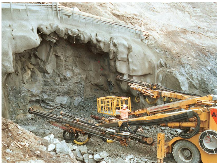
Figur 6.3 Eksempel på uheldig løsning i påhugg. Det er noe forbolting, men den er ikke bundet sammen med armering ev. heller ikke sprøytet inn. Resultatet er utfall og svært ujevn kontur. (Foto: Statens vegvesen).
