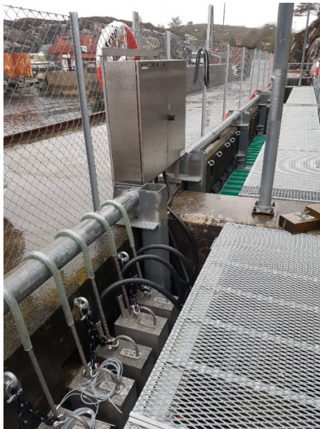
Figur 6 – Måleskap med måleutstyr i umiddelbar nærhet til de instrumenterte elementene.
