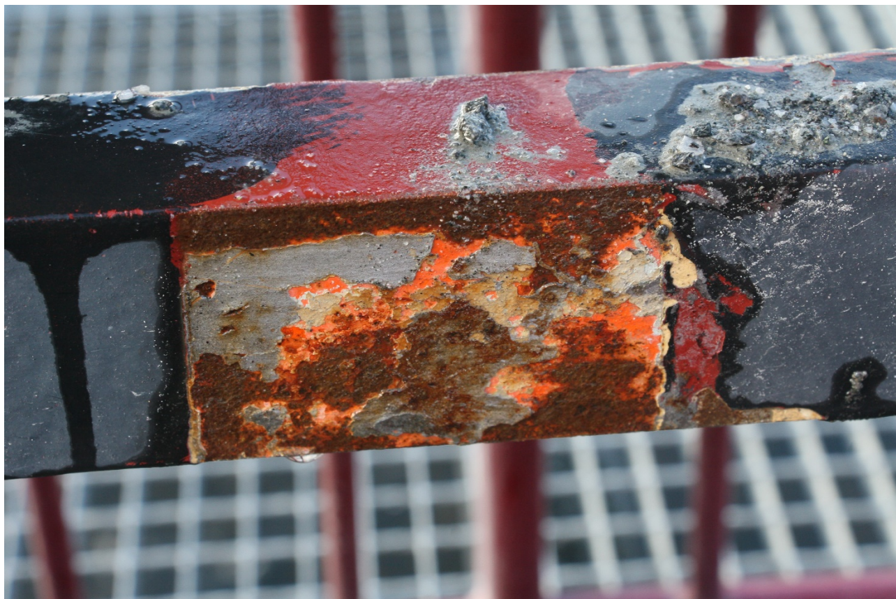
Figur 8. Skader i belegget på rekkverk som viser blymønje i underliggende strøk
