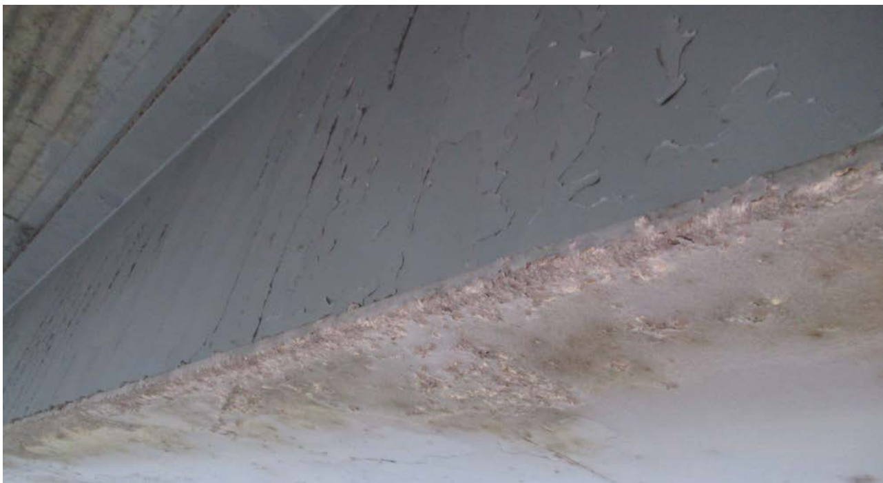
Figur 13. Korrosjon på innside av bærebjelke og underside av underflens (2017) på Kvalpsundet bru.
