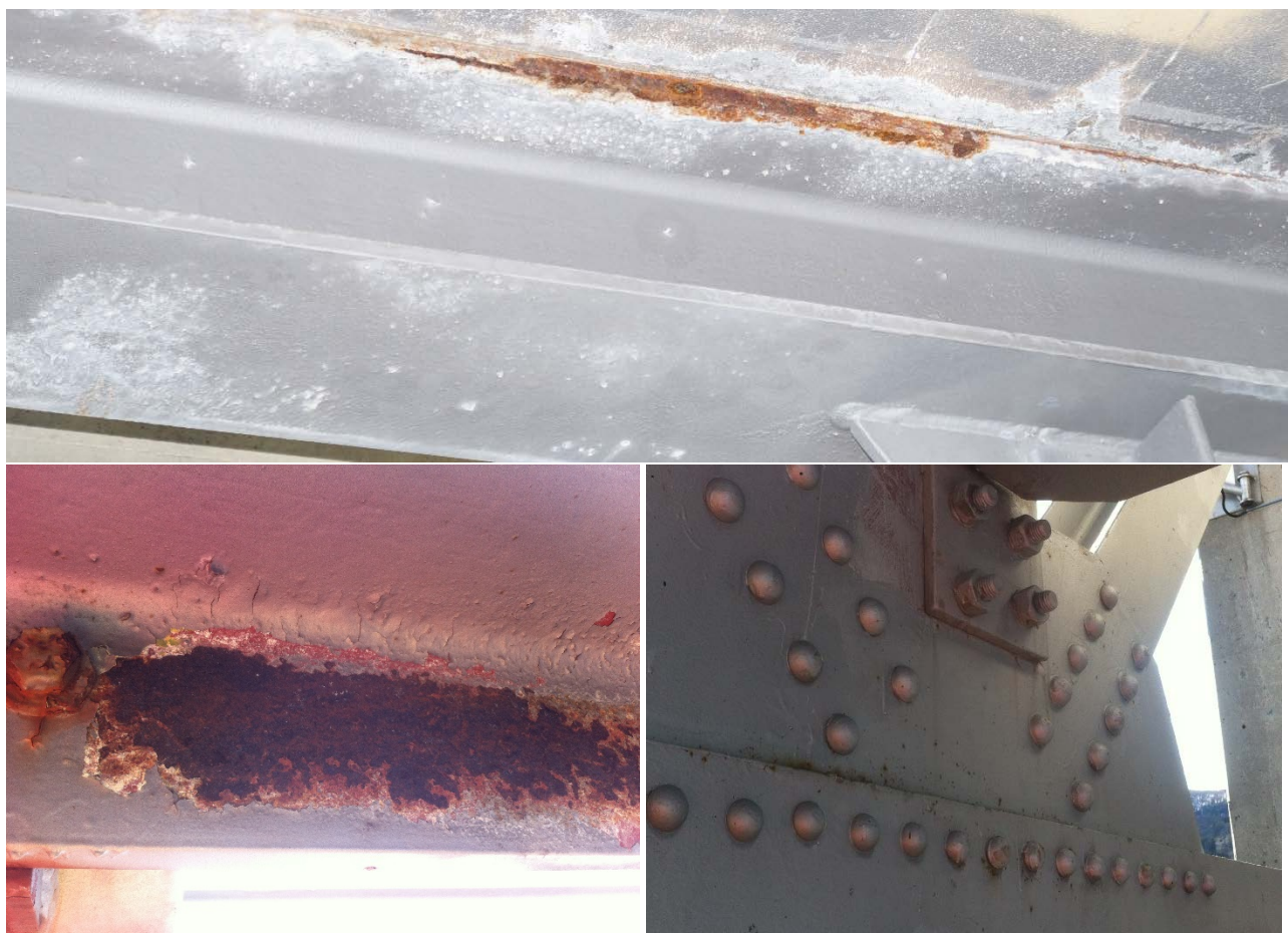
Figur 14. Nedbrytning av belegg på Tjeldsundbrua.
