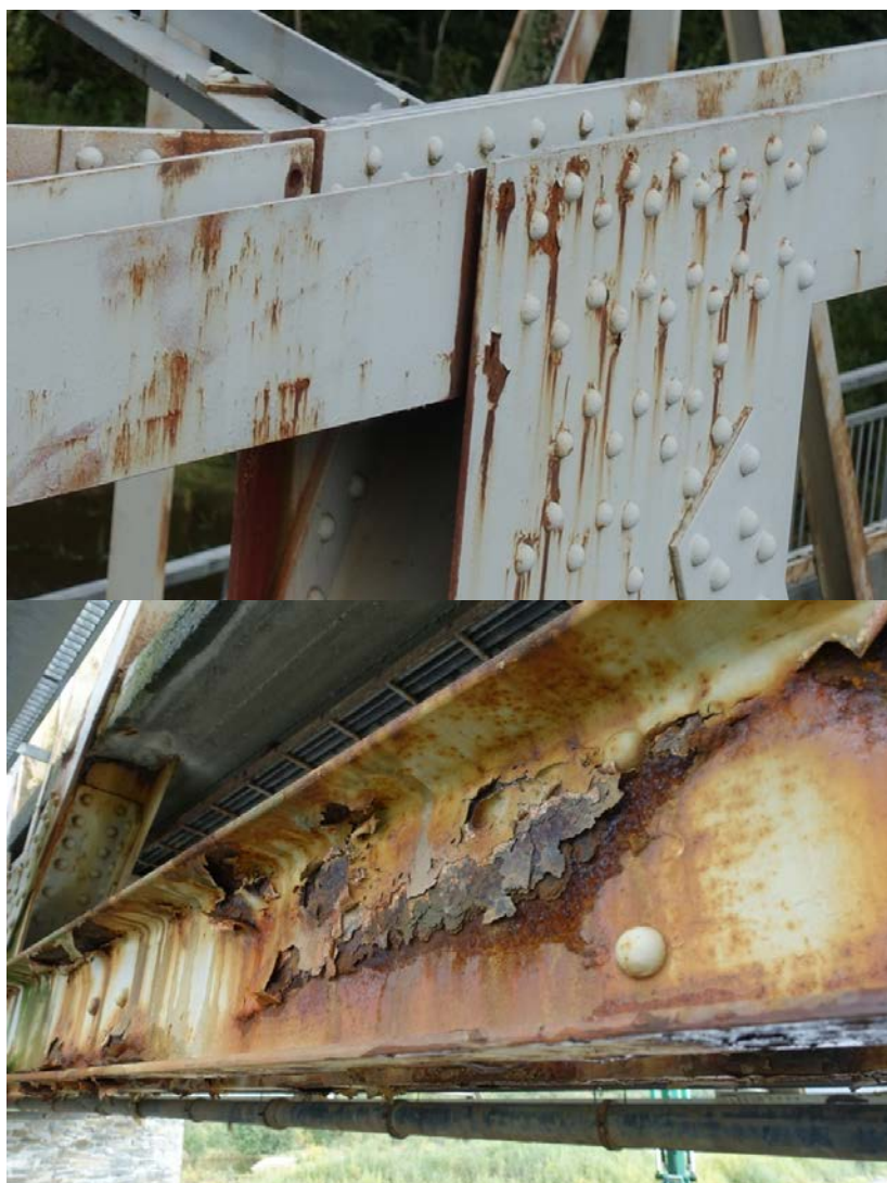
Figur 7. Nedbrytning av belegg på overgurt (over) og undergurt (under) på Kvål bru
