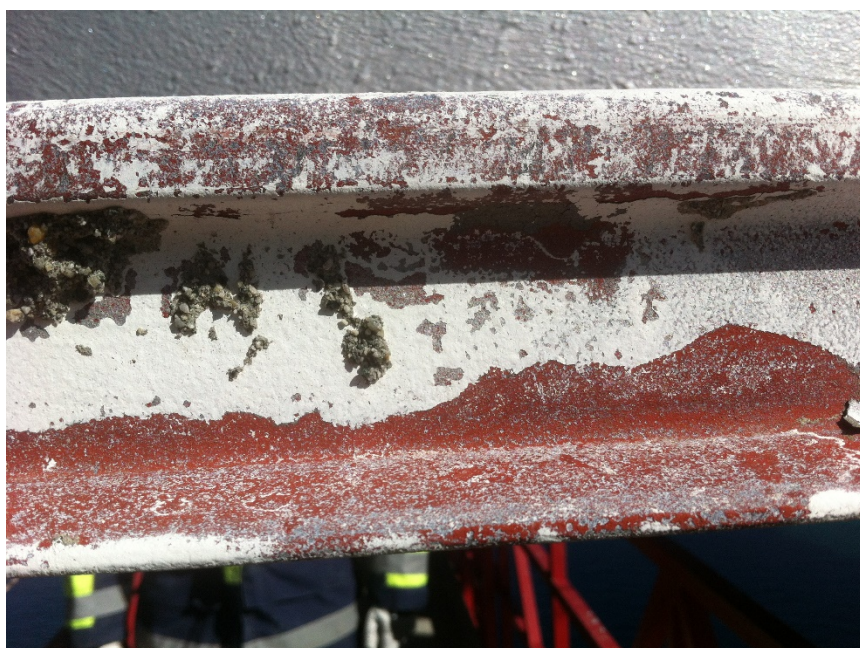
Figur 19. Rød sinkkromatholdig maling brukt mellom 1967 og 1969.
