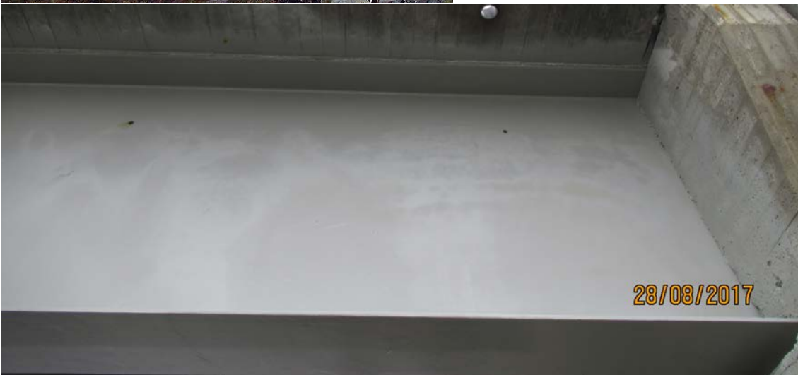
Figur 12. Tilstand til belegget på Madsøybrua
