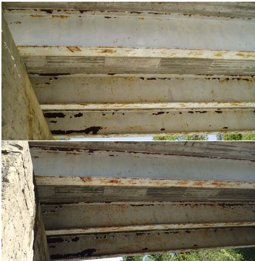
Figur 9. Tilstand til belegg på Ena bru i Midtre Gauldal. Øverste bilde er tatt i 2007 og nederste i 2017
