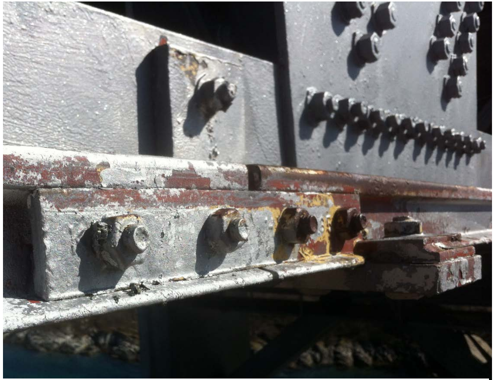
Toppstrøket på Tjeldsundbrua er slitt av og eksponerer underliggende rød kromatholdig maling. Byggeår 1967. Bildet ble tatt i 2015.
