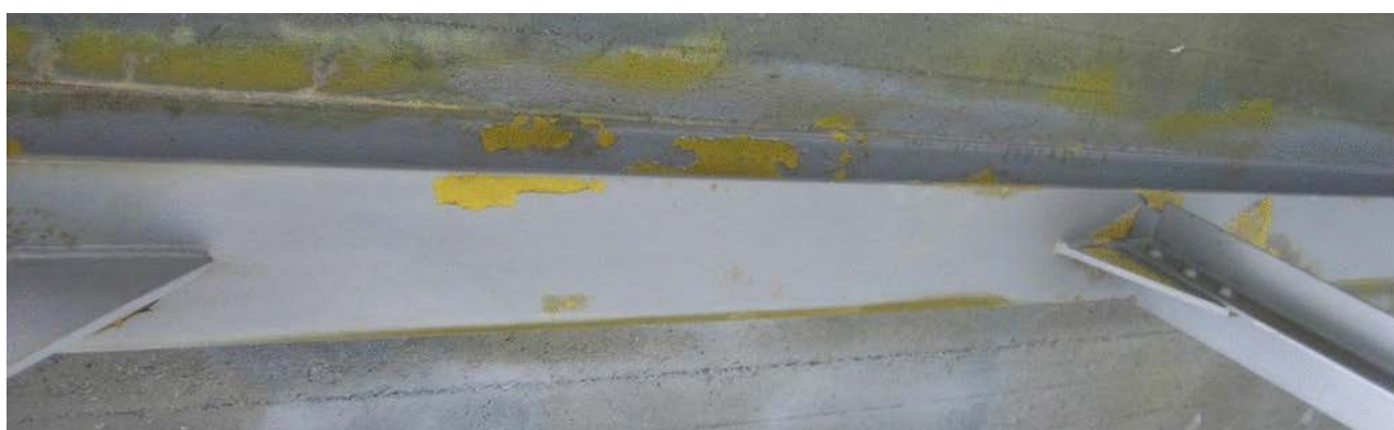
Figur 11. Tilstanden til belegget på Rombaksbrua før vedlikehold i 2011.
