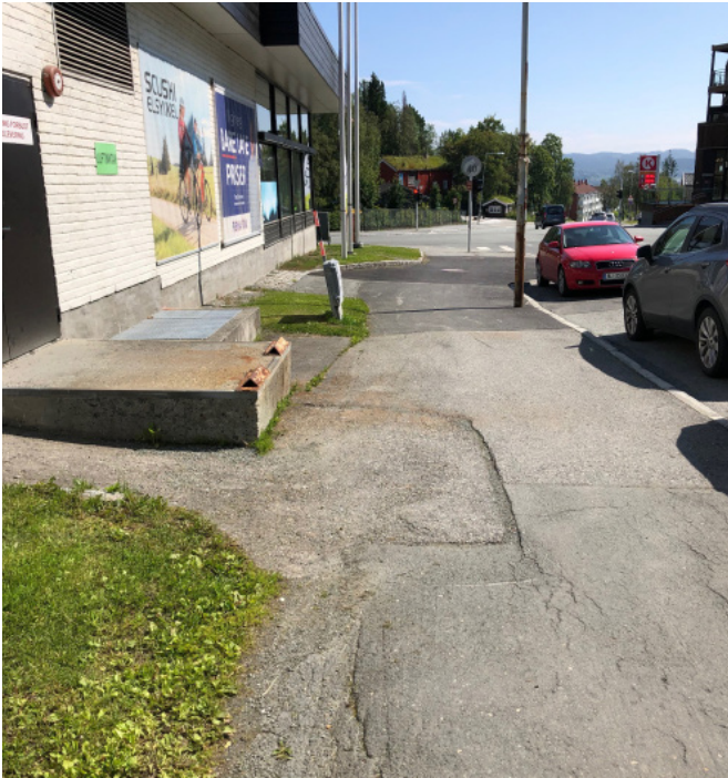
Bilde 2.5: Her er ikke ferdselssonen tydelig avgrenset, og den flyter ut i veggsonen. Det er flere hindringer på siden av vegen som kan føre til farlige situasjoner for personer med nedsatt syn. Her kunne man lagt en gatesteinslinje langs gresset som et ledende element. Byåsen butikkssenter, Trondheim. Foto: Frøydis Hollakleiv.
