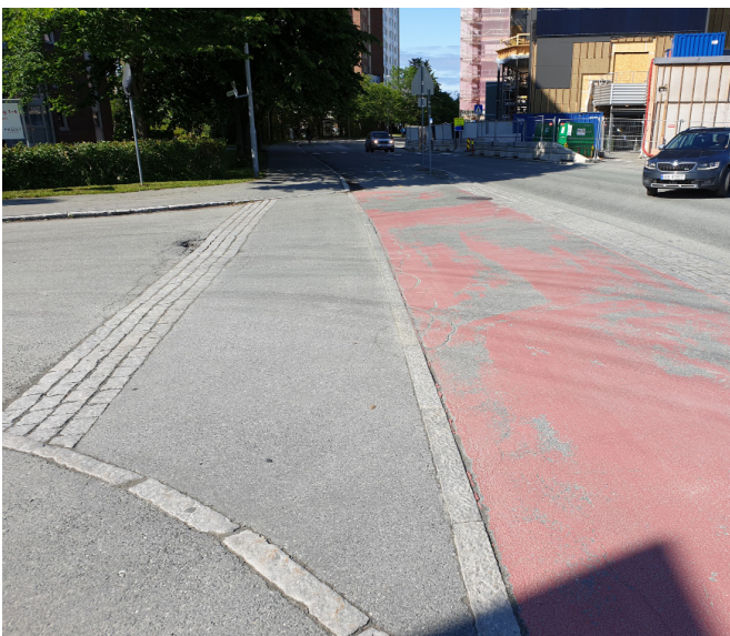
Bilde 2.7: Langs denne brede avkjørselen er ferdselssonen markert med gatestein på venstre side, og kantstein mot sykkelfeltet bidrar som avgrensning på høyre side. Trondheim. Foto: Liv Øvstedal, Statens Vegvesen
