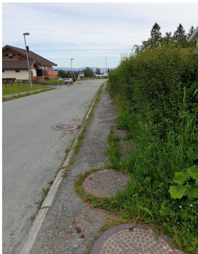
Bilde 2.2: Her er ikke ferdselssonen tilstrekkelig bred, og dekket er lite framkommelig for en rekke fotgjengere. Det smale fortauet fører til at rullende og andre vil trekke ut i vegbanen. Et enkelt tiltak vil være å fjerne vegetasjonen og reasfaltere fortauet. Driftsprosedurene bør oppgraderes for å unngå slike situasjoner. Tiller, Trondheim. Foto: Liv Øvstedal, Statens Vegvesen.
