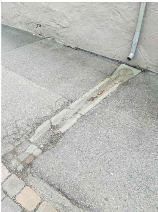
Bilde 2.4: En eldre vannrenne som kan skape problemer for rullestolbrukere og rullatorbrukere. Baklandet, Trondheim. Foto: Jahn Ivar Kjølseth.
