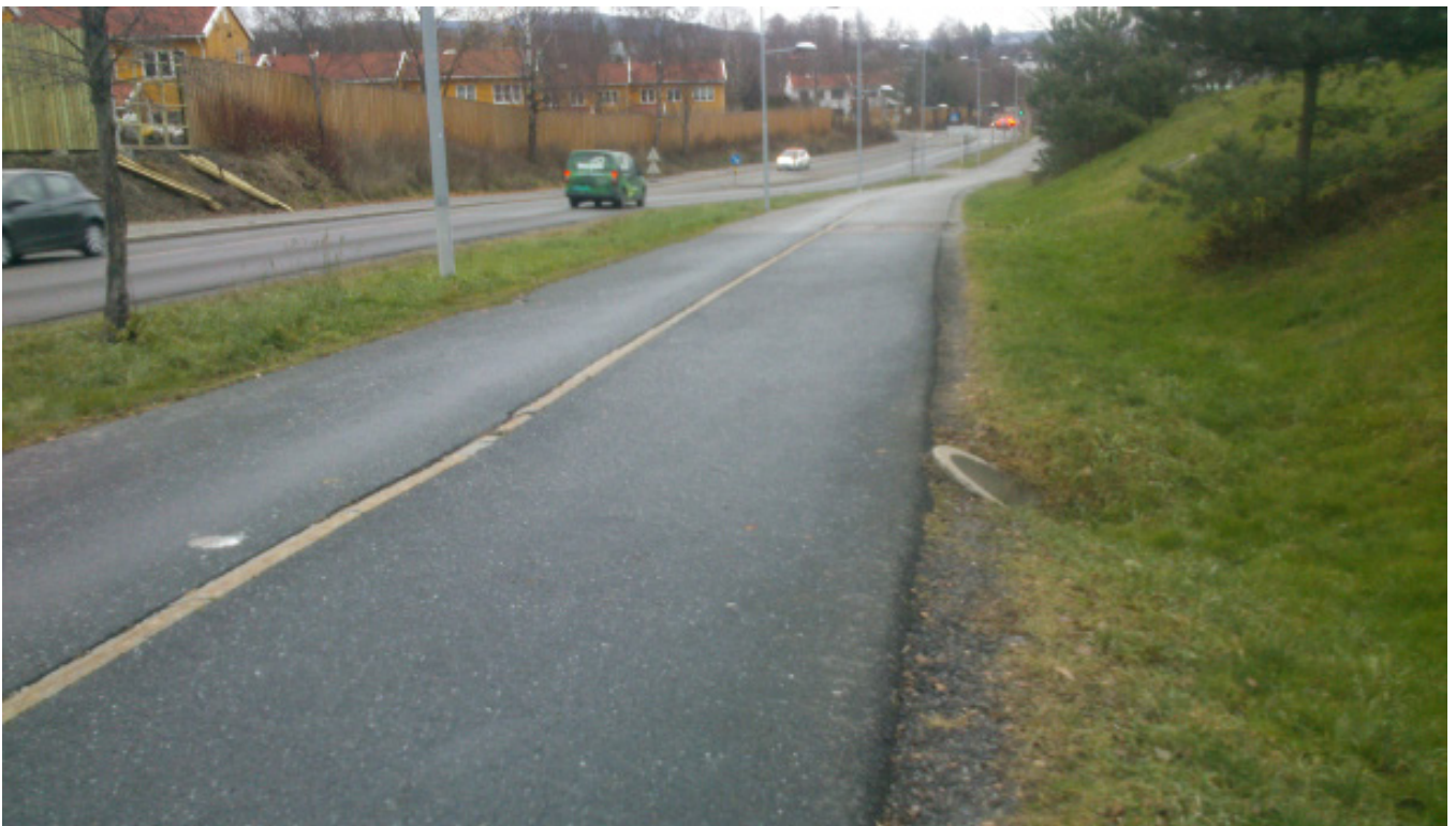
Bilde 2.12: Sluket til høyre for gang- og sykkelvegen kan utgjøre en fare for personer med nedsatt syn som følger høyresiden. Her kan man legge lys kantstein med tilstrekkelig vishøyde forbi sluket slik at svaksynte og personer med blindestokk ledes forbi. Oslo. Foto: Liv Øvstedal, Statens Vegvesen.
