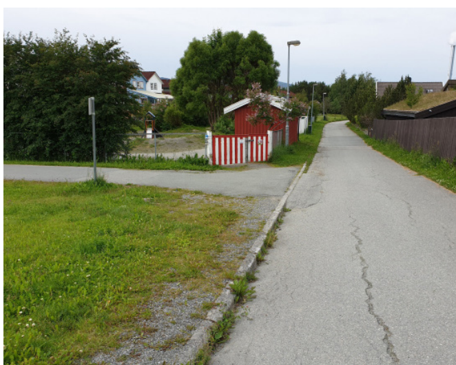
Bilde 2.20: Her har noen bygd en asfaltovergang fra kantsteinen og ned i gang- og sykkelvegen. På denne måten blir det lettere å krysse med blant annet sykkel, vogn og rullestol. Trondheim. Foto: Liv Øvstedal, Statens Vegvesen
