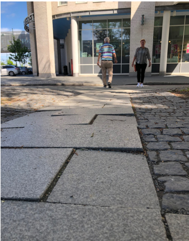
Bilde 4.1: Heller er anlagt i ferdselssonen for å skape et jevnt underlag med kontrast til omgivelsene, men hellene har forflyttet seg og utgjør snublefare. Hellene burde legges på nytt med bedre grunnarbeid eller man kan prøve et annet materiale, f.eks. asfalt. St. Olavs hospital. Foto: Frøydís Hollakleiv.
