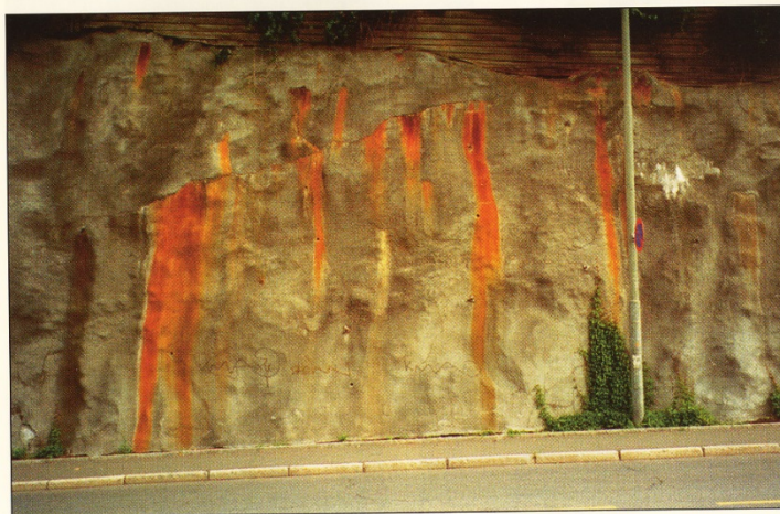
Skjæring i alunskifer sikret med sprøytebetong. Oksidasjon av svovelkis i skiferen har ført til rustutfelling og frigjøring av sulfationer. Det er stedvis registrert oppsmuldring ved sulfatangrep, samt utfelling av kalsiumkarbonat.
