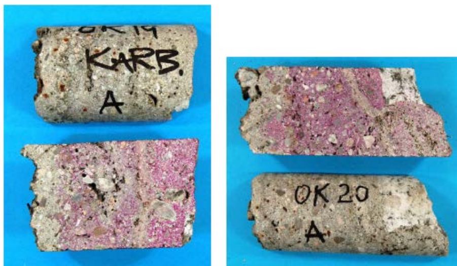
VI.30. Overflatekarbonatisering inntil omkring 12 mm. Betongalder 10 år. Foto: SINTEF.
