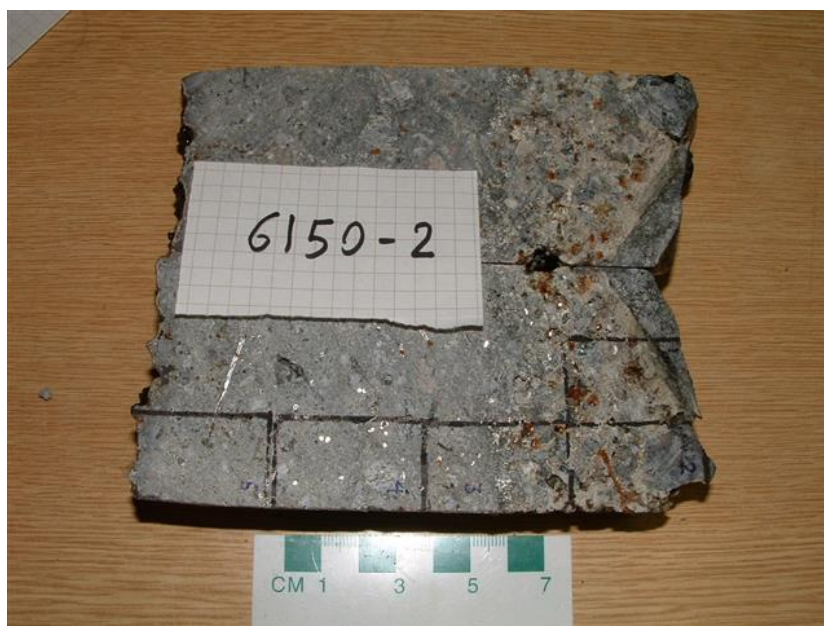
V4.53. Kjerne 6150 med tynnslipområder. Merk kraftig utluting og nedbryting med destruktiv fiberkorrosjon inntil 40 mm fra heftsona. Årsaka var i dette tilfellet innverknad av syrer frå biofilm som hadde trengt inn på heftsona (Hagelia 2011b). Dette er svært uvanleg. Betongalder 12 år. Foto: Per Hagelia
