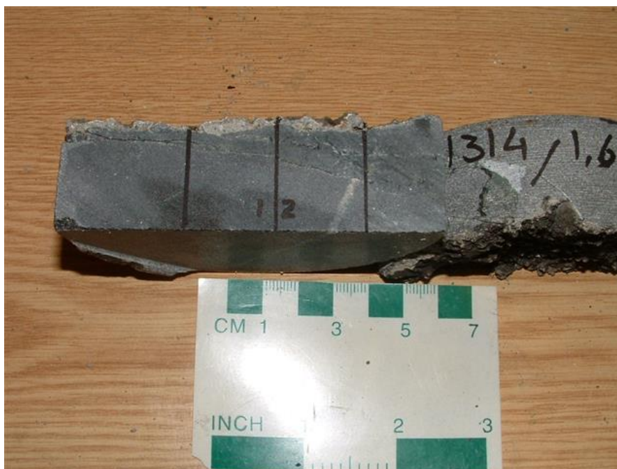
V4.16. Kjerne 1314 med tynnslipområder. Merk svært tynn og kvit sprøytebetong. Muleg er noko av betongen tæra bort. Betongalder 15 år. Foto: Per Hagelia.
