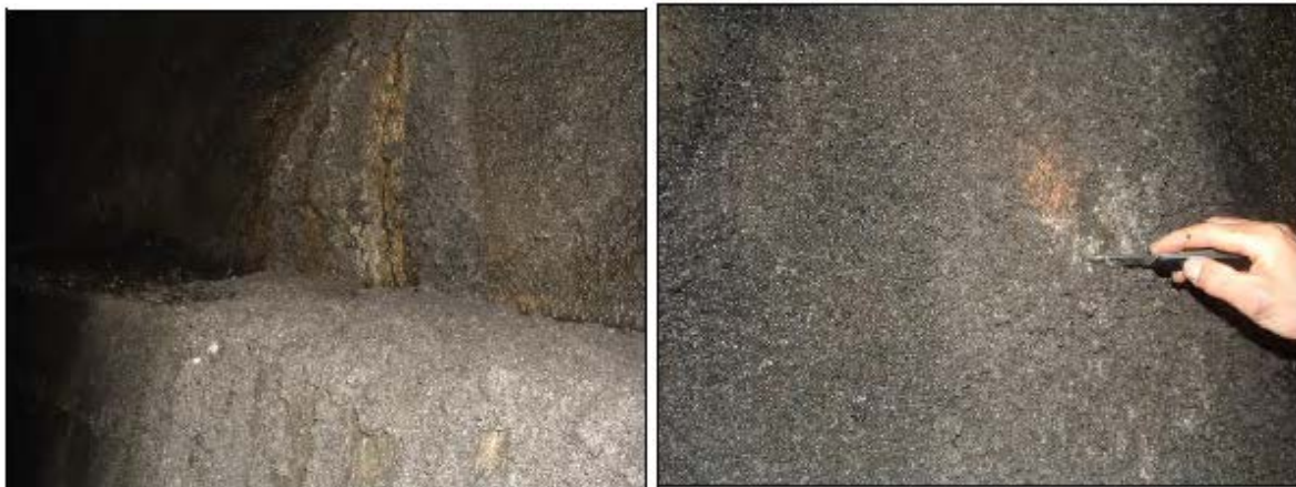
V4.40. Laus betong på sprøytebetongoverflater og bankett var svært vanleg i den undersjøiske delen av Freiffjordtunnelen i 2006 (Betongalder 15 år). Dette er ikkje prelltap, men gips ( \text{CaSO}_4 \cdot 2\text{H}_2\text{O} ). I samband med rehabiliteringa i 2006-2007 blei dette bellegget spylt vekk før påsprøyting av ny betong for å unngå sulfatangrep og avskaling langs ny heftsone. Foto: Per Hagelia.
