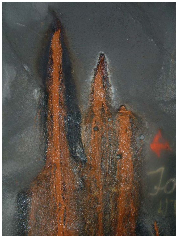
V4.86. Pelnummer 16060 vis a vis inngangsdøra til transformatoriosk med lokaliteter for KJ I, II, II, IV og V. Utboring av kjernene april 2004 ved betongalder 5 år. Fotoet er frå vinter 2005/2006 ved betongalder 6 år. Foto: Per Hagelia.
