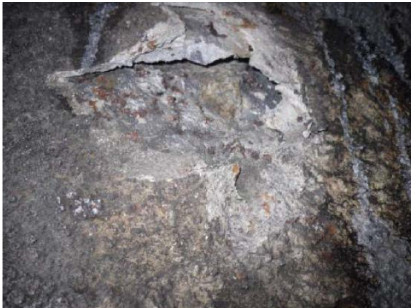
V4.8. Flekkerøytunnelen, pelnummer 1380H med avskaling: området for tynnslip 1380-9. Bergoverflata var vår utan biofilm. Betongalder 26 år: Foto: Mannvit.
