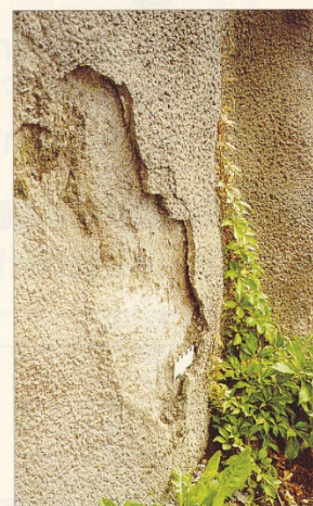
Thaumasittangrep har ført til avskaling og fiberkorrosjon i sulfatresistent sprøytebetong på alunskifer i Oslo. Sementlimet er fullstendig oppsmuldra i eit 1–2 cm skikt.
