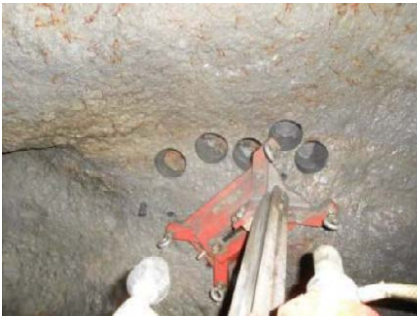
V3.22. Ekeberg tunnelen, pelnummer 1815H. Uttak av kjerner, inklusive strukturanalyse med tynnslip (sjå Tabell 4.14). Betongalder 22 år. Foto: Mannvit.
