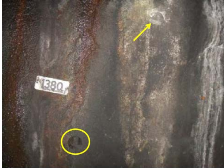
V4.9. Flekkerøytunnelen, pelnummer 1380H med avskaling: området for tynnslip ST1380 (gul pil) og tidlegare kjerneboring. Bergoverflata var våt delvis med biofilm. Betongalder 26 år: Foto: Mannvit.
