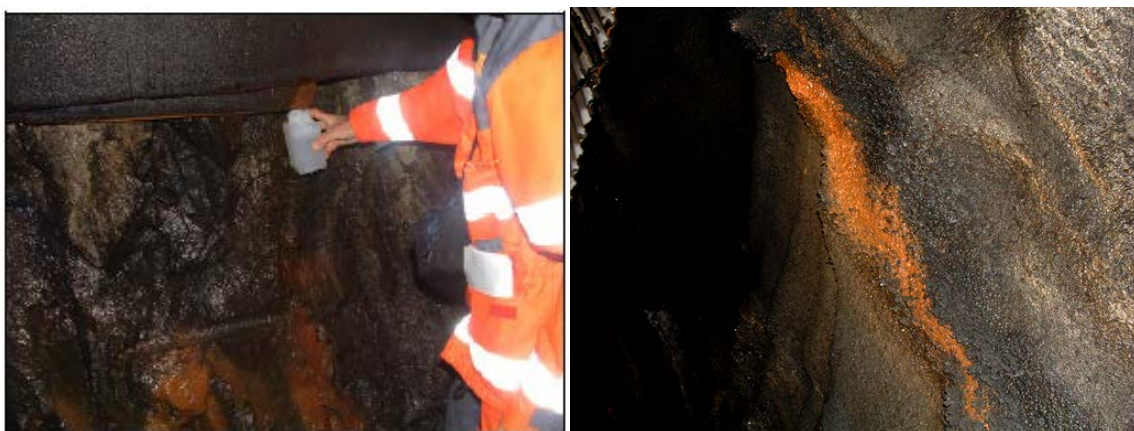
V4.41. Prøvetaking av vatn ved pel 4930. Vatnet rann langs biofilm bak platetaket. Høgre bilde viser kraftig nedbryting under syregivande biofilm (rusta) og med utfelling av gips på kvar side (grå-svart). Betongalder 15 år. Foto: Per Hagelia.
