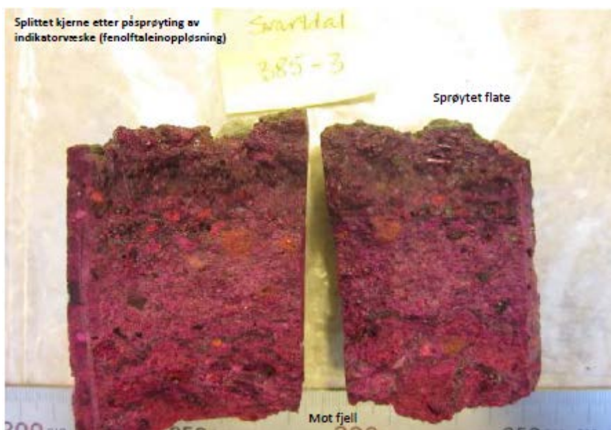
V3.52. Kjerne 385-3. Overflatekarbonatisering inntil 1-2 mm, men med litt diffus karbonatisering ned til 10-20 mm. Kjernebrot, kontakt mot berg er ikkje bevart. Betongalder 16 år. Foto: Mannvit.
