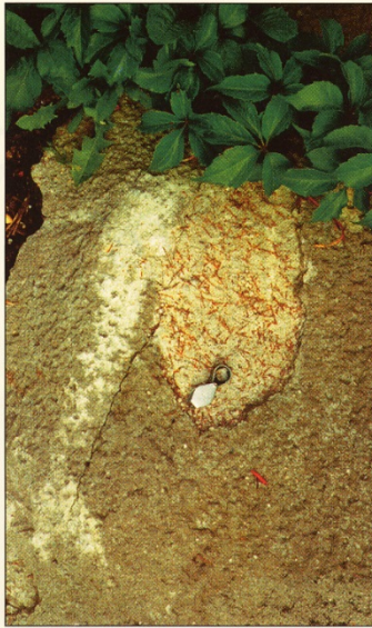
Eksempel på sulfatangrep i sprøytebetong. Det er sterk oppsmuldring i et ca. 1-2 cm tykt skikt mellom fiberarmet betong og overflatebetong. Merk også avskallingen og fiberkorrosjonen.
