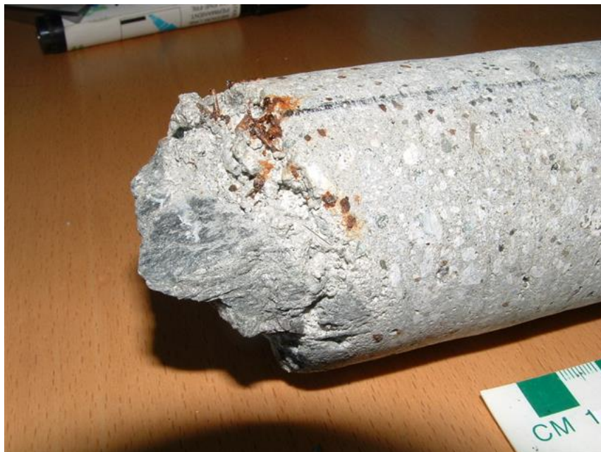
V4.35. Kjerne Core 1-1 sett frå heftsona med karbonatisering og stålfiberkorrosjon. Betongalder 13 år. Foto: Per Hagelia.
