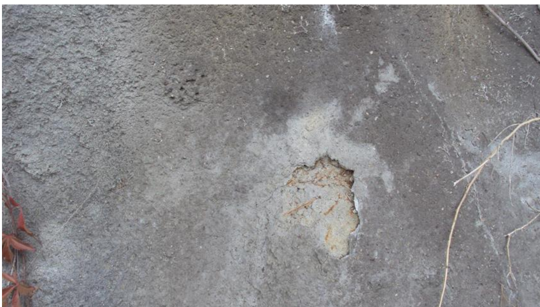
V3.4. Detaljar frå Åkebergveien i 2014. Avskaling i sprøytebetong langs sone med fullskala thaumasitt sulfatangrep og destruktiv stålfiberkorrosjon. Betongalder 27 år. Foto: Per Hagelia.
