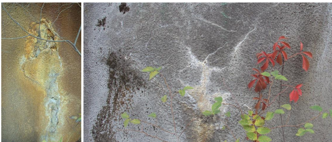
V3.3. Detaljar frå Åkebergveien i 2014. Venstre: Kraftig nedbryting av sprøytebetong og avskaling i overflata. Gul utfelling av forvittrings-mineral (jarositt m.m.) er danna frå syregivande sulfidoksidasjon i alunskifer. Høgre: Utfelling av kalsiumkarbonat på overflata og på nettriss (og muleg gips og thaumasitt) danna ved utluting av betongen i kombinasjon med thaumasitt sulfatangrep. Betongalder 27 år. Foto: Per Hagelia.
