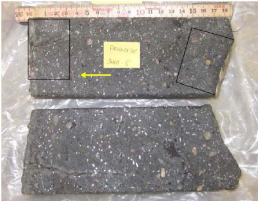
V4.19. Kjerne 885H med tynnslipområde. Muleg er noko av betongen tæra bort. Betongalder 26 år. Foto: Mannvit.
