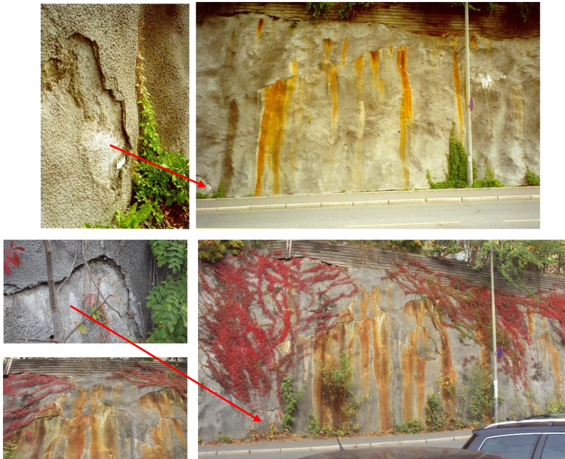
Figur 4.41: 13 år gammel betong: Intern avskaling langs fullstendig nedbrote 1–3 cm sjikt (øvt-venstre). All stålfiber bortkorrodert: fullskala TSA og PCD: Utfelling av jern-oksyhdroksid frå enkelte sprekker elles lite oppsprukken (øvt-høgre). 27 år gammel betong: Intern avskaling hadde auka kraftig, samt med omfattande krakering over store deler av skjeringa. Foto Per Hagelia.
