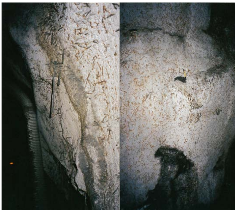
V4.2. Eksempel på kvit sprøytebetong som er påverka av vatn frå bergsida. Venstre: Lange stalaktittar av kalsitt med brucitt ( Mg(OH)_2 ) og destruktiv stålfiberkorrosjon i overflata. Høgre: tilsvarande med omfattande fuktgjennomslag i 0 - 1 m over sålen. Område nær pumpeumpen. September 2002. Betongalder 14 år. Foto: Per Hagelia.
