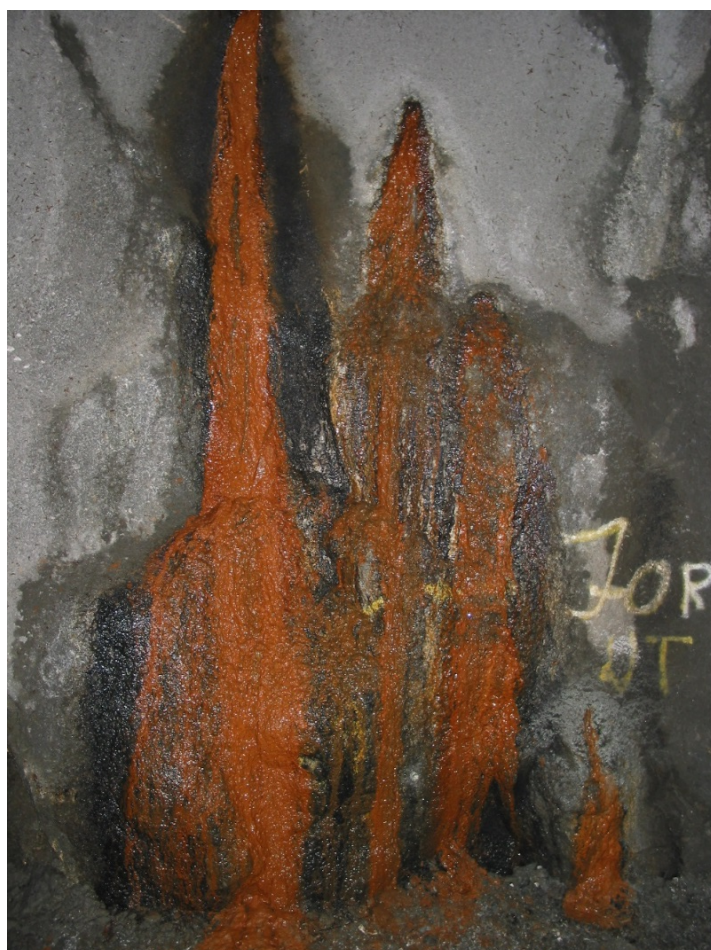
V4.85. Pelnummer 16060 vis a vis inngangsdøra til transformatoriosk ved servicetunnelen ned til pumpesumpen. Utvikling av lagdelt biofilm med tykk slimete jernbakteriar over mørk manganrik biofilm. Betongalder 5 år, mars 2004. Foto: Per Hagelia.
