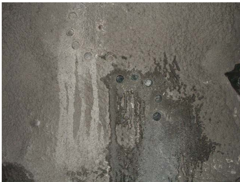
V.1.26. Lokalisering av kjernene 3-1, 3-2, 3-3, 3-4 og 3, 5 (høgre) ved pelnummer 4410 frå lys og opprinneleg tørr betong med tydeleg ytre karbonatisering. Bora ut i 2004. Betongalder 13 år. Prøvene 3-1, 3-4 og 3-5 blei brukt til trykkprøving; 3-2 og 3-3 for strukturanalyse med tynnslip. Prøvepunktta oppe til venstre representerer kjerner bora ut i 1996, og undersøkte i etatsprogrammet «Riktig bruk av sprøytebetong i tunnelar» (Røhrsveen og Lygre 1996, Davik 1997b). Foto: Per Hagelia.
