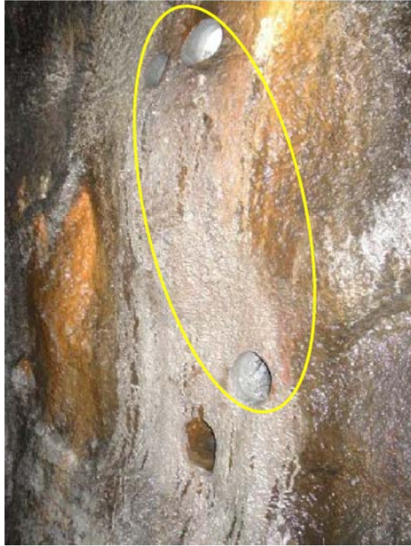
V4.7. Flekkerøytunnelen, pelnummer 1380H. Bergoverflata var vår med biofilm. Betongalder 26 år: Foto: Mannvit.
