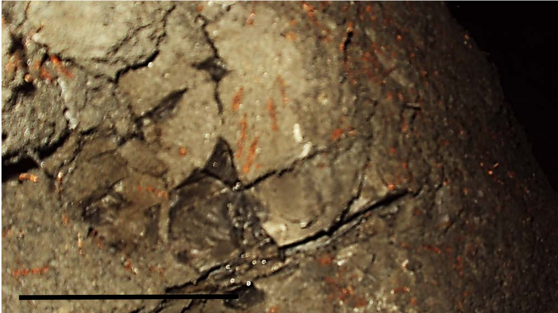
V3.25. Ekebergtunnelen, pelnummer ca. 1835H Indikasjon på alunskifersvelling. Pelnummer. Det er tidligere rapportert om aktiv svelling frå kjellarar på Ekeberg (Ole Fromreide, sjå notat etter samtale 2000 under). Betongalder 22 år. Målestokk = 1 m. Foto: Per Hagelia.
