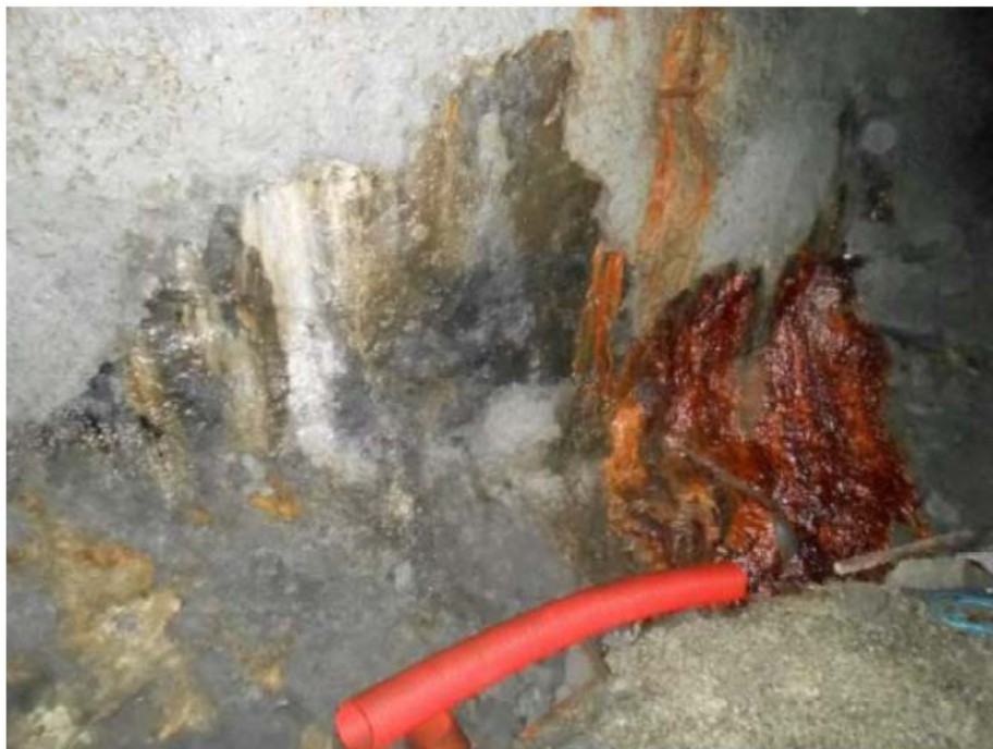
V3.24. Ekeberg tunnelen, pelnummer 1820H med kraftig nedbryting nær sålen. Betongalder 22 år. Foto: Mannvit.
