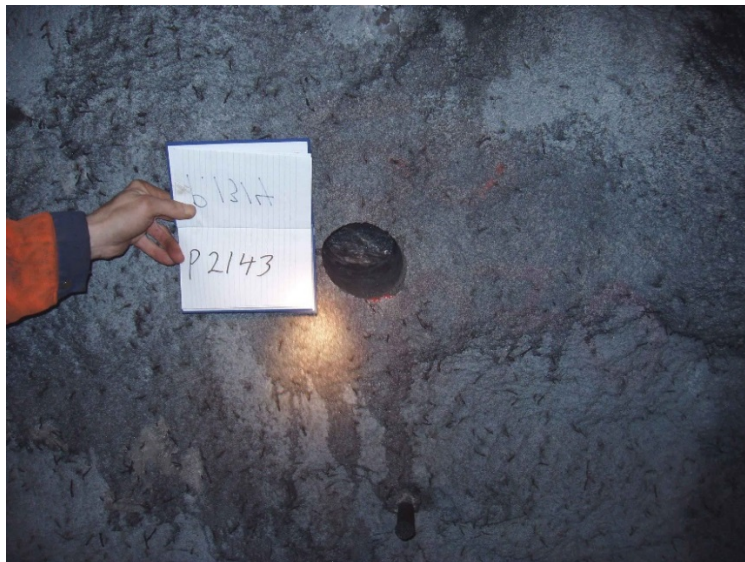
VI.24. Lokalisering av kjerne 2142 i lys og opprinneleg tørr betong med tydeleg ytre karbonatisering. Bora ut i 2003. Betongalder 15 år. Foto: Dag Øystein Løyning, Mesta.
