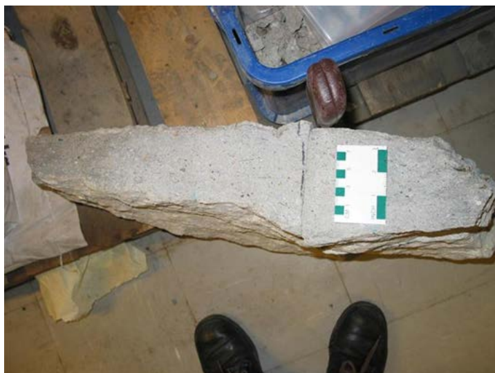
V4.84. Pel ca. 16055 mars 2004. Prøve («Spall 1») av avskala fullt intakt sprøytebetong utan fiberkorrosjon, samla inn utan hamring frå venstre side av tunnelen ned til pumpesumpen. Denne betongen blei i stor grad meisla bort og erstatta av ny sprøytebetong våren 2004. Betongalder 5 år. Foto: Per Hagelia.
