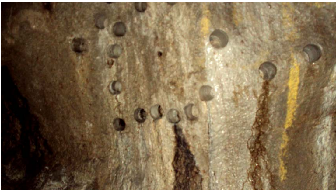
V4.89. Pelnummer 15930 . Tre nye kjerner (størst diameter) i høgre del av bildet blei bora ut i 2015 i Varige konstruksjonar ved betongalder 16 år. Generelt vedvarande fuktig område sidan 1999, med tydeleg auka utluting og utfelling av kalsiumkarbonat sidan 2004 (sjå V4.82). Utvikling av biofilm lokalt i små lekkasjar frå borehol. Foto frå betongalder 17 år: Per Hagelia.
