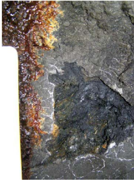
V3.45. Kraftig avskaling og nedfall av tynn sprøytebetong i nisja ved pelnummer 320. Merk omfattande utfelling av rust og gule forvitningsmineral (jarositt m.m.) på overflata, men også på heftsona. Betongalder 16 år. Foto: Mannvit.
