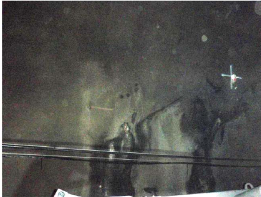
V4.42. Kjerne 3790-fk3 bora ut i litt vått område med moderat kalkutfelling. Stålfiberkorrosjon var avgrensa til overflata. Betongalder 18 år. Foto: Jan Viggo Holm.
