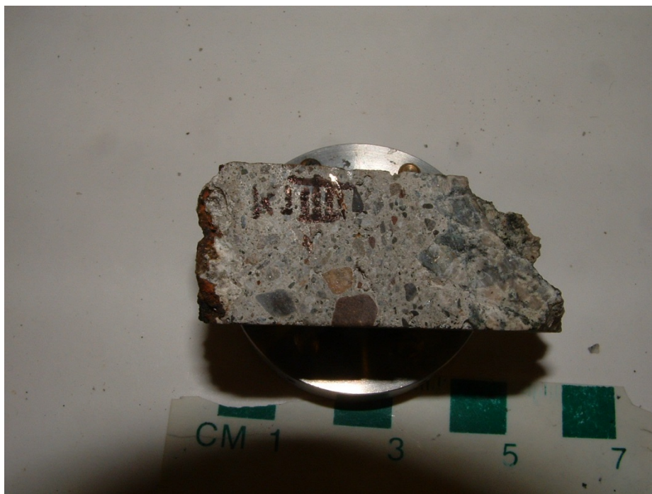
V4.93. Kjerne KJ III av sprøytebetong under tykk syregivande biofilm. Merk rustutfellingar frå biofilmen på overflata (venstre). Kjerna blei tatt frå stripe med biofilm som hadde danna eit søkk i overflata med tap av tverrsnitt estimert til 5 mm. Intern nedbrytingsmekanisme tilsvarande KJ II. I dette tilfelle god heft mot berg (høgre). Betongalder 5 år. Foto: Per Hagelia.
