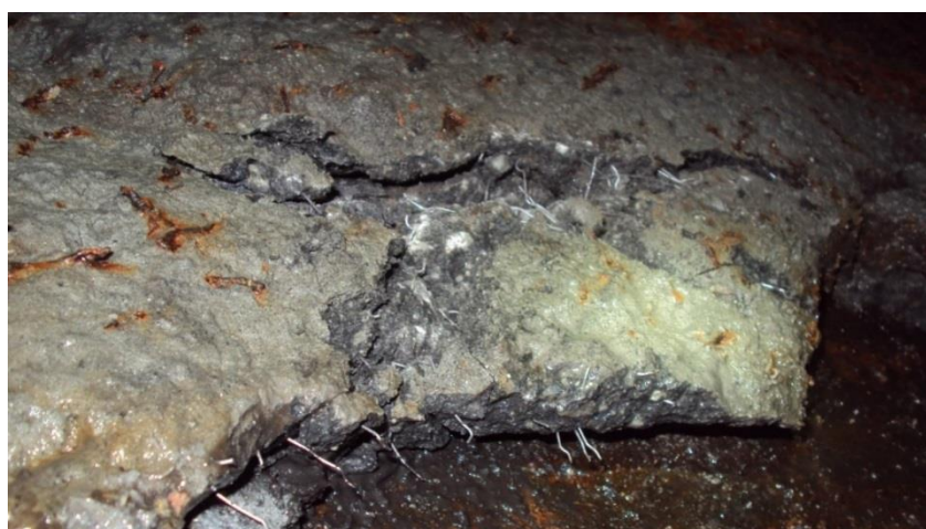
Figur 4.40: Ekebergtunnelen – Pel 1815 med avskaling. Stålfiberen i riss og sprekkar er heilt intakt på grunn av pH = 11,9 . Det lokale lekkasjevatnet er sterkt påverka av høg pH vaska ut frå betongens porevatn. Sprøytebetongen her er i ein tidleg fase av nedbryting. Stålfiberen på overflata i kontakt med fuktig luft og karbonatisert pasta er kraftig korrodert.
