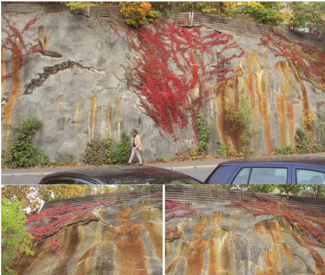
V3.2. Sprøytebetongen i Åkebergveien var kraftig krakelert etter 27 år på grunn av kombinert syre- og thaumasitt sulfatangrep og sannsynlegvis svelling i alunskiferbergmassen. Rusta og gule render er utfelte frå oksidert alunskifervatn via gjennomsettande sprekkar i betongen. Foto: Per Hagelia.
