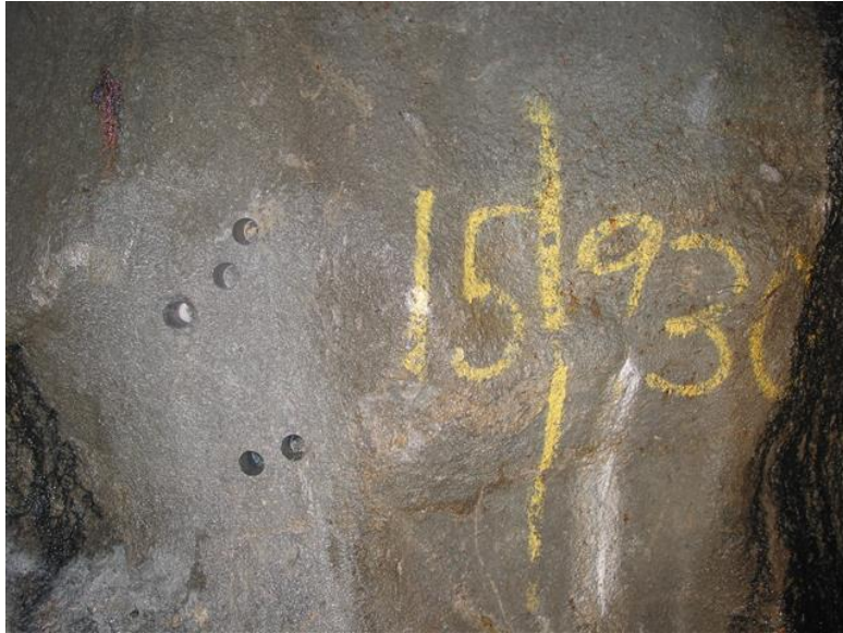
V4.82. Pel 15930 i mars 2004 etter utboring av kjernene 6 t.o.m. 10 i område med fuktig overflate og lokal utfelling av kalsiumkarbonat utan biofilm (litt biofilm til venstre og høgre side). Betongalder 5 år. Foto: Per Hagelia.
