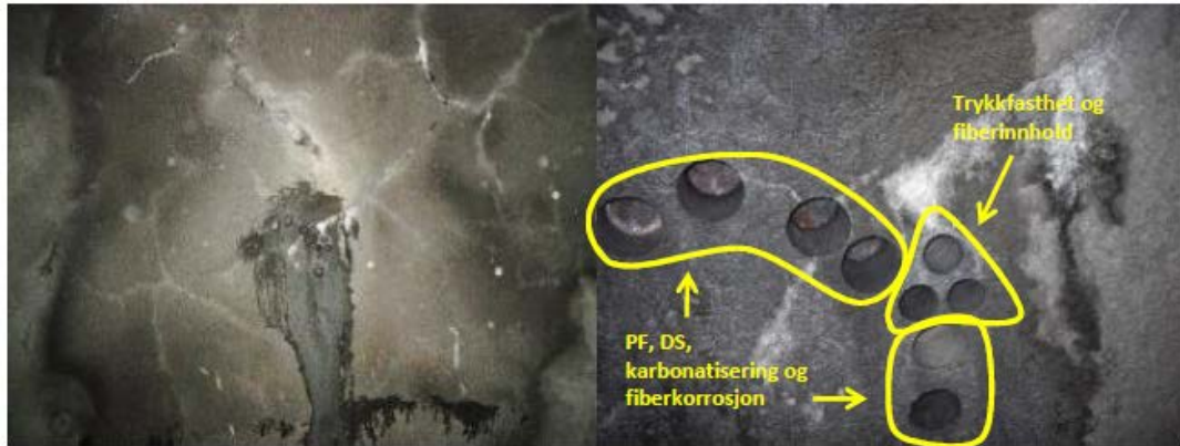
VI.6. 405 høgre. Bora ut frå lift i krakalert område 4,5-5 m over vegbanen i 2014. Betongalder 14 år. Foto: Mannvit.
