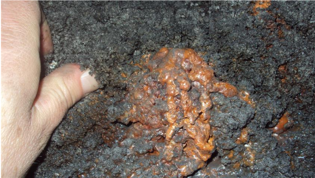
V4.11 Flekkerøytunnelen i området omkring pelnummer 1360-1380, med sterk nedbryting og tap av tverrsnitt i overflata. Betongalder 26 år. Foto: Per Hagelia.
