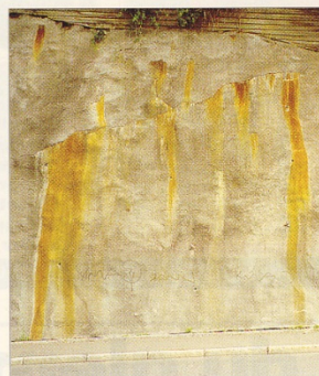
Skjæring i alunskifer sikra med sprøytebetong. Oksidasjon av magnetkis og svovelkis har ført til rustutfelling; frigjering av sulfationer og lokal nedbryting ved sulfatangrep.
