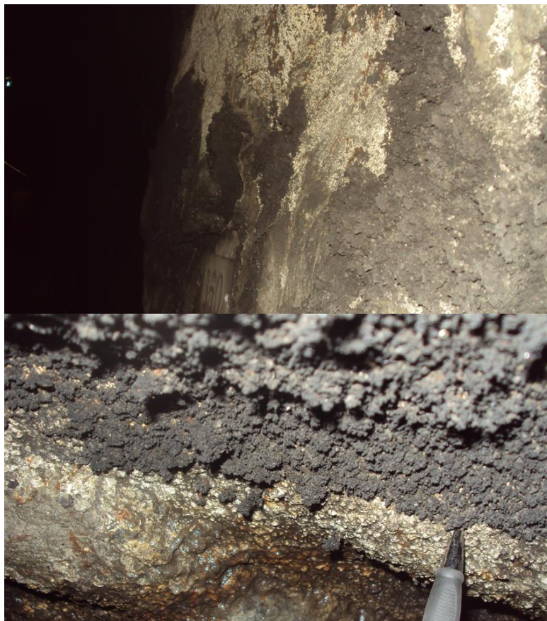
V4.10 Flekkerøytunnelen, pelnummer 1360V med sterkt nedbroten og bortøra sprøytebetong. Området hadde tidlegare tynn sprøytebetong heilt ned til sålen, med biofilm. Ved betongalder 26 år var det bare bassanitt og litt gips spreidd over deler av overflata. Foto: Per Hagelia.
