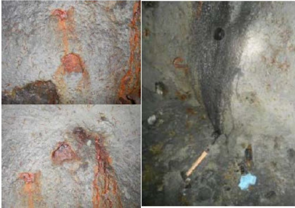
V3.23. Ekeberg tunnelen, pelnummer 1820H med lys nedbroten betong og destruktiv stålfiberkorrosjon. Pelnummer 1825H (høgre bilde): Kjerne 1825 av 90 mm tykk relativt intakt sprøytebetong, og handstykke 1825 av sterkt nedbroten betong nær sålen (Tabell 4.14). Betongalder 22 år. Foto: Mannvit.
