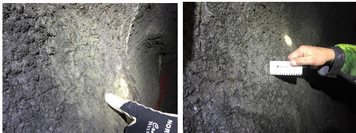
Figur 4.46: Laus betong på sprøytebetong i austgåande løp i Svartdalstunnelen: Pel 587 venstre side (venstre bilde) og pel 922 høgre side (høgre bilde). Merk lyse område med kalsitt: Foto: Knut Boge, Geovita AS.
