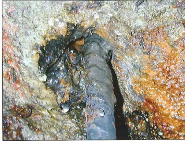
Figur 4 Opphengsbolt for vass- og frostsikringshvelv i undersjøisk miljø i Hvalertunnelen (Bye TI & Kynningsrud HR (2015). Korrosjonen er konsentrert i overgangen til berg.
