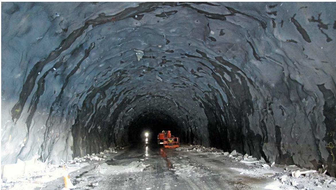
Figur 4 Situasjon etter at vass- og frostsikringskvelvet var rive ned. Det var relativt tørt i tunnelen, men med lokale fuktgjennomslag. Kvit og pulverisert perlittbetong ligg på vegbanen saman med restar av PE-skum. Foto: Statens vegvesen.
