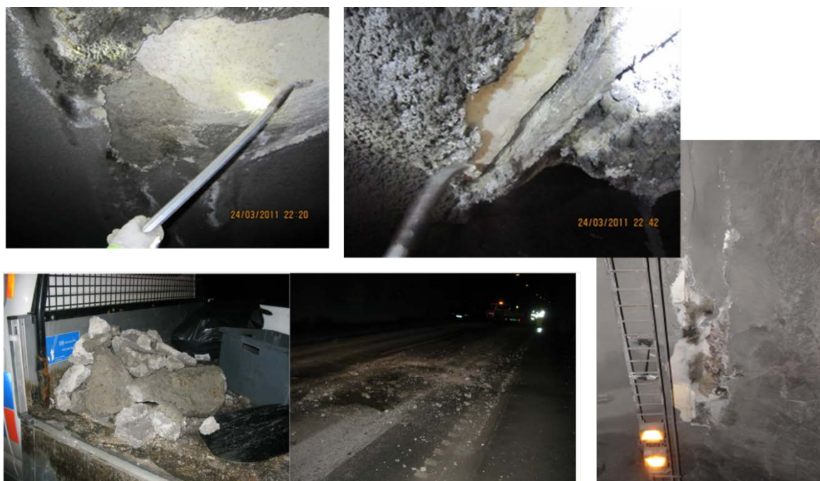
Figur 3 Nestunnelen i 2011, ni år etter reparasjon. Det var kraftig avskaling i heile tunnelen med nedfall og skade på bil. PE-skummet var blottlagd fleire stader. Foto: Statens vegvesen.
