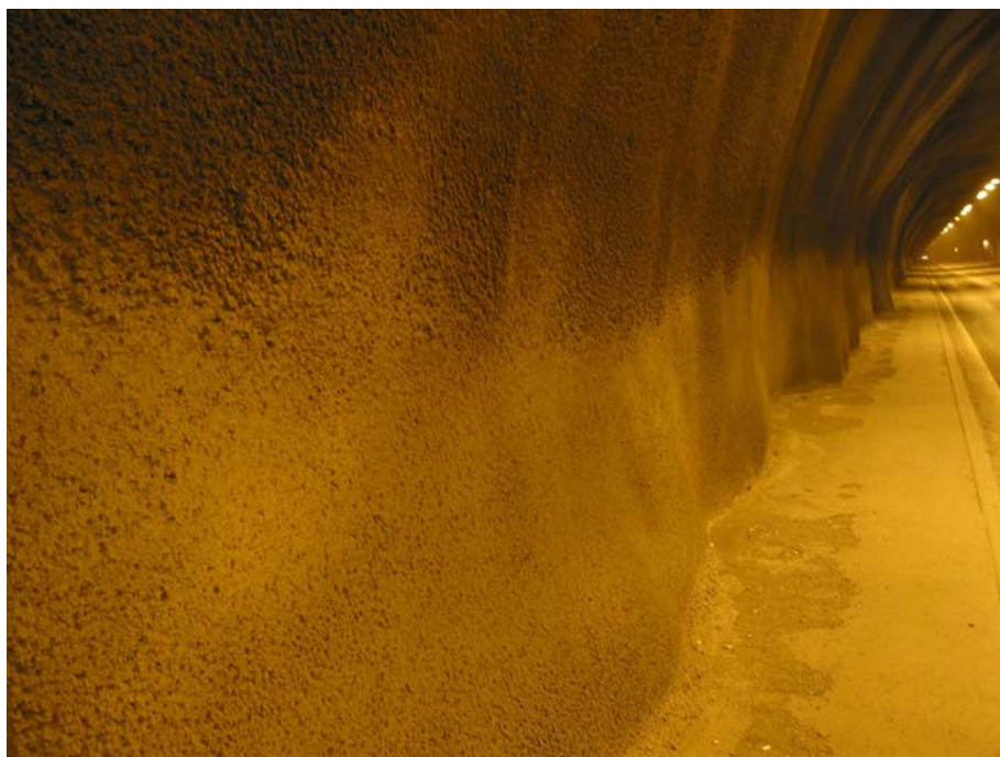
Figur 2 Nestunnelen rett etter reparasjon i 2002. Ny sprøytebetong med perlitt blei påført, saman med eit ytre lag av mikro-PP fiber betong utan perlitt. Fiberfri sprøytebetong blei til slutt sprøyta opp på den nedste meteren over vegbanen. Foto: Statens vegvesen.
