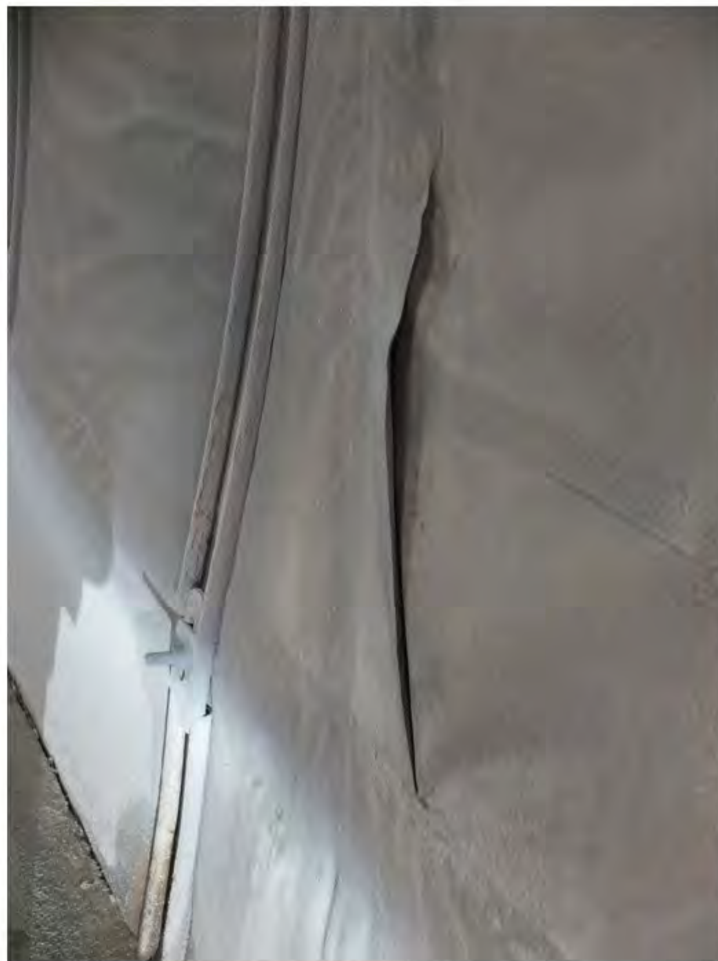
10 Duk har løsnet i skjøt
