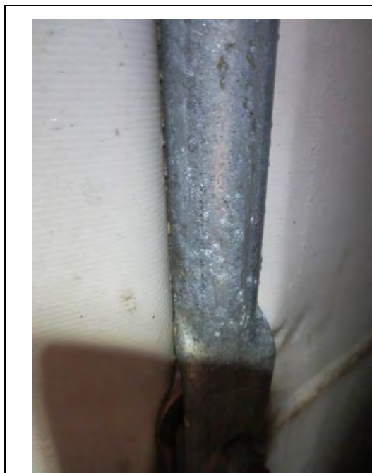
Foto 2.9.17. Bakrør med noe sinkoksyd på overflaten
