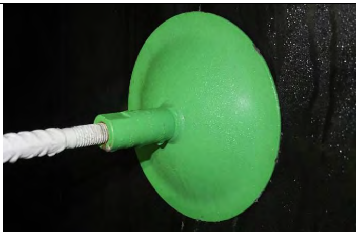
Foto 2.10.17. Bakskive med påsveist hylse montert i ferskvannssonen. Lakkskade på skivekanten kan observeres.
