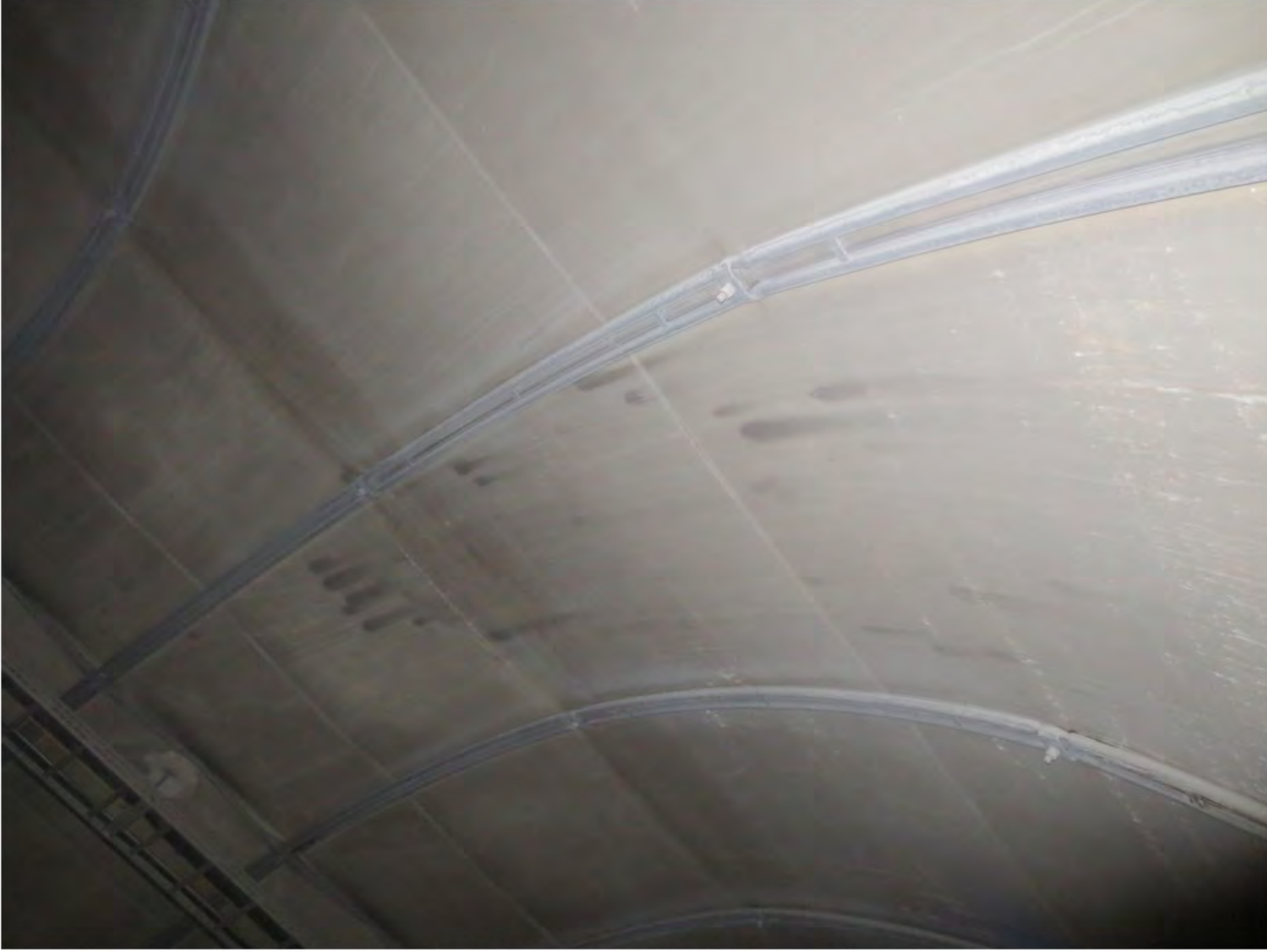
27 Tunnelduk seksjon mot vest type 556 - Punktvis misfarginger av duk
