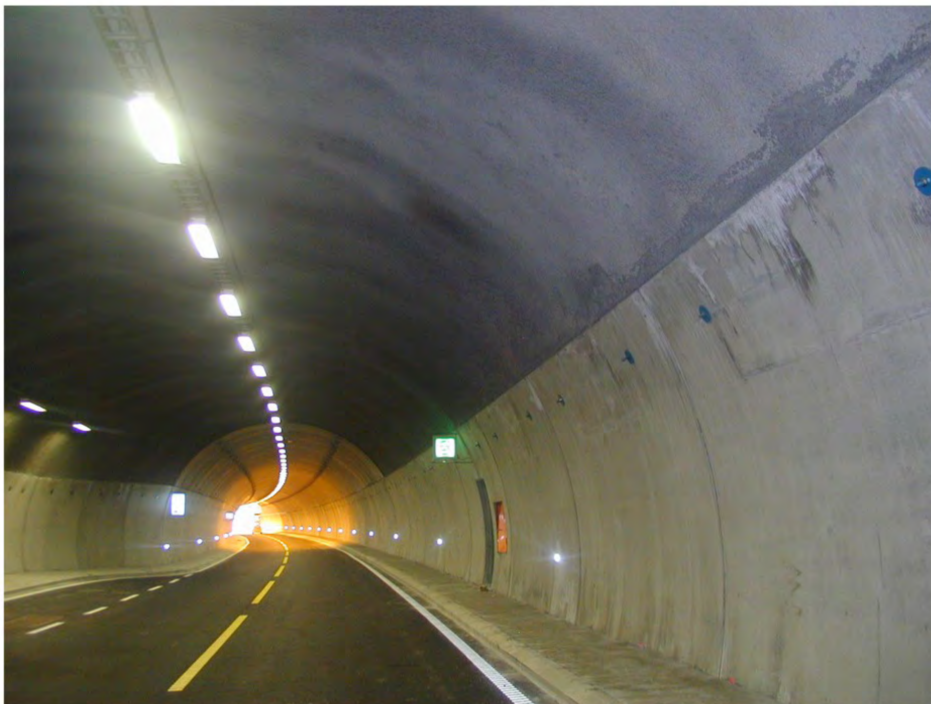
1 Oversikt T200 i havarinisje
