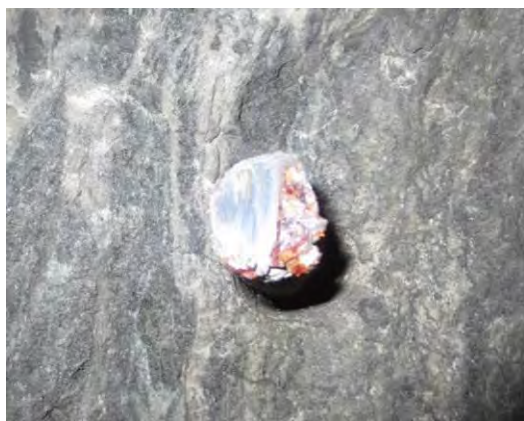
Foto 2.4.18. Lite korrosjon på kappflate på opprinnelige festebolter
