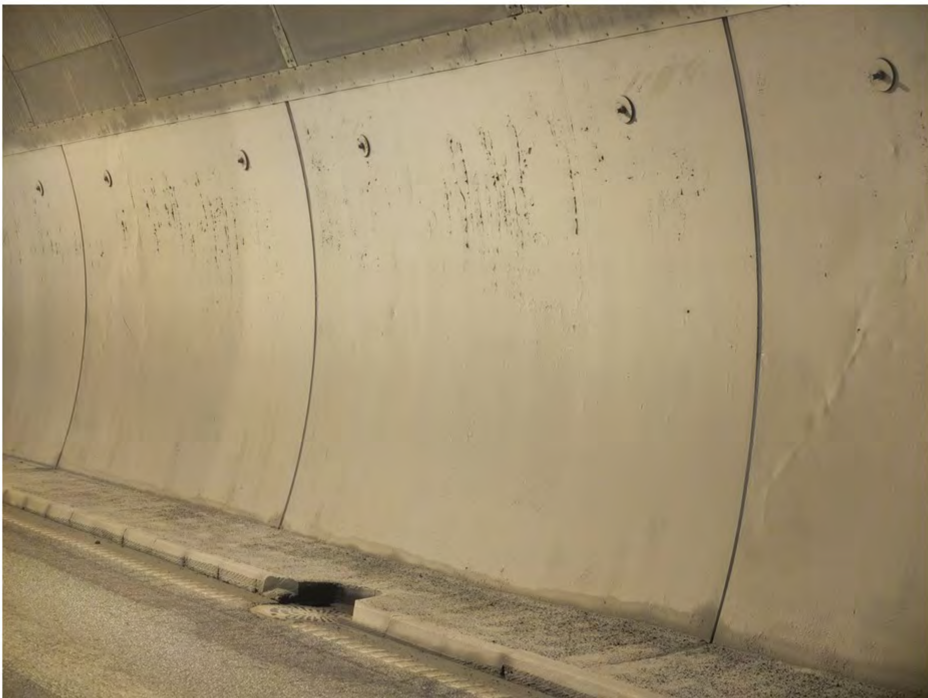
24 Malingsavflassing på veggelementer
