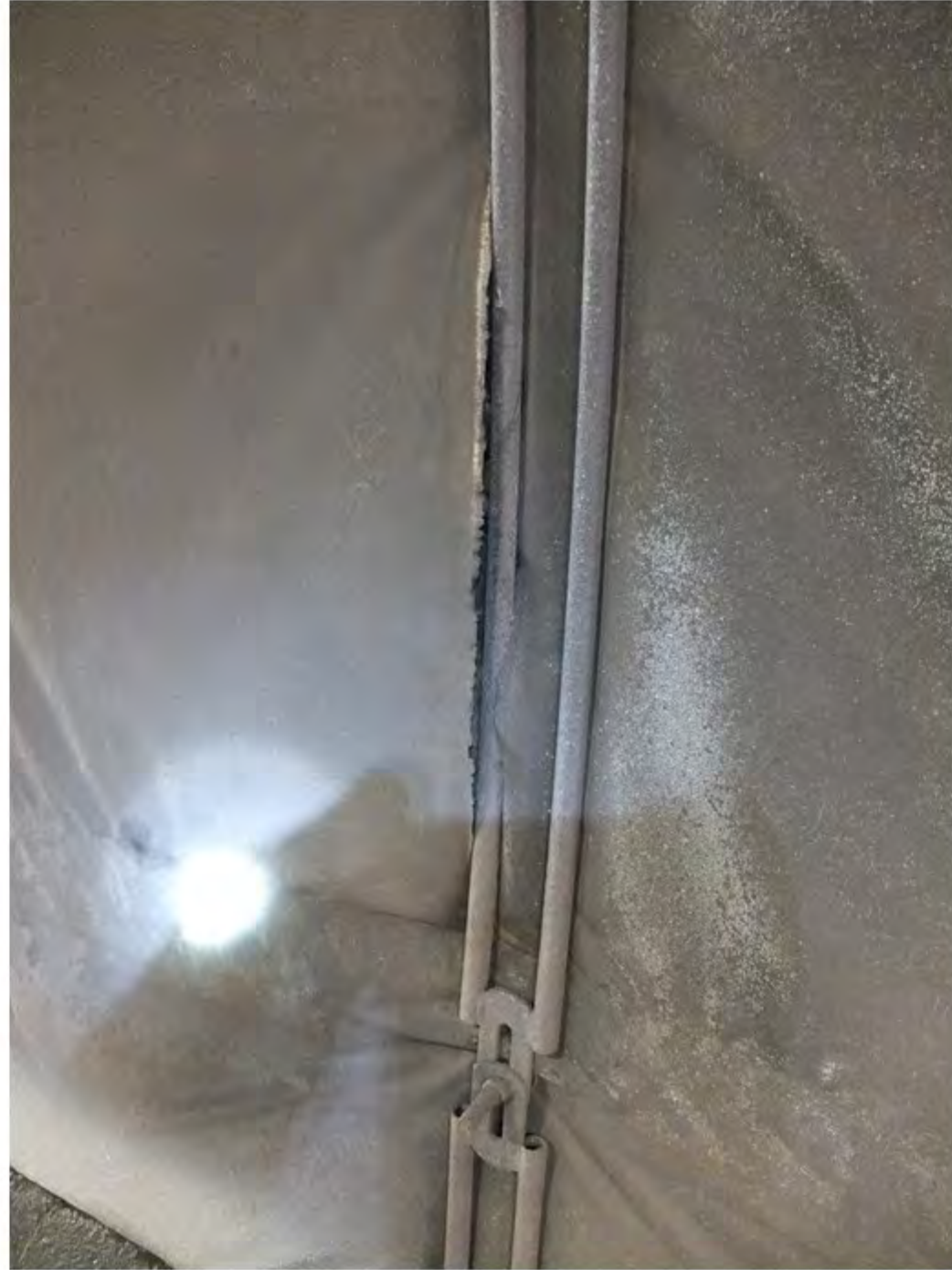
11 Brudd i duk ved fremrør
