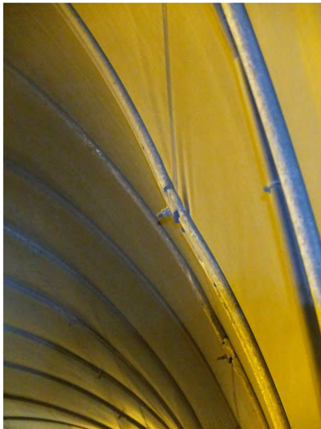
20 Brudd i festebolt - 1,5 km fra portal Frøyasiden
