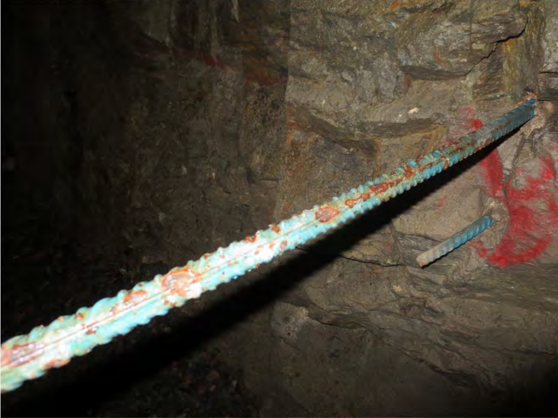
25 Misfarging på festebolter fra avleiringer
