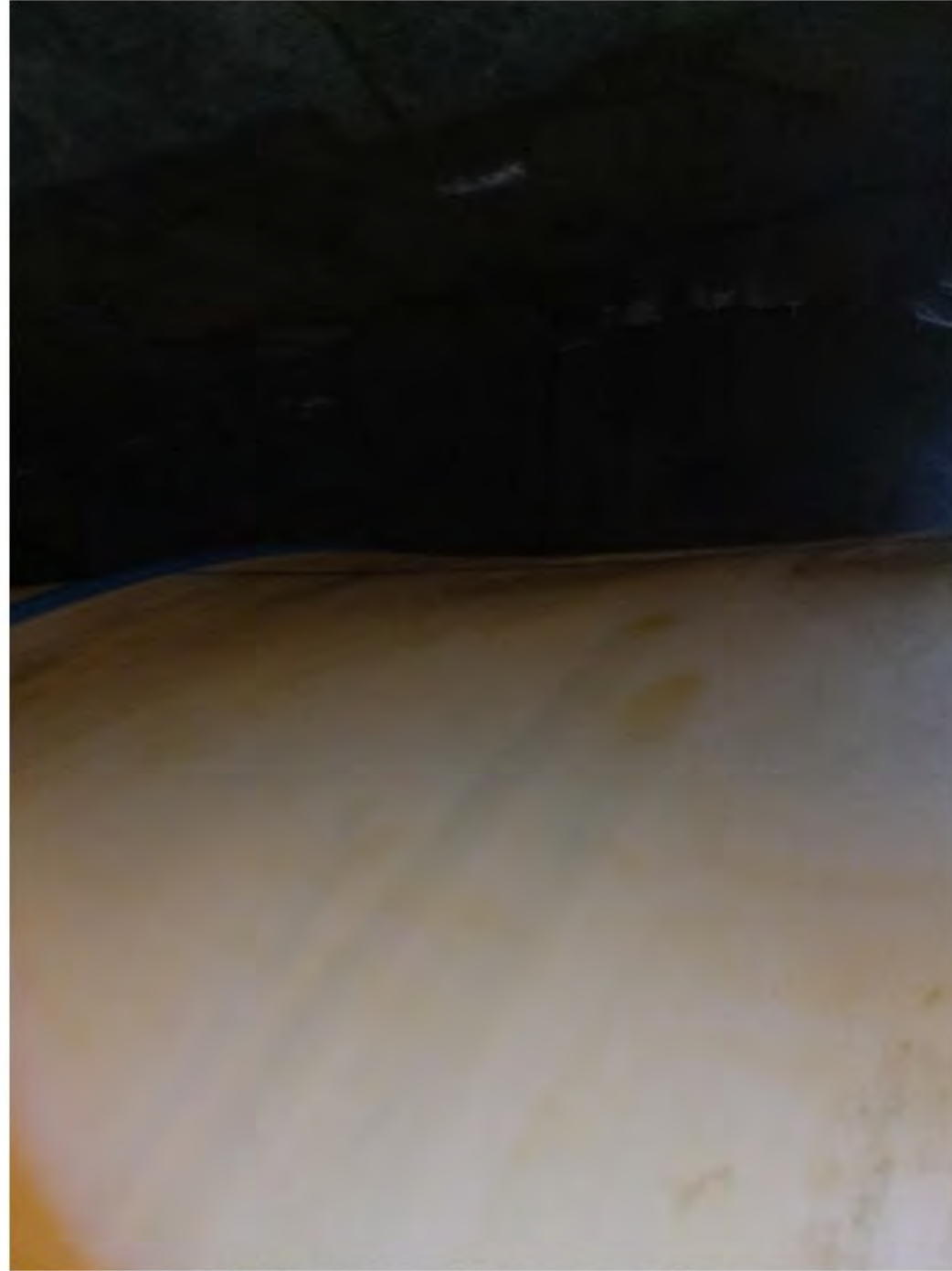
21 Misfarginger på duk fra vanndrypp
