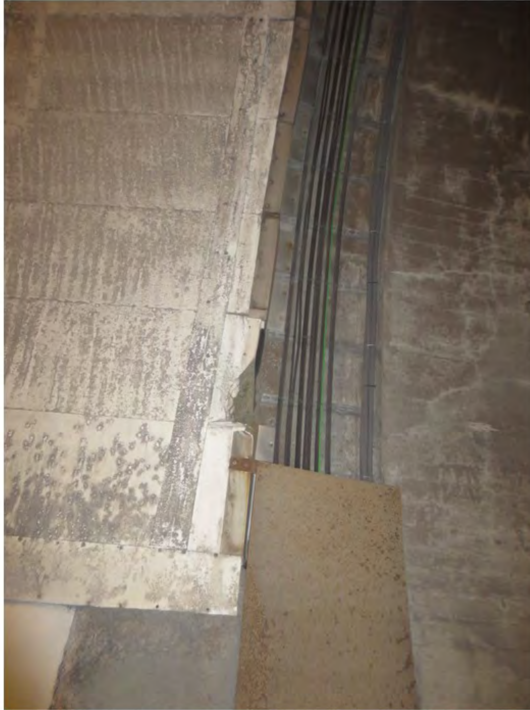
25 Overgang til portal - Omfattende malingsavflassing på platekassetter
