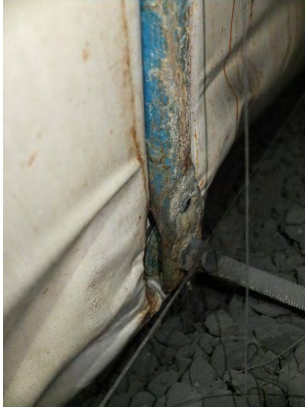
45 Nedre boltegjennomføring i duk - Blæring i combicoat samt saltavleiringer på overflate
