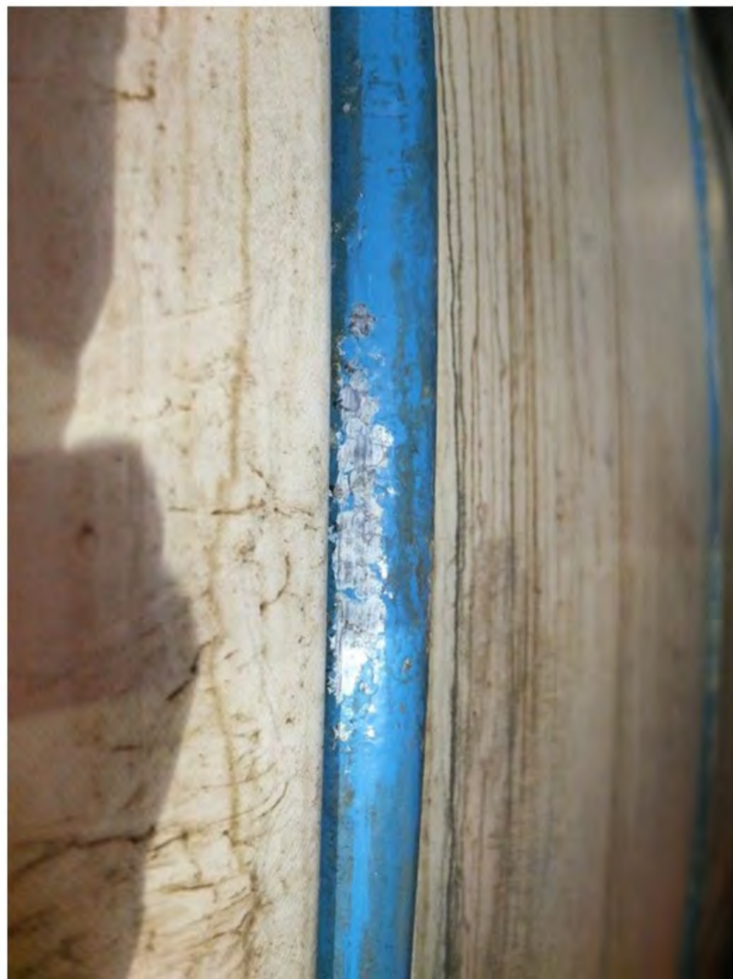
36 Blæring i Combicoat fjernet - Hvitrust og lett tæring av sink registrert
