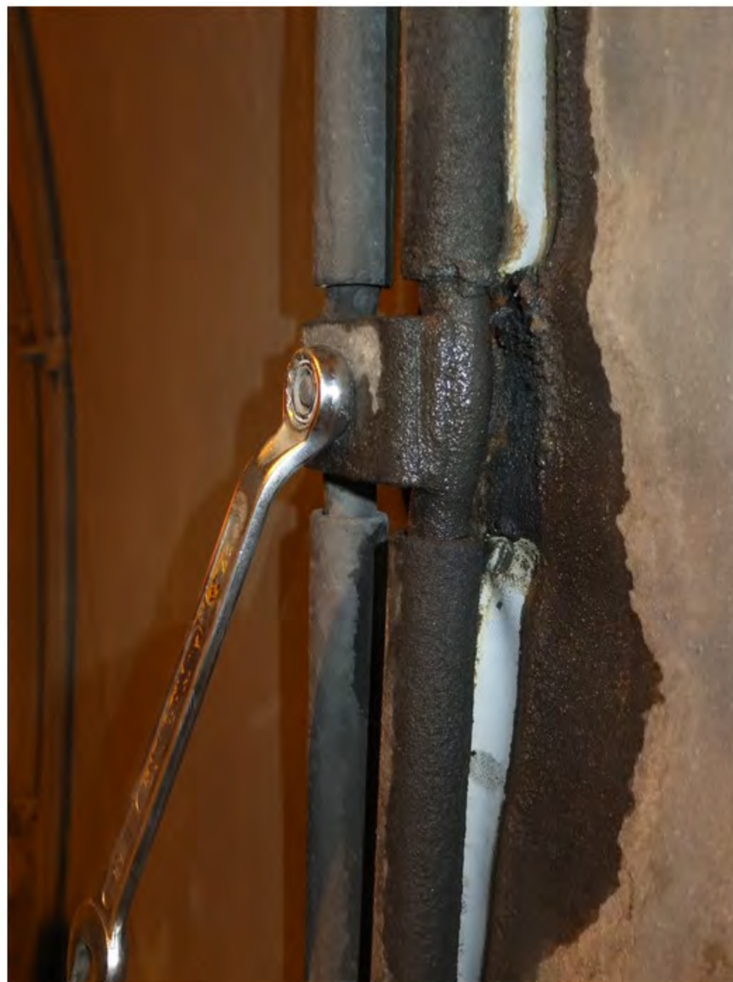
34 Løsnet fremrør i lekkasjepunkt
