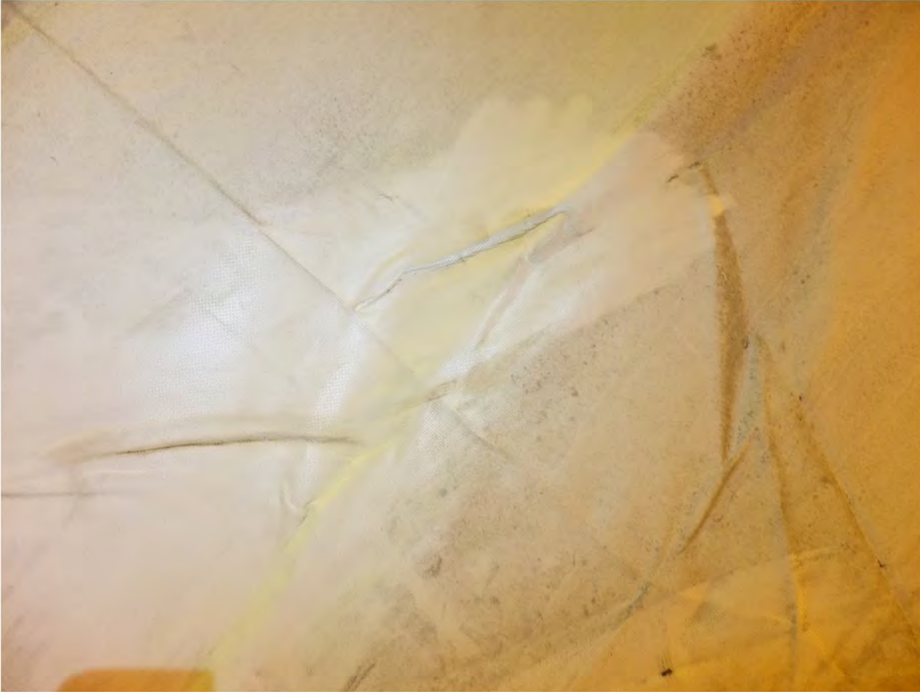
17 Reparasjonsfelt med duk type 556 - Brett i duk med brudd i plastmaterialet
