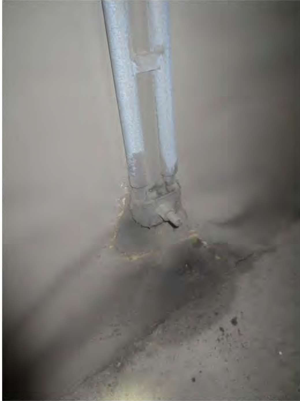
9 Lekkasje ved nedre boltefeste - Stålrør demonteres - 2 km fra portal Hitrasiden
