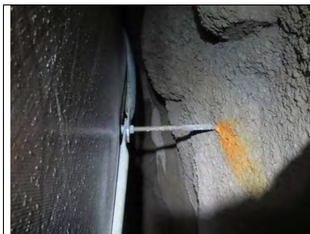
Foto 2.8.20. Utfelling av jernoksid fra boltehull
