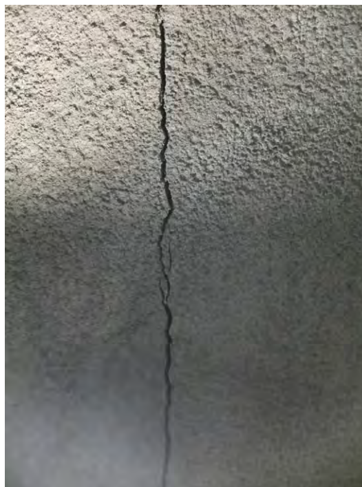
Foto 2.10.8. Linsedannelse ved initiell opprissing av fugen
