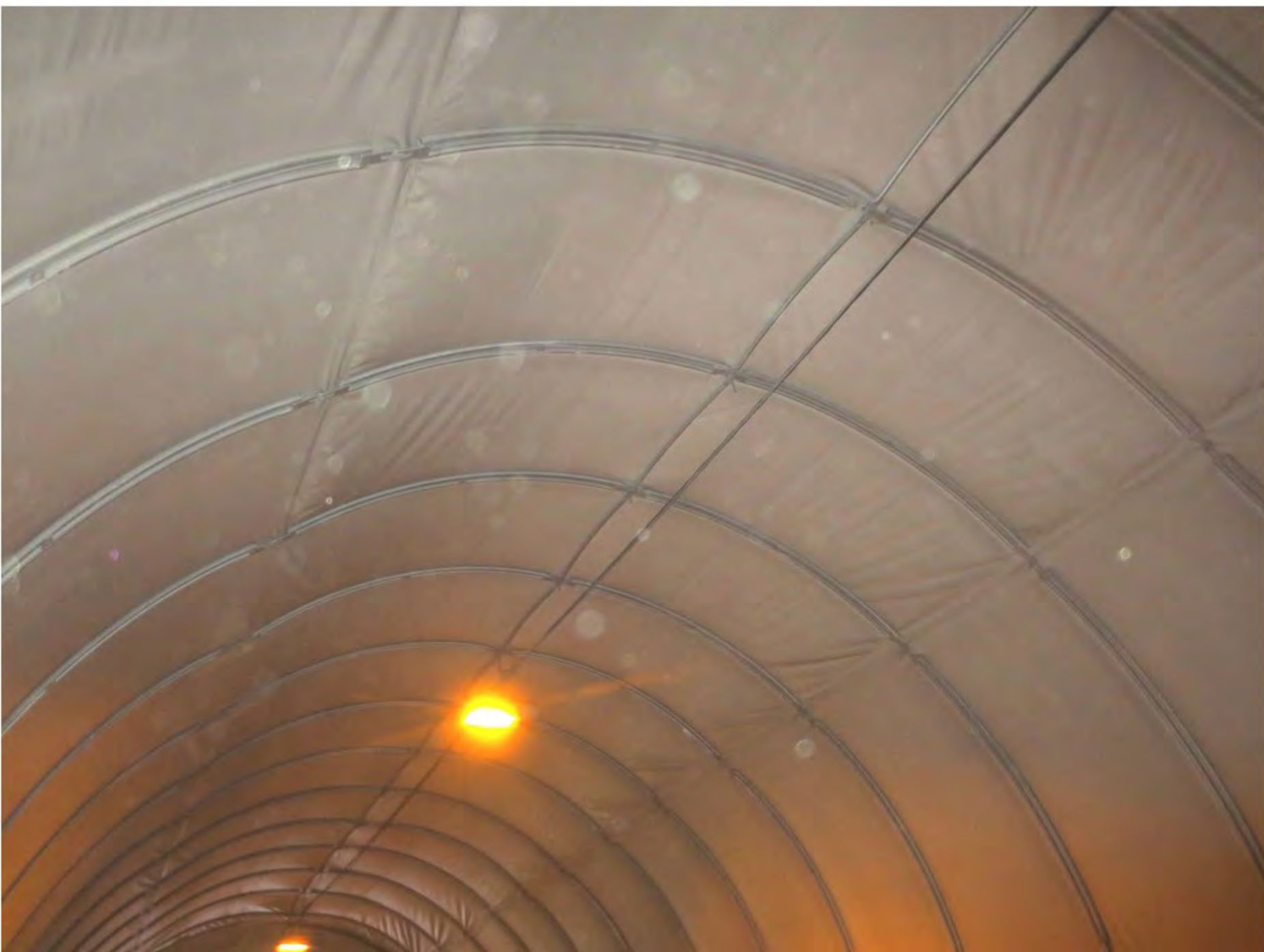
4 Profil 50 - Buklinger i duk pga dårlig stramming
