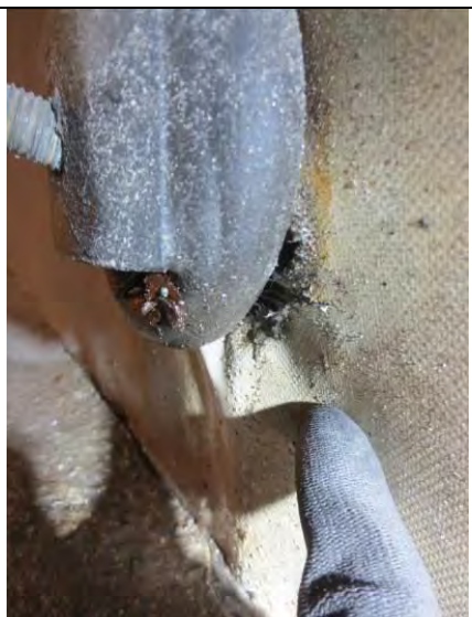
Foto 2.5.7. Hull i tunnelduk ved nedre festebolt mot bankett
