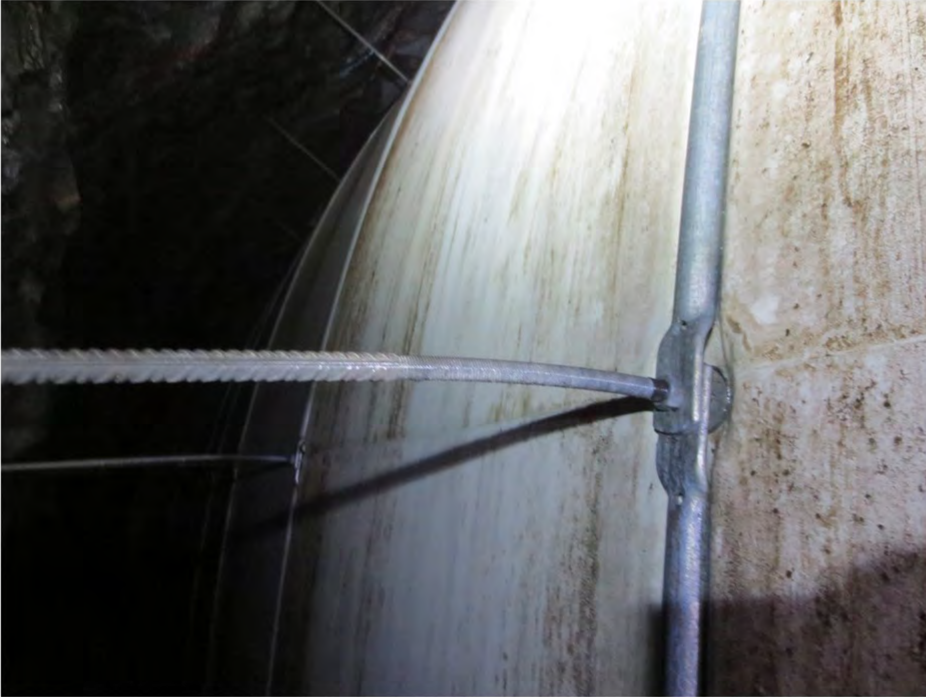
19 Festebolt seksjon mot øst - Bøyningsdeformasjon i bolt
