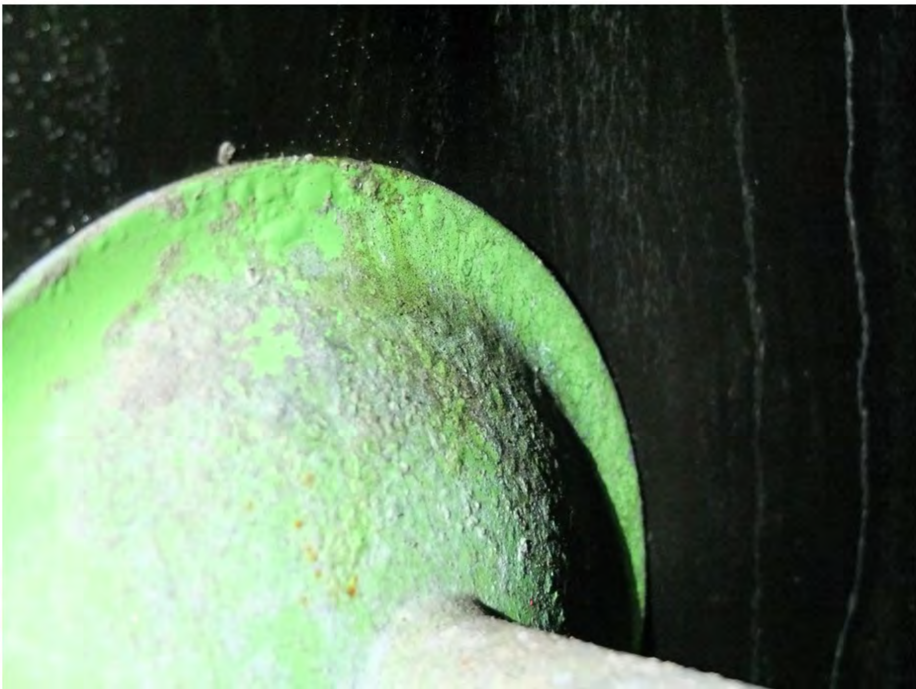
14 Blæring og rustutslag på skive
