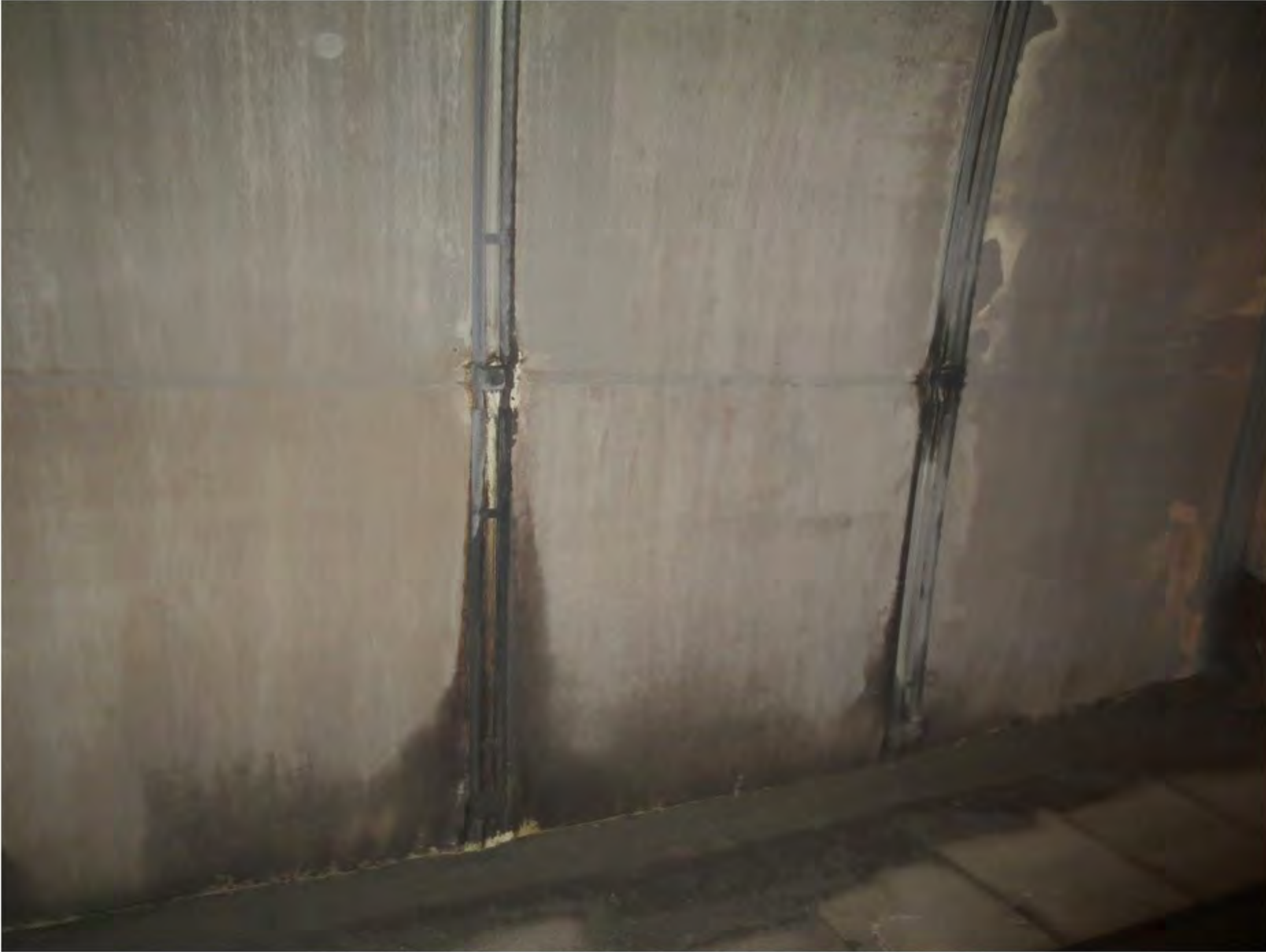
3 Tunnelduk østre seksjon med lekkasjepunkter
