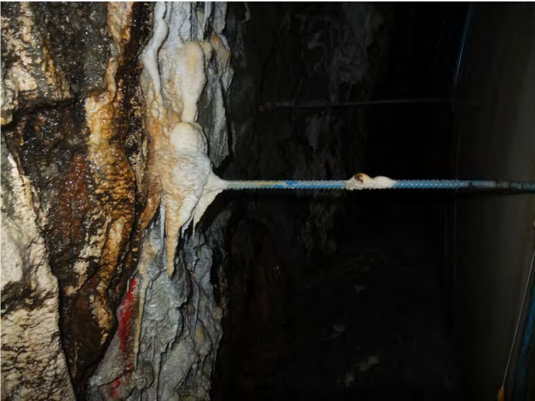
26 Kalkavleiringer og dryppstein på baksiden av hvelv
