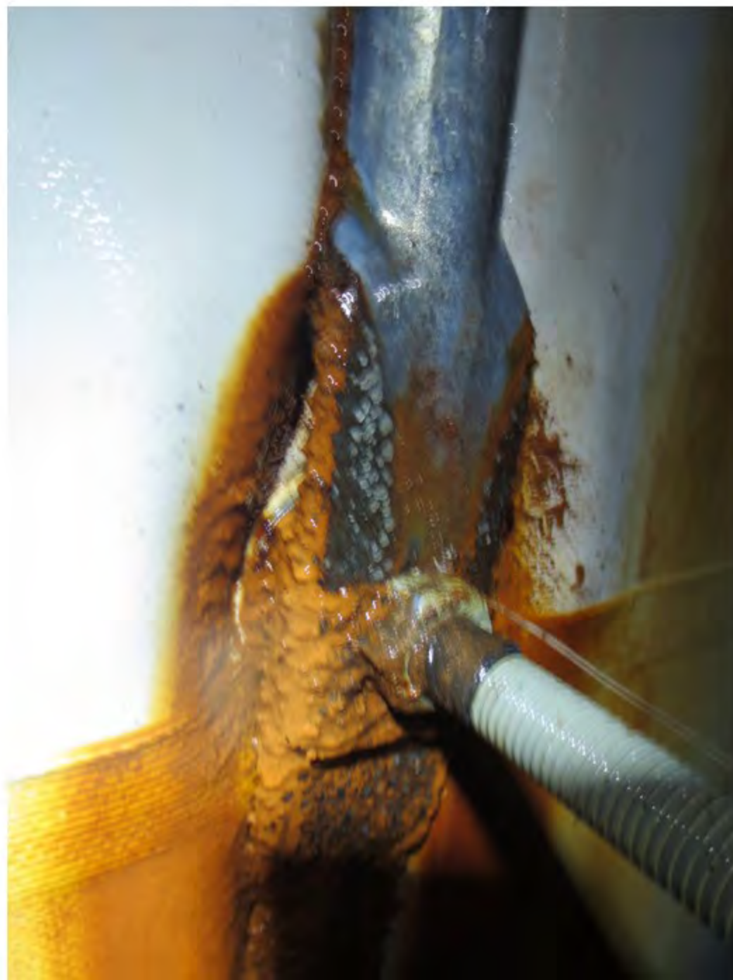
30 Profil 1100 - Tæring av sink under avleiringer av innlekkasjevann
