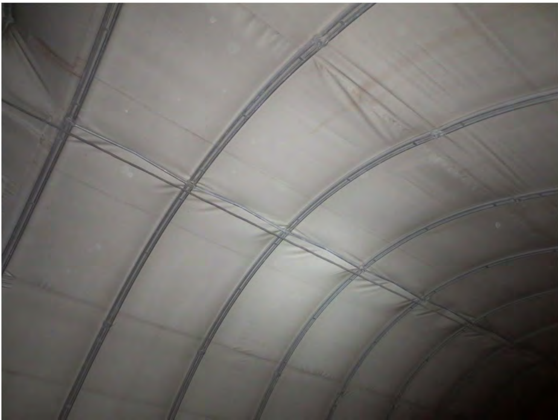
4 Profil 900 - Buklinger av duk pga dårlig stramming i hengen
