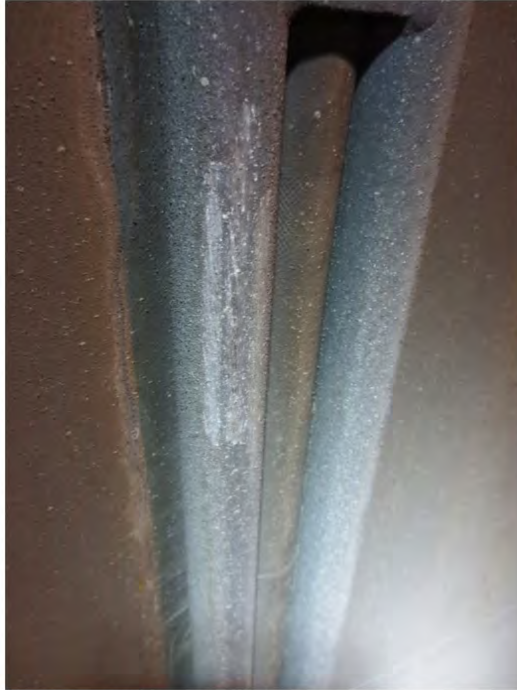
35 Fremrør etter at tilsmussing er fjernet
