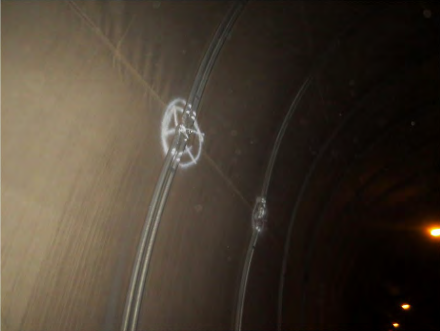
23 Brudd i festebolter - 1,7 km fra portal Hitrasiden
