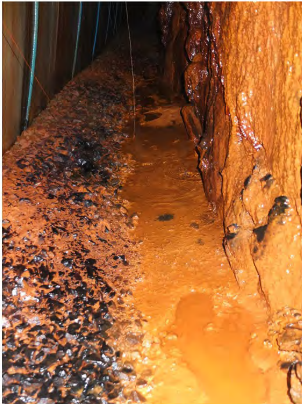
16 Innlekkasje bak hvelvet
