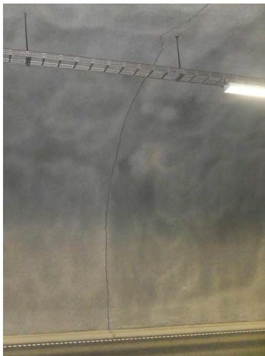
Foto 2.10.7. Dilatasjonsfuge, rissanviser forskjøvet ved kabelbrubolt
