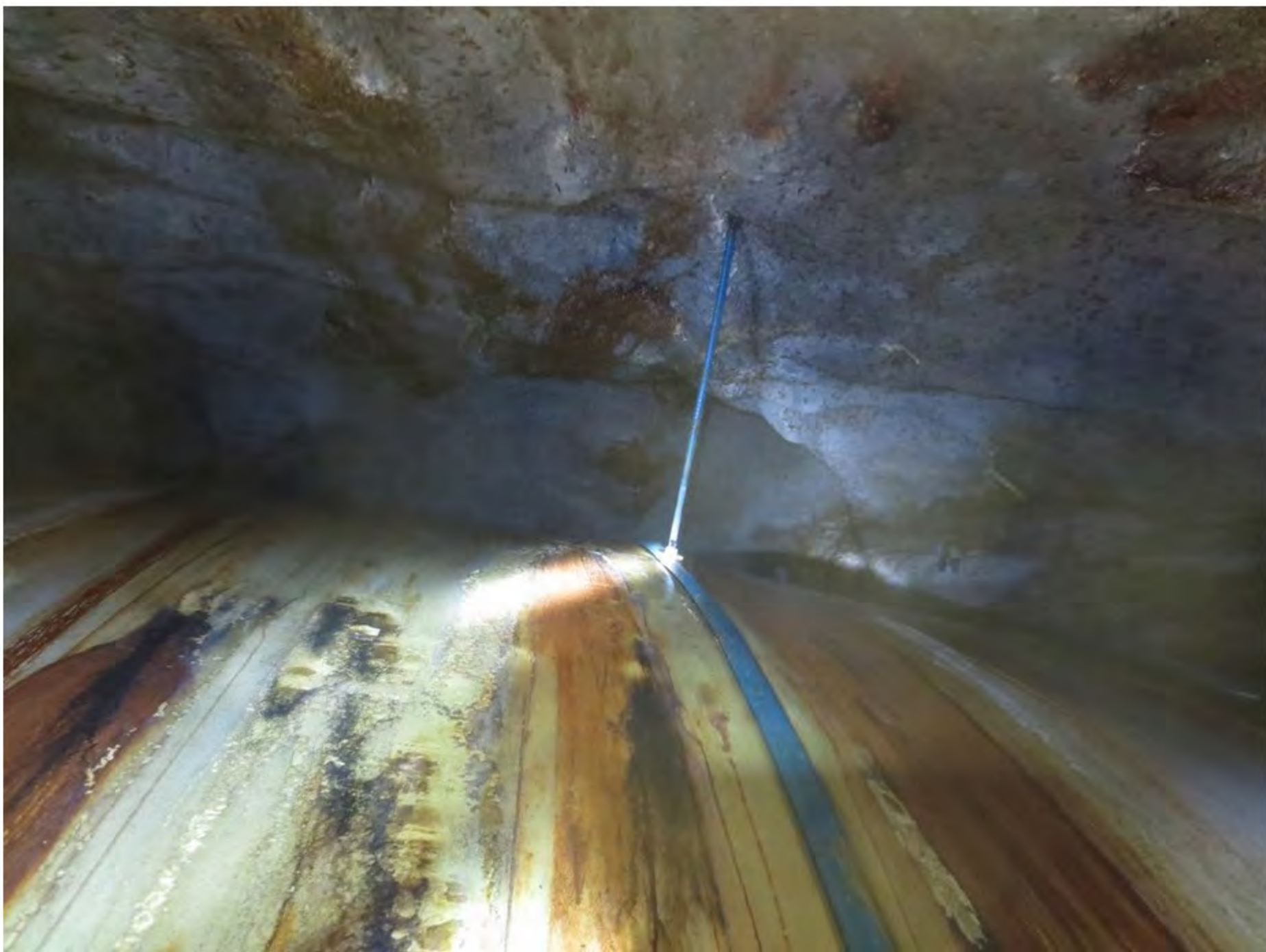
32 Belegg på tunnelduk
