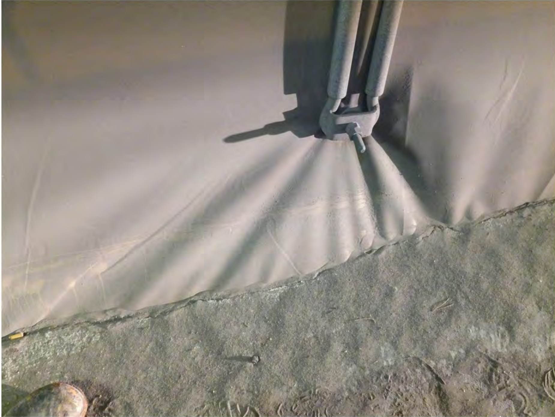
15 Lokal deformasjon i duk ved nedre bolteinnfesting
