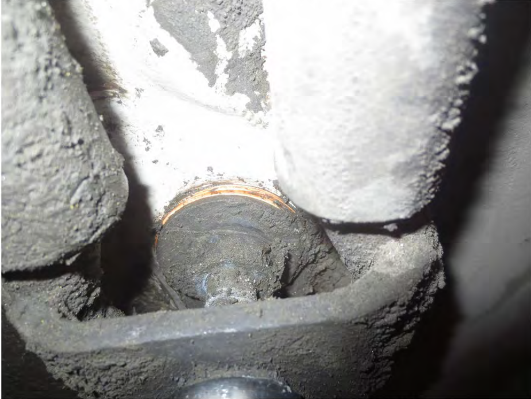
15 Profil 1560 - Ingen lekkasje i pakning - Lekkasje er høyere opp på duken
