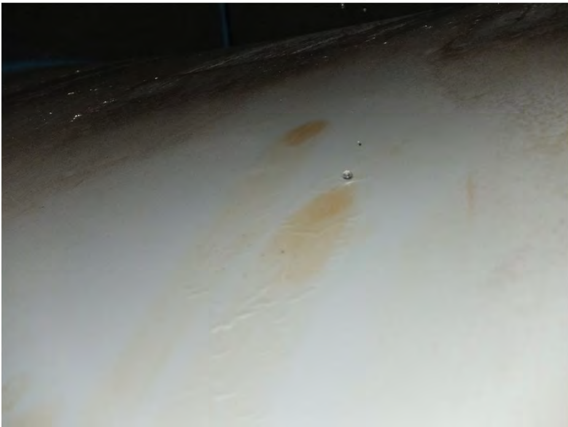
20 Vanndrypp fra berget gir misfarging
