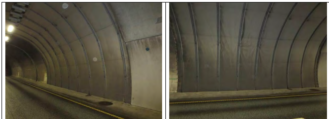
Foto 2.5.3. Oversikt tunnelduk T100 i generelt god stand
