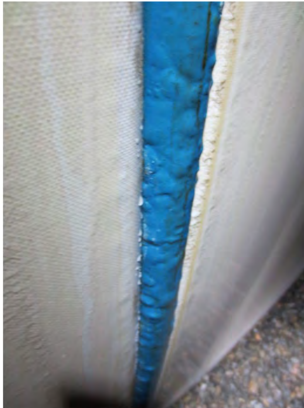
22 Omfattende blæring i lakk - 500 meter inn fra Bjorøysiden
