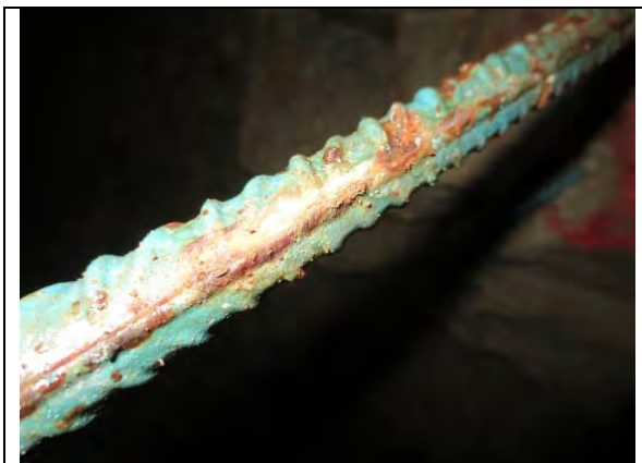
Foto 2.3.12. Punktkorrosjon og misfarging på festebolt
