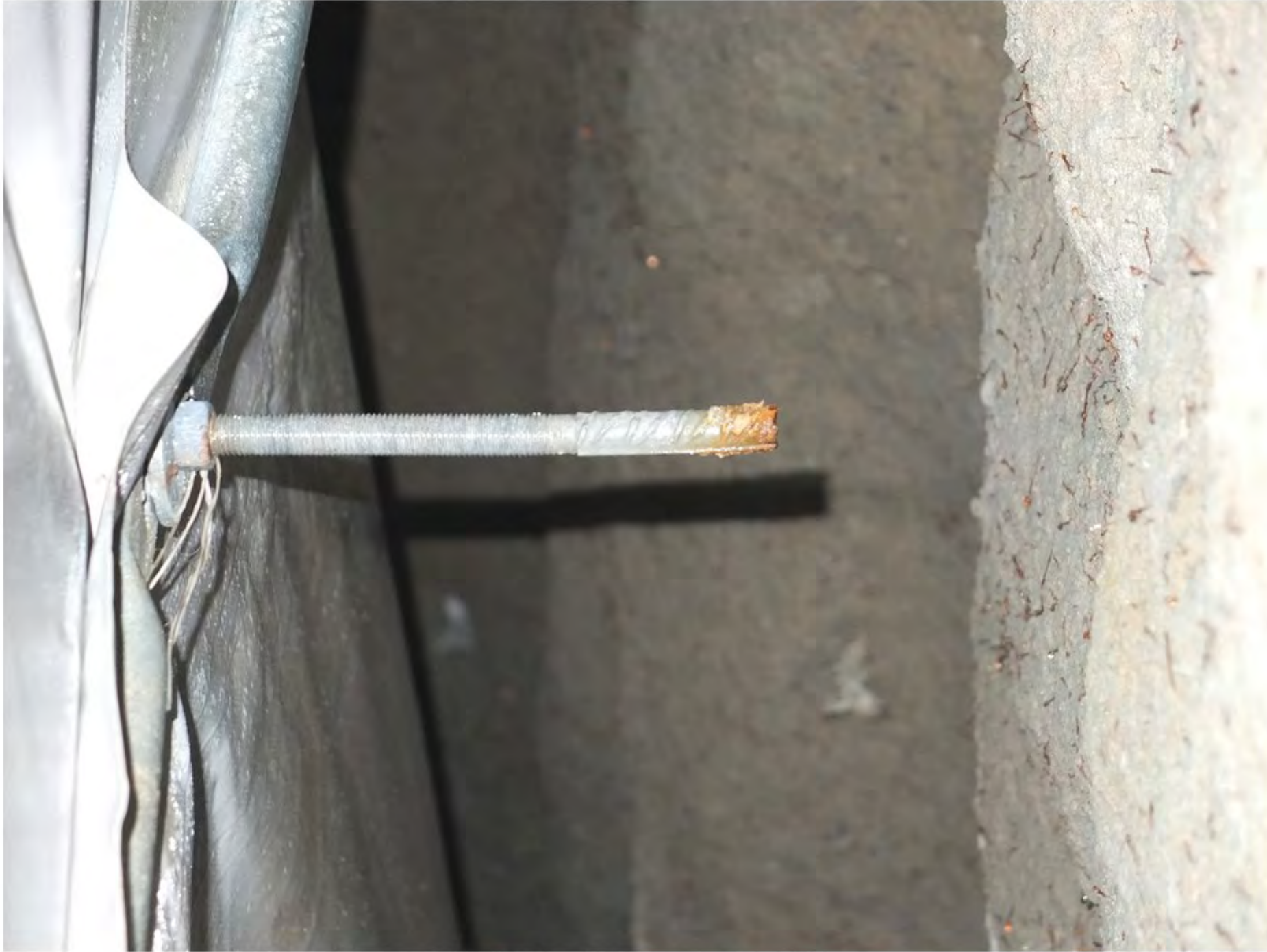
33 Brudd i festebolt ved overgang til berg
