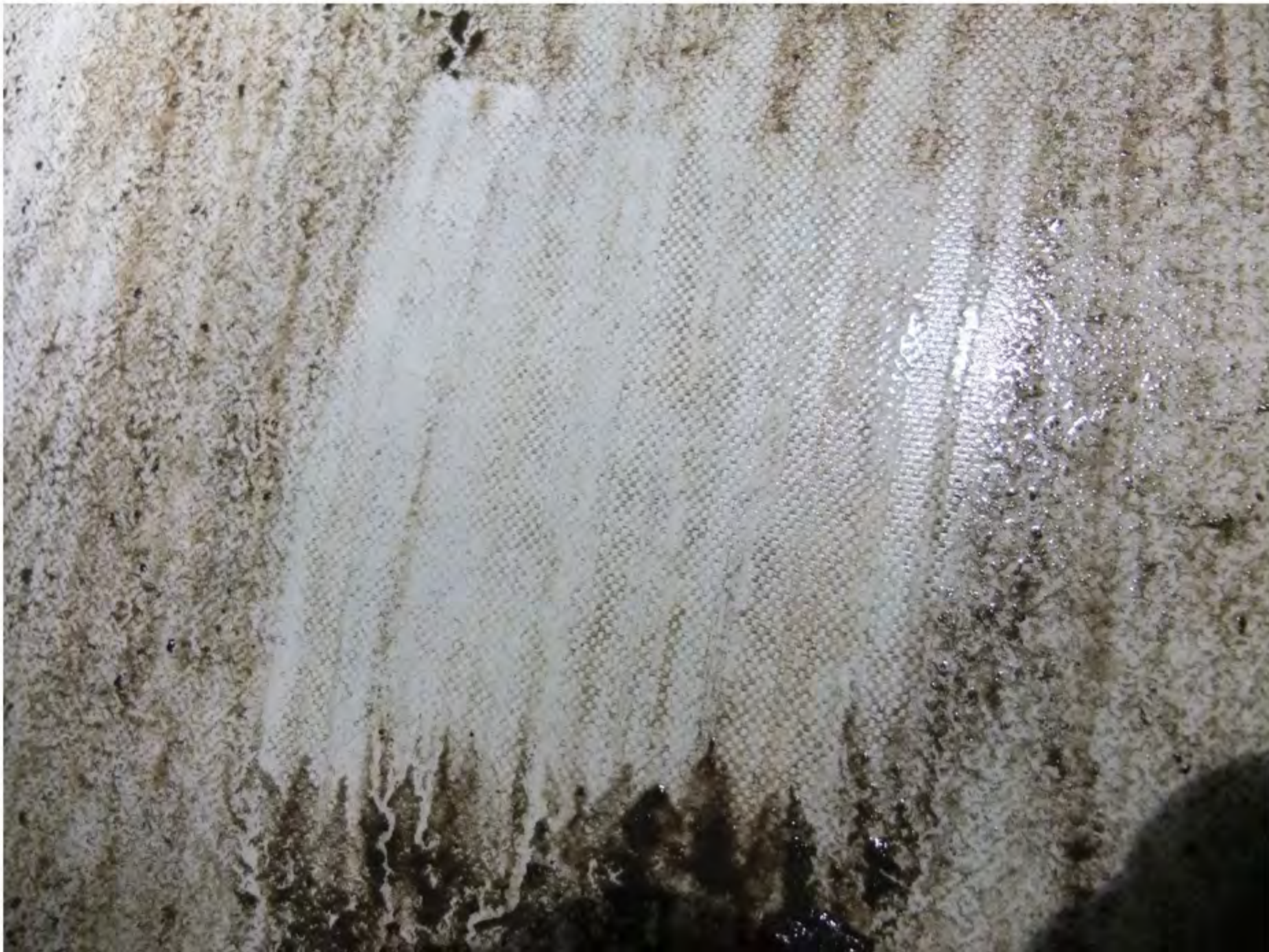
12 Tunnelduk type 554 på bergsiden etter at avleiringer er fjernet
