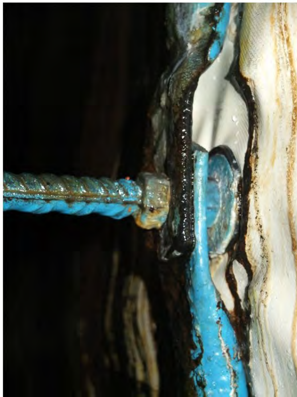
44 Blæring i Combicoat på bakrør og skive
