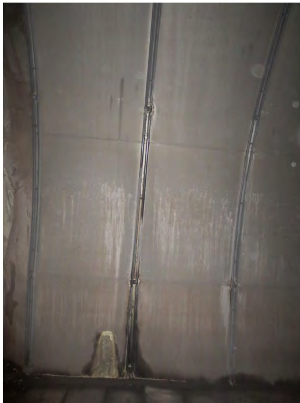
2 Tunnelduk østre seksjon med lekkasjepunkter
