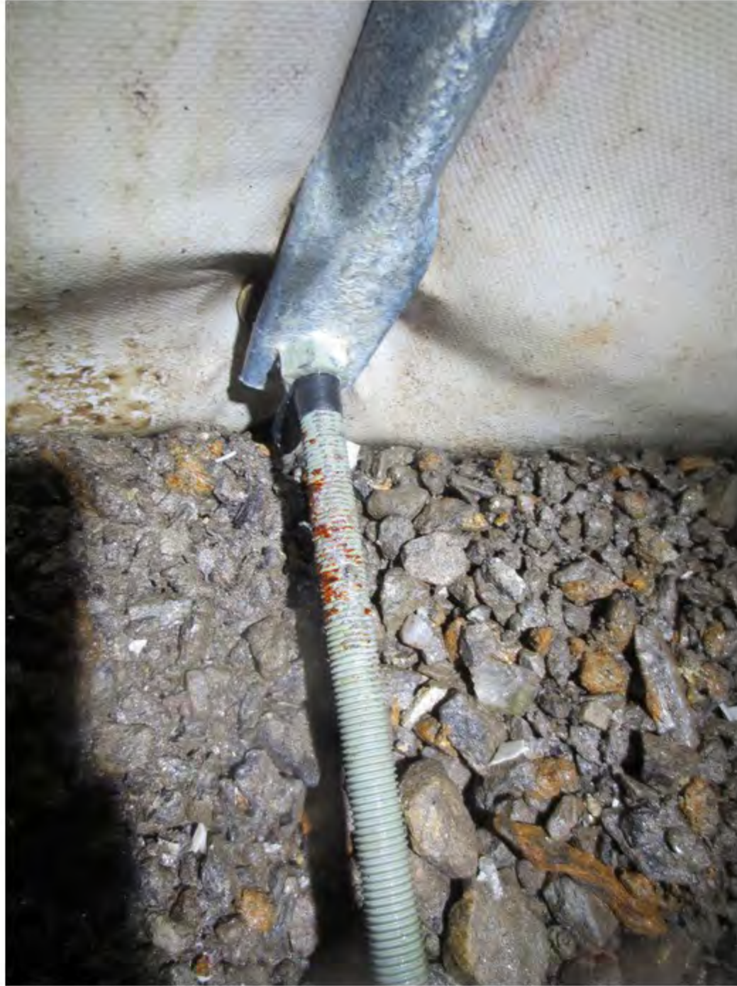
35 Profil 1100 - Påbegynt korrosjon i gjengeparti på Combicoated bolt
