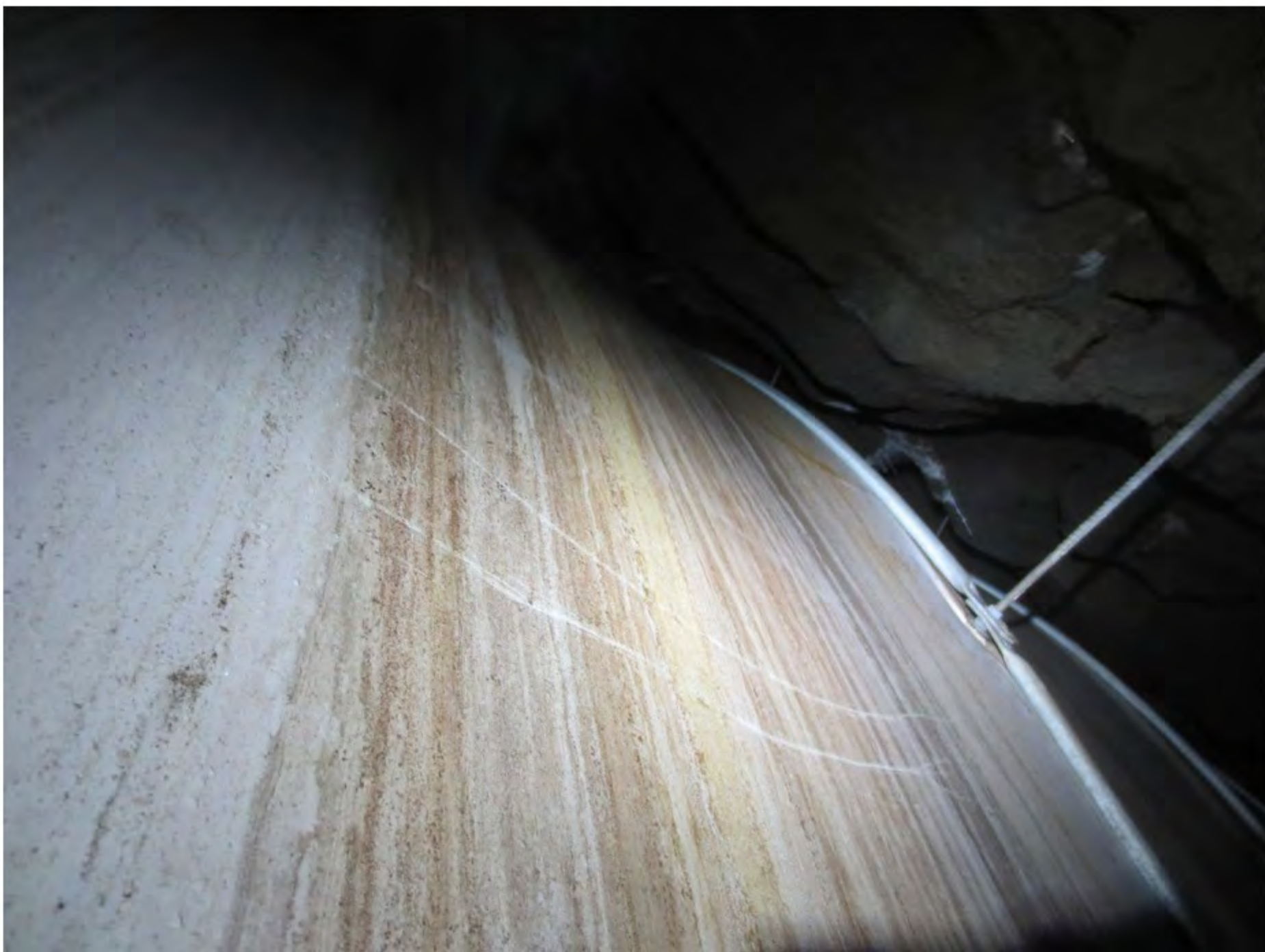
22 Profil 50 - Misfarging og belegg på duk fra lekkasjevann
