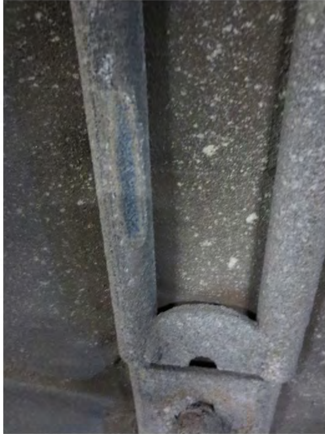
17 Ujevnheter og tæring på sink et stykke over bankett
