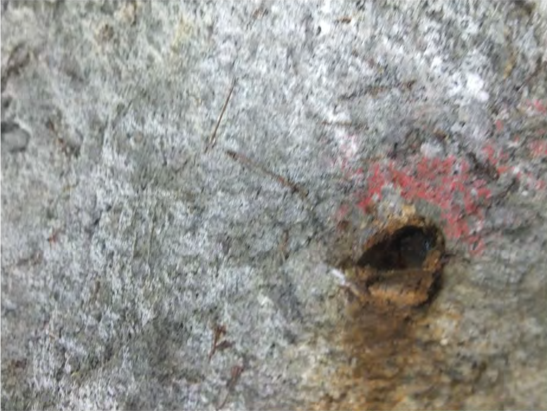
35 Bruddflate i festebolt inne i berget
