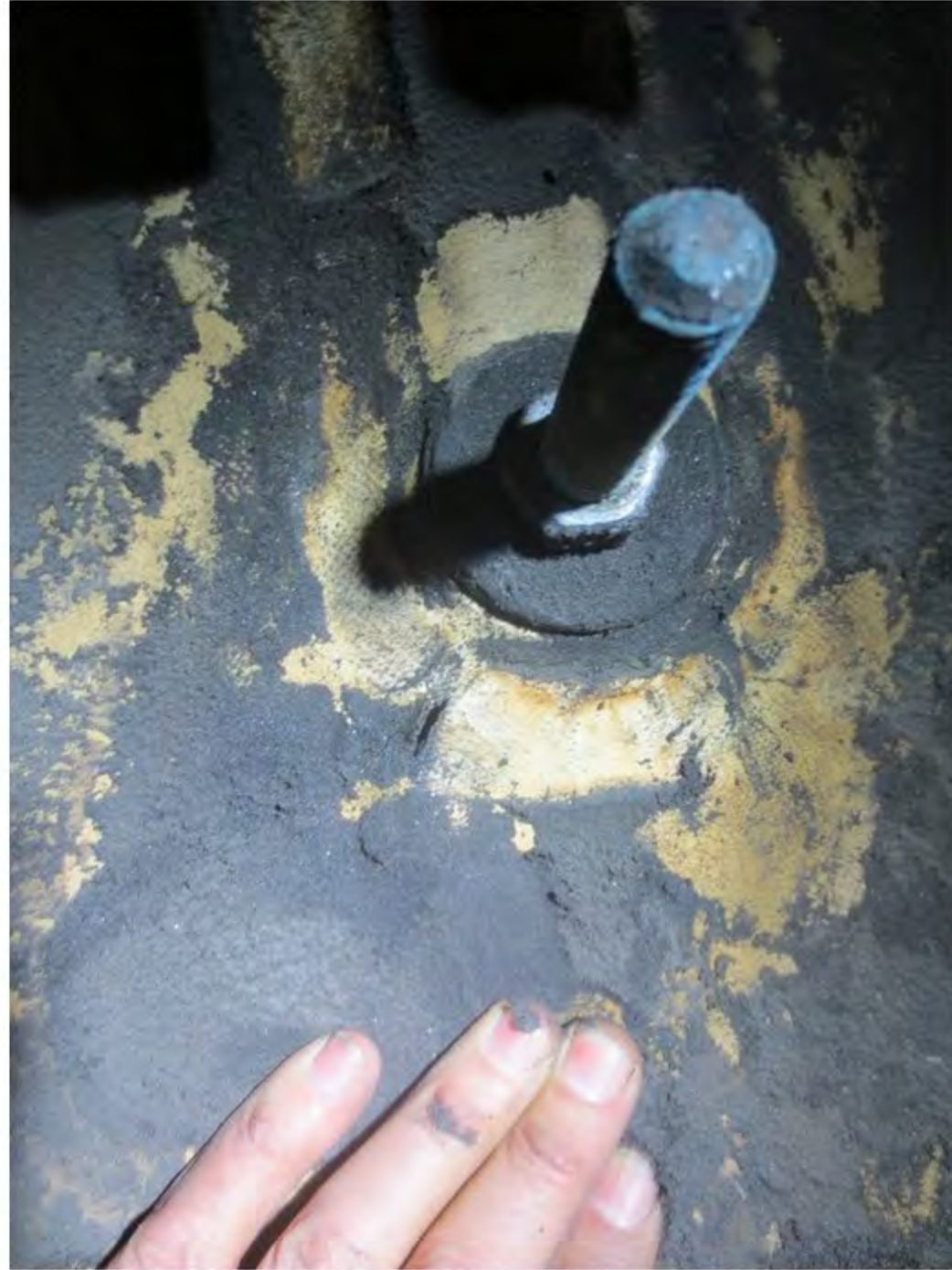
11 Fremrør demontert - Hull i duk nedenfor pakning
