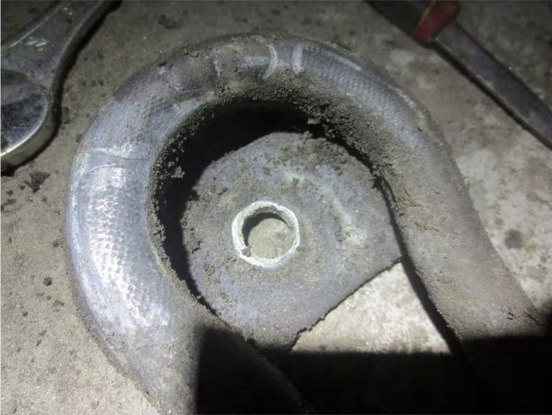
13 Ujevnheter i overflate på stålprofil
