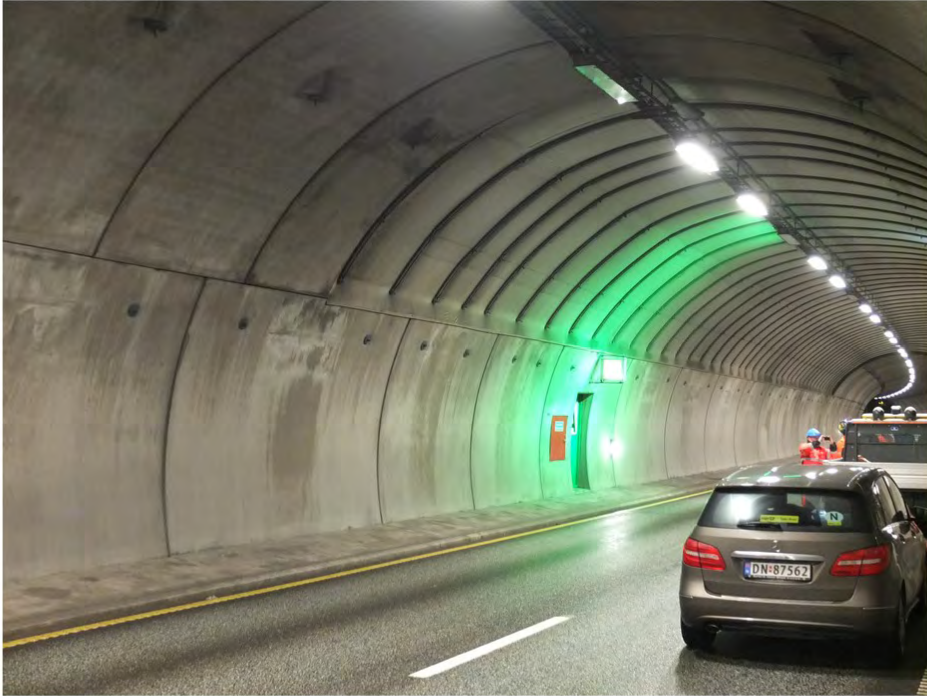
19 Tunnelduk i tak ved havrinisje
