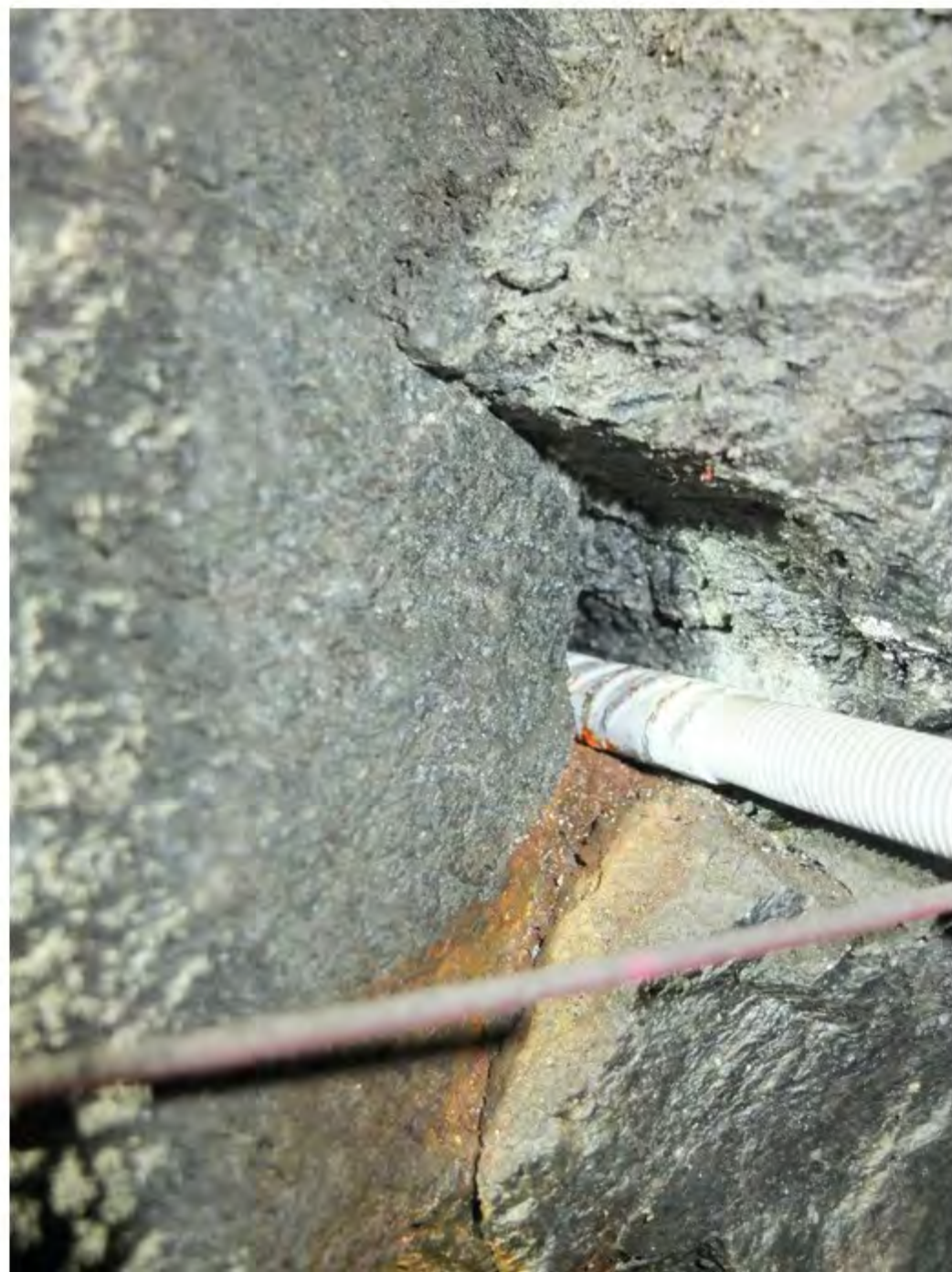
20 Lakkskade kammer - Lokal korrosjon
