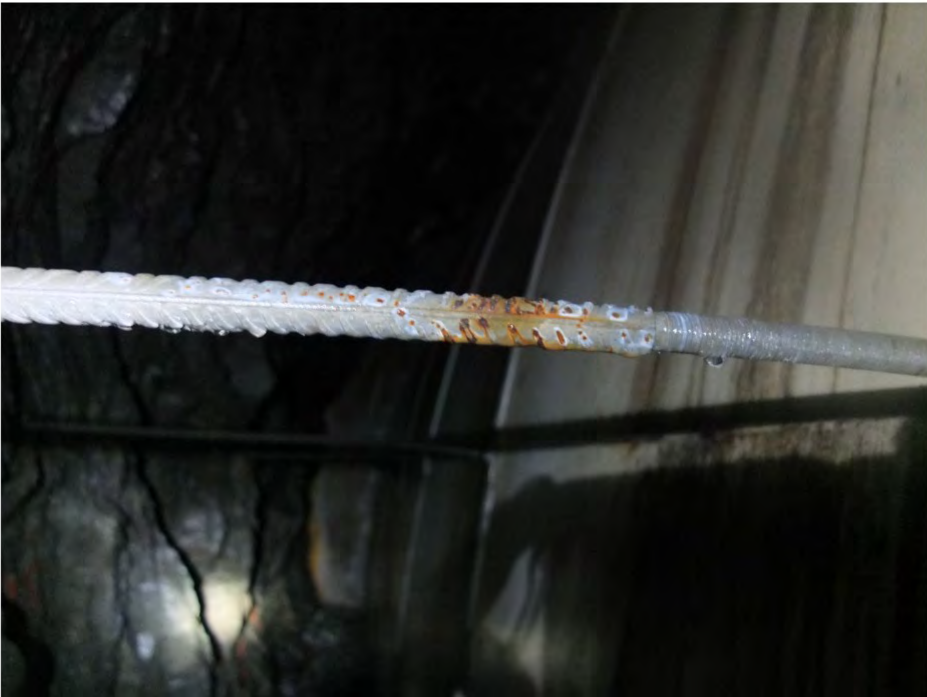
20 Skader i sinkbelegg samt misfarging
