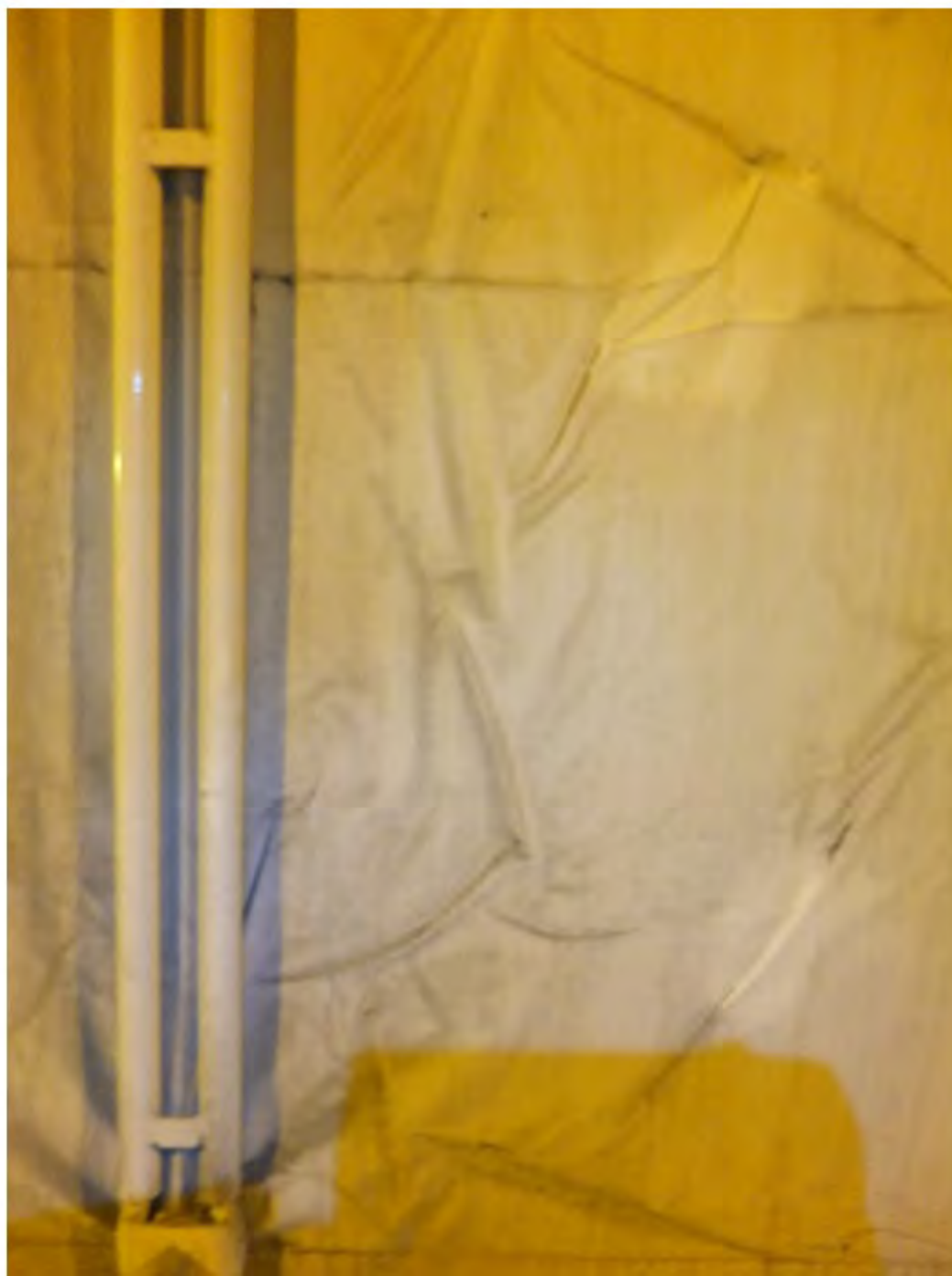
16 Reparasjonsfelt med duk type 556 - Stort omfang av bretter i duk - Dårlig stramming
