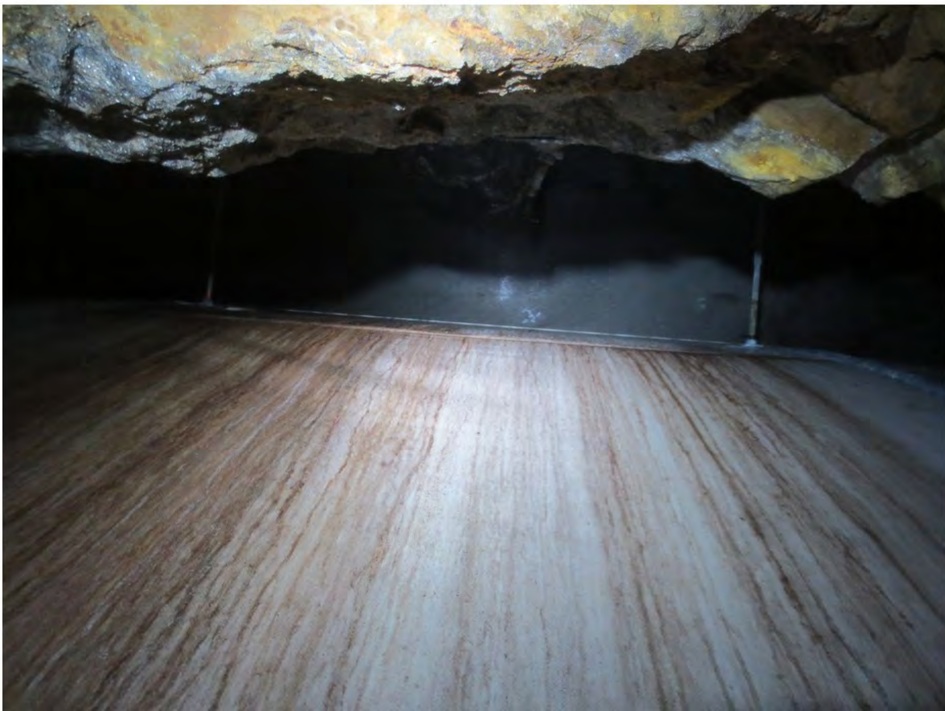
20 Profil 100 Bak hvelvet - Typisk belegg og avleiringer på tunnelduk
