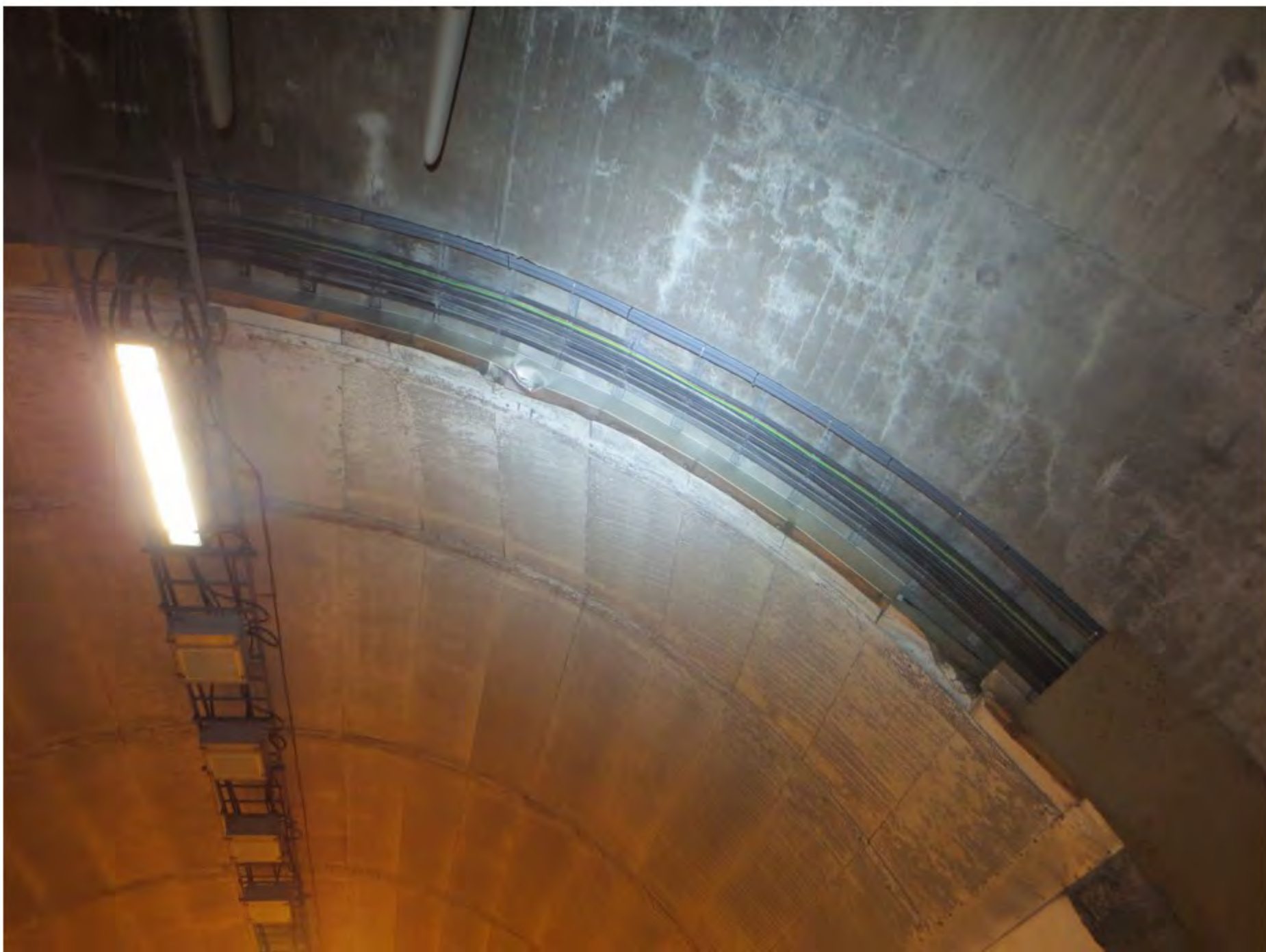
26 Mekanisk skade på avslutningsbeslag for platekassetene
