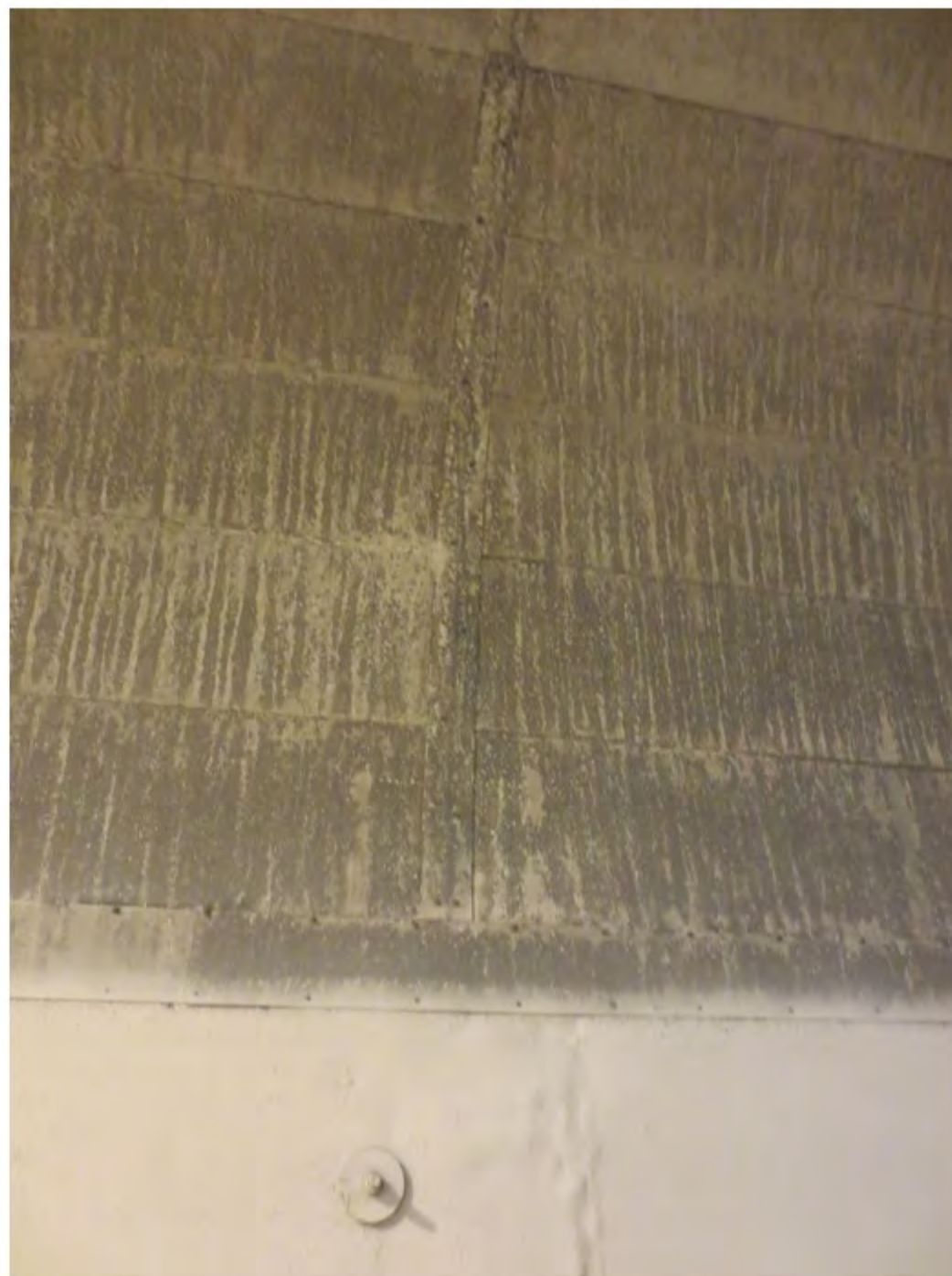
4 Mangelfull rengjøring av overflater
