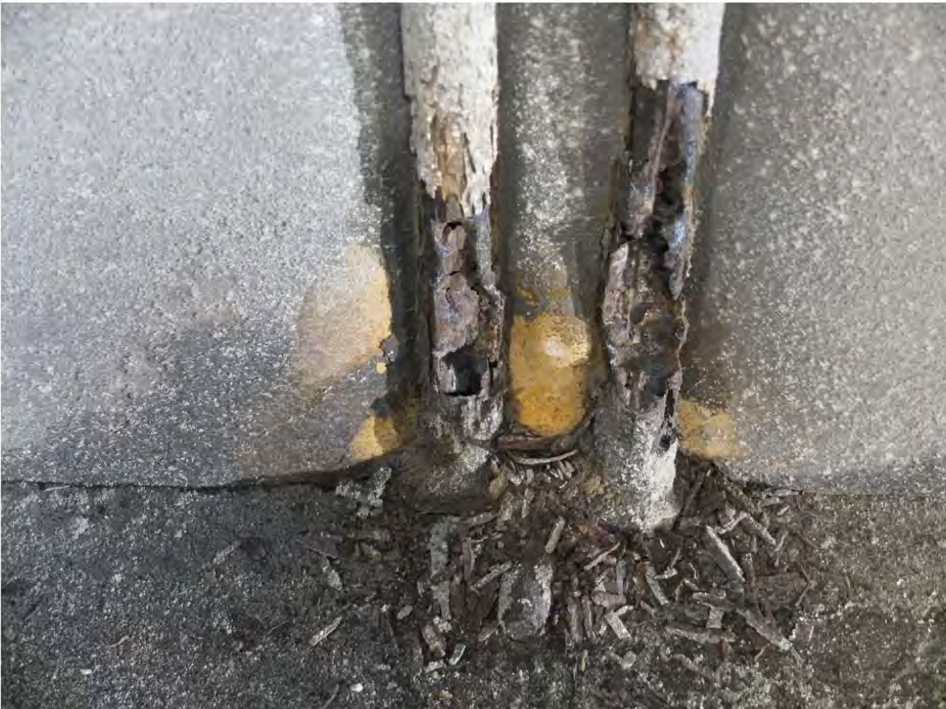
16 Fremrør er rustet helt av ned mot bankett
