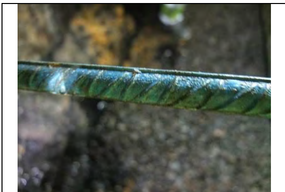
Foto 2.3.11. Blæring i pulverlakk på festebolter
