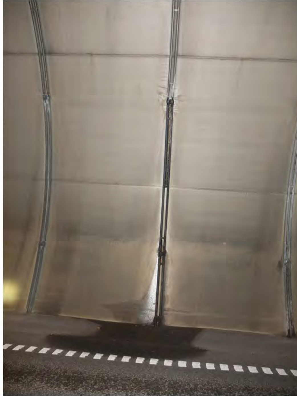
9 Lekkasje gjennom duk
