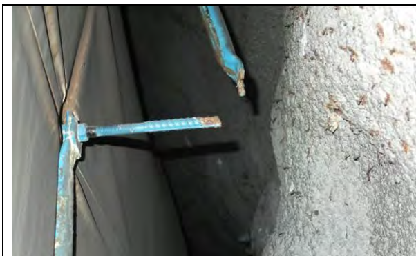
Foto 2.2.6. Brudd i festebolt og bakrør
