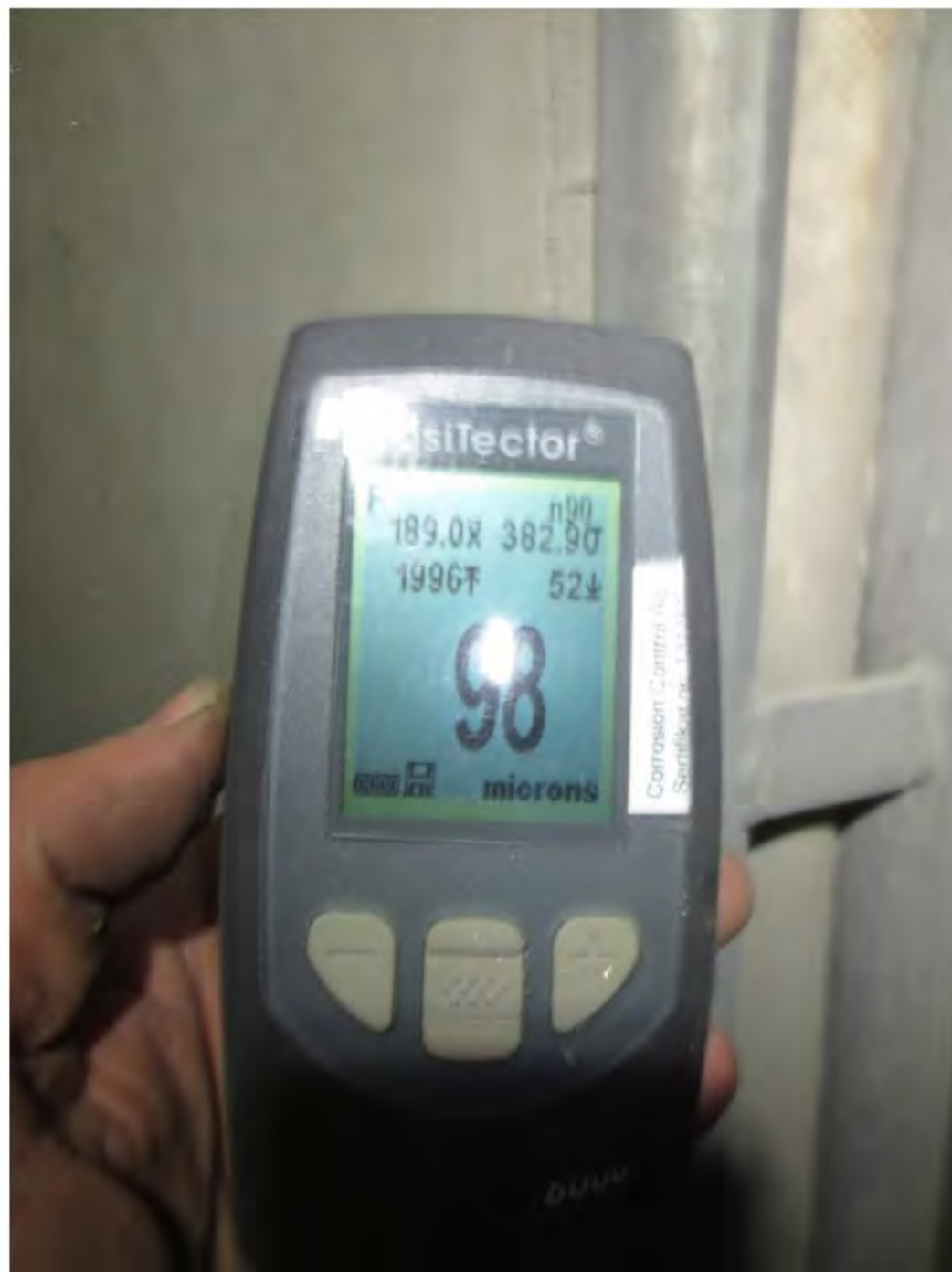
18 Profil 900 Framrør - Tykkelse varmforsinking 98 my 1 meter over bankett
