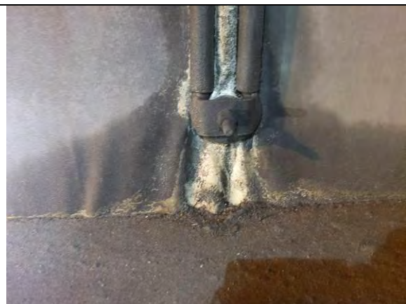
Foto 2.4.3. Lekkasje gjennom duk ved nedre boltegjennomføring
