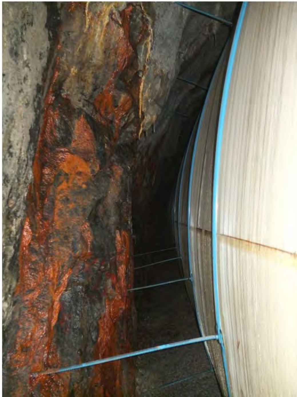
26 Oversikt duk og stålkomponenter bak hvelvet - 1,7 km fra portal Hitrasiden i bunnpartiet
