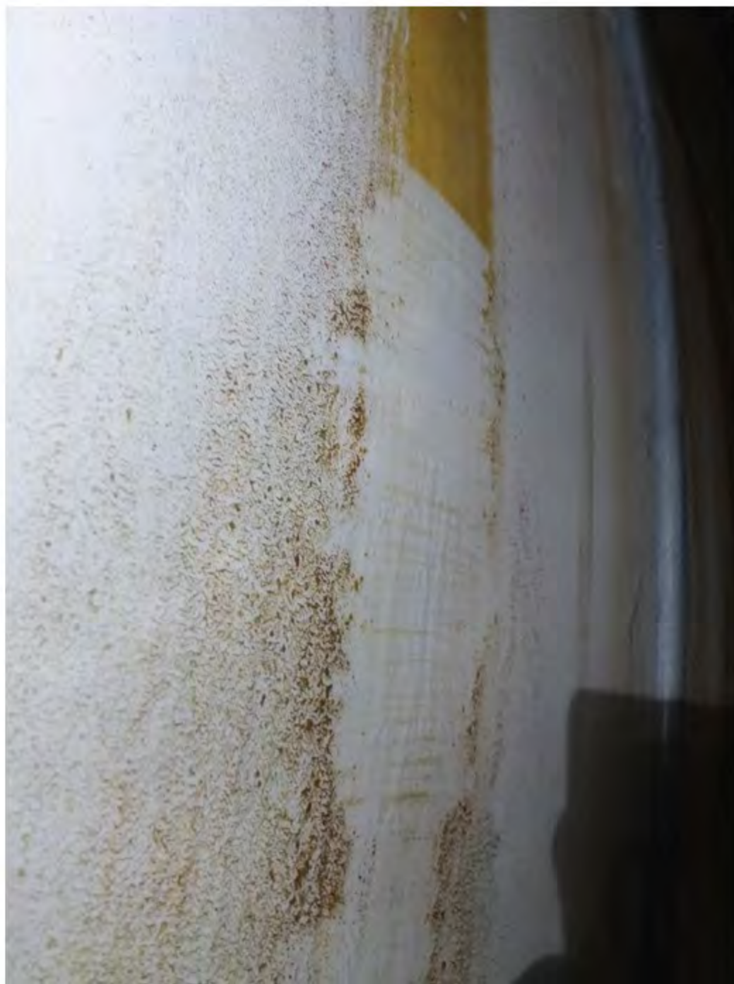
24 Profil 1300 - Belegg fjernet - Ingen synlig skade på duken
