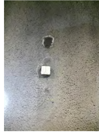
Foto 2.10.4. Punktlekkasje motsatt side.
