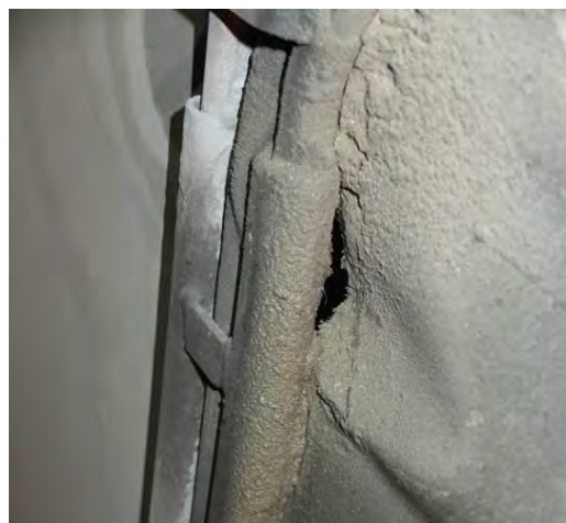
Foto 2.9.10. Hull i duk ved rørbue på trafikksiden.
