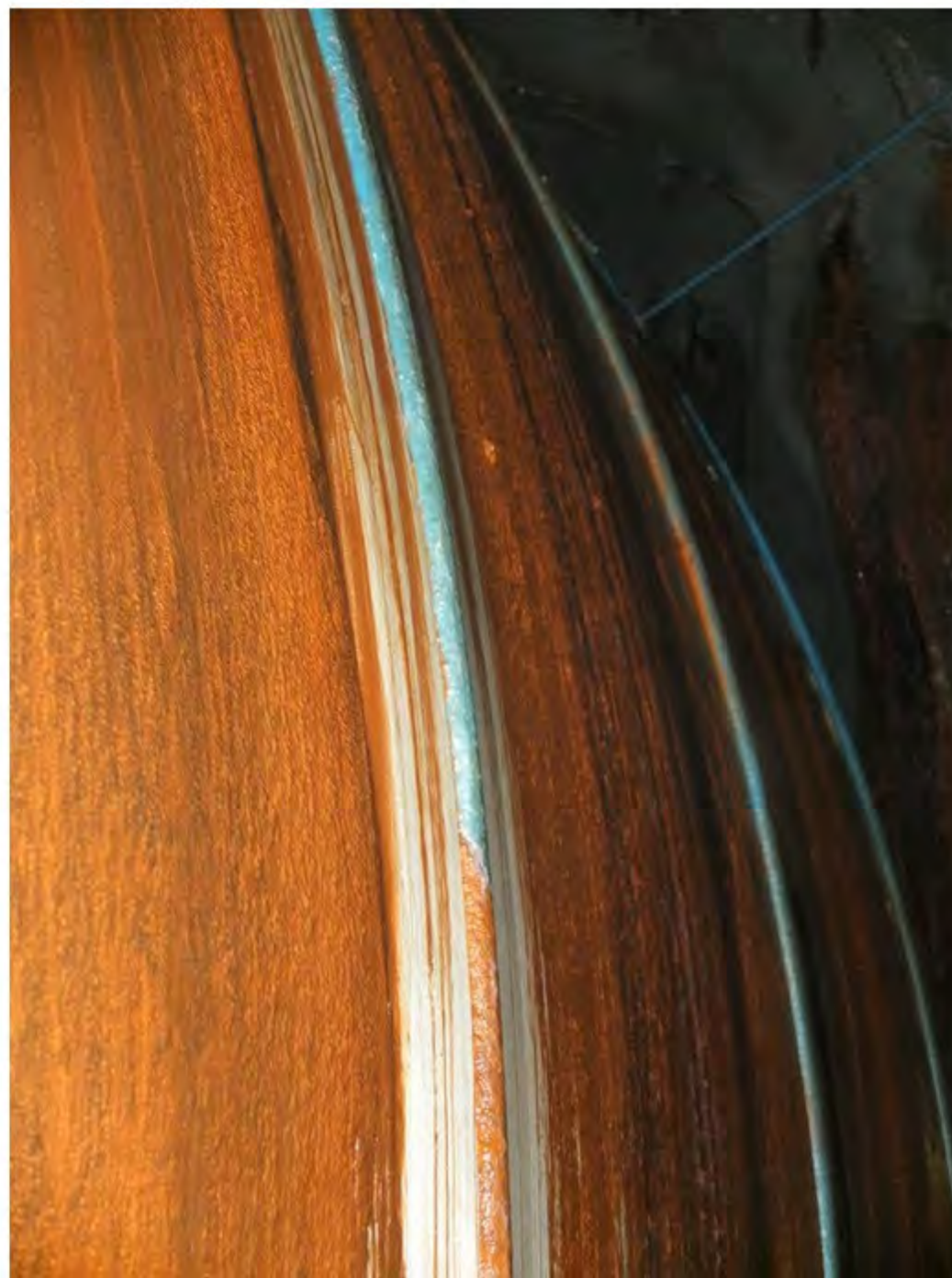
30 Avleiringer på tunnelduk på baksiden av hvelvet - 2 km fra portal Hitrasiden i bunnpartiet
