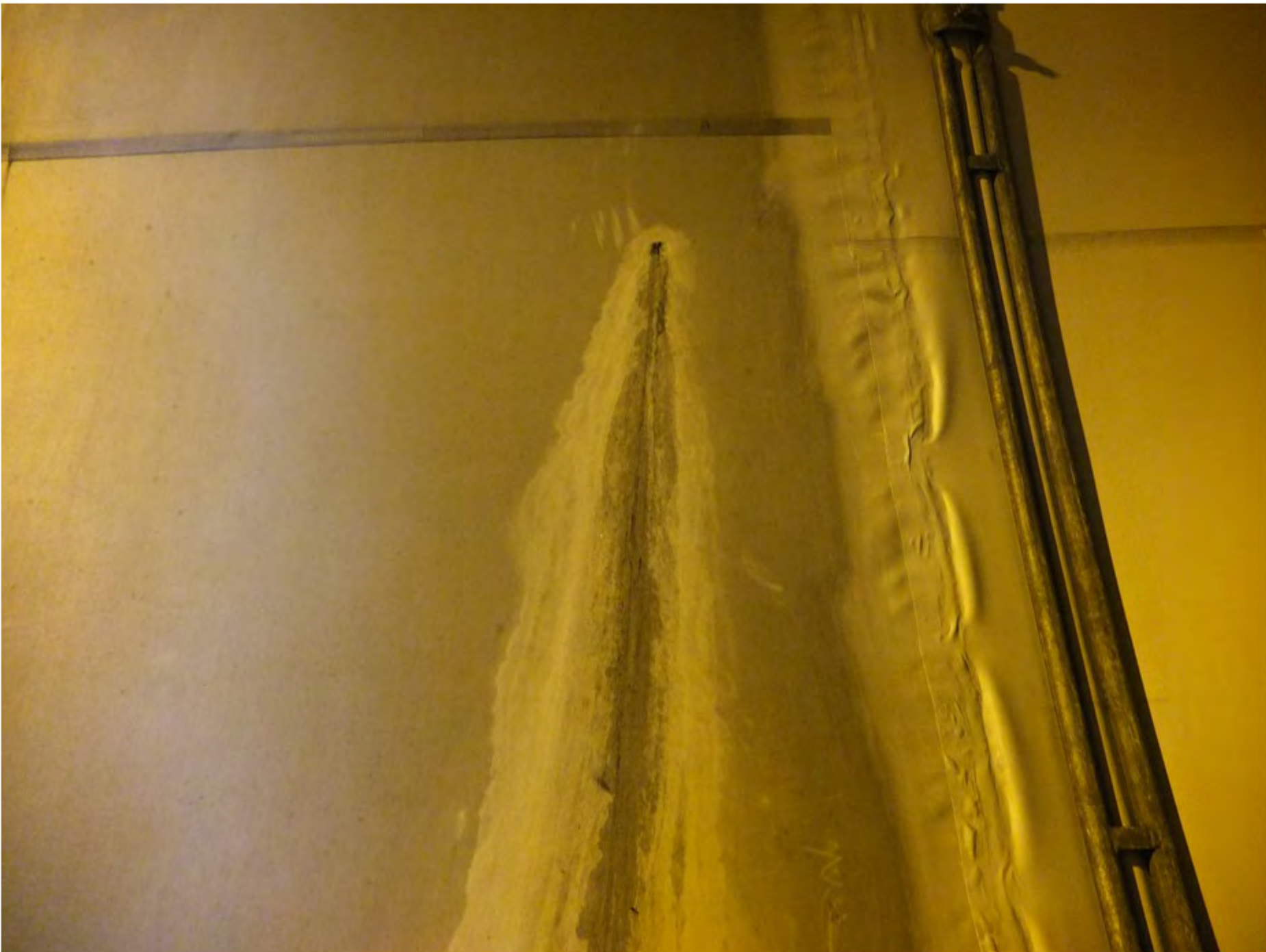
8 Overgang til reparert sone - Hull i duk etter mekanisk skade
