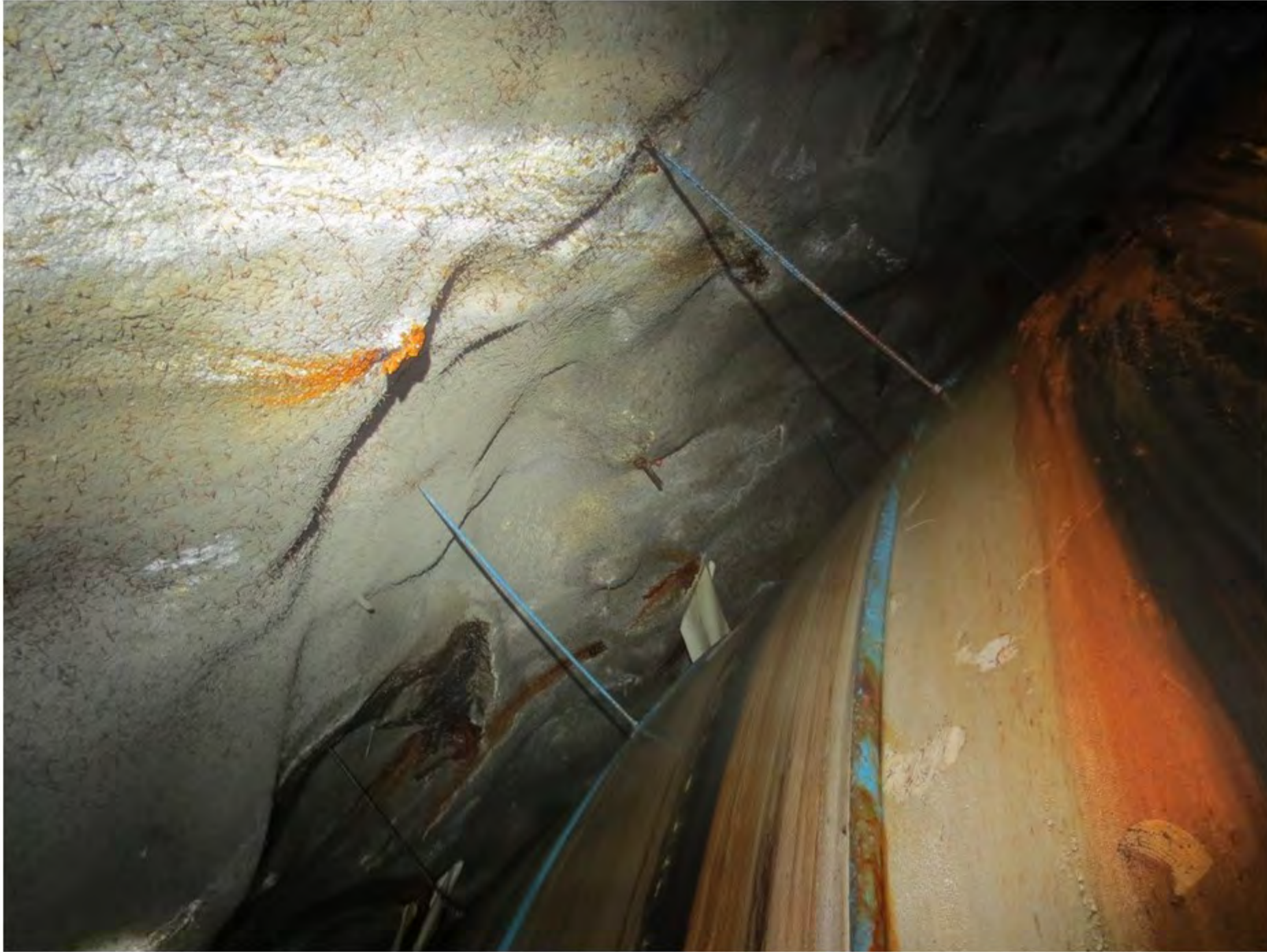
31 Belegg på tunnelduk
