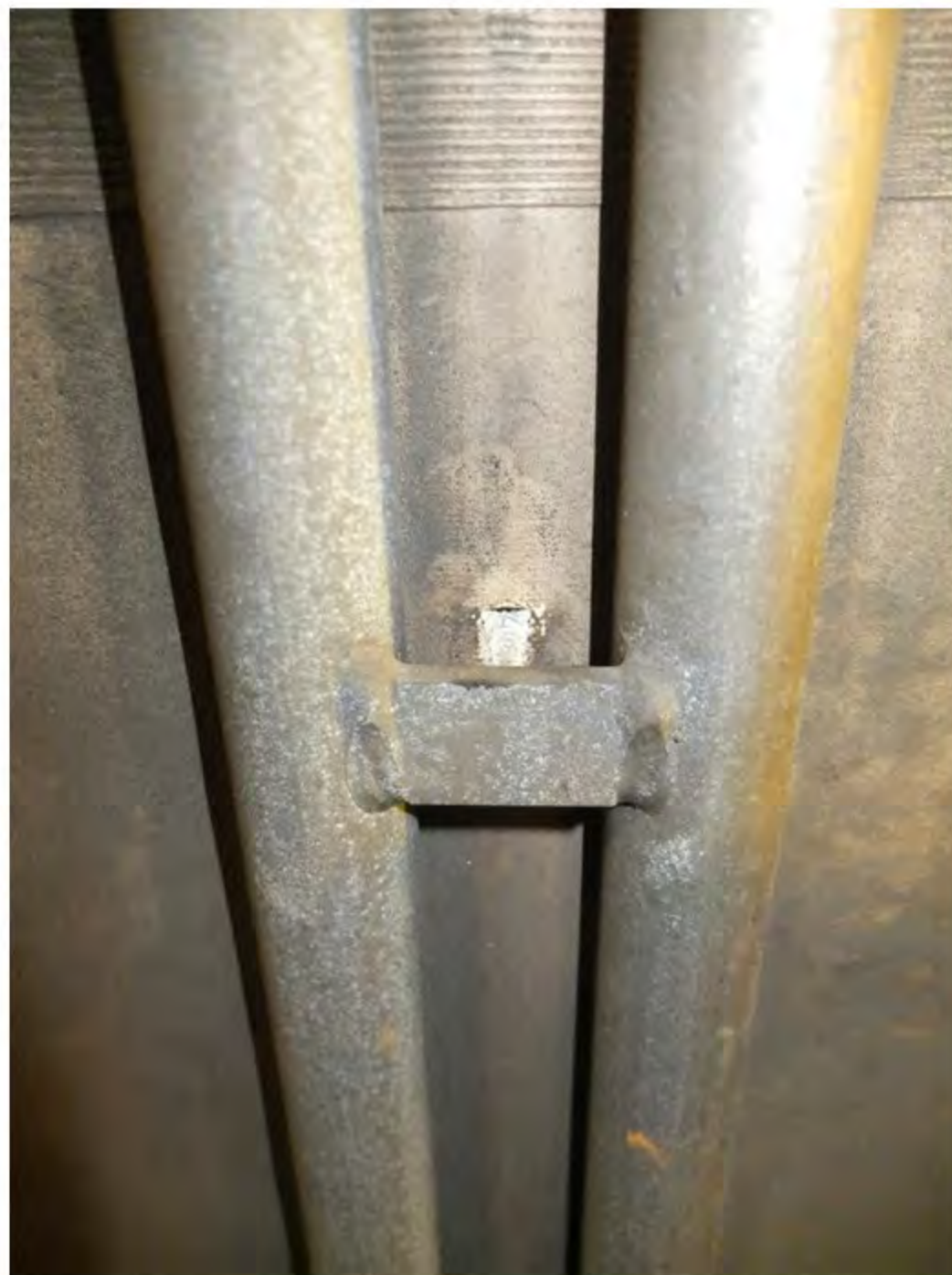
14 Lokal skade i duk fra tverrstål mellom fremrørene
