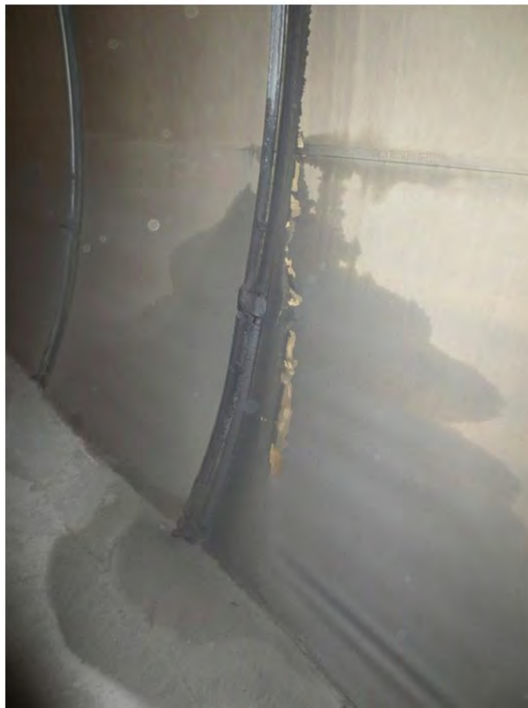
6 Fuktgjennomgang i tunnelduk
