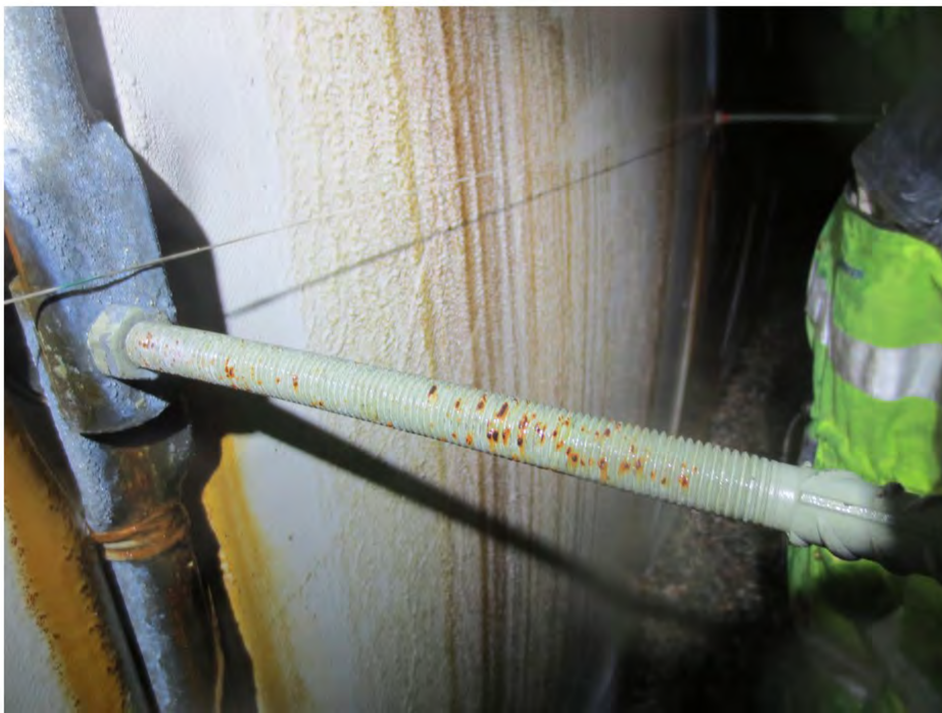
34 Profil 1300 - Avleiringer fra lekkasjevann på festebolt
