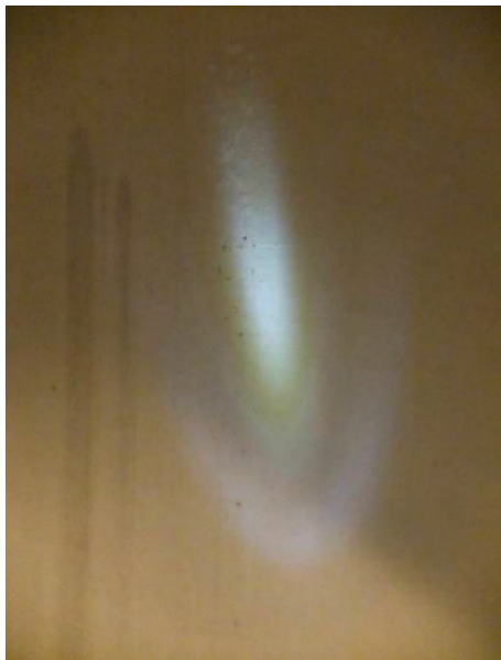
Foto 2.6.7. Avleiring til v. Betydelig lekkasje mot baksiden, opplyst område. Lekkasje (nedfukning av polyestervev).
