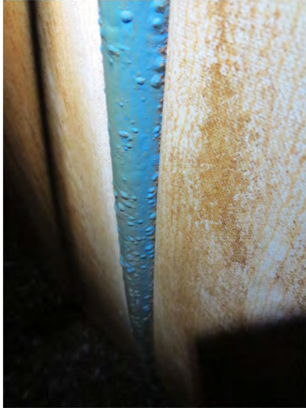
19 Blæring i lakk - 300 meter inn fra Bjorøysiden
