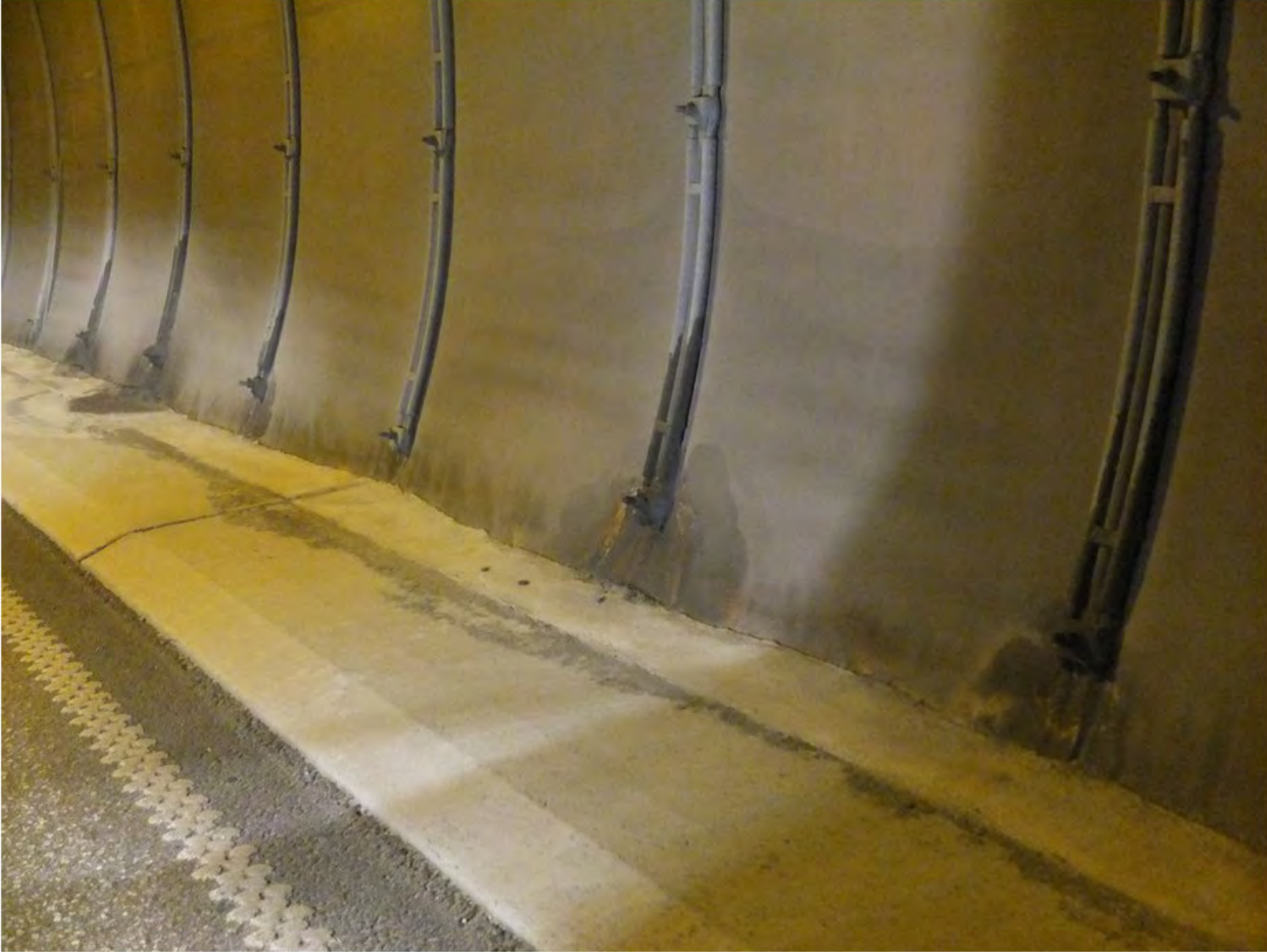
5 Fuktgjennomgang i tunnelduk
