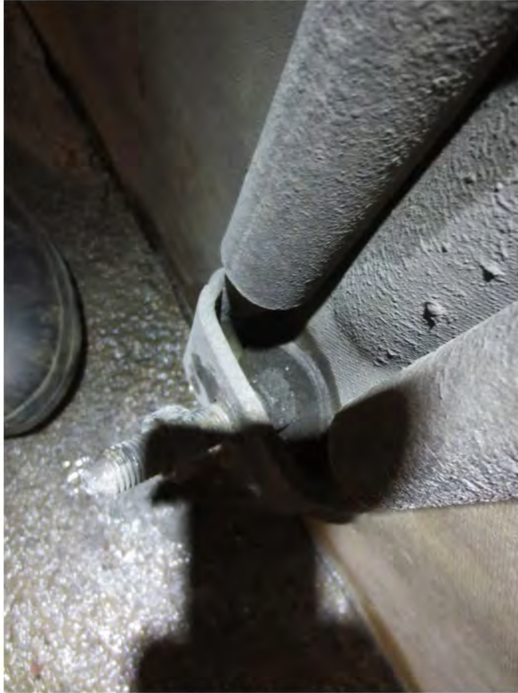
15 Fremrør løsnet i lekkasjepunkt
