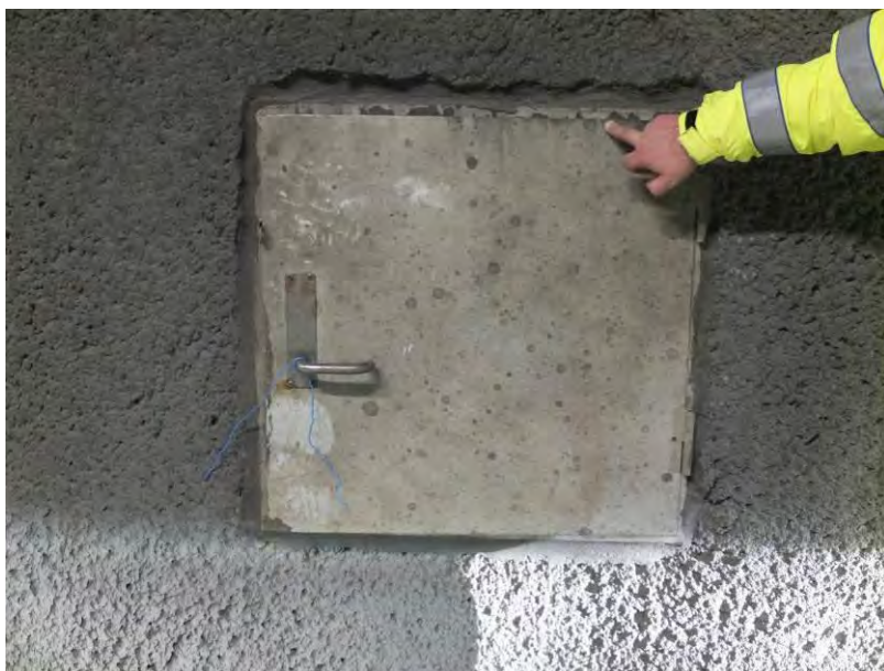
Foto 2.10.9. Luke for adkomst bak hvelvet, totalt 3 stk i Ellingsøytunnelen.
