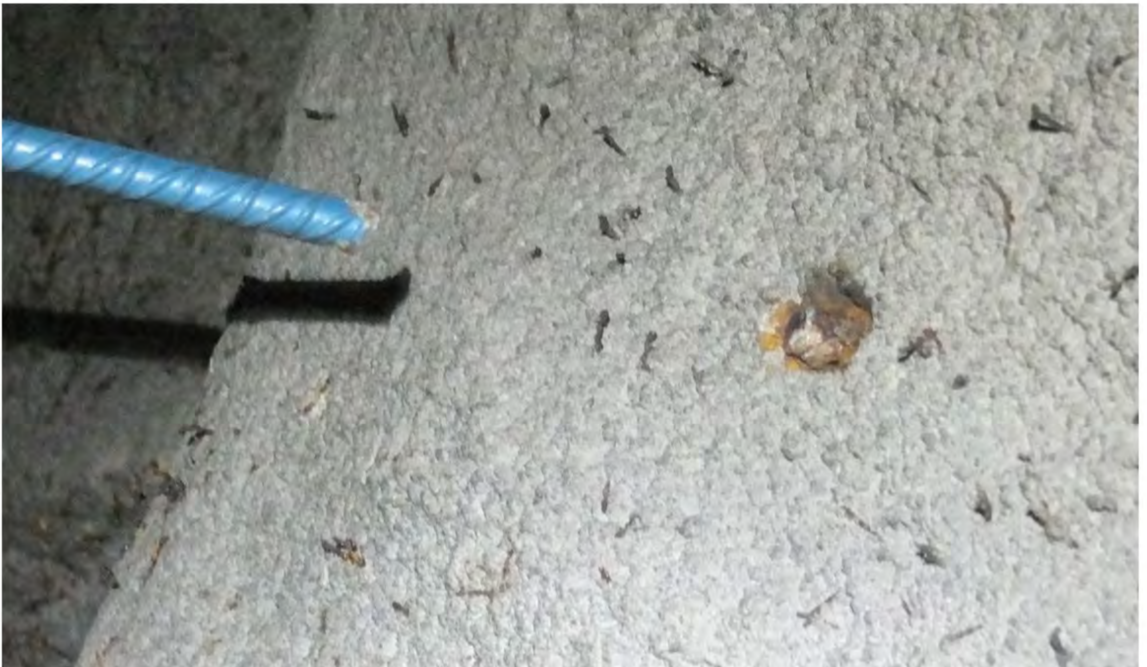
22 Brudd i festebolt 1,5 km fra portal Frøyasiden - Kraftig korrosjon på bolt ved innfesting i berg
