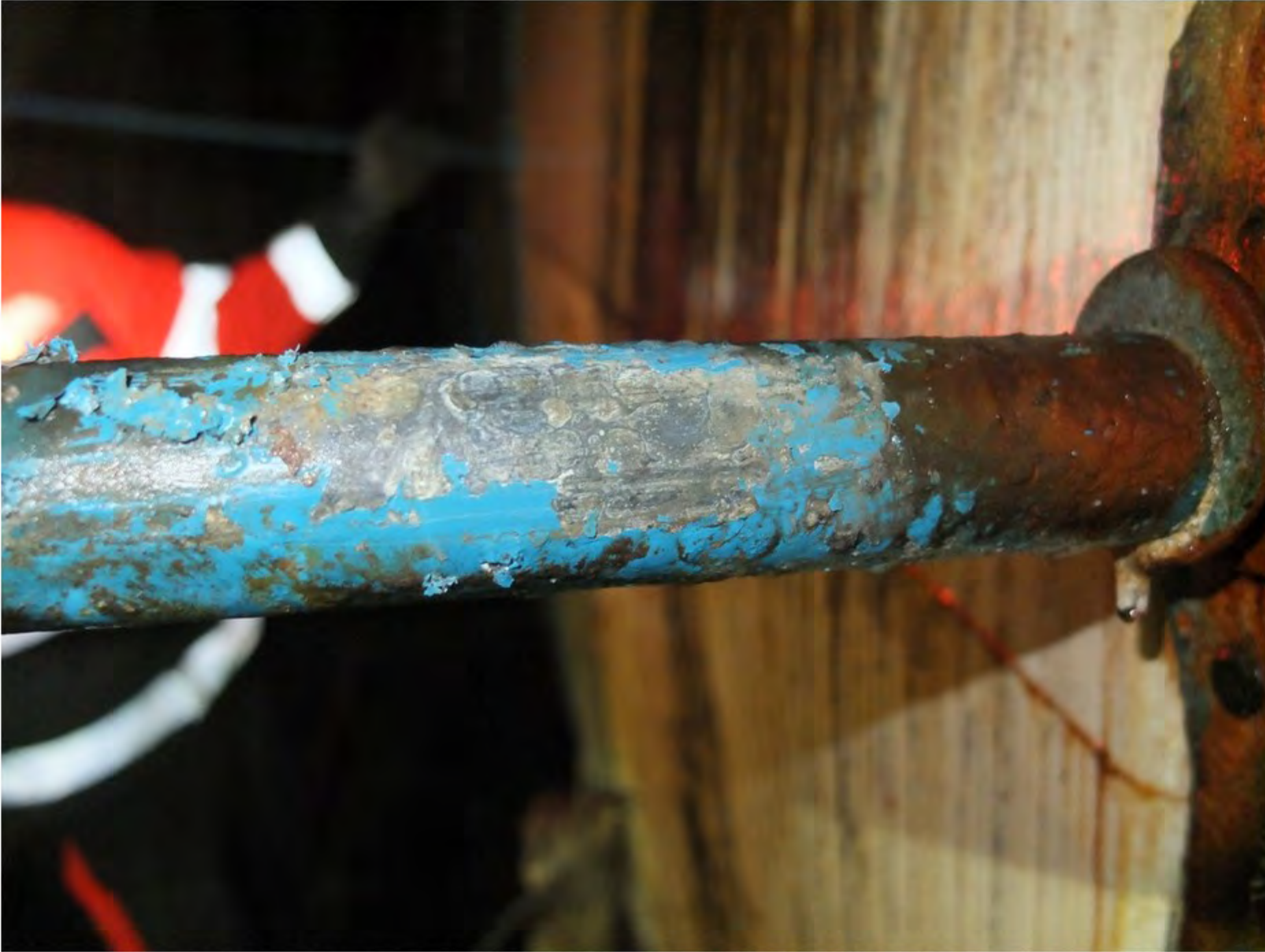
41 Blærende Combicoat fjernet på avstivningsrør for festebolt - 2 km fra portal Hitrasiden i bunnpartiet
