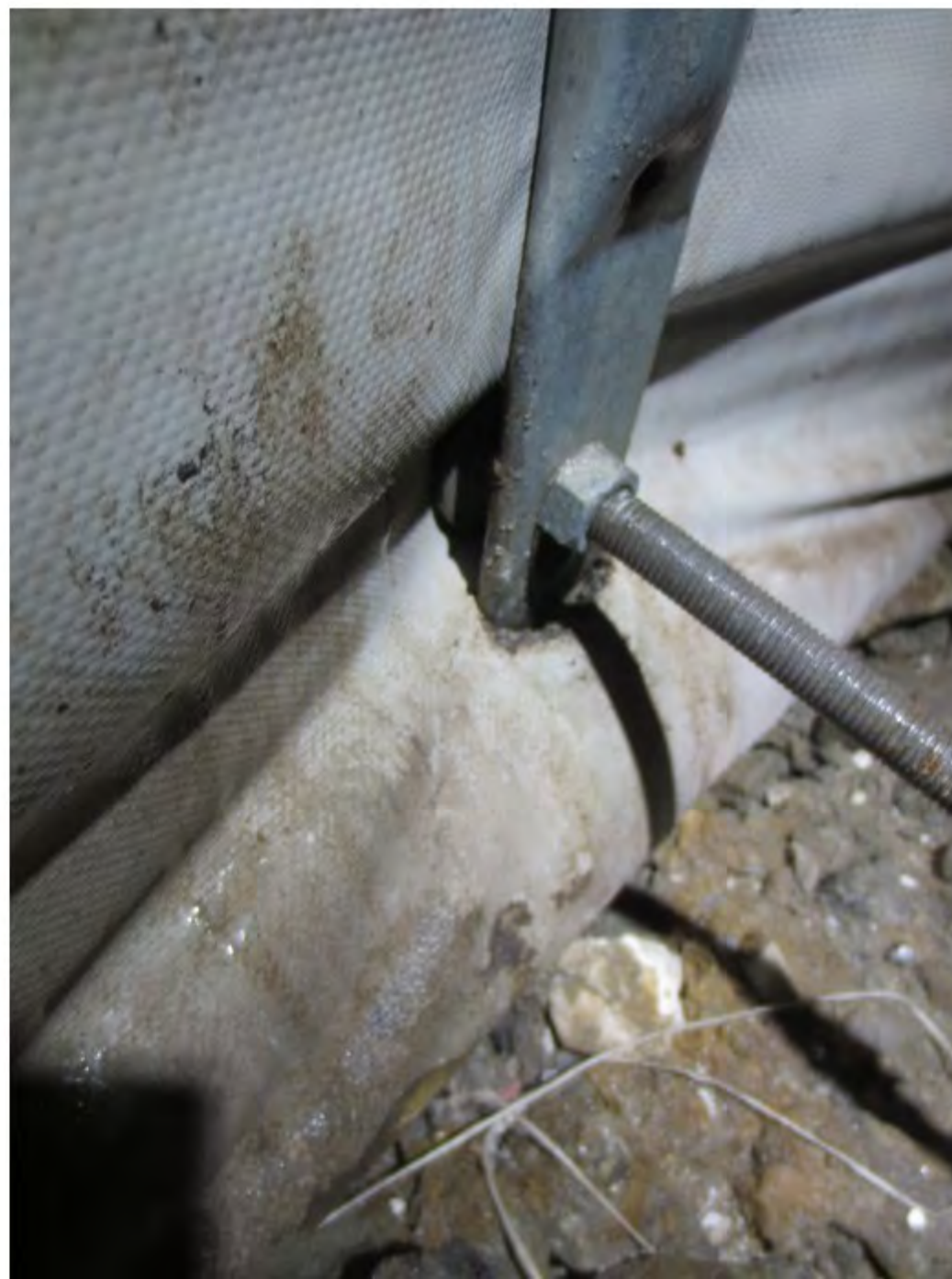
24 Profil 200 - Brudd i duk ved endeavslutning av bakrør
