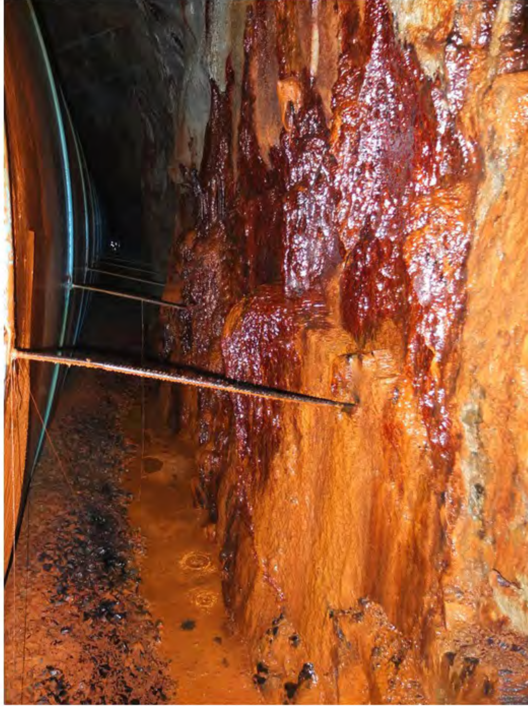
15 Innlekkasje bak hvelvet
