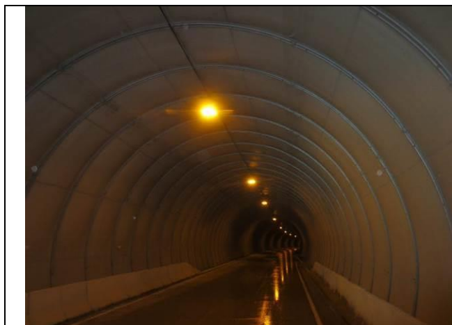
Foto 2.9.2. Føringskant i lengde ca 20 m fra vestre portal
