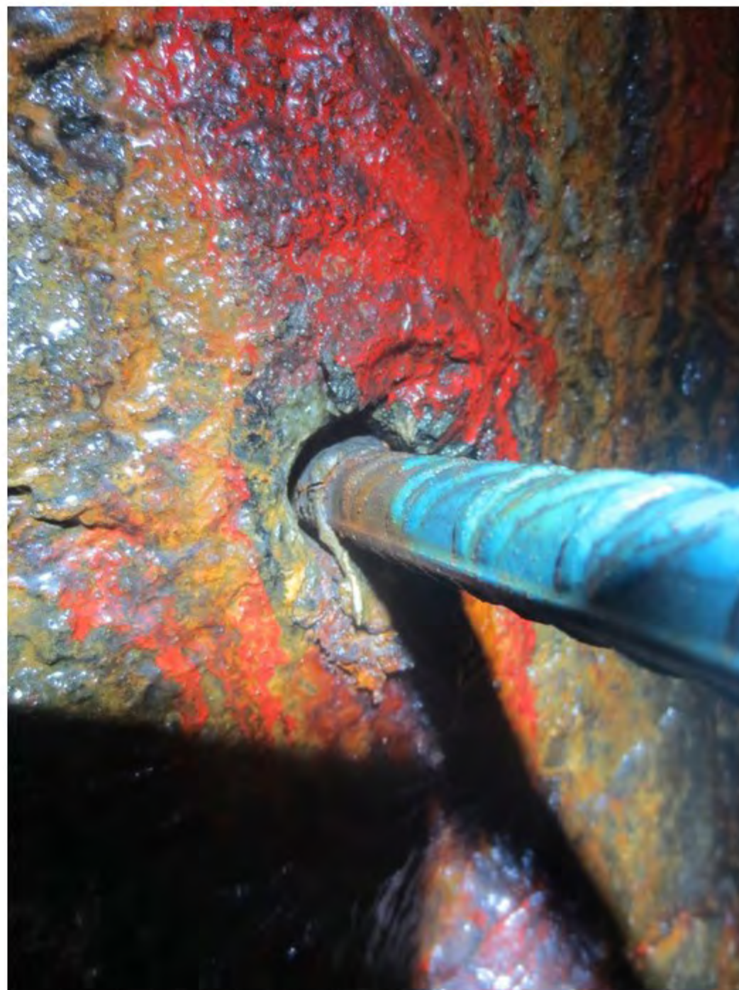
28 Mangelfull innstøping av festebolt
