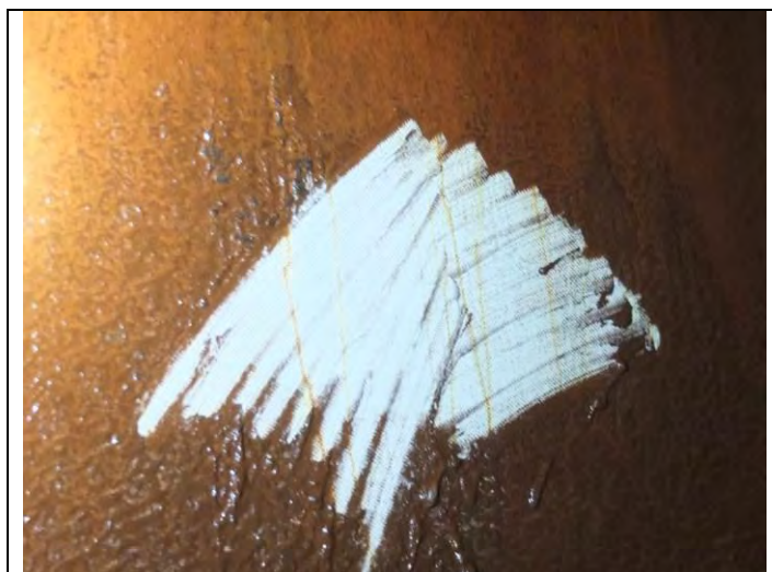
Foto 2.3.7. Duk i god stand. Belegg er fjernet, noe misfarging.
