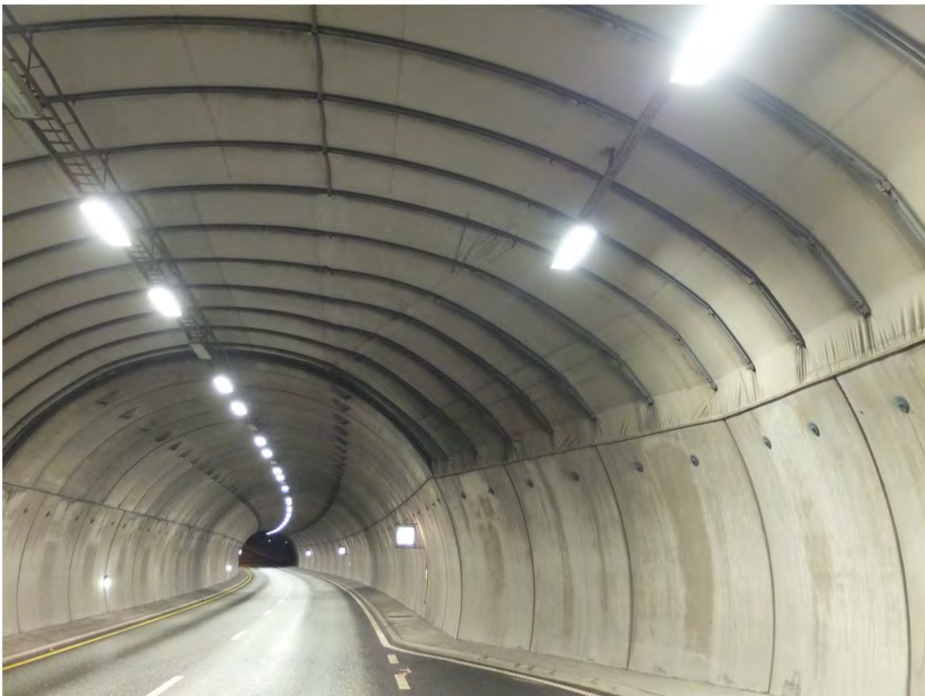
18 Tunnelduk i tak ved havarinisje
