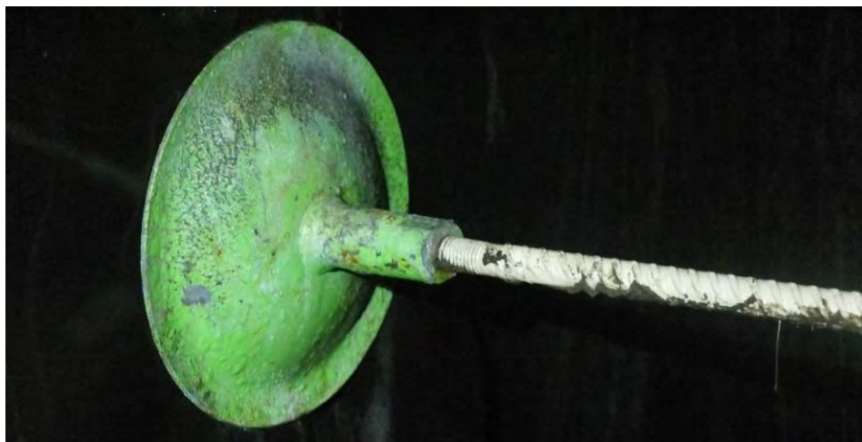
Foto 2.10.16. Mindre rustutfelling på skive og hylse (saltvannssonen)
