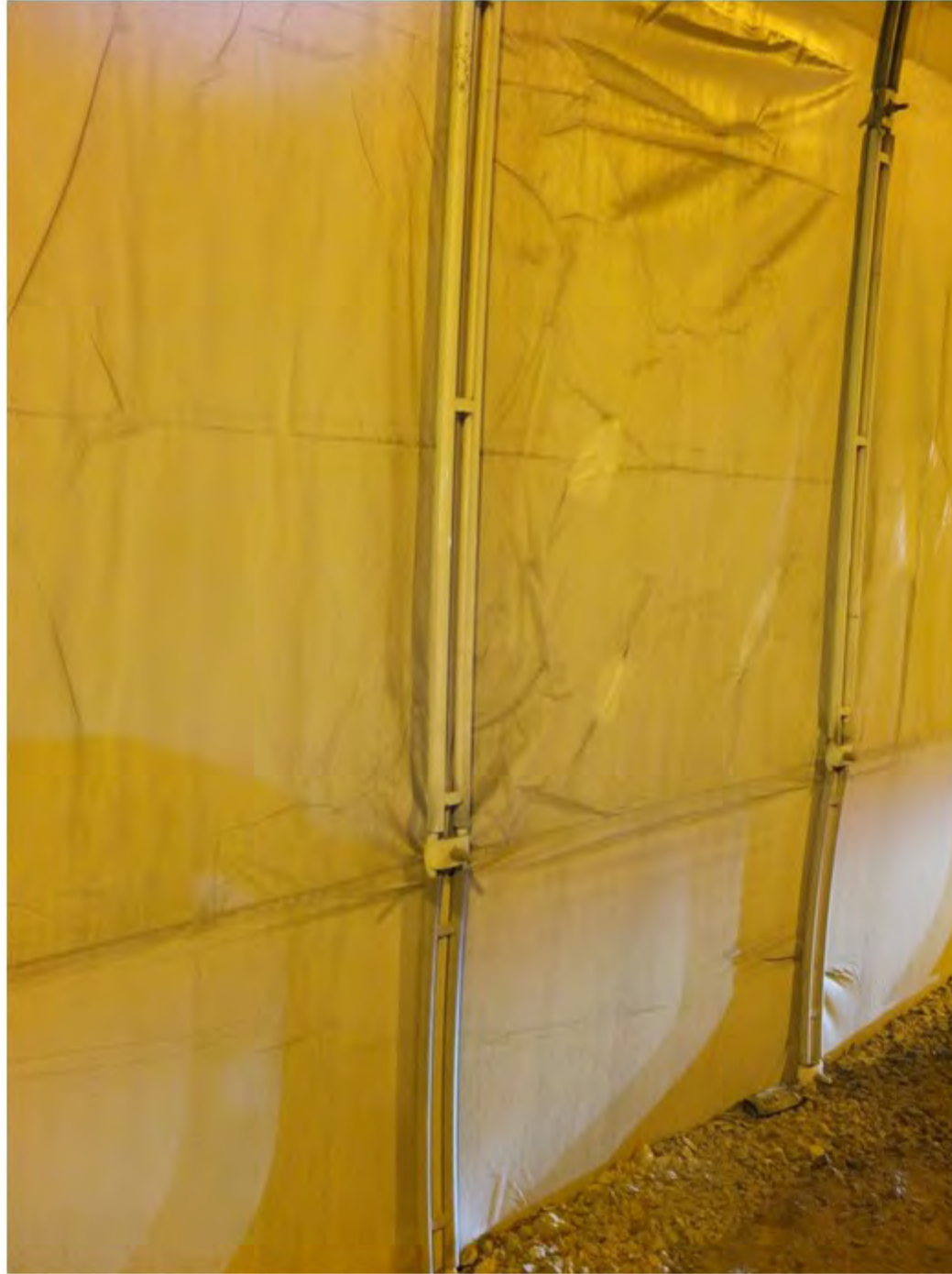
15 Reparasjonsfelt med duk type 556 - Stort omfang av bretter i duk
