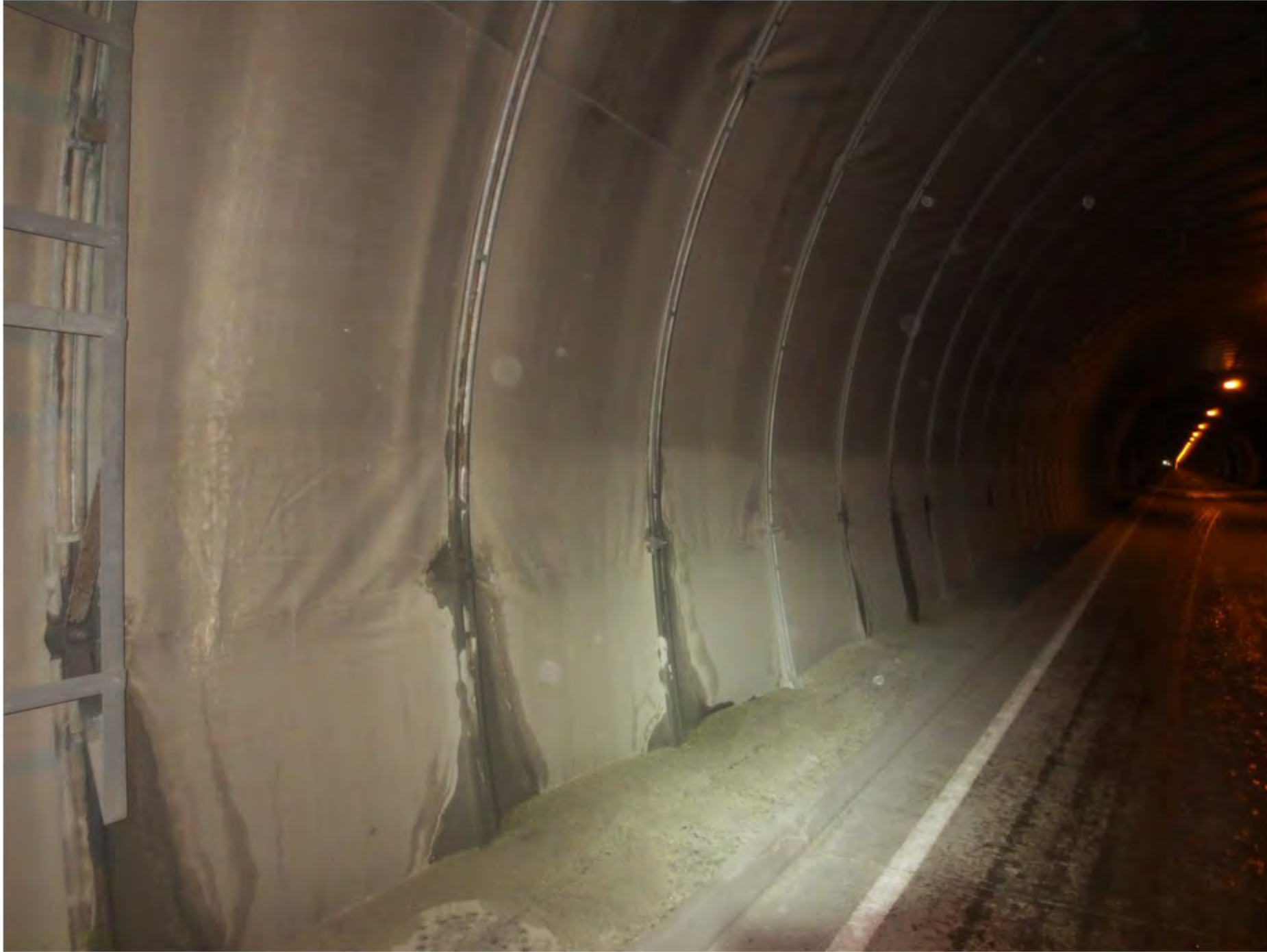
11 Profil 1560 - Fukt og mindre lekkasjer ved festebolter
