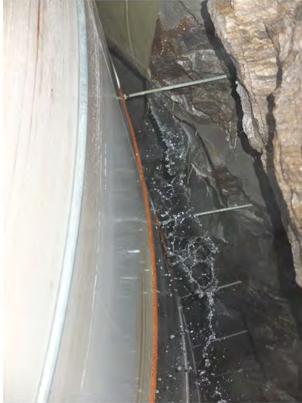
21 Profil 1100 - Avskjernet omfattende punktlekkasje
