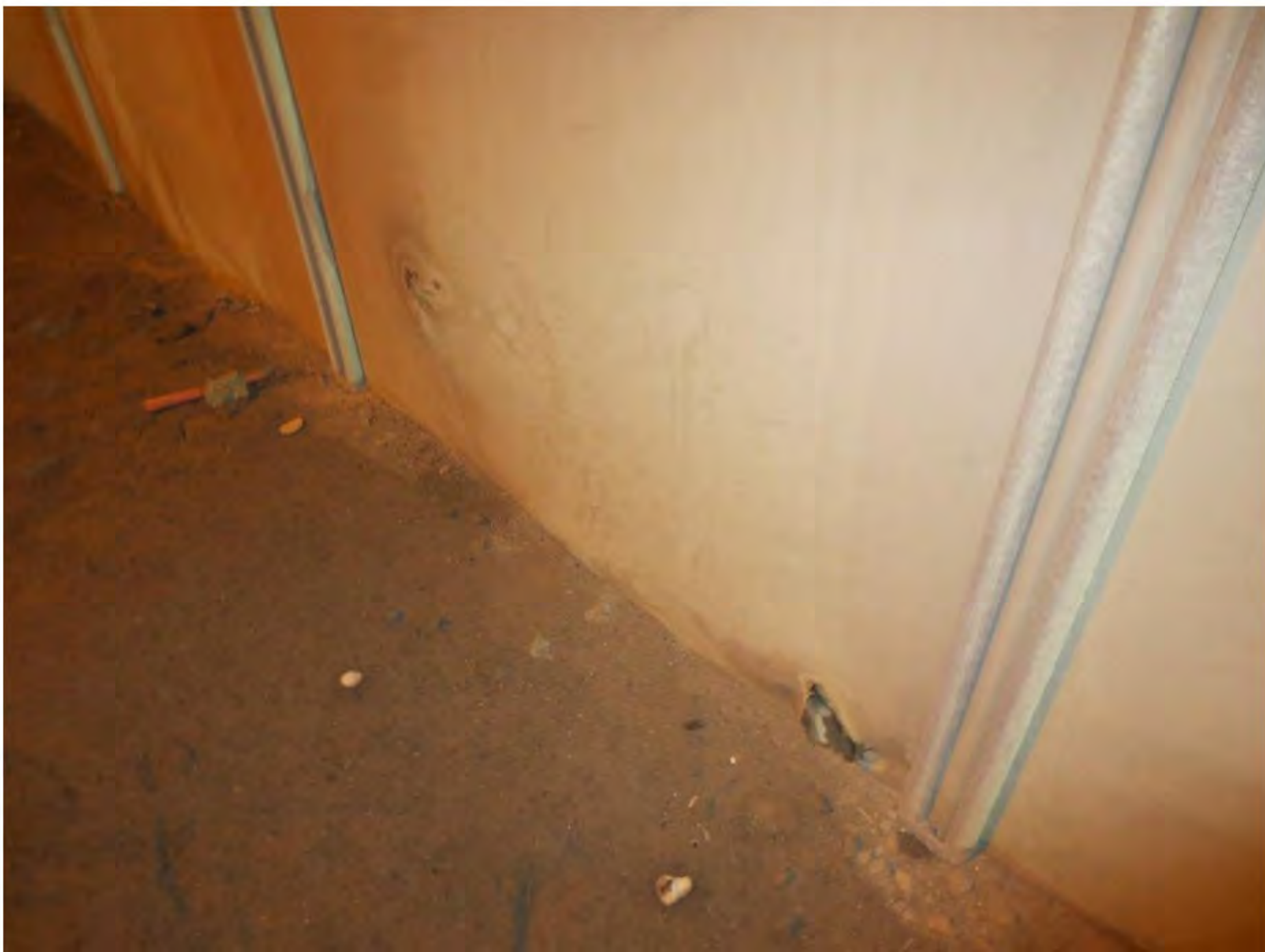
6 Profil 50 - Skade i duk rett over oppfylt skulder
