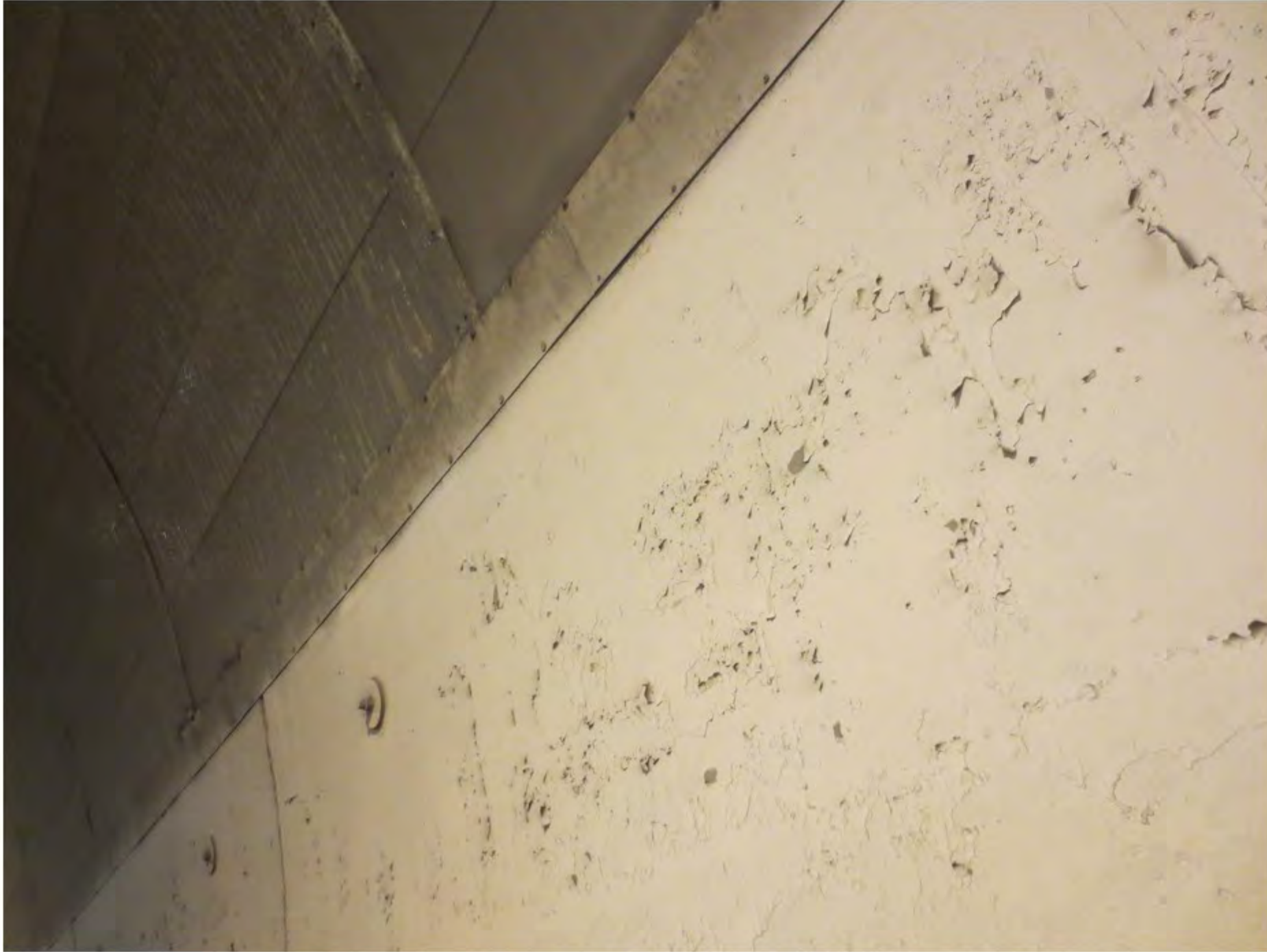
23 Overgang platekassetter veggelement - Malingsavflassing på veggelement
