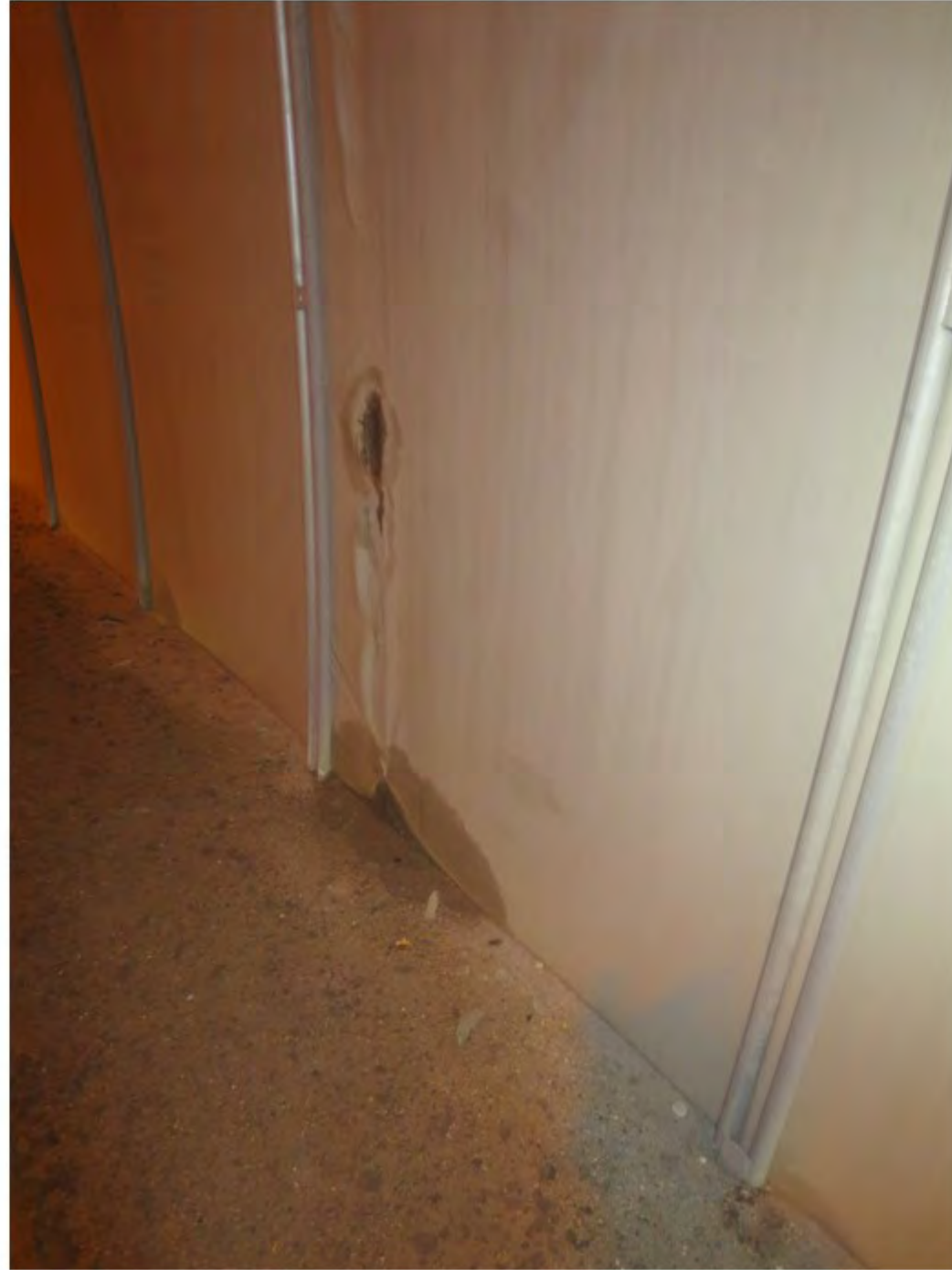
11 Profil 200 - Fukt lekkasje ved nedre boltefeste
