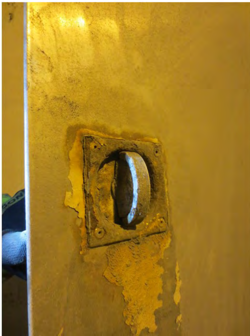
40 Korrosjonsskader på håndtak til luke
