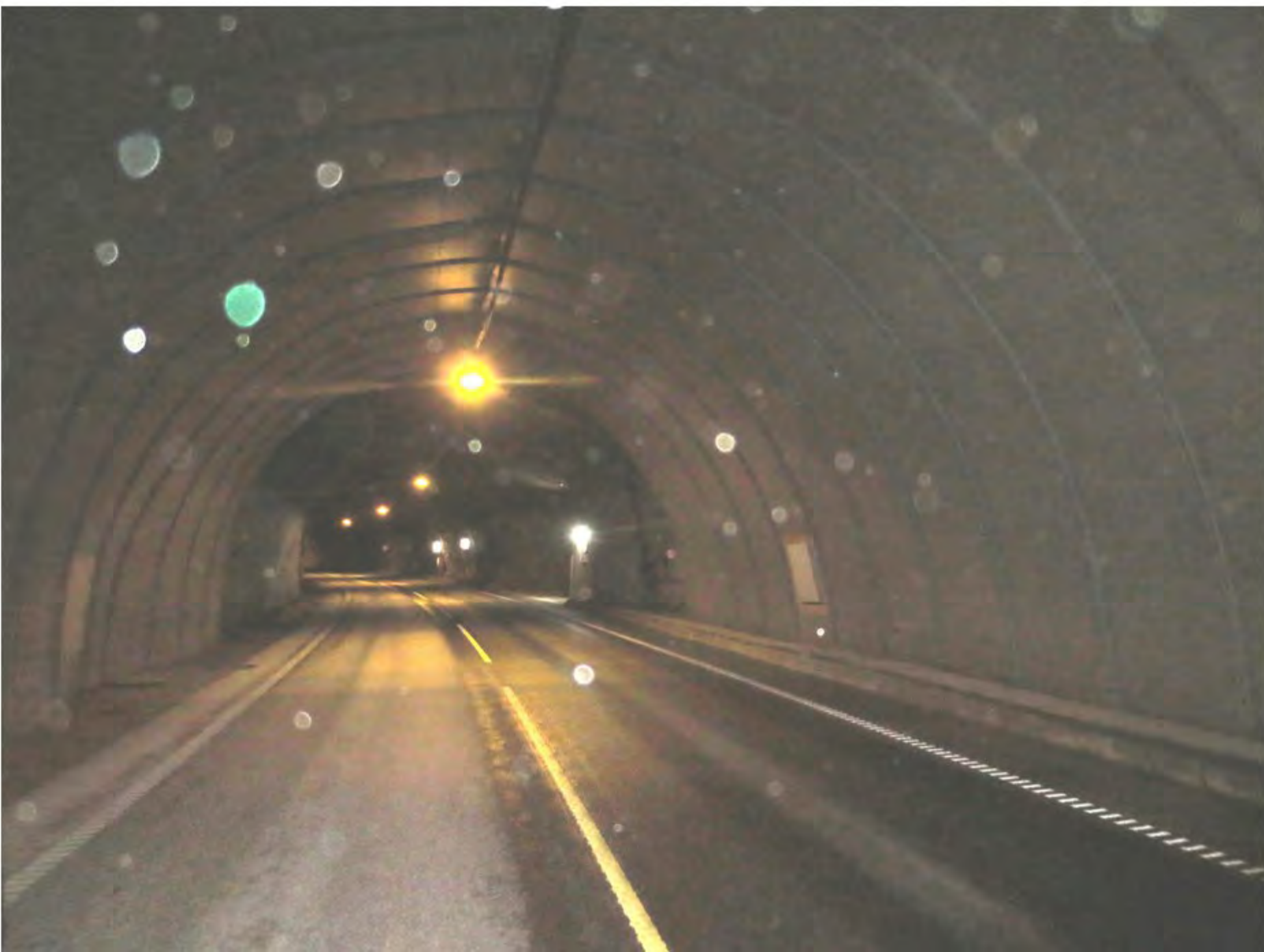
24 Tunnelkledning type 556 i seksjon mot vest
