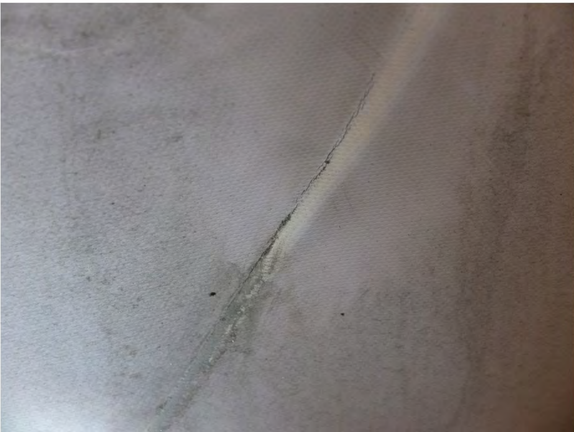
18 Reparasjonsfelt med duk type 556 - Brett i duk med brudd i plastmaterialet
