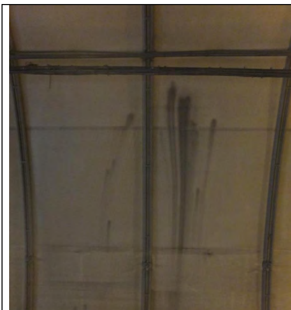
Foto 2.4.7. Punktvis misfarging på duk av type 556
