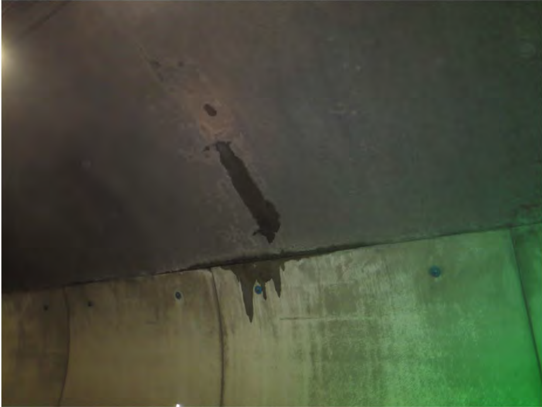
3 Lekkasje punkt i sprøytebetong
