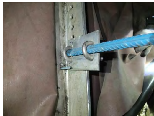
Foto 2.12.15. Detalj festebolt med innfestingsplate og U-klammer
