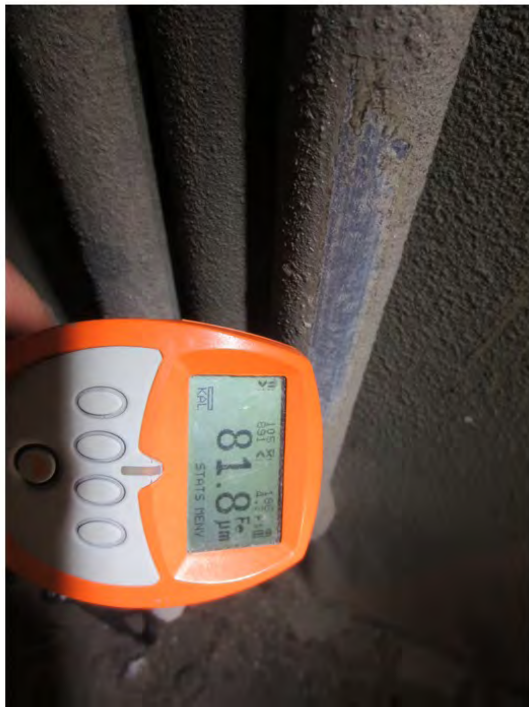
36 Tykkelse av sinkbelegg på trafikksiden
