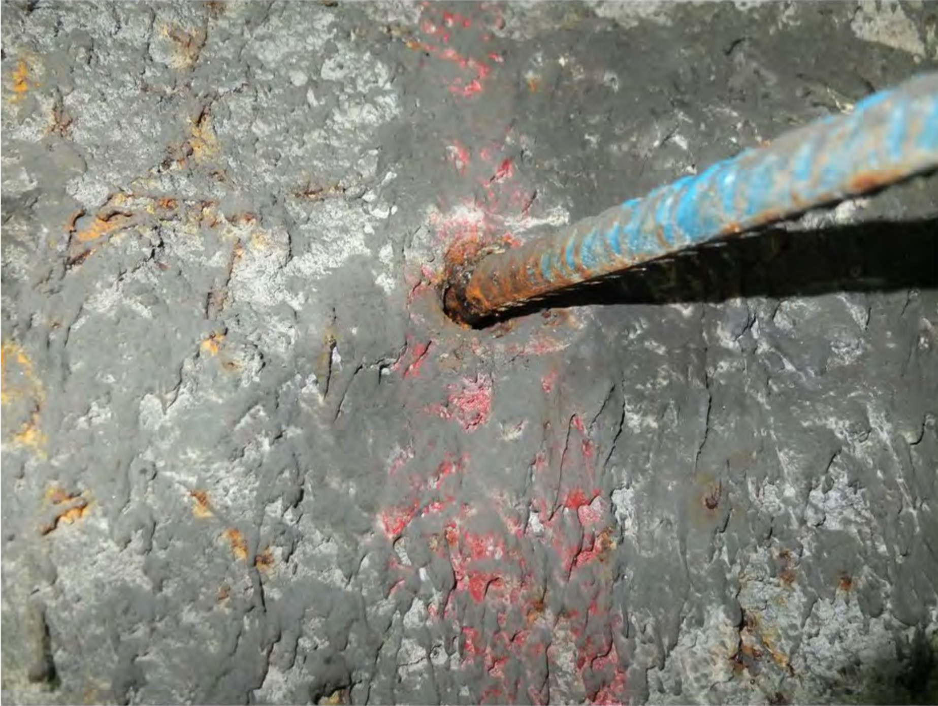
29 Korrosjon ved berginnfesting av bolt
