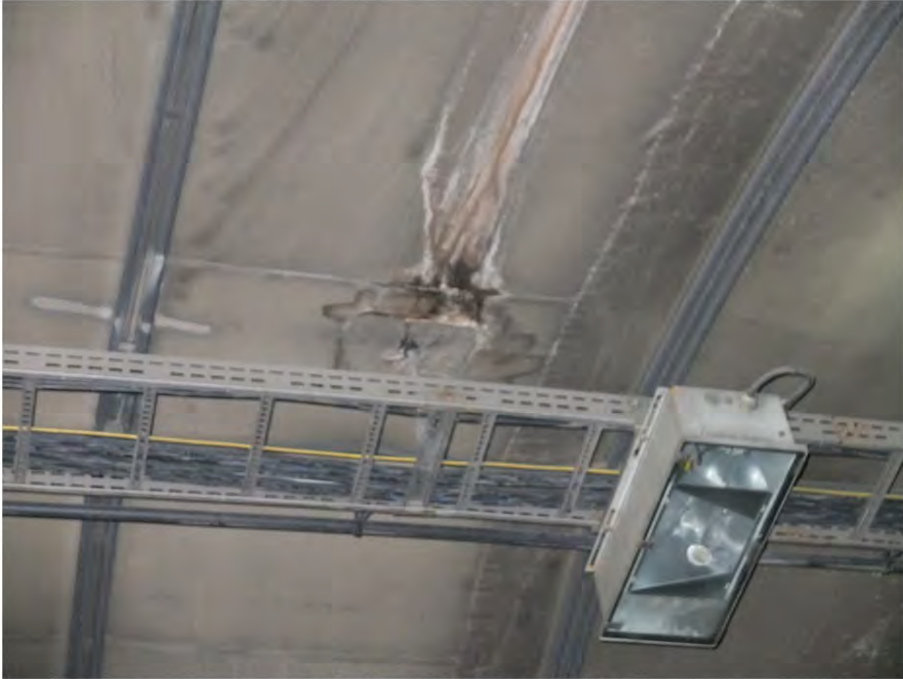
9 Lekkasje ifbm opphengsbolt for kabelbru
