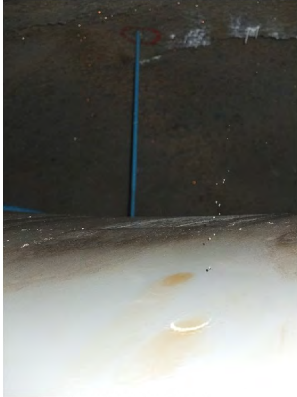
19 Vanndrypp fra berget gir misfarging
