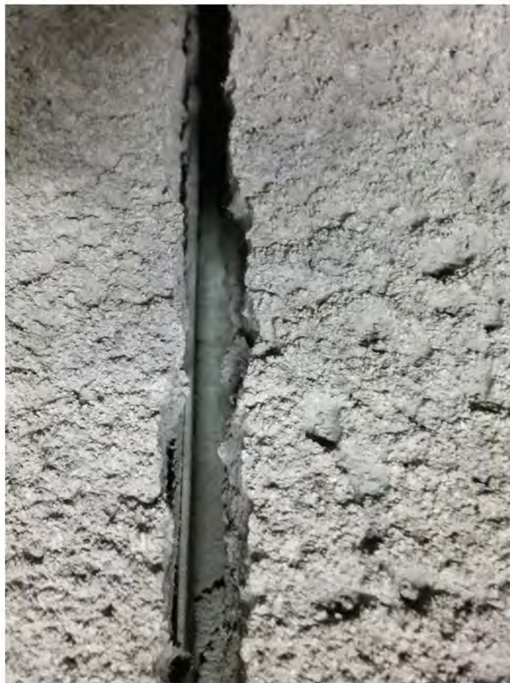
8 Dilatasjonsfuge - Rissanviser synlig
