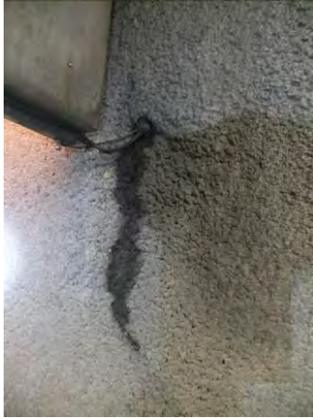
Foto 2.10.3 Lekkasje skiltinnstallasjon venstre side.
