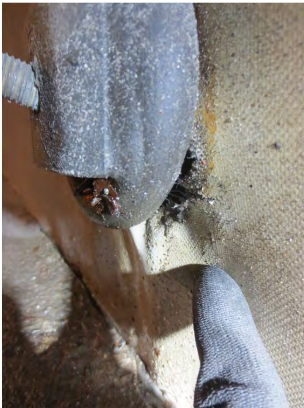
16 Lekkasje pga brudd i duk
