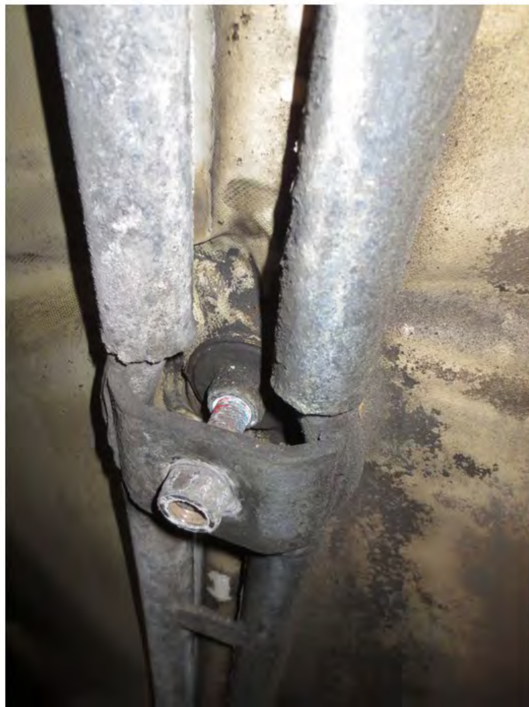
10 Løsnet fremrør - 800 meter fra Bjorøysiden
