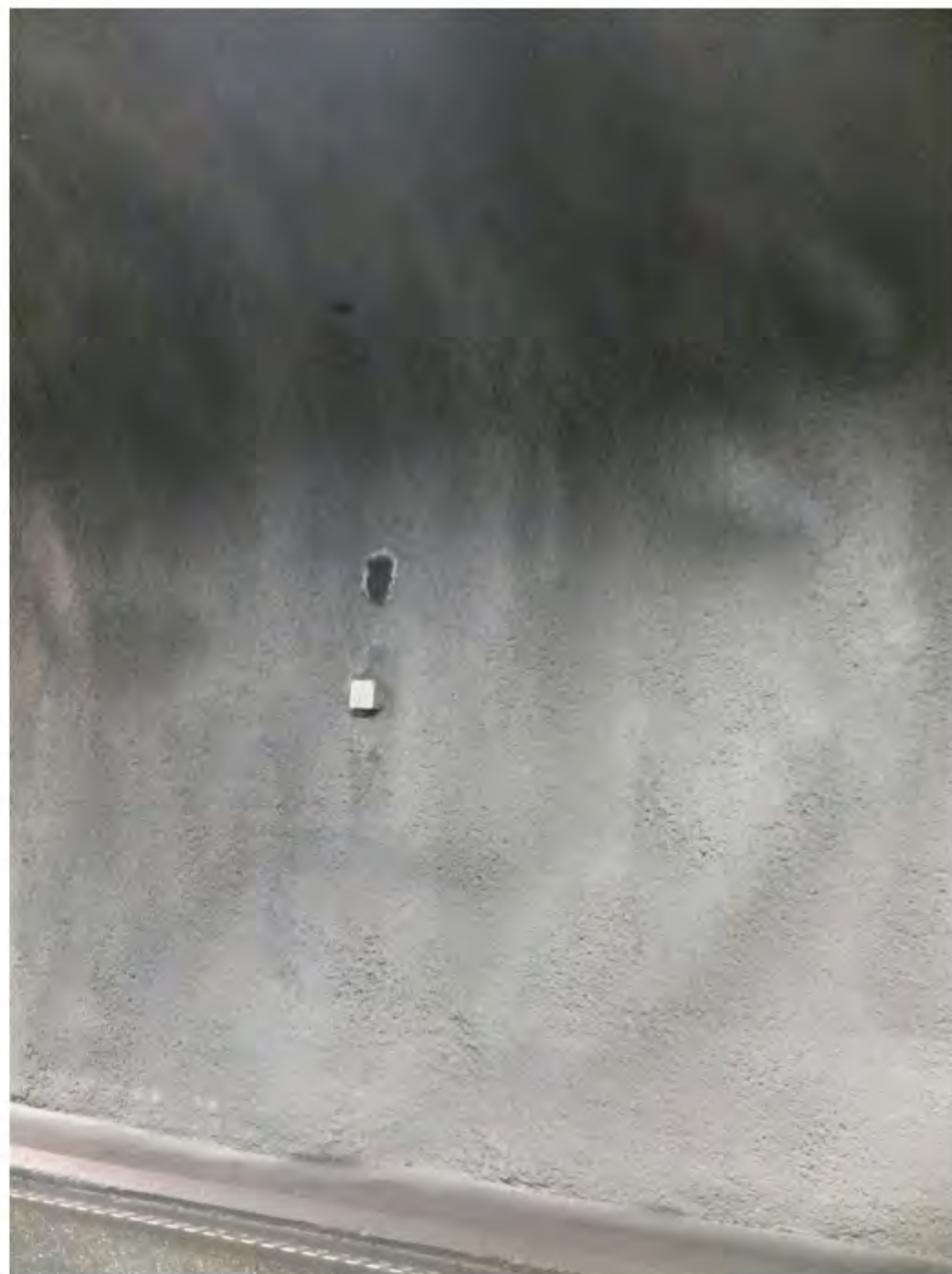
4 Punktlekkasje ifbm rørføring
