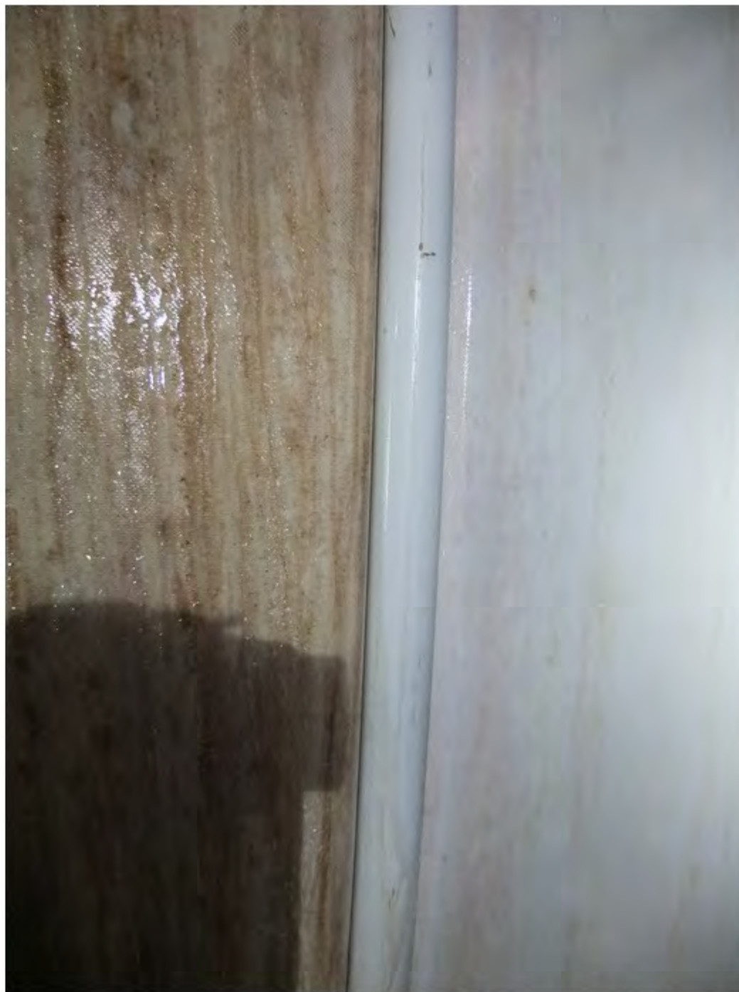
15 Detalj bakrør - God tilstand
