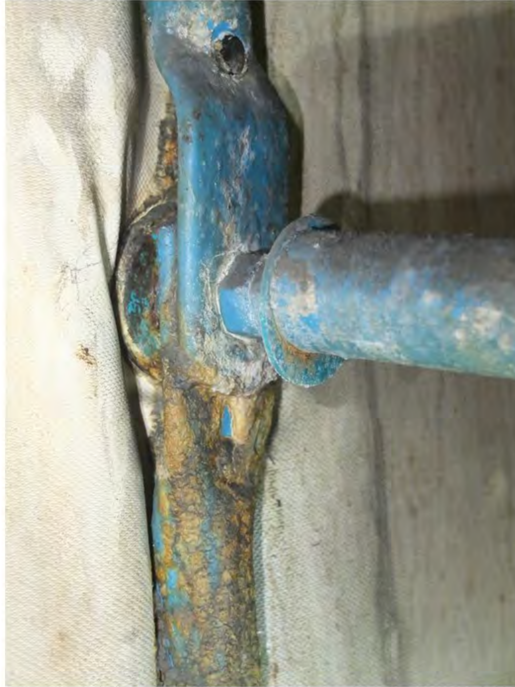
43 Boltegjennomføring i duk - Blæring i combicoat samt saltavleiringer på overflate
