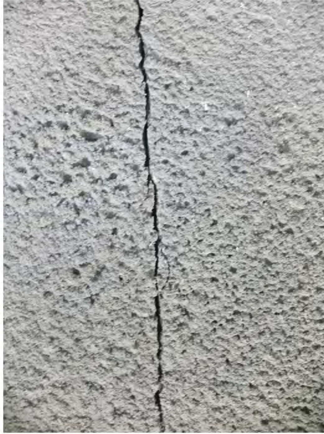
7 Dilatasjonsfuge - Løse biter
