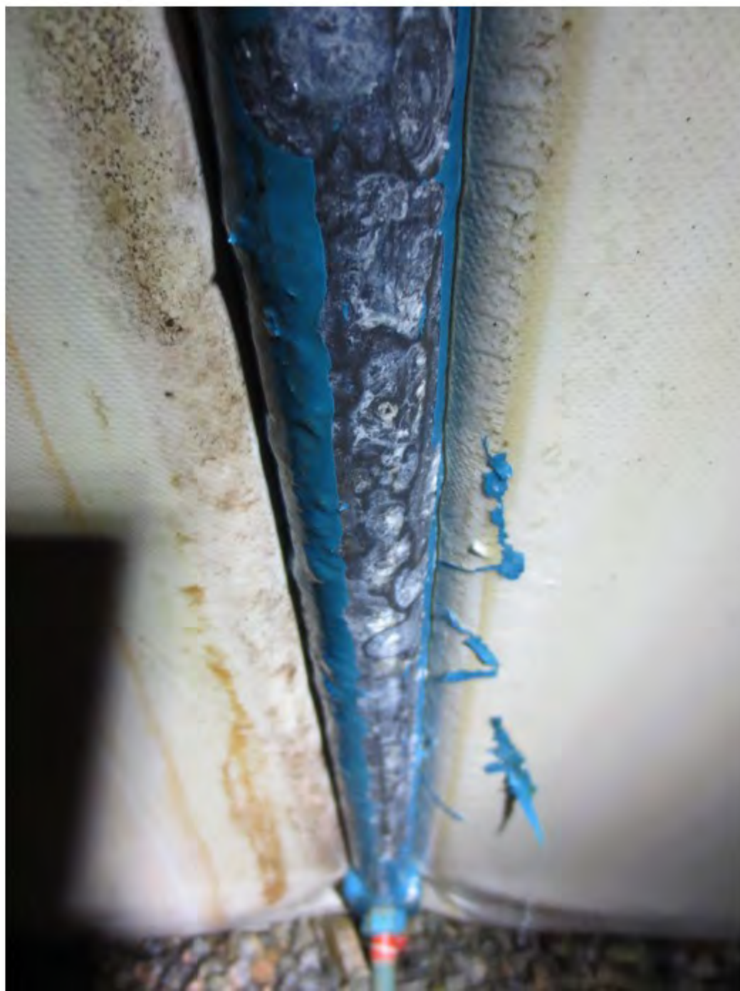
24 Løs lakk fjernet - Tæring i sink - 700 meter inn fra Bjorøysiden
