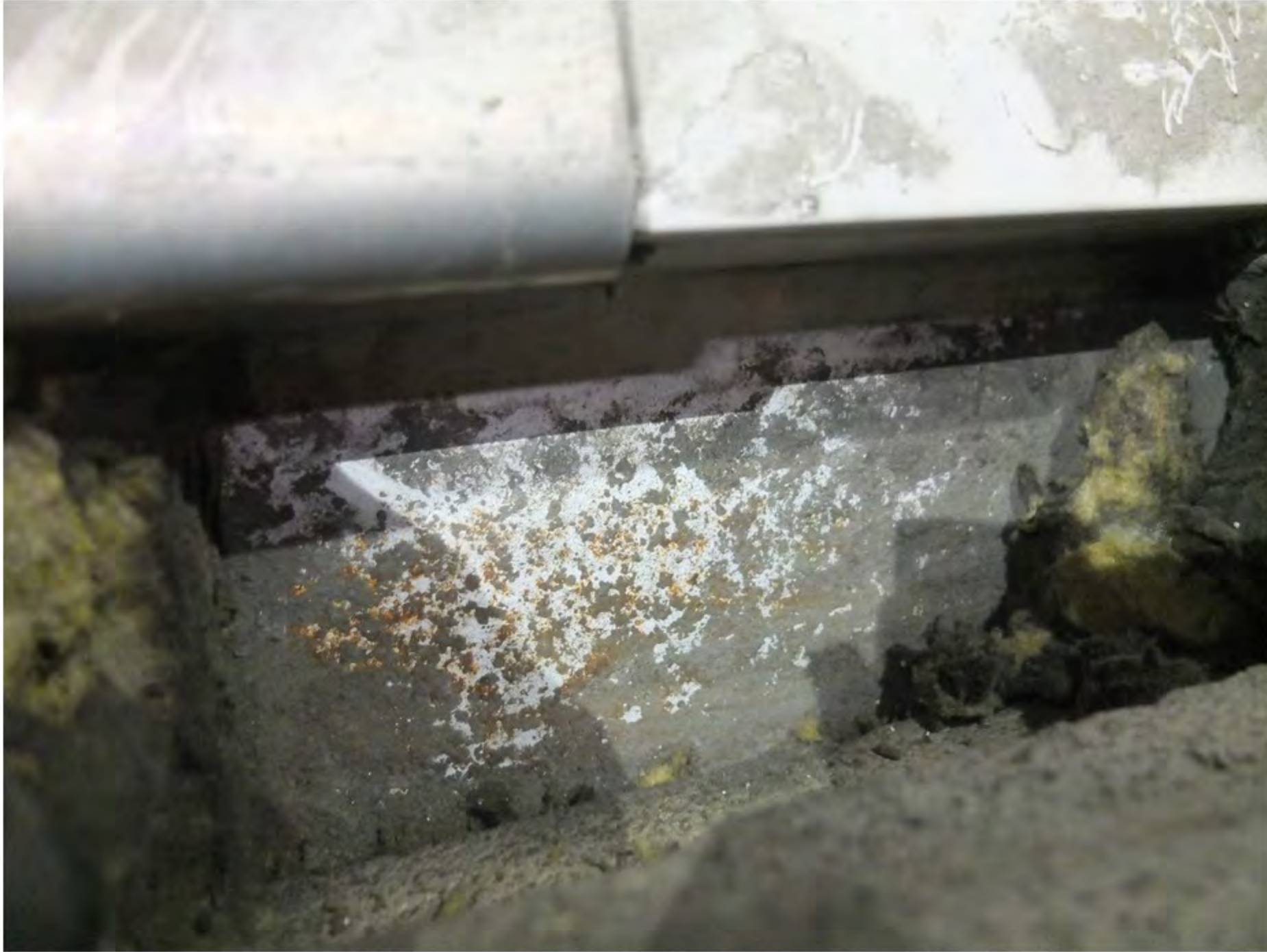
37 Korrosjon på baksiden på dekkbeslag mellom veggelement og UK platekassett
