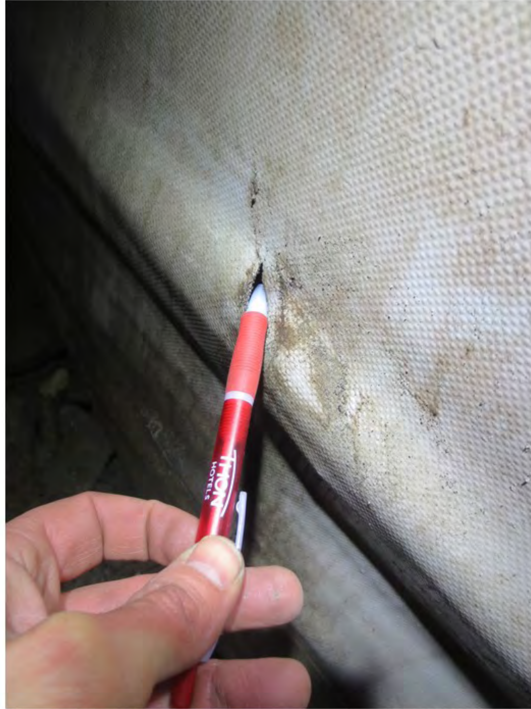
25 Profil 100 - Brudd i duk pga oppfylling for skulder
