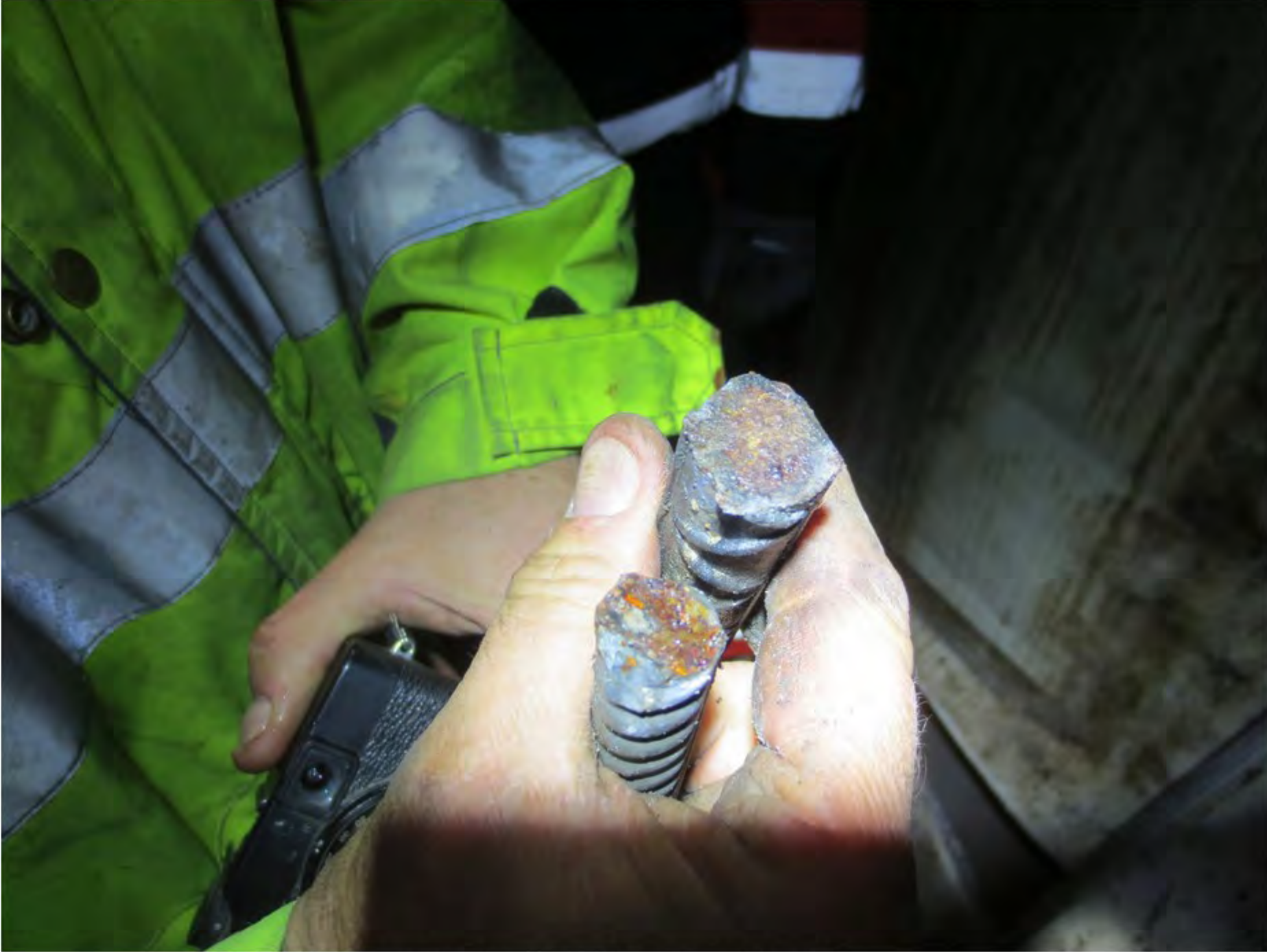
21 Lite korrosjon på kappflater på festebolter
