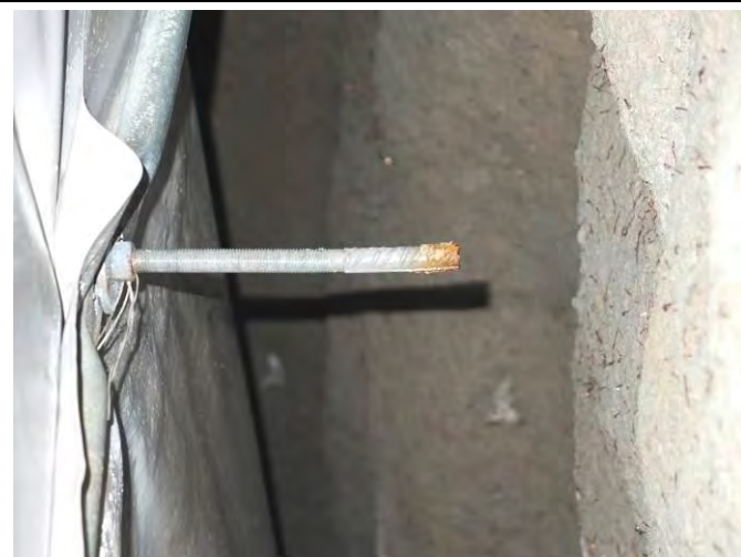
Foto 2.8.23. Tverrsnittsreduksjon pga korrosjon
