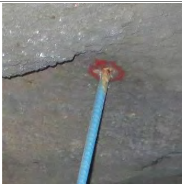
Foto 2.5.17. Lokal korrosjon på bolt ved innfesting i berg.
