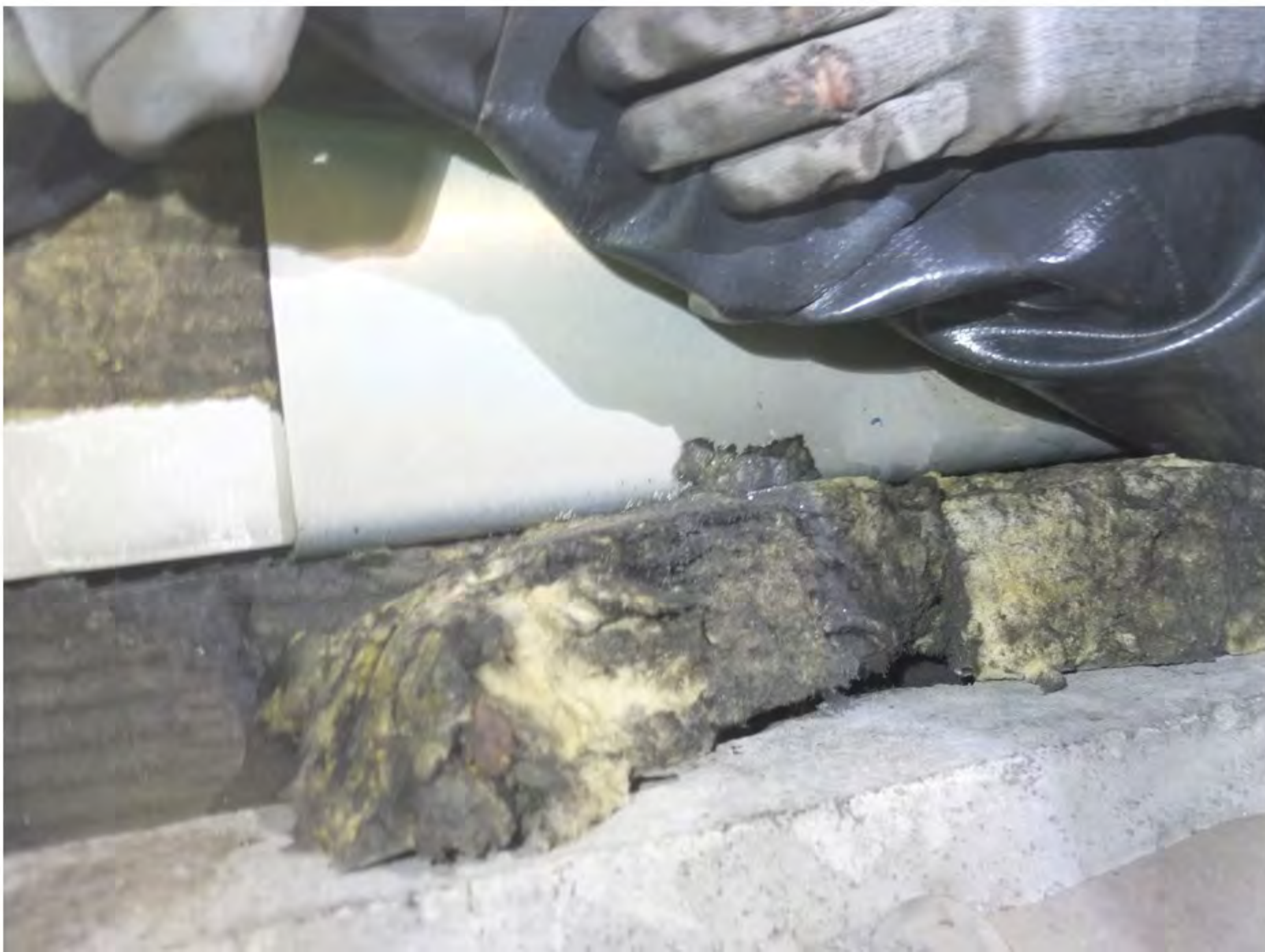
36 Våt isolasjon i overgangen mellom veggelement og UK platekassett
