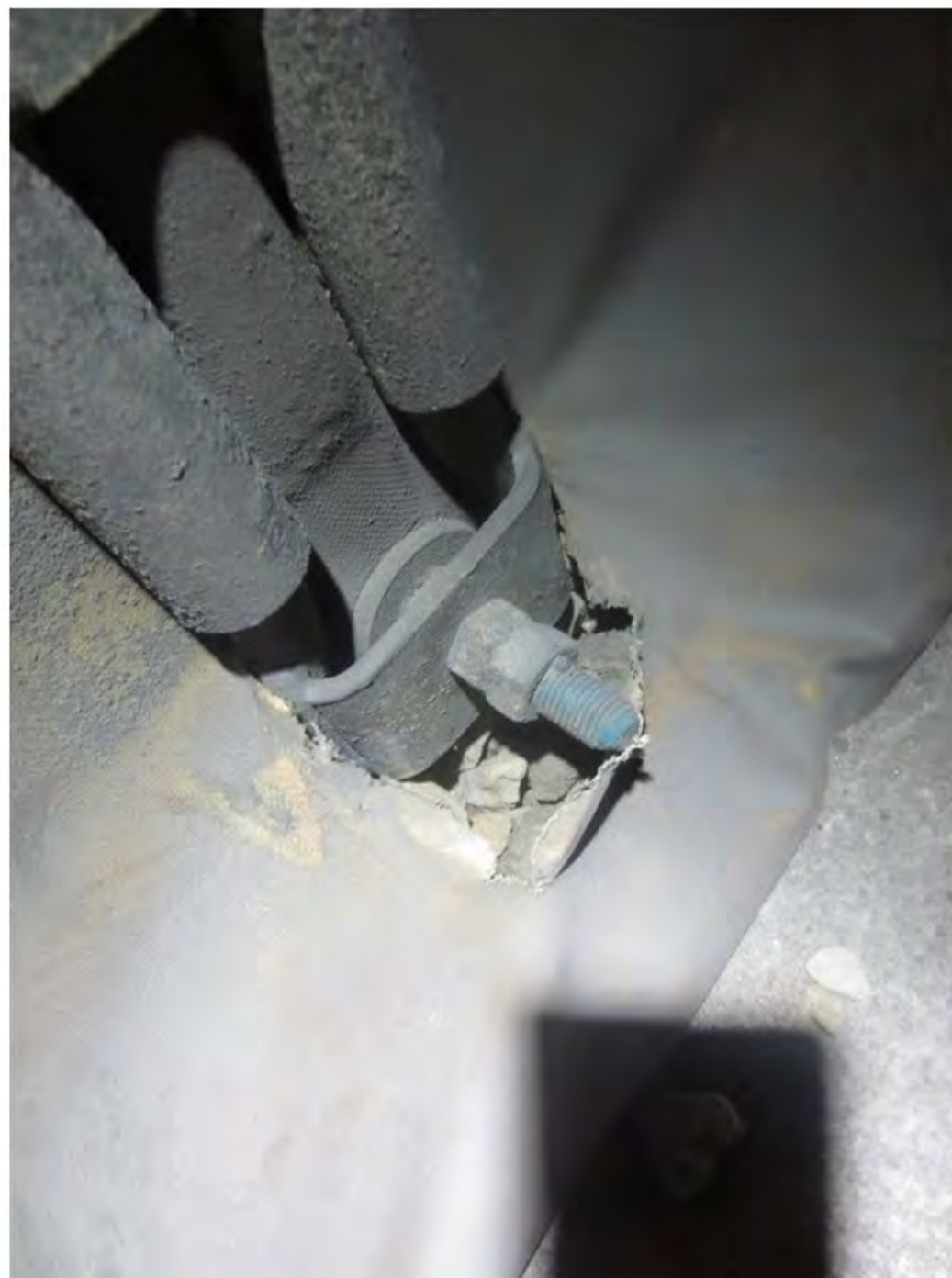
16 Mekanisk skade på duk ifbm nedre bolteinnfesting - Uheldig detaljutforming med stramning av duk
