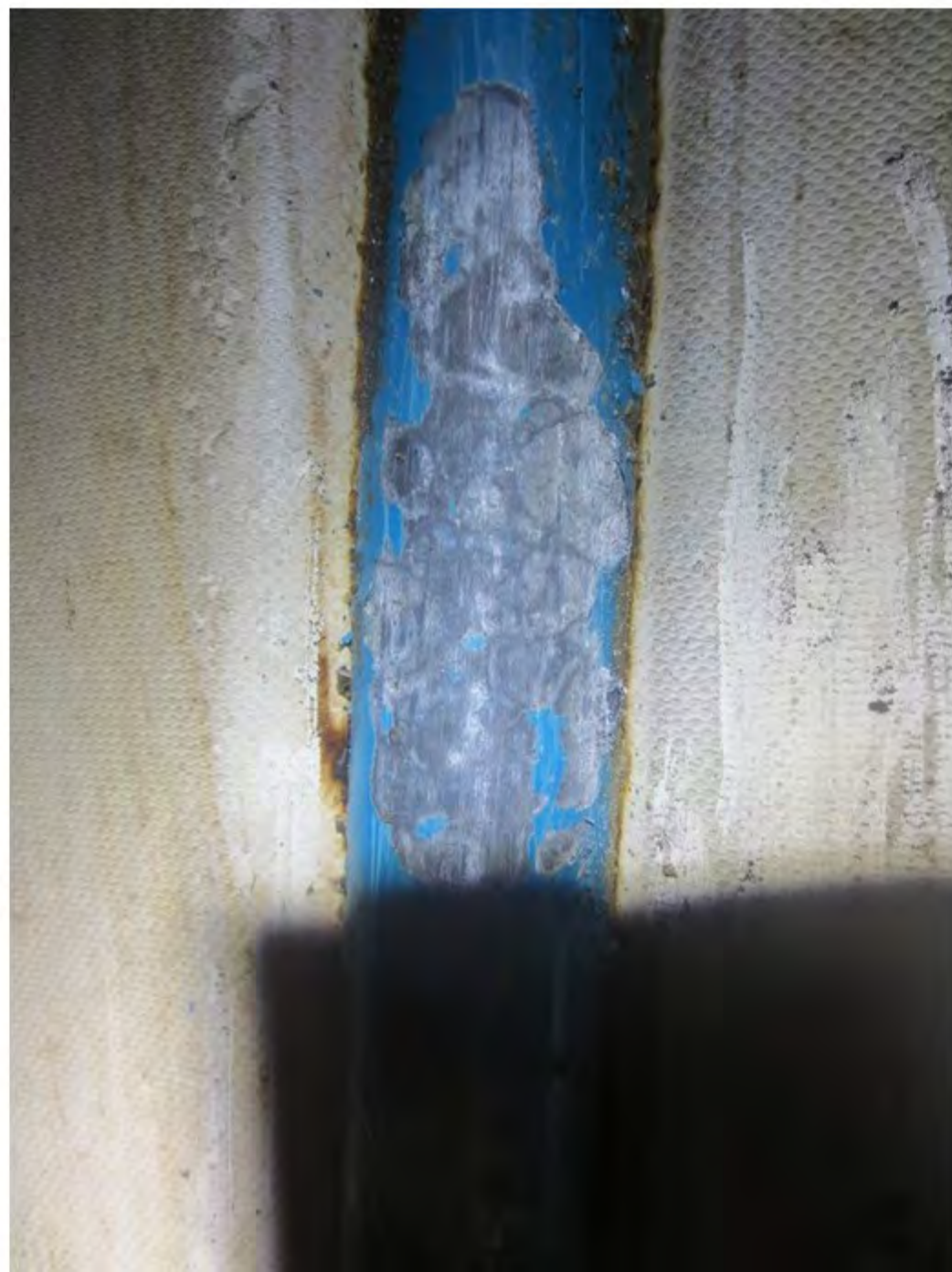
40 Lett tæring av sink avdekt etter fjerning av Combicoat
