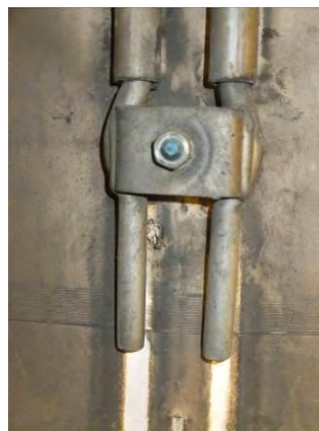
Detalj skjøt rørbånd med H-formet skjøtestykke (løsnet rør). Hull i duk noe over langsgående fabrikkskjøt av duken.
