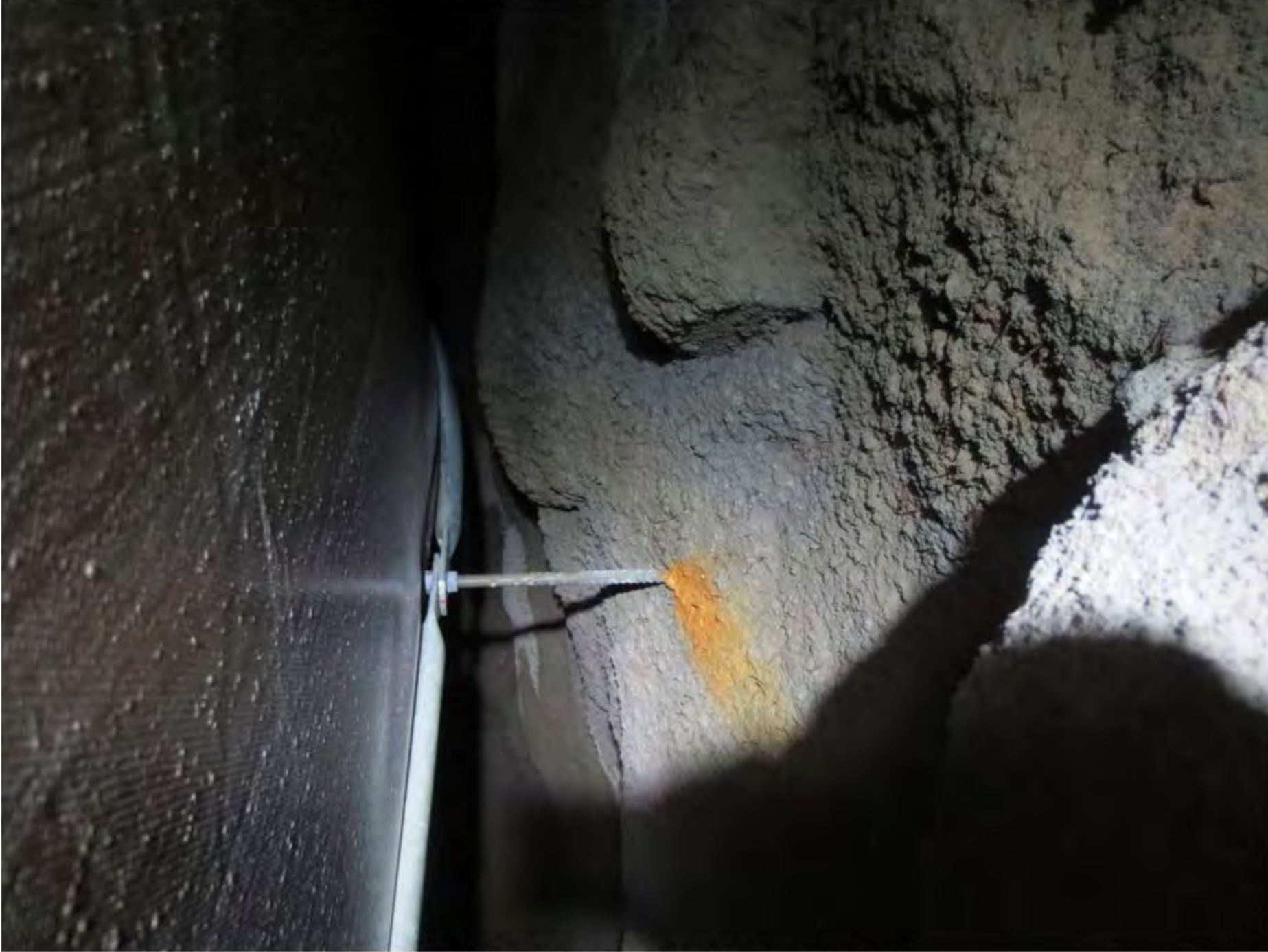
39 Profil 500 - Utfelling av jernoksid fra boltehull
