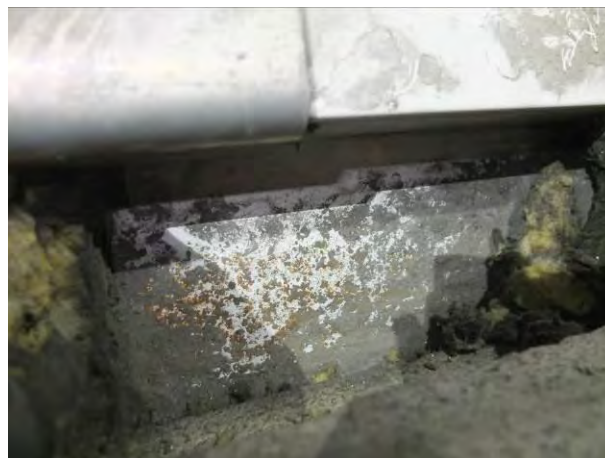
Foto 2.12.21. Korrosjon på dekkbeslag mellom veggelement og uk platekassett
