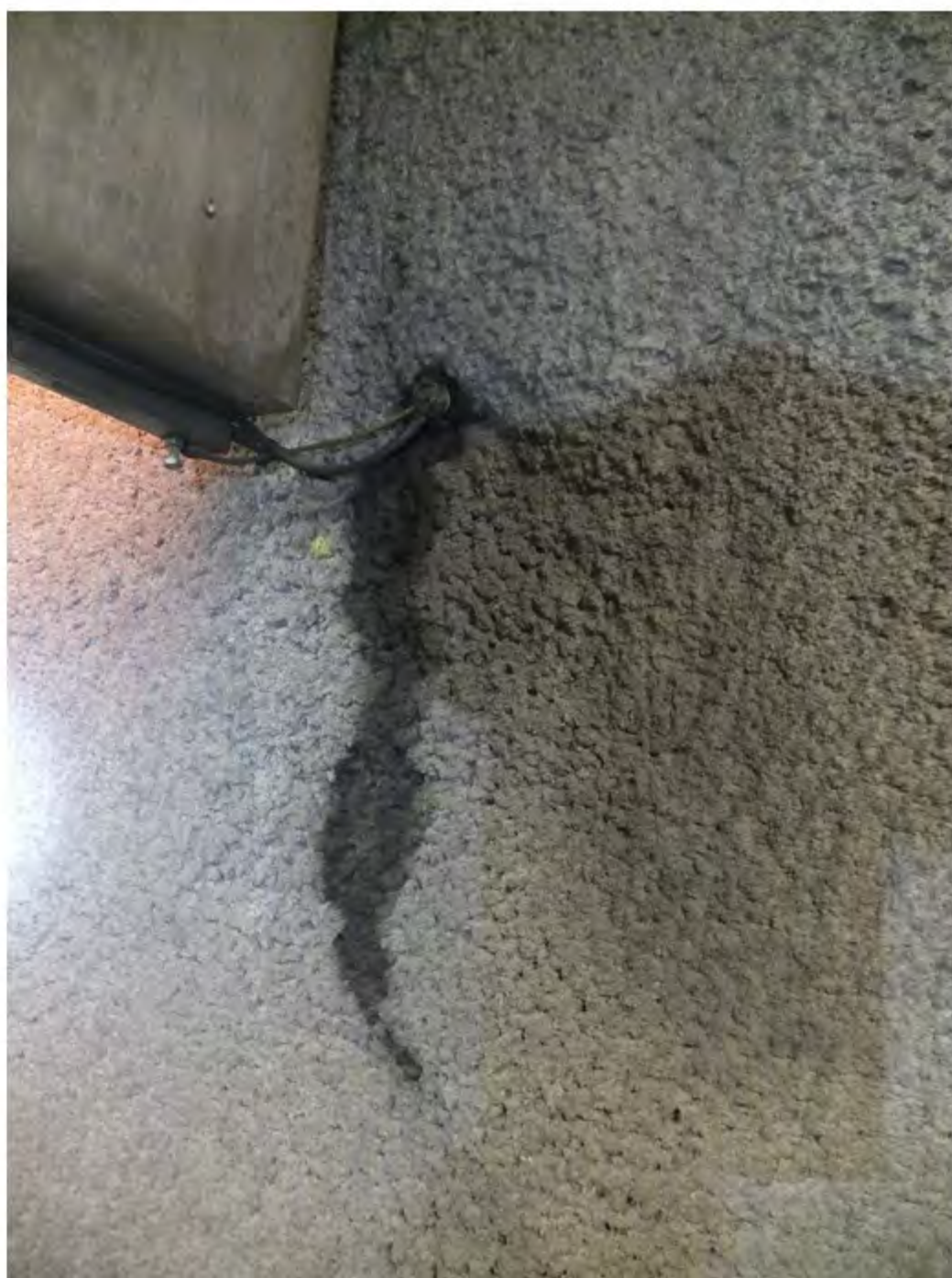
6 Punktlekkasje ifbm trekkerør
