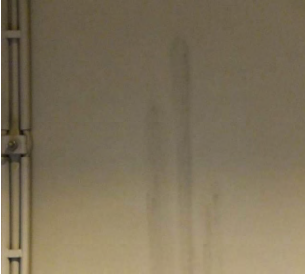
Foto 2.6.9. Drypp på baksiden av duken. Foto fra trafikksiden.
