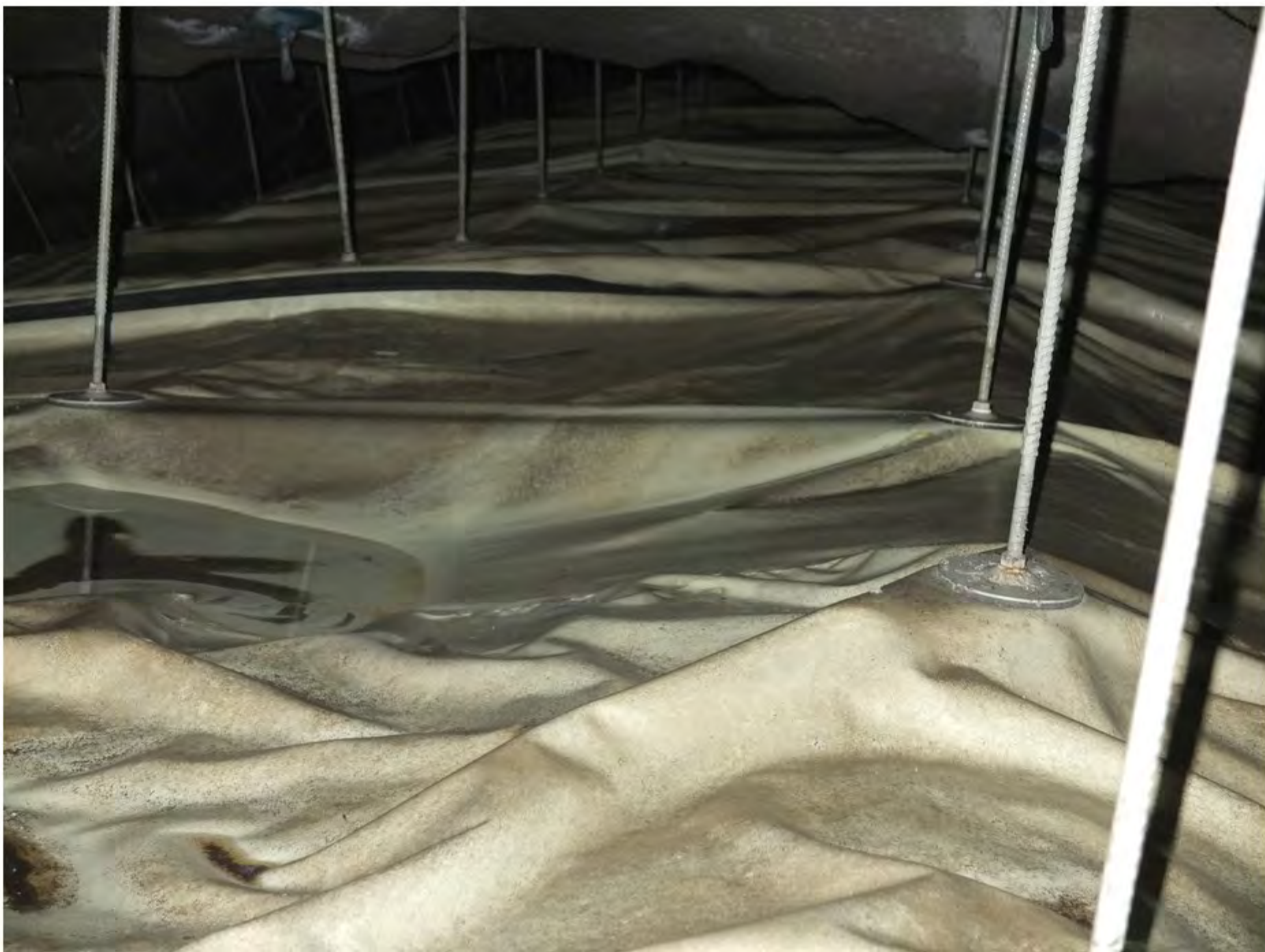
12 Oversiden av takhvelv - Stående vanndam
