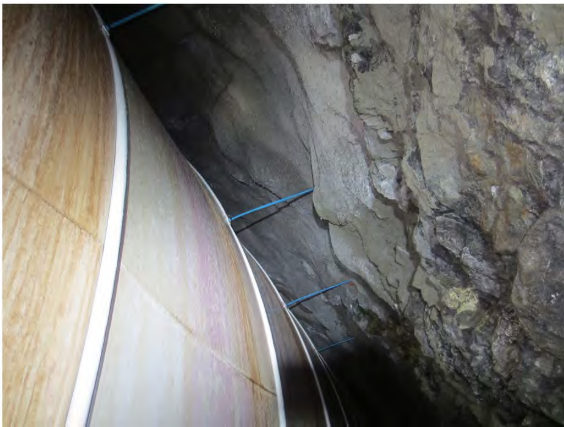
14 Avleiringer på tunnelduk
