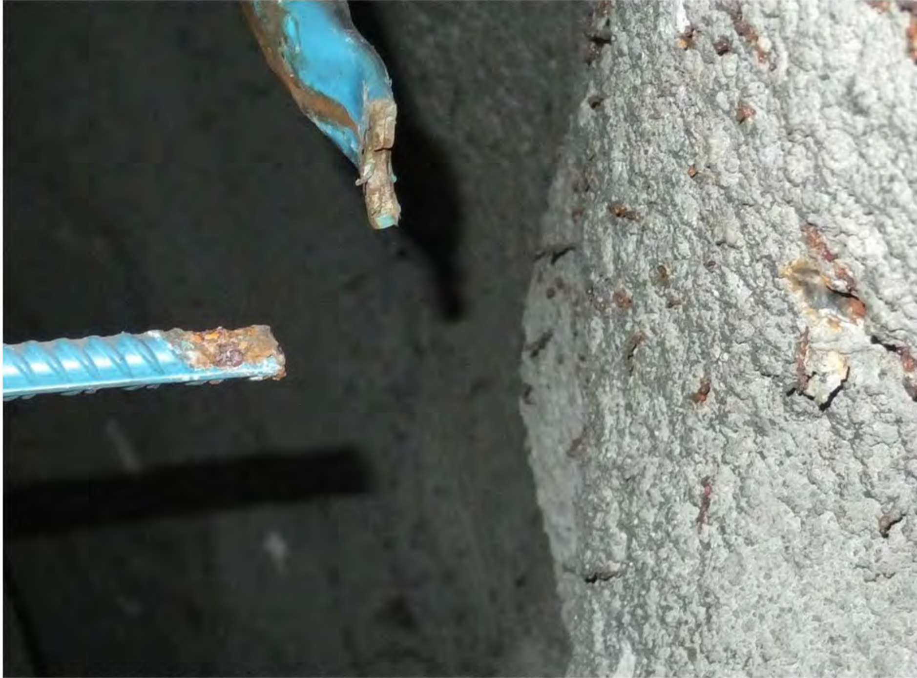
21 Brudd i festebolt og bakskinne - 1,5 km fra portal Frøyasiden - Kraftig korrosjon på bolt ved innfesting i berg
