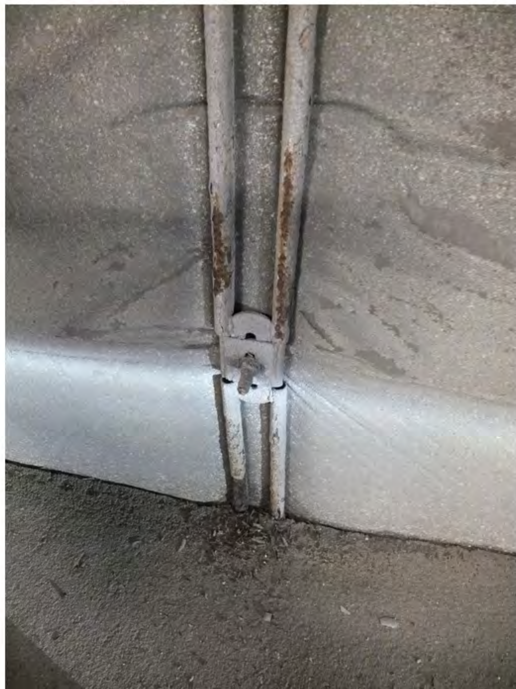
14 Korrosjon på fremrør
