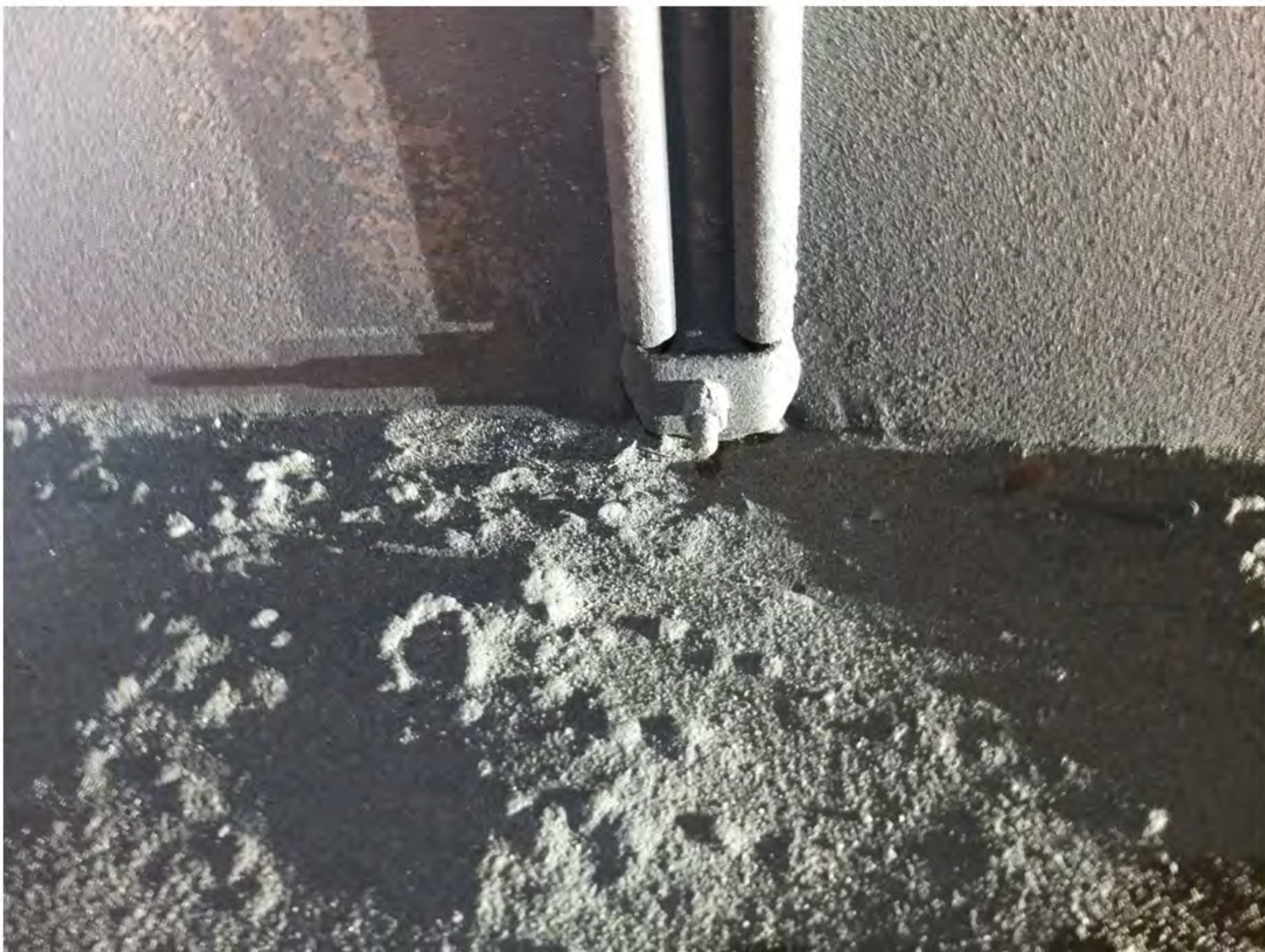
6 Mye tilsmussing på fremrør og tunnelduk
