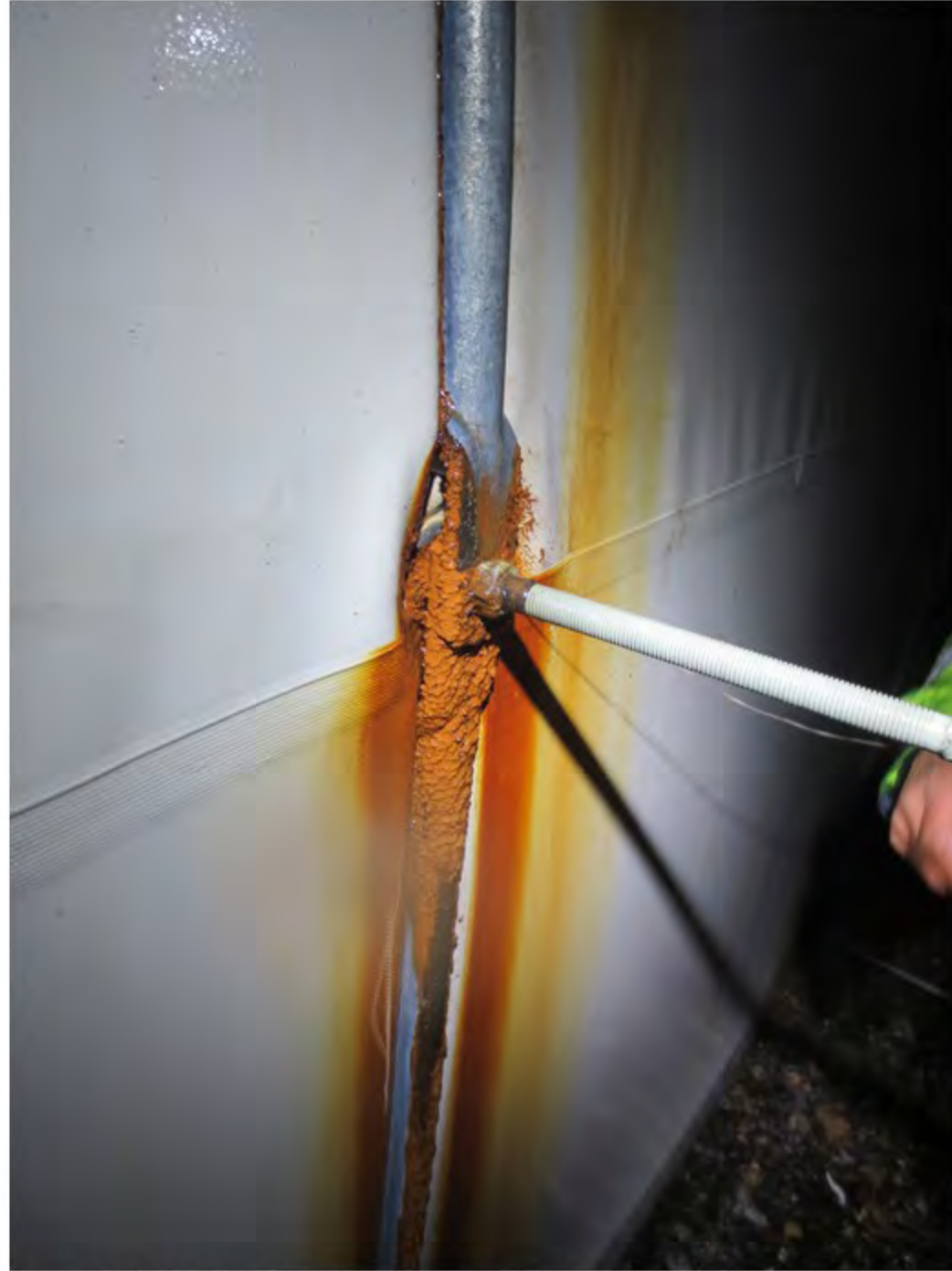
29 Profil 1100 - Avleiringer fra innlekkasjevann på bakrør
