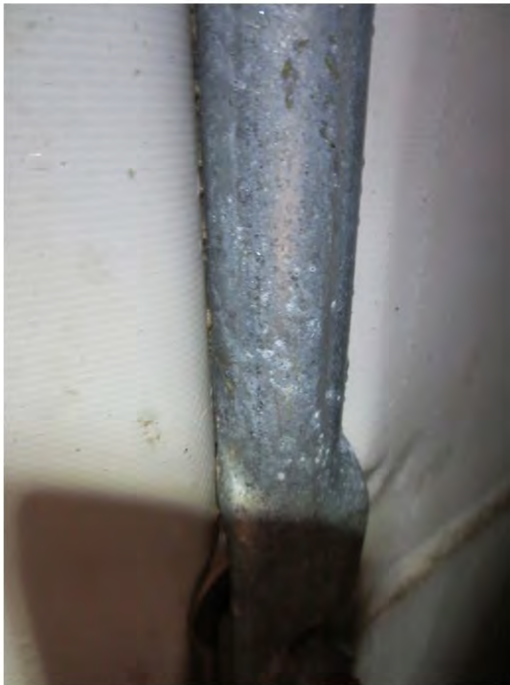
27 Profil 100 - Bakrør med noe utslag av sinkoksyd - hvitrust
