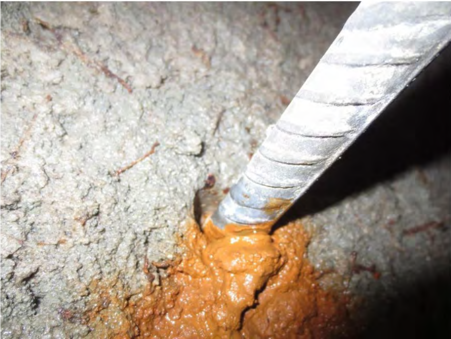
40 Profil 500 - Utfelling av jernoksid fra boltehull
