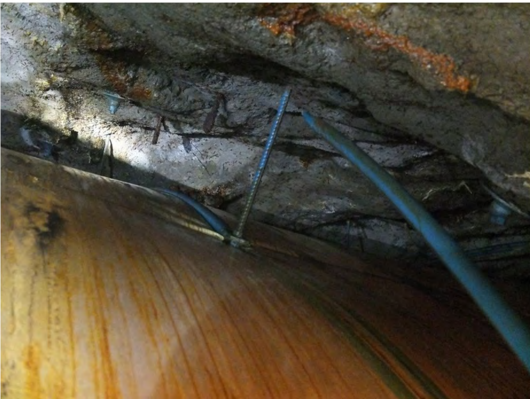
24 Brudd i festebolt og bakrør - 1,7 km fra portal Hitrasiden i bunnpartiet
