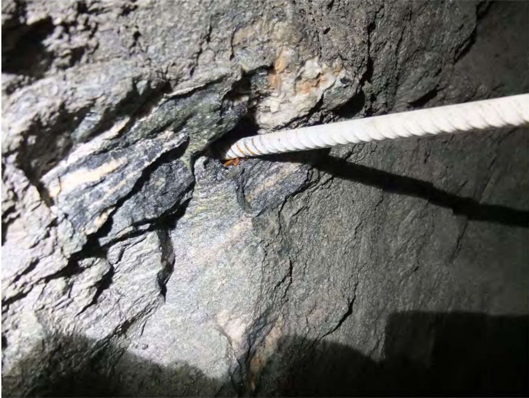
27 Skade sinkbelegg kammer
