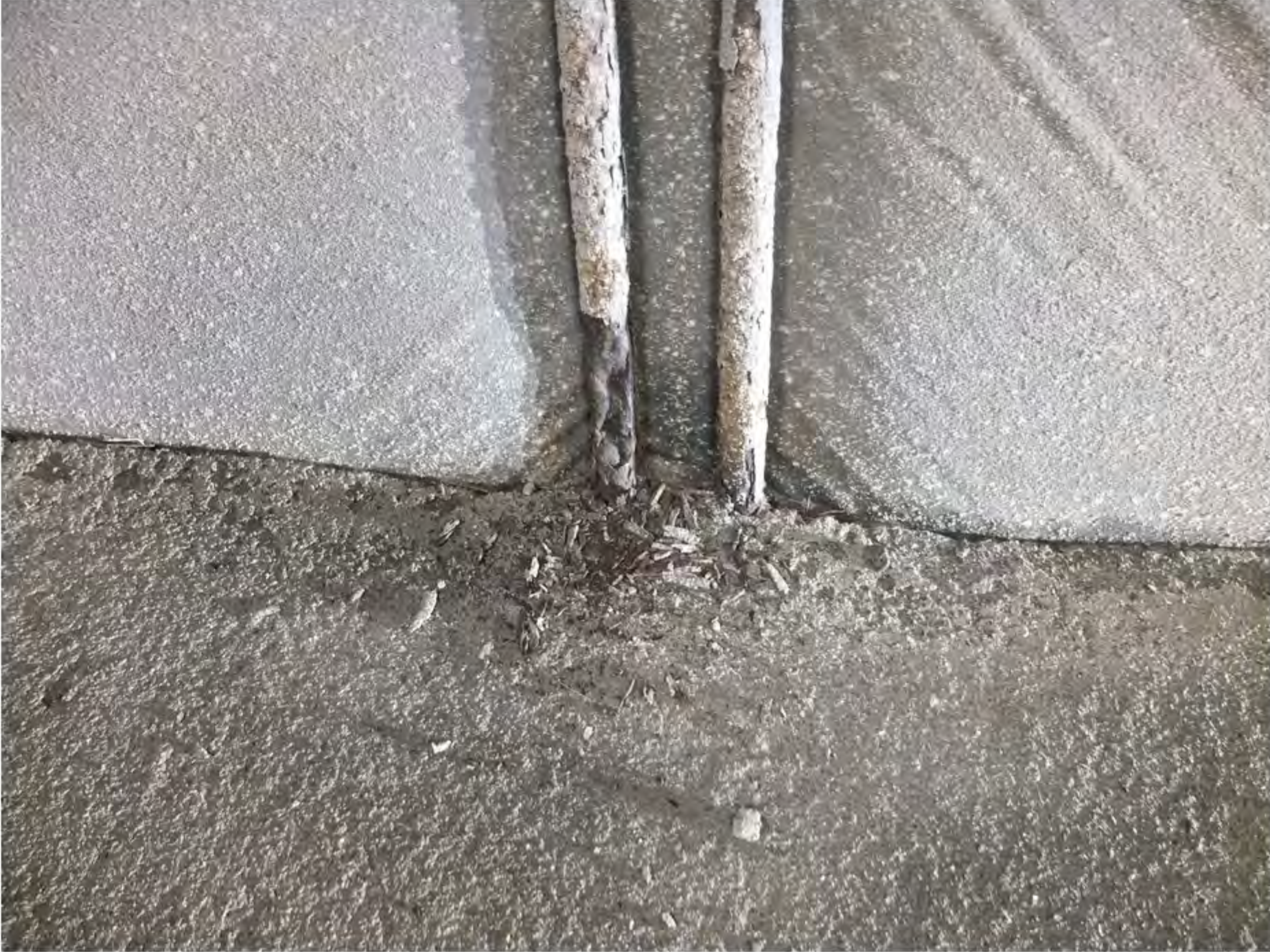
15 Korrosjon på fremrør ned mot bankett
