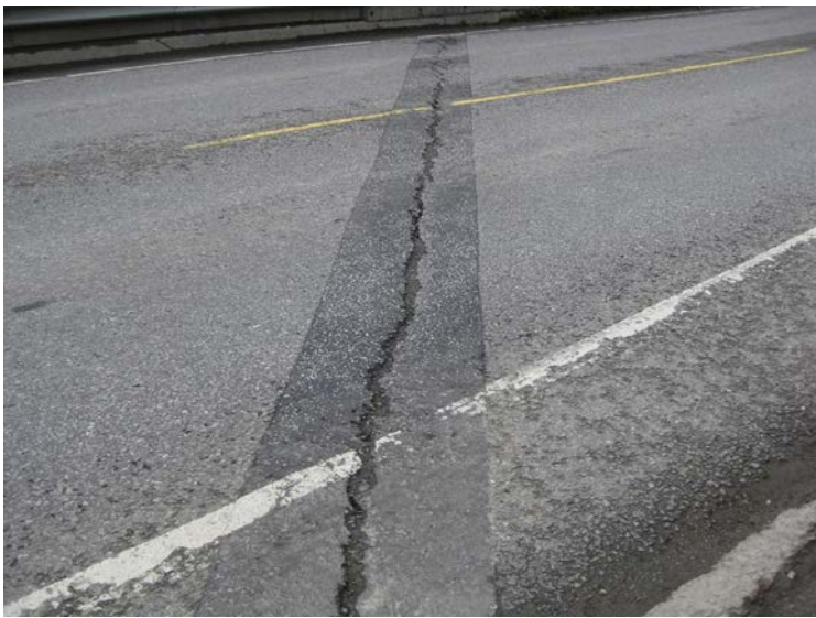
Figur 9 Typisk sprekk i asfaltfuge (foto fra Brutus)
