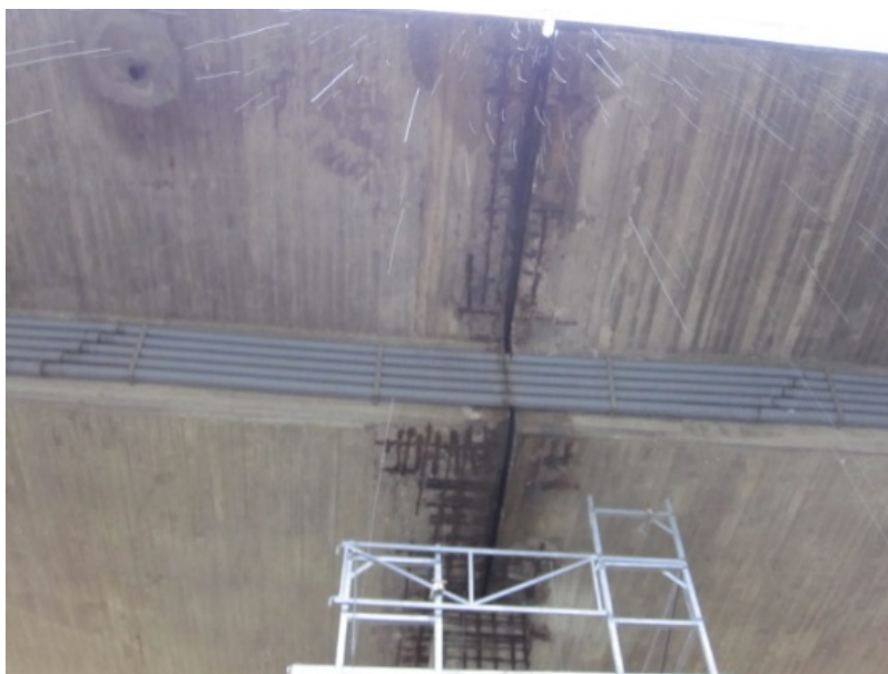
Figur 8 Armeringskorrosjon som følge av kloridholdig vann fra lekkasje i fuge (foto: Gaute Nordbotten)
