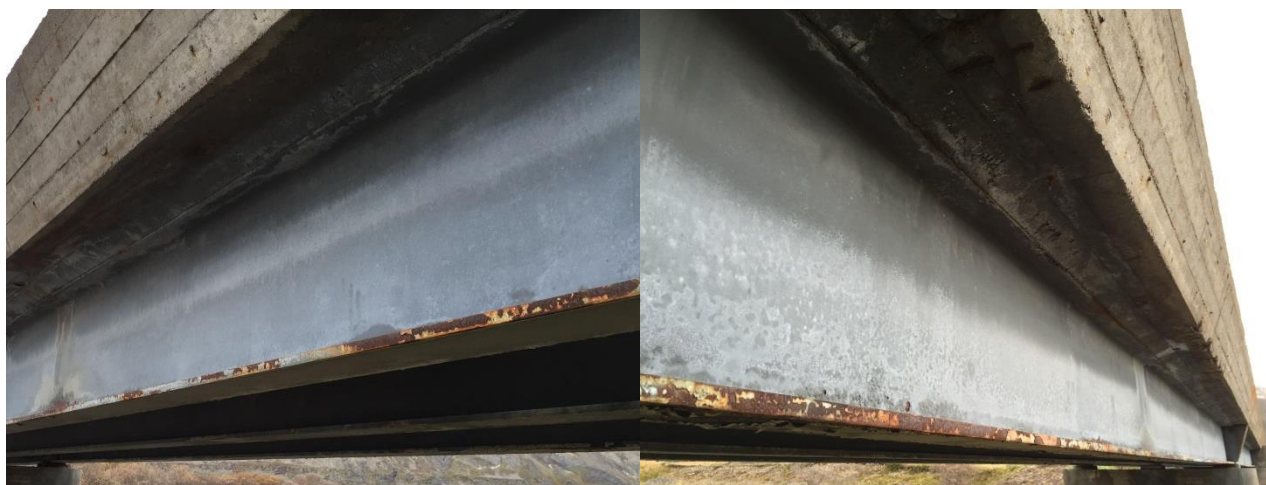
Figur 9. Nedbrytning av belegget på bjelkene. Til venstre vises den bjelken som står nærmest sjøen, den siden som vender mot sjøen. Til høyre vises den andre siden av brua, med bjelke som vender bort fra sjøen.
