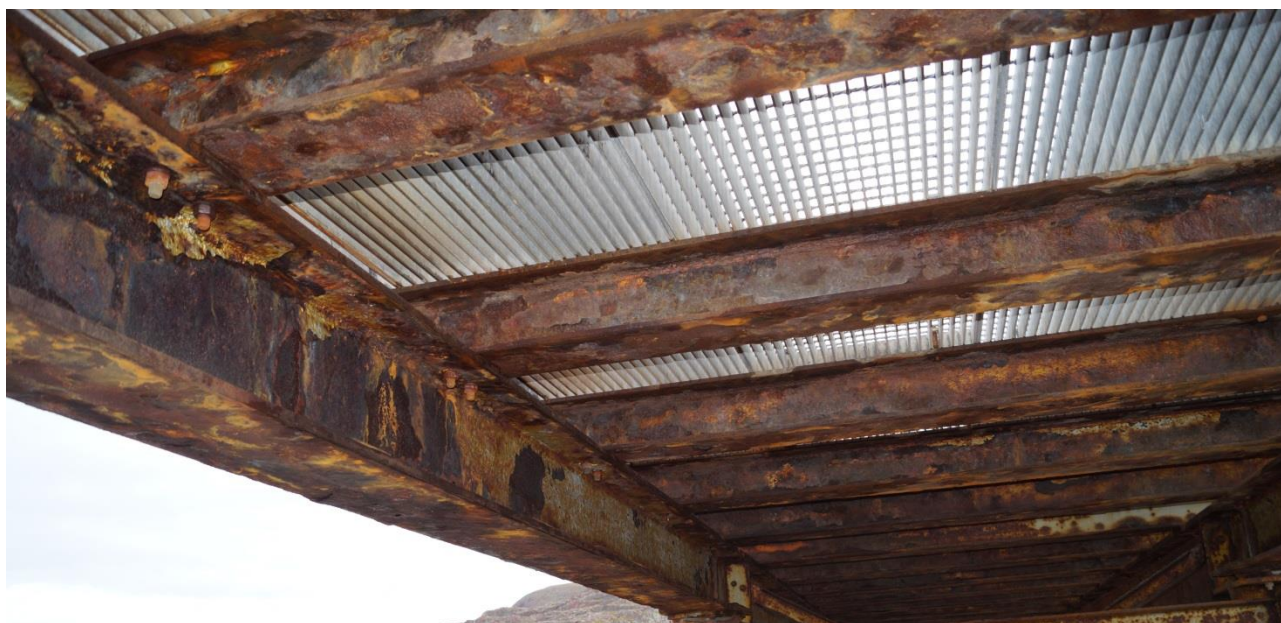
Figur 22. Beleggtilstand på Østerelv bru i 2015
