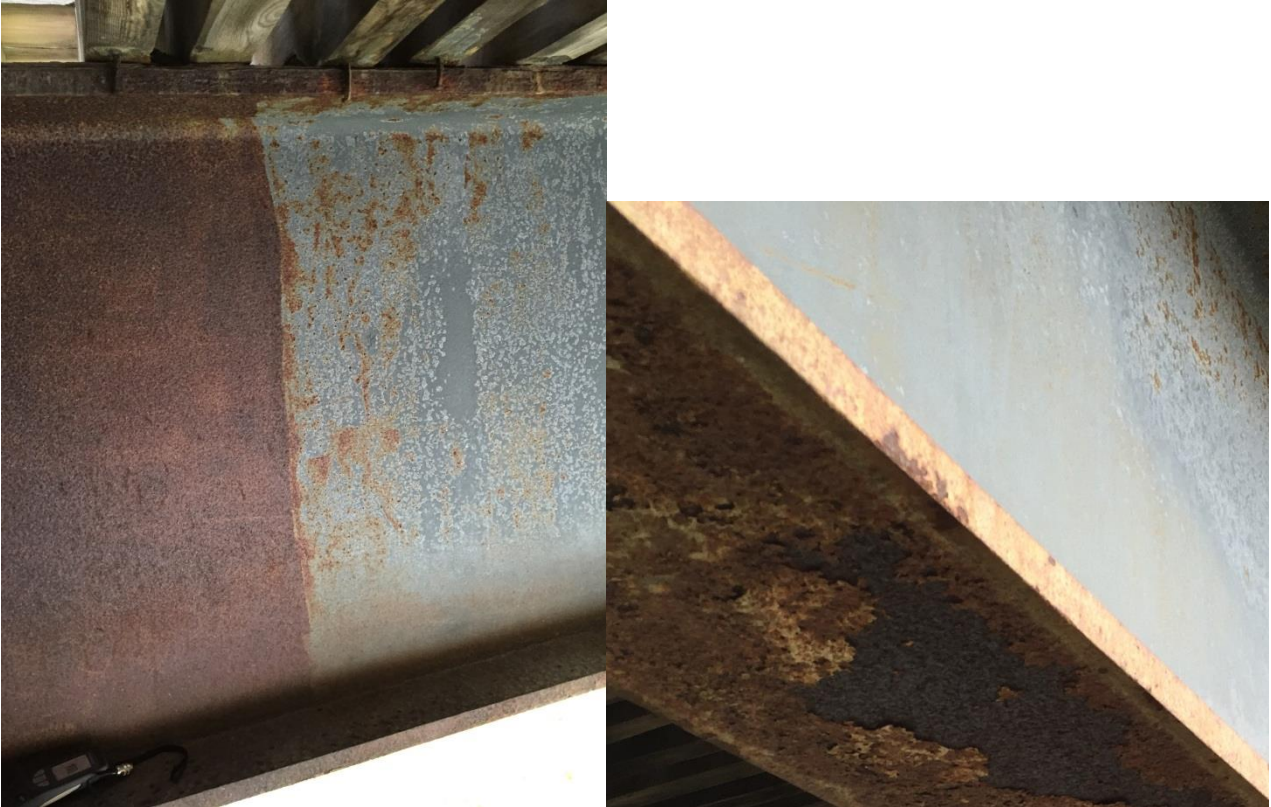
Figur 3. Effekt av filmtykkelse og kant. I det korroderte området i bildet til venstre var filmtykkelsen ca. 90 \mu\text{m} , mens i område uten korrosjon var filmtykkelsen 140 \mu\text{m} (kalibrert på glatt stål). Bildet til høyre viser mindre nedbrytning langs en kant, som indikerer at stripecoating har blitt utført.
