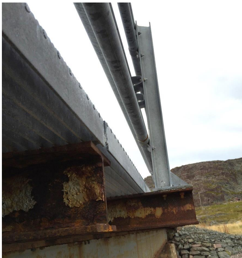
Figur 24. Tilstanden til varmforsinking på Østerelv bru. Rekkverk og brudekke er varmforsinket, mens bjelkene under har to strøk høysink primer og to strøk alkyd/KK.
