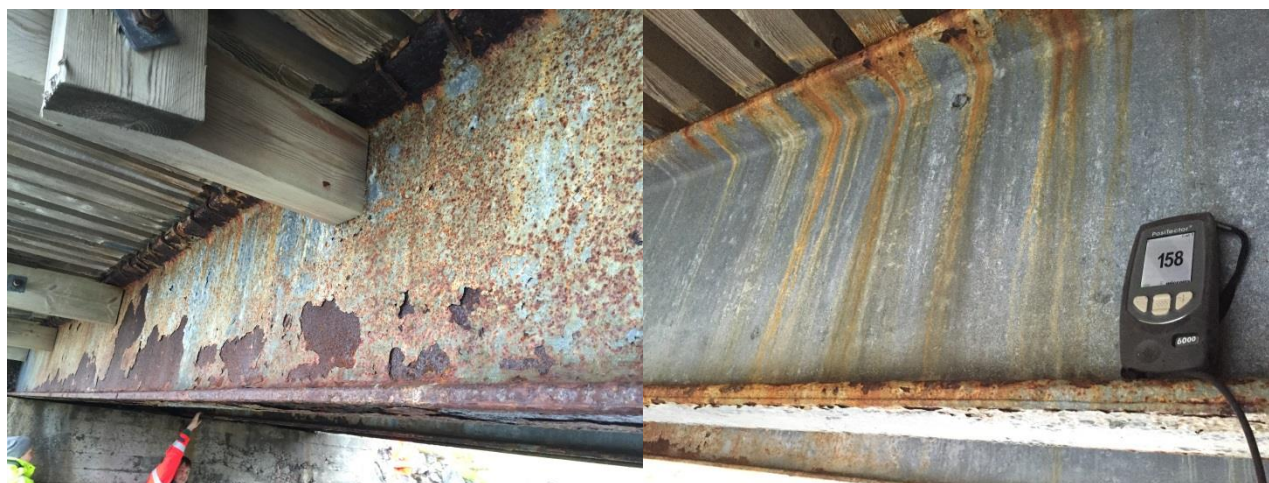
Figur 7. Nedbrytning av belegget på bjelkene. Til venstre vises den bjelken som står nærmest sjøen, den siden som er vendt mot sjøen. Til høyre vises midterste bjelke vendt fra sjøen.
