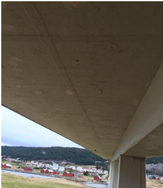
Figur 78 Fra Leine-siden. Ingen synlige skader. Det er utført blokkeringer av jernbindertråd i kontakt med anoden.
