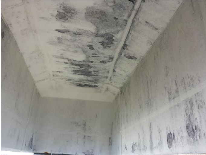
Figur 92 Generell slitasje og avflassing av maling ved lokalitet 1. Lokalt også avflasset anode
