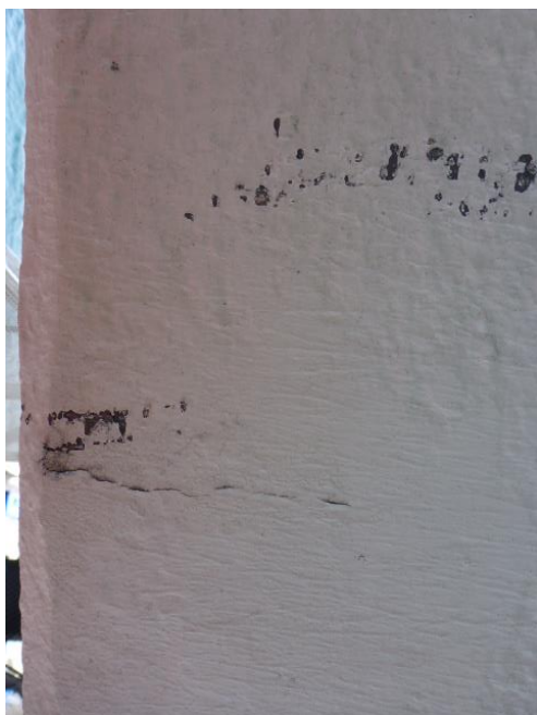
Figur 89 Riss i maling og anode + løs maling, underkant drager, lokalitet 3
