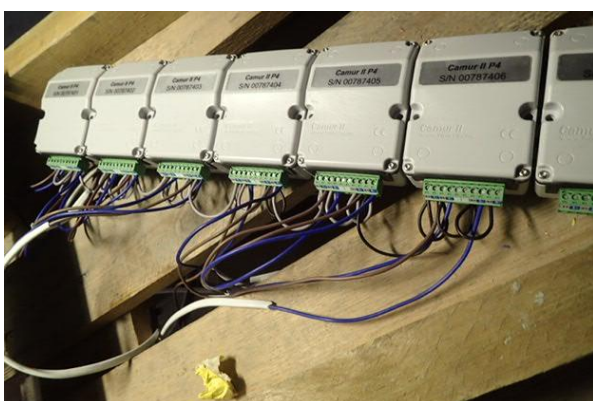
Figur 26 Ledninger fra referanseelektrodenes splittet og montert i nodebokser i styreskapet.
