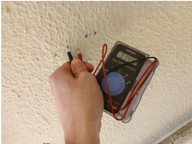
Figur 81 Måling av pin-motstand på brudrager ved styreskap akse 9. Enkeltmåling i figuren har verdi 314,4 \Omega
