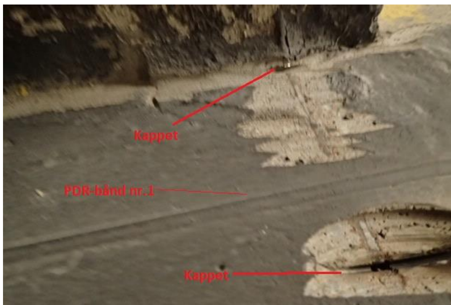
Figur 67 Lokalisert og fjernet stålgenstand fra søyle ved "J/K 1", gjennom anoden og ned til overkantarmoring.
