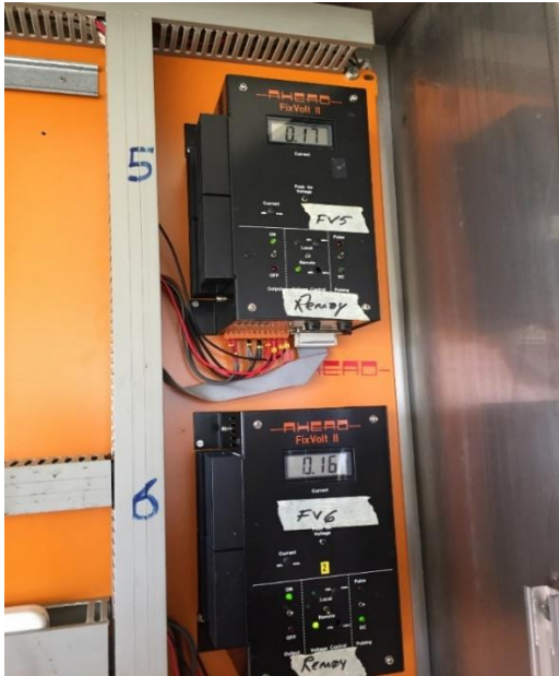
Figur 75 Styreskap på Leine-siden (mot Fosnavåg). Strømforsyning til sone 5 og 6 der det går henholdsvis 170 og 160 mA likestrøm.
