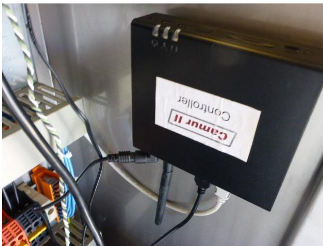
Figur 82 Styreskap i akse 1 (mot Hopen). Avslått Camur II Controller.
