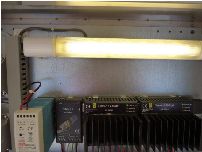
Figur 79 Styreskap i akse 9 (mot Veiholmen). Ingen strøm ut i feltene jf. lysindikator på Camur II FixVolt
