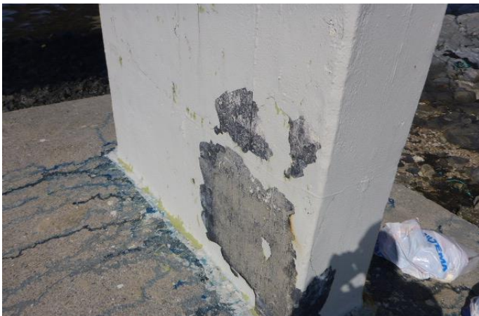
Figur 90 Løs epoksyforsegling nederst på pilar akse 8. Avflassing av fritt eksponert anode
