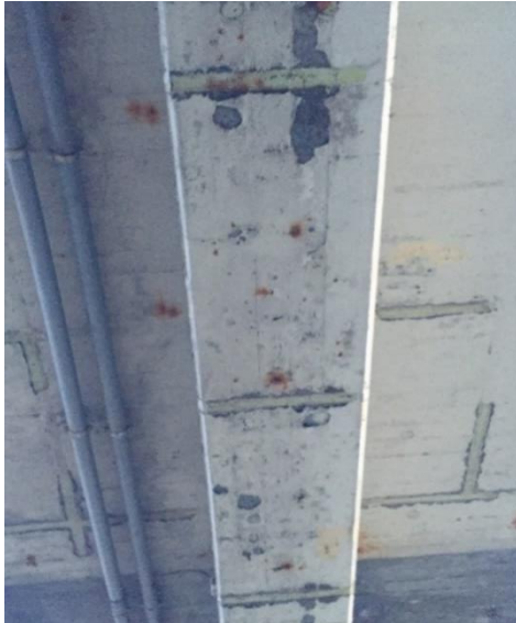
Figur 73 Underkant av brudrager og brudekke sett fra landkar på Nerlandsøy (akse 21). Avflassing, spesielt over epoksyforsegling av sølvbånd.
