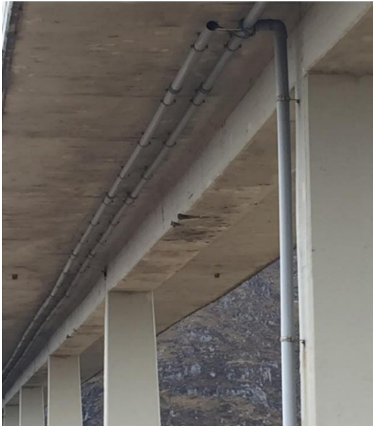
Figur 77 Fra Remøy-siden. Noe malingsavflassing og noen små avskallinger på brudrager. Ellers få synlige skader.
