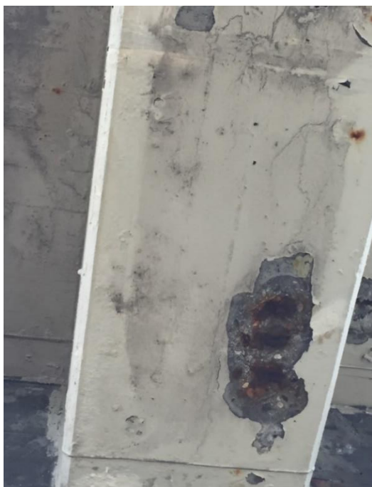
Figur 74 Brudrager sett fra akse 21. Malingsavflassing og betongavskalling over bøylearmering forårsaket av pågående armeringskorrosjon
