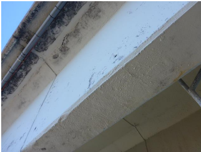
Figur 85 Lo-siden av brudrager og underkant bruvinga ved akse 1. Avflassing av maling og delvis anode (i underkant bruvinga).
