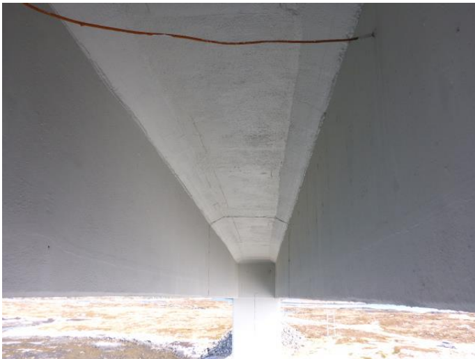
Figur 93 Lokalitet 3 og 4, under møteplass midt på broen. Visuelt fremstår spennet innvendig som skadefritt.
