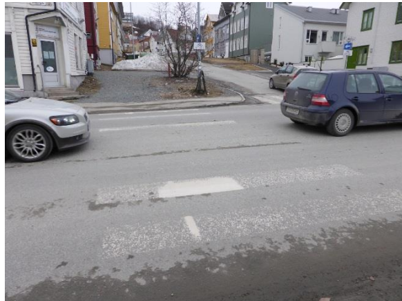
Stor slitasje på gangfelt
