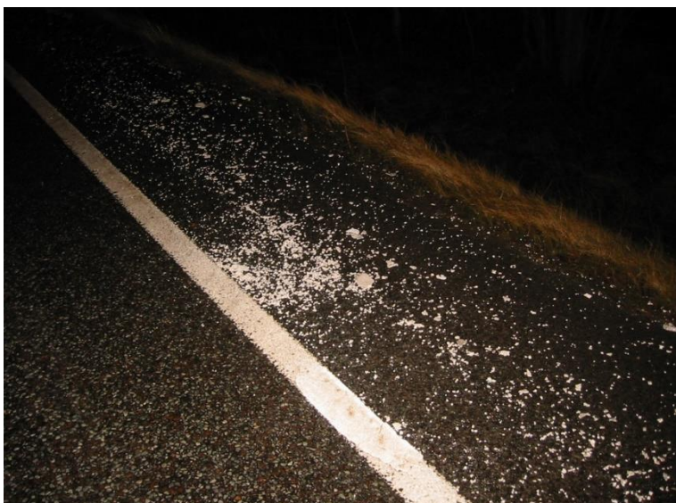
Figur 6.29: Dårlig vedheft kan først vise seg i løpet av vinterperioden når linjene utsettes for mekanisk påvirkning ved vintervedlikehold. Bildet viser linjer med dårlig vedheft som er knust av plogen.
