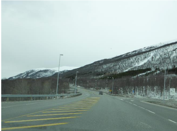
Stor slitasje på sperreområde for å vise kanalisering av vegkryss
