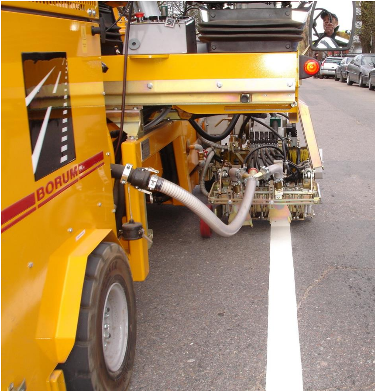
Figur 2.4: Utlegging av ekstrudert termoplast. Den varme massen presses ut gjennom et klaffesystem som en sammenhengende film, gjerne med 3 mm tykkelse.
