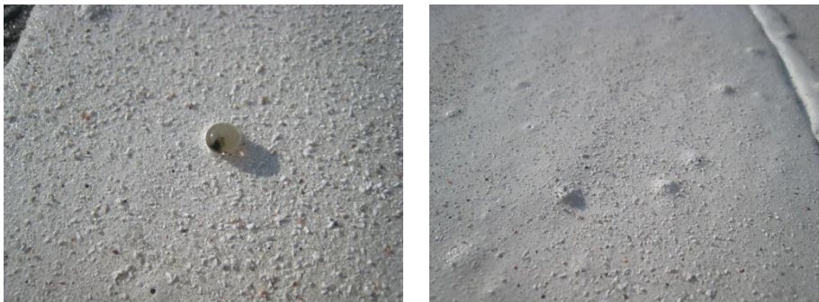
Figur 6.28: Vann/fuktighet fra underlagt som trenger gjennom linjen ved utlegging. Om fuktigheten sperres inne vil det oppstå lommer med redusert vedheft.
