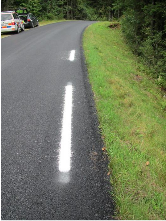
Figur 6.33: Sprut/"splæsje" forårsaket av fuktig underlag
