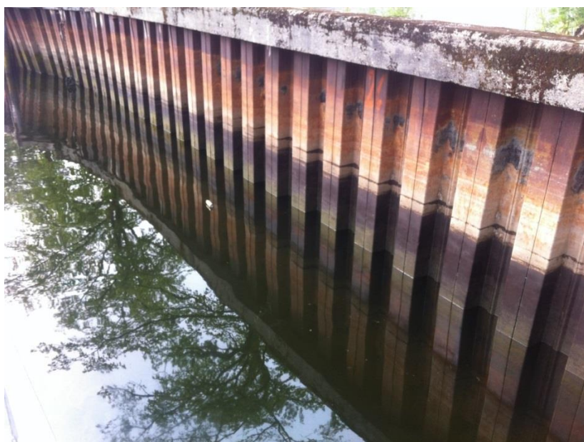
Figur 5. Generell korrosjon på spuntvegg (Foto: SINTEF)
