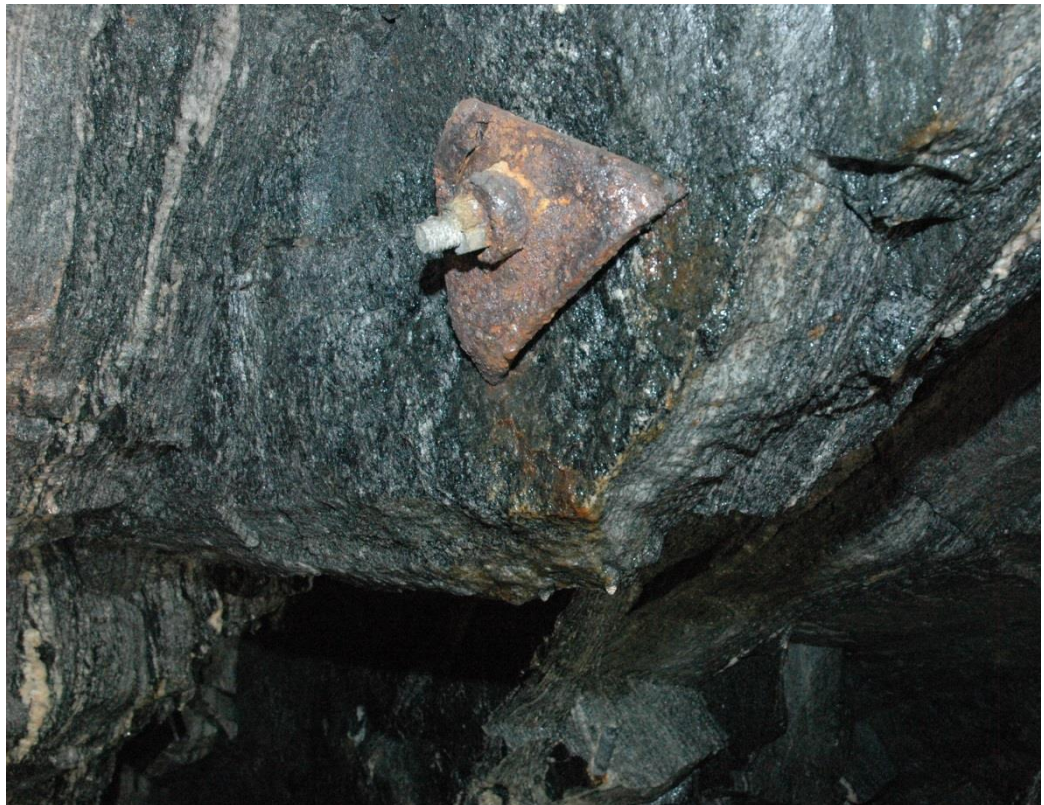
Korroderet bergsikringsbolt, Rv15 Grasdaltunnelen, Stryn, åpnet 1977 (Foto: Karen Klemetsrud, Statens Vegvesen)
