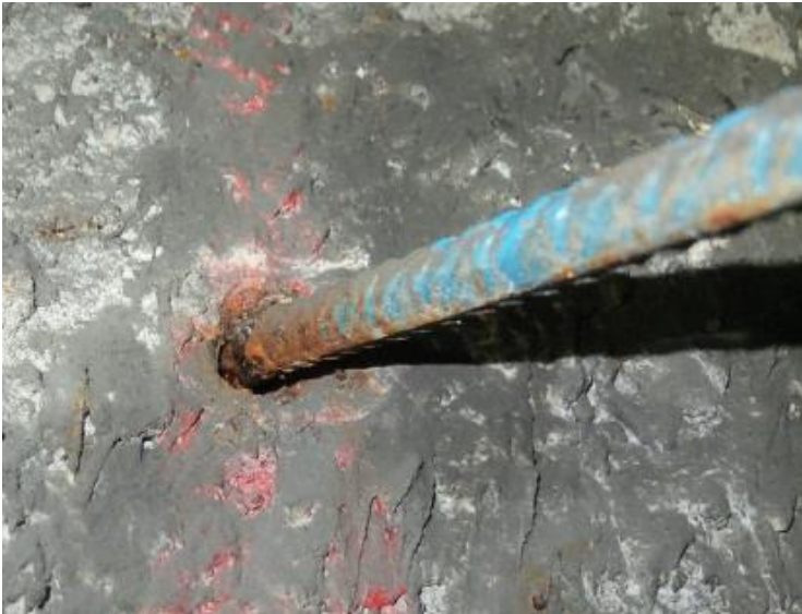
Figur 7. Galvanisk korrosjon på stål der kamstålet går inn i fjellet. Ulik pH i mørtel og utenfor, samt god tilgang på fuktighet, dirigerer angrepet til akkurat i overgangen (Foto: Aas-Jacobsen).
