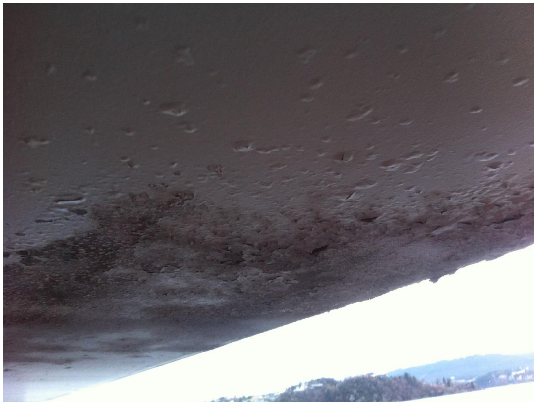
Figur 1. Omfattende korrosjonsskader i område med lav filmtykkelse, målt til omkring 250 µm for både sink og maling.
