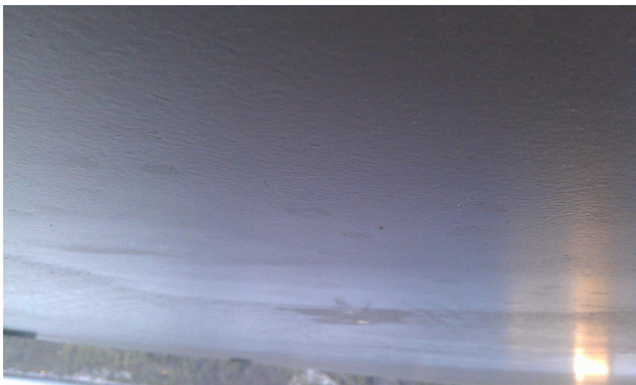
Figur 7. Belegget på Imarsundbrua er i god stand.
