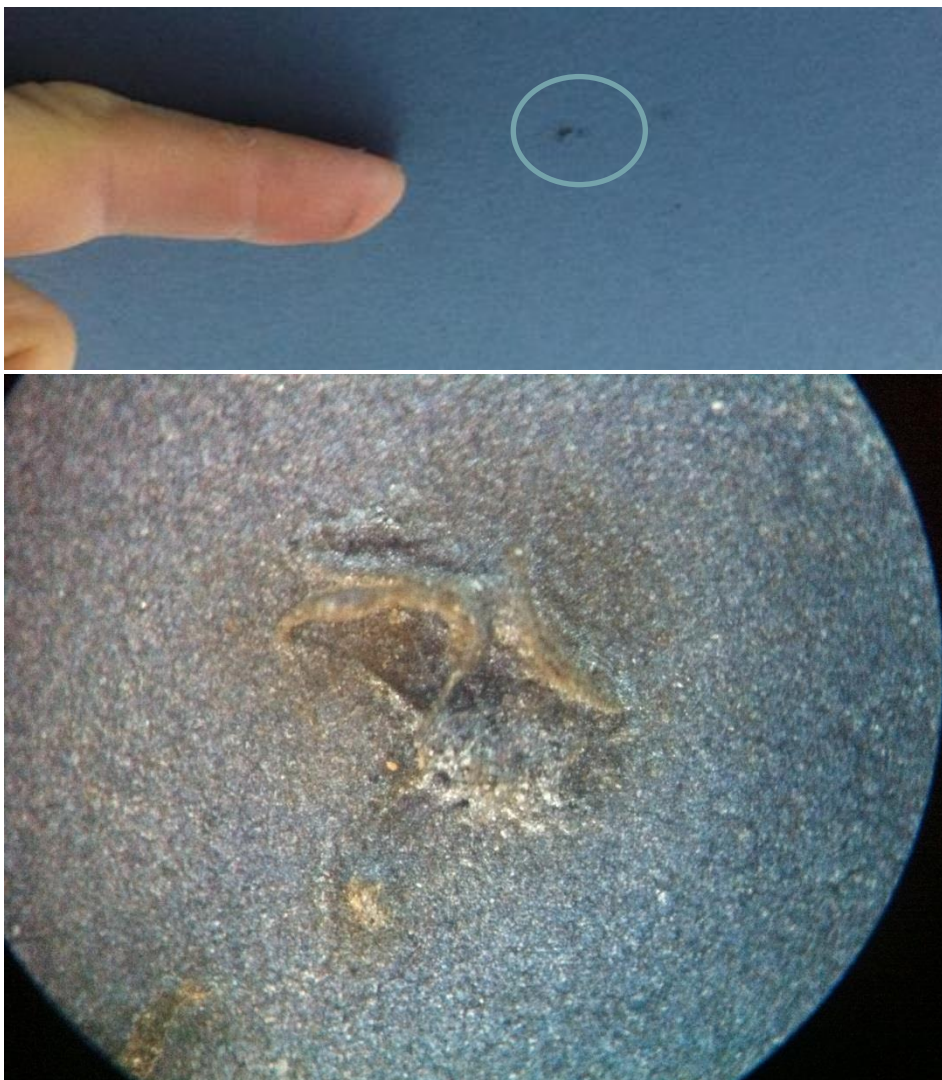
Figur 10. Nålestikk på Melhusbrua som ikke har utviklet seg til større korrosjonsangrep
