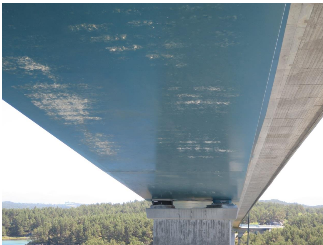
Figur 13. Korrosjonsskader på viadukt på Bømlabrua
