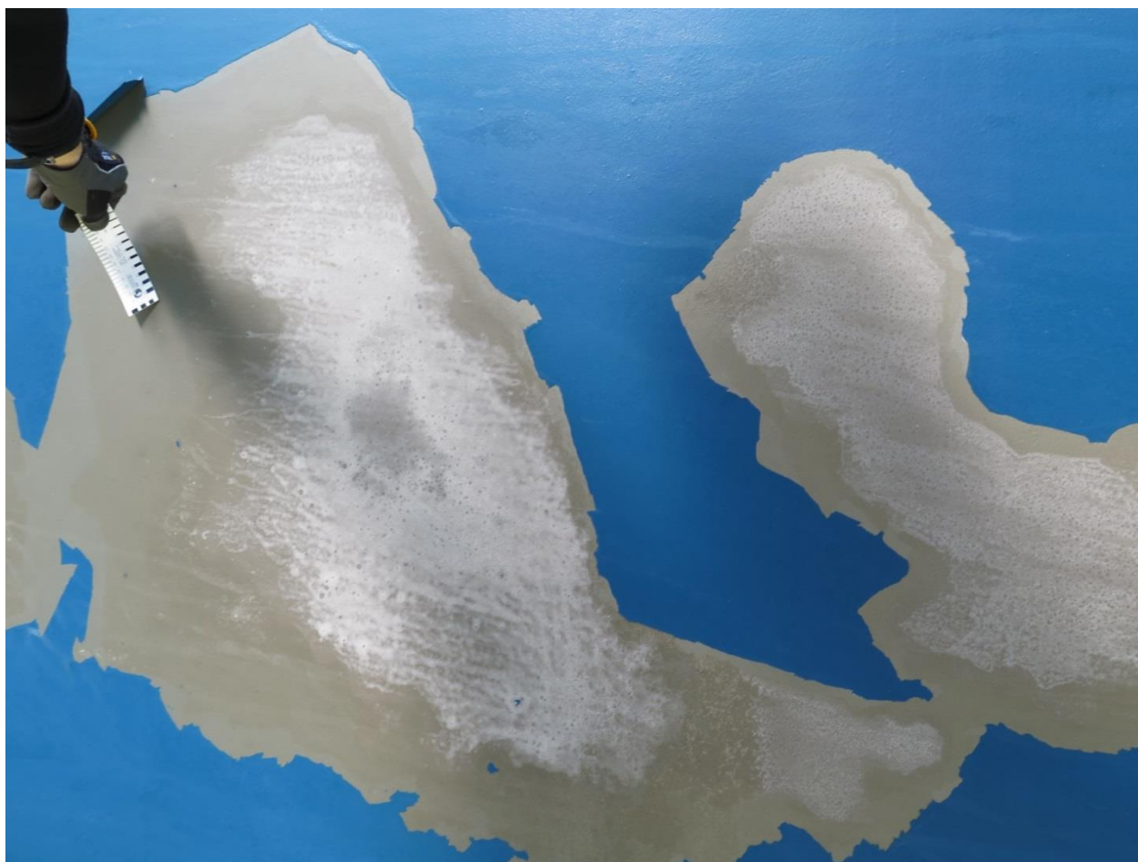
Figur 11. Avflassing av toppstrøk og korrosjonsskader på Stordabrua.
