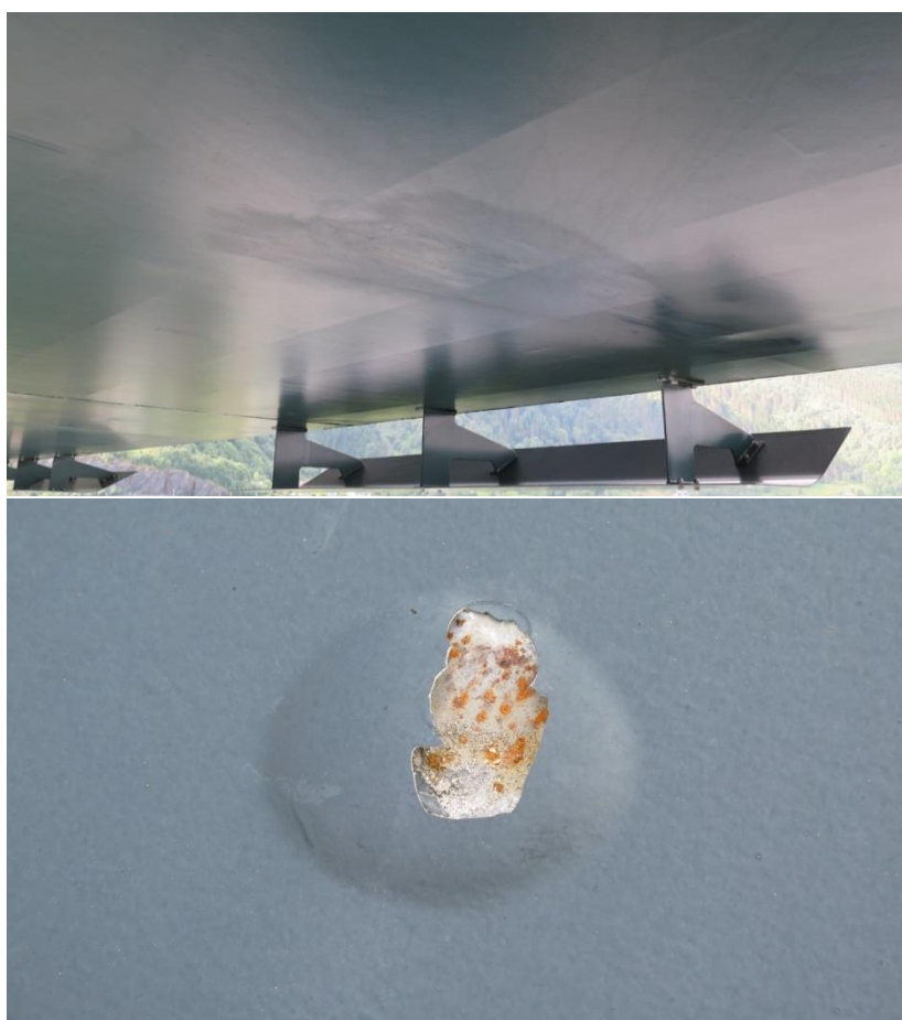
Figur 6. Få korrosjonsskader på Osterøybrua. Bildet viser en enkelt skade.
