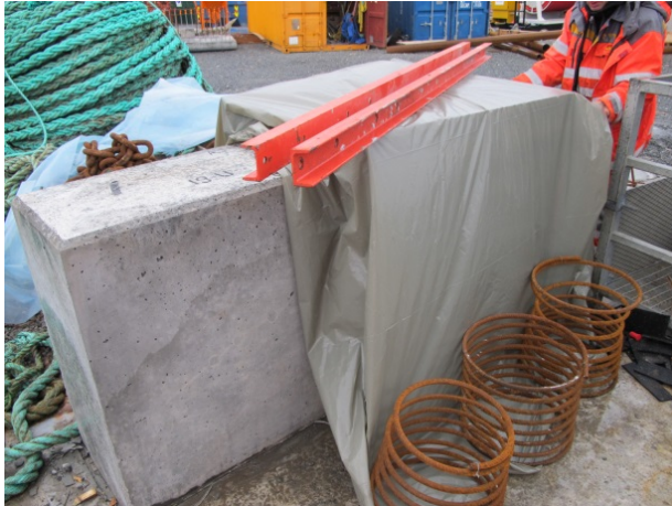
Figur 29 Tildekking behandlet del av element umiddelbart etter påføring, side B.
