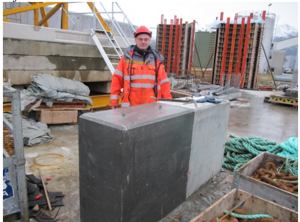
Figur 28 Stort element ferdig behandlet. Flate A, impregnert del til venstre.
