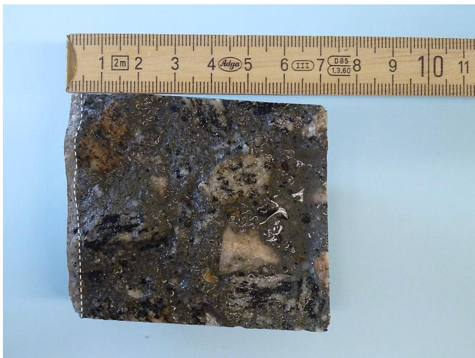
Kerne 1-S-3 – Til venstre ses den eksponerede overflade, mod højre ses den fræ- sede overflade. Den imprægnerede del (de yderste mm fra venstre) fremstår lysere end den øvrige del af kernen.
