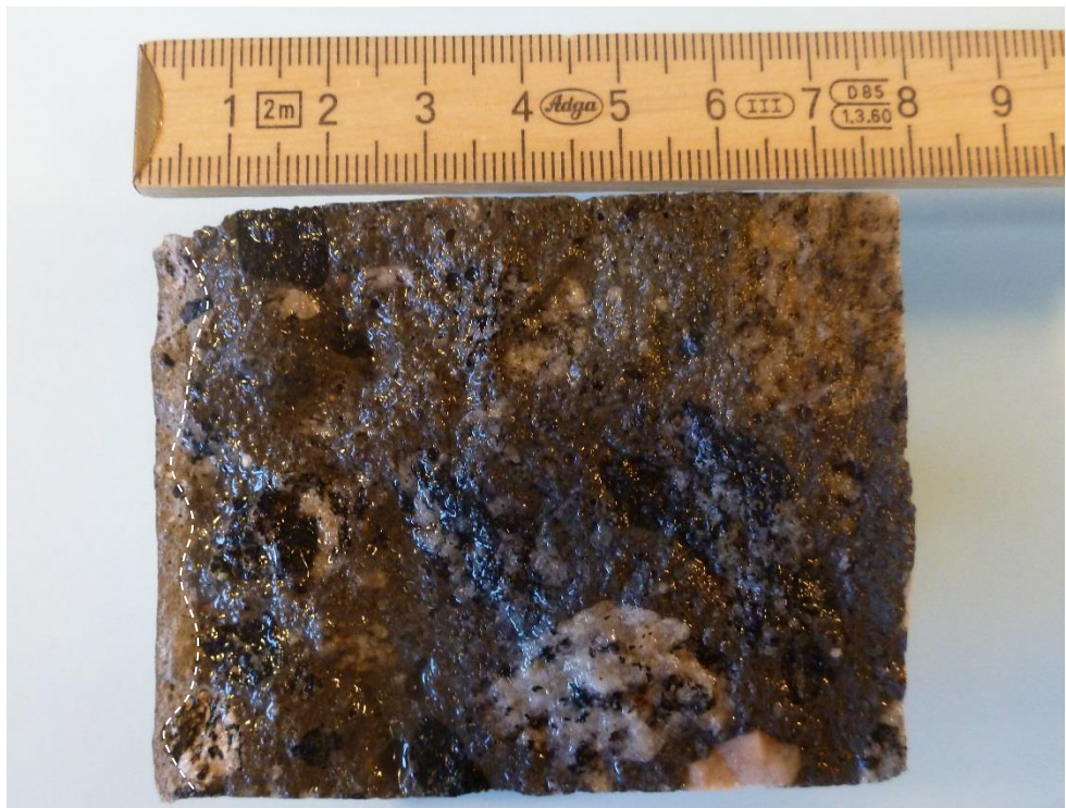
Kerne 4-S-3 – Til venstre ses den eksponerede overflade, mod højre ses den fræ- sede overflade. Den imprægnerede del (de yderste 3-5 mm fra venstre) fremstår lysere end den øvrige del af kernen.
