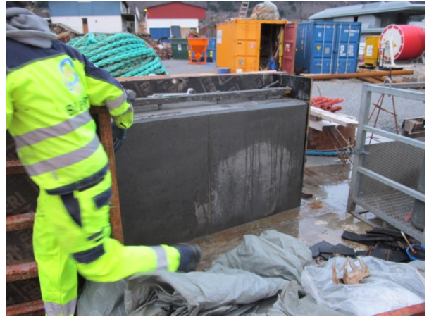
Figur 24 Umiddelbart etter forskalingsriv sideflate. Beskjeden vanntilførsel fra toppflate.
