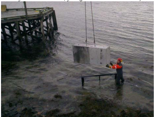
Figur 45 Stort element heises på plass i stålramme i tidevannssonen på Lønset 10/12-13 (foto: Martin Gedra)
