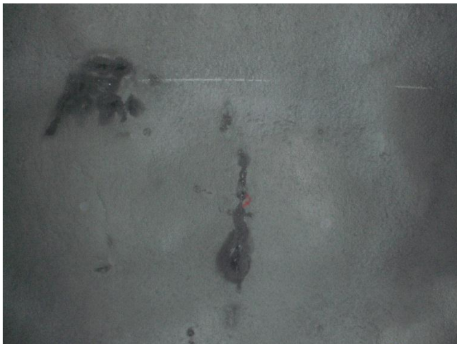
Bilde 7 Sprekker nær profil 1
