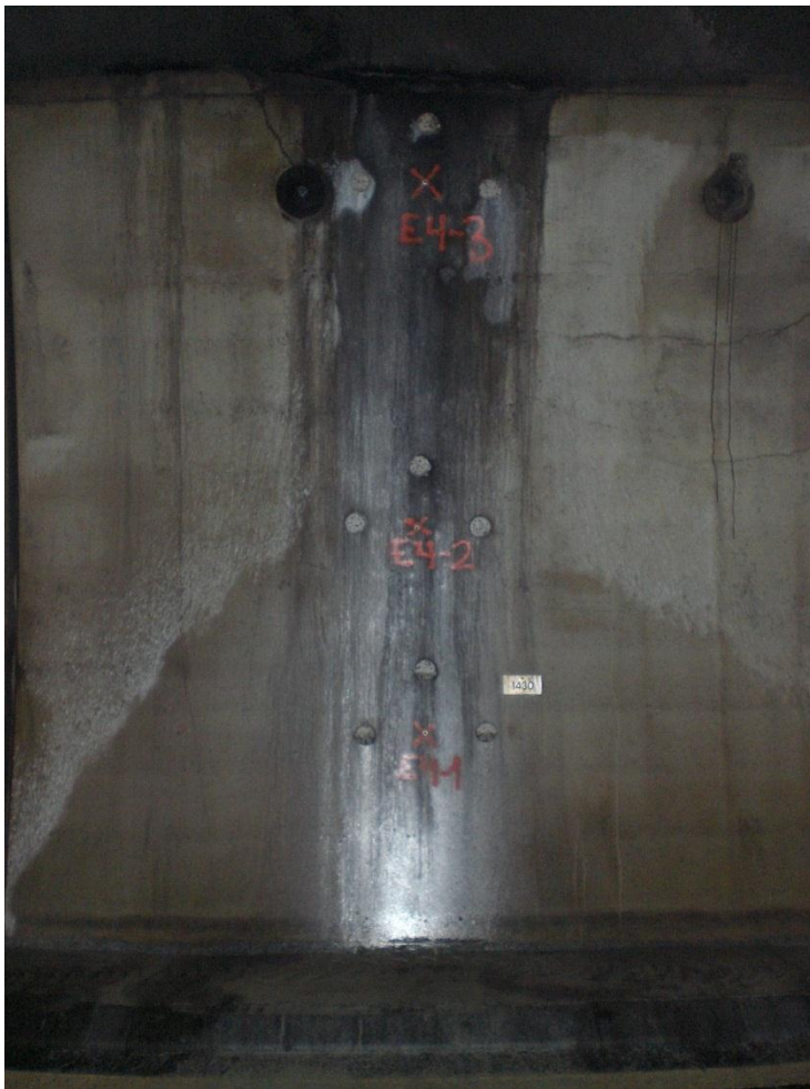
Bilde 9 Lekkasje i profil 4
