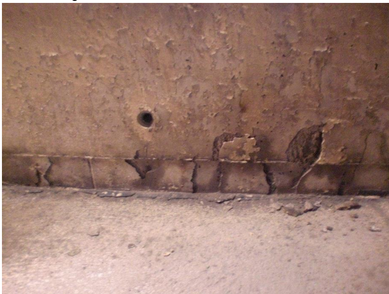
Bilde 16 Armeringskorrosjon nederst på vegg i profil C
