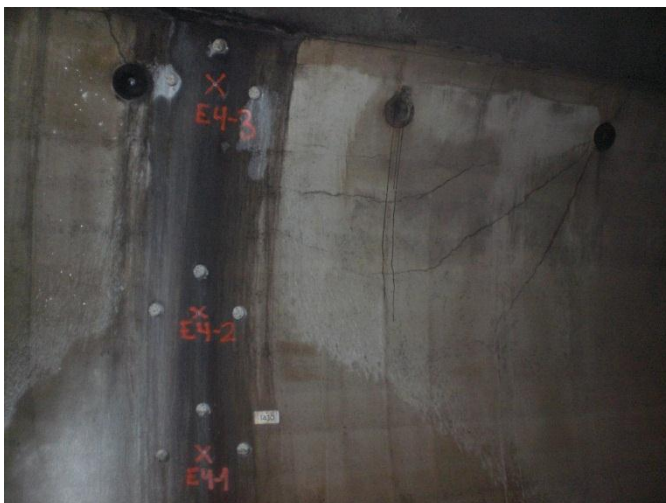
Bilde 8 Riss i profil 4
