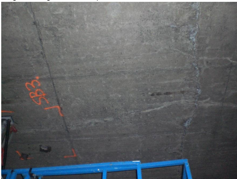
Bilde 15 Riss i tak i profil C
