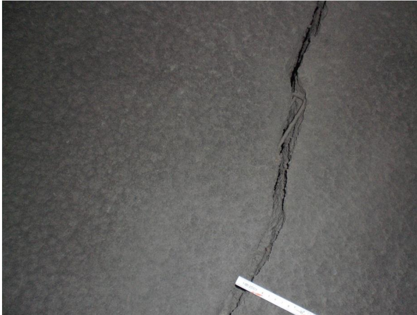
Bilde 5 Sprekk nær profil 8
