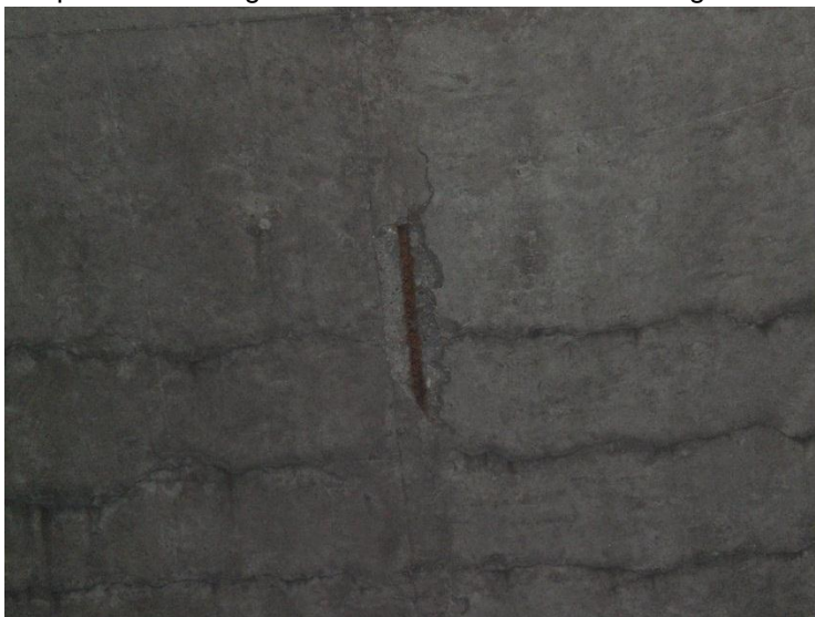
Bilde 14 Armeringskorrosjon i tak i profil B
