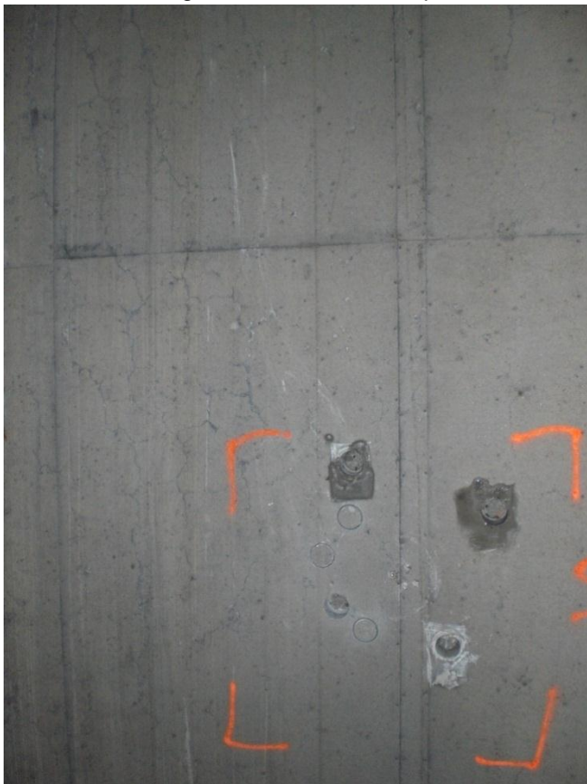
Bilde 11 Krakeleringsriss i tak i profil A
