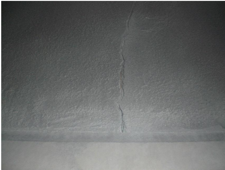
Bilde 4 Sprekk nær profil 7
