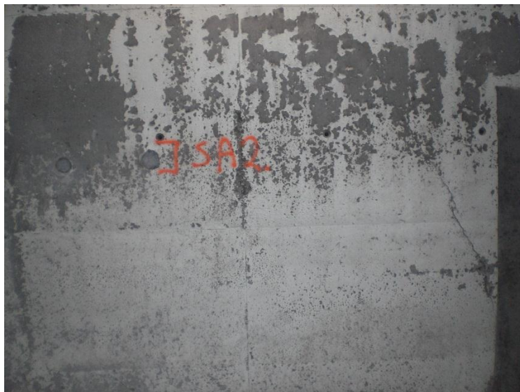
Bilde 12 Riss i vegg i profil A
