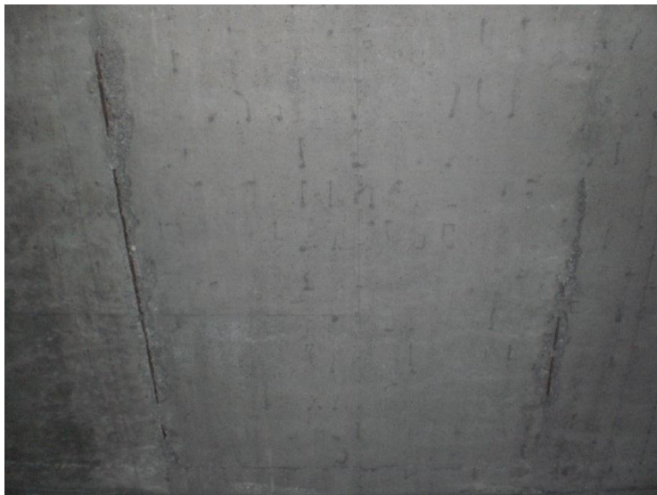
Bilde 13 Armeringskorrosjon i tak i profil A
