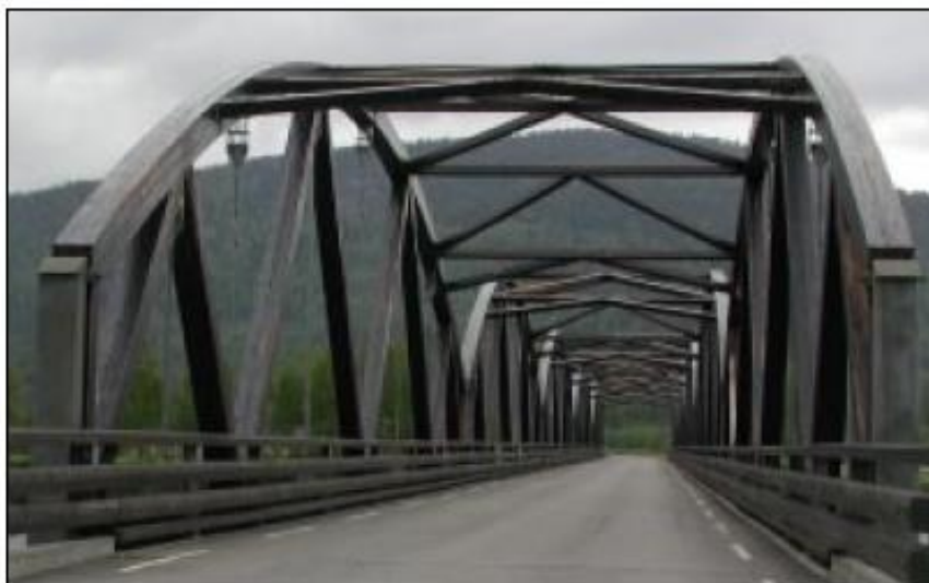
Figur 6-30: Evenstad bru med overliggende vindfagverk Figure 6-30: Evenstad Bridge with elevated wind bracing
