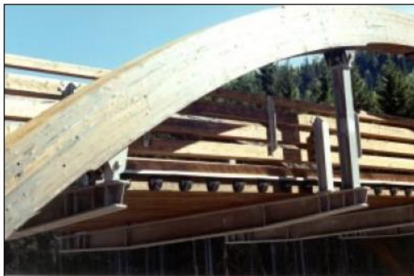
Figur 6-31: Hengesøyler og tverrbærer i stål danner en U-formet avstivningsramme Figure 6-31: Suspension posts and cross girders form a U-shaped stiffening frame
