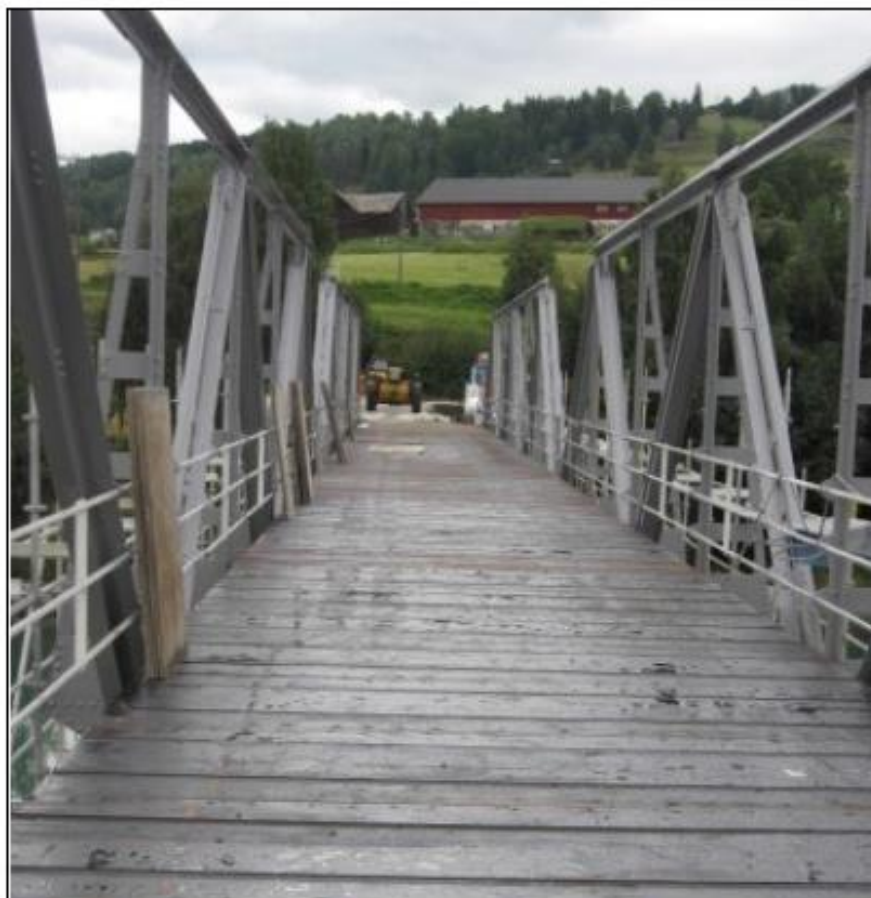
Figur 6-22: Hundorp bru med nytt dekke av kreosotimpregnerte massivtrelementer. (Sweco) Figure 6-22: Hundorp Bridge with a deck made up of creosoted cross laminated timber element. (Sweco)
