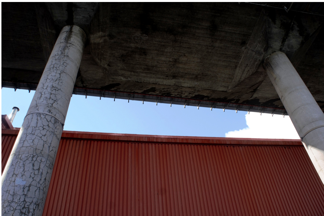
(a) Varierende krakelering fra søyle 16 til 15
