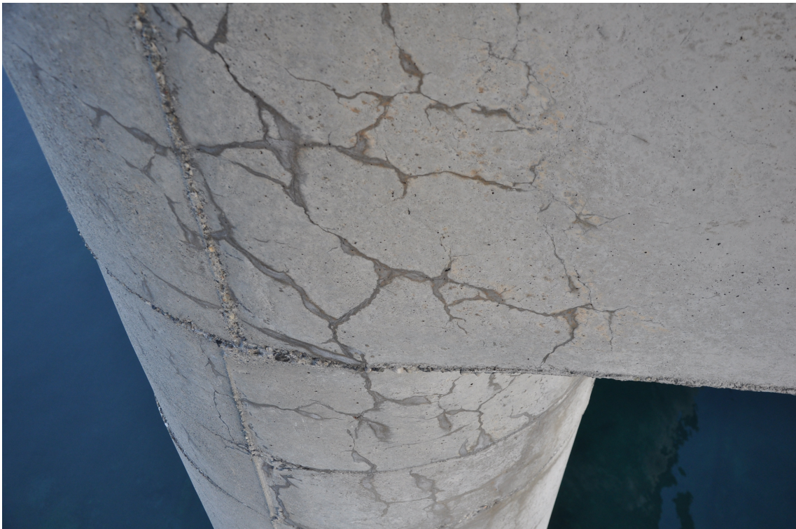
(a) Krakelering med synlig alkaligel i seksjon B
