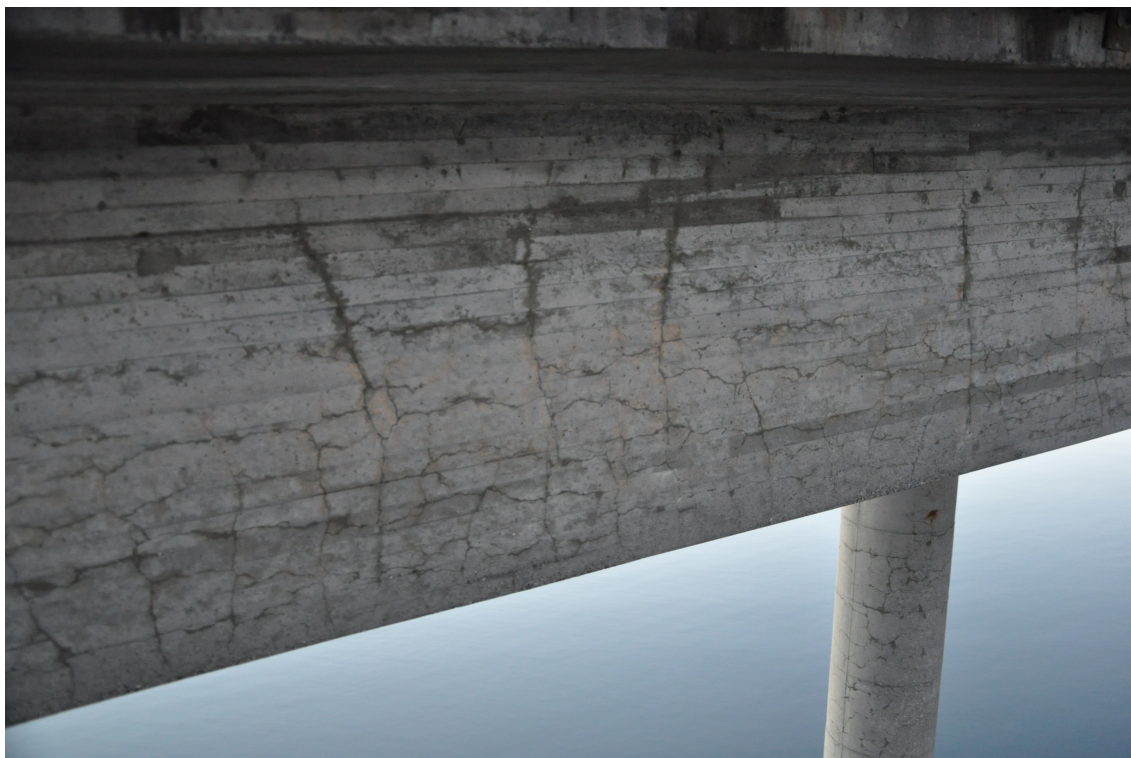
Figur 7.7: Krakeleringsriss mellom akse 17 og 18
