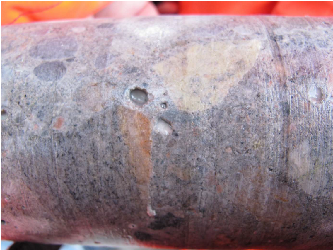
(b) Synlig alkaligel for søyle akse 16
