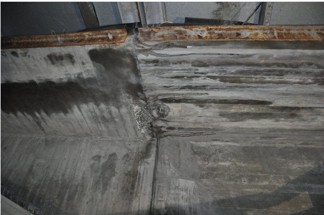
(b) Underside av dilatasjonsfuge i akse 32
