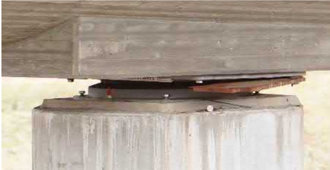
Foto 39. Løs midlertidig fastholding av glidelagrene ikke fjernet i byggefasen.
