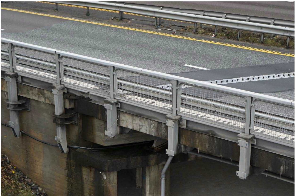
Foto 18. Inspeksjon av eksponert overflate etter nylig regnvær.
