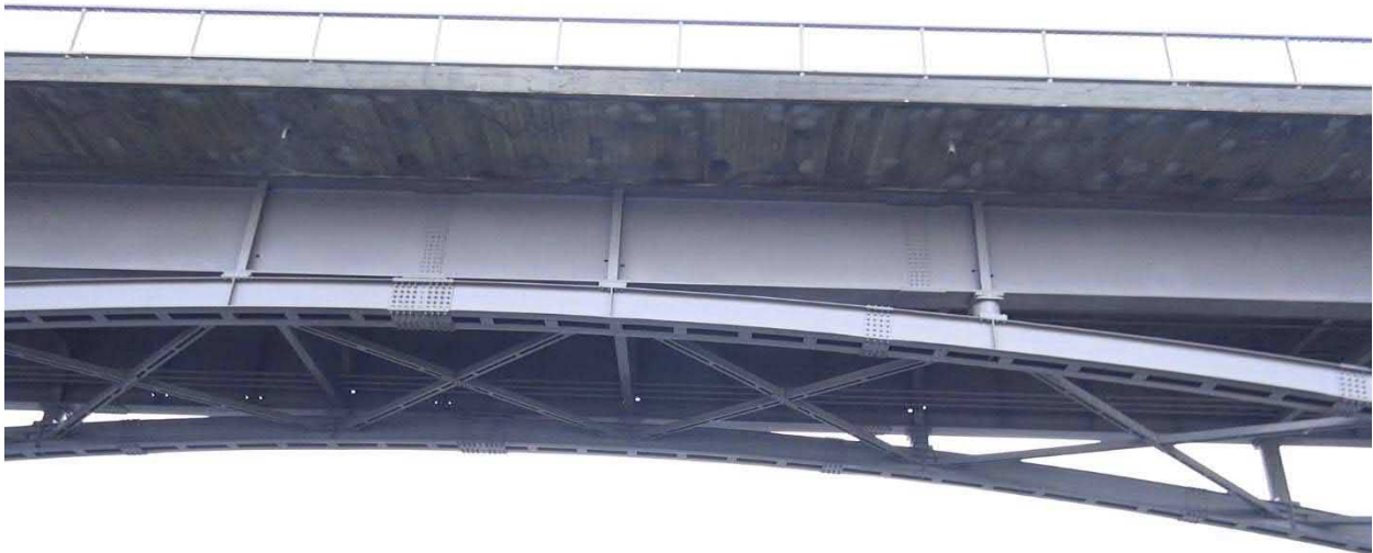
Foto 37. Stålbuen med et nesten lukket tverrsnitt dronens kamera ikke kan se inn i. Alt vedlikehold inni dette tverrsnittet er vanskelig å få utført tilfredsstillende.
