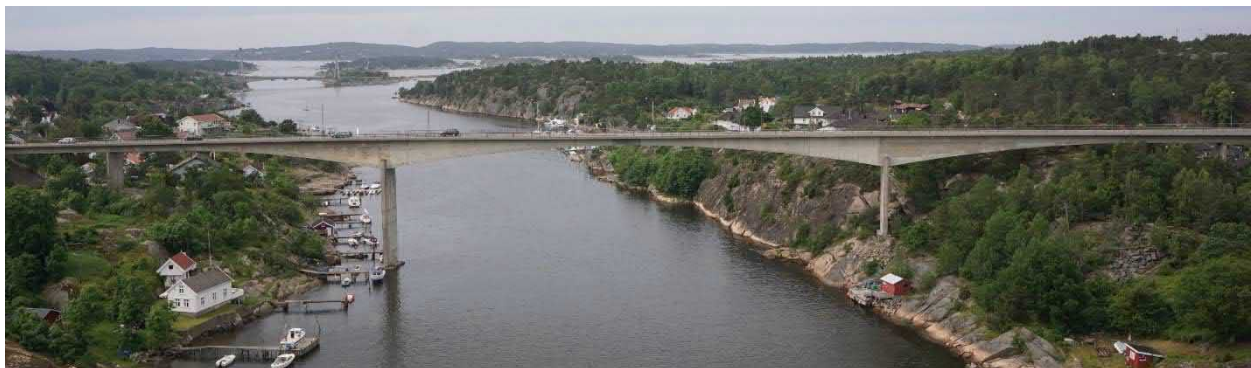
Foto 32. I utgangspunktet en relativt enkel bru å inspisere med drone med få detaljer og store ensartede overflater.
