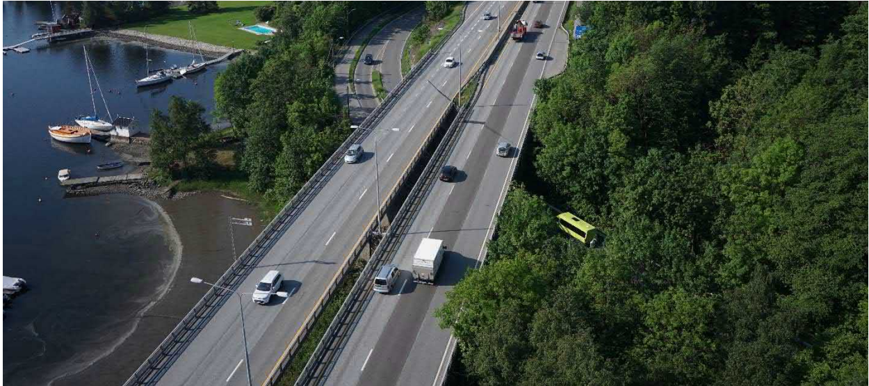
Foto 11. Bjørnsvikbruene i Sandvika ligger relativt høyt, men det er også tett med vegetasjon rundt bruene. Her valgte vi i tillegg inspeksjon med billift for å kartlegge delaminert betong underkant fuger. Bruene er av Norges mest trafikkerte.
