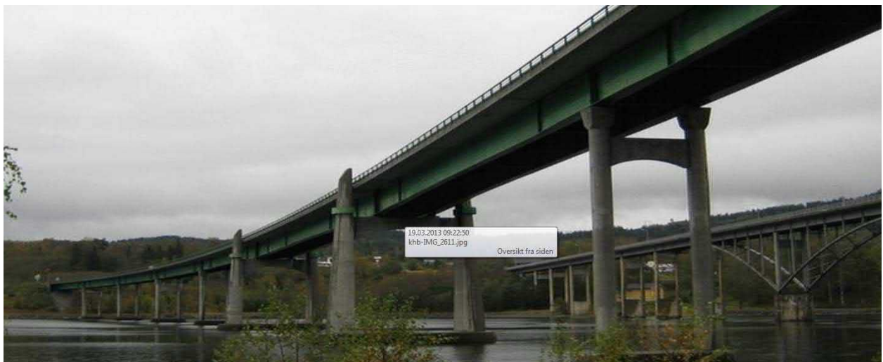
Foto 19. Minnesundbrua i noe dårlig lysforhold tatt med kamera fra bakkenivå.
