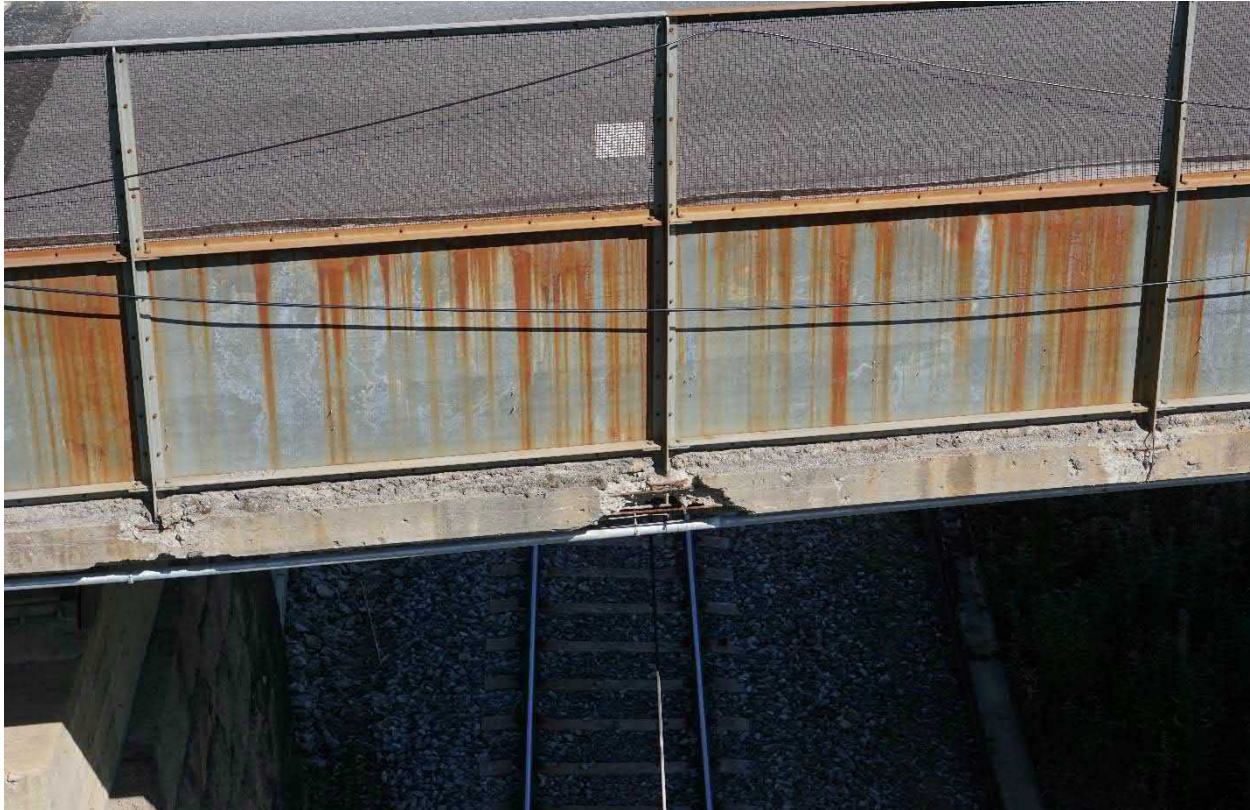
Foto 30. Foto av samme skade tatt fra drone. Enklere å vurdere skaden rett forfra enn fra siden.
