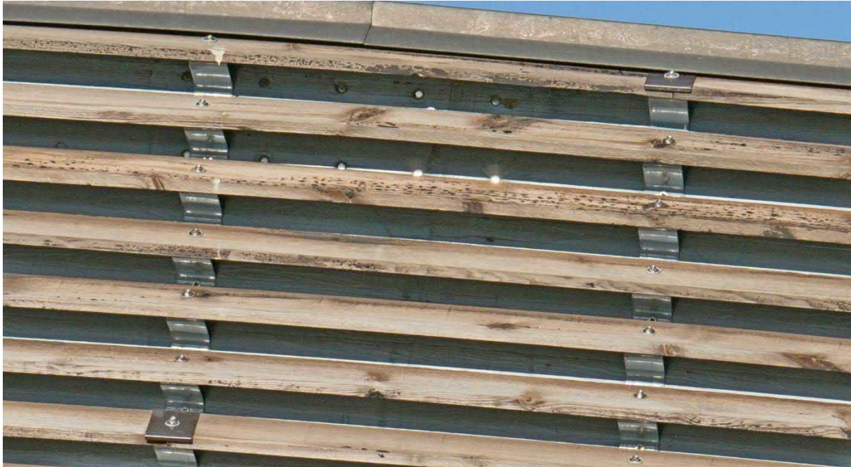
Foto 41. Riktig vinkel på kamera gjør det mulig å se under sjalusibeskyttelsen og også evt. oppsprekking ved dybelinnfestning av hengestang.
