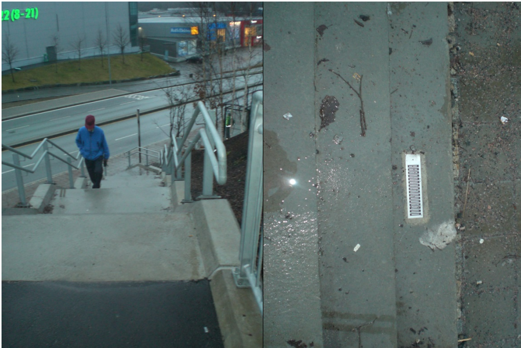
Trapp med varmekabler.
