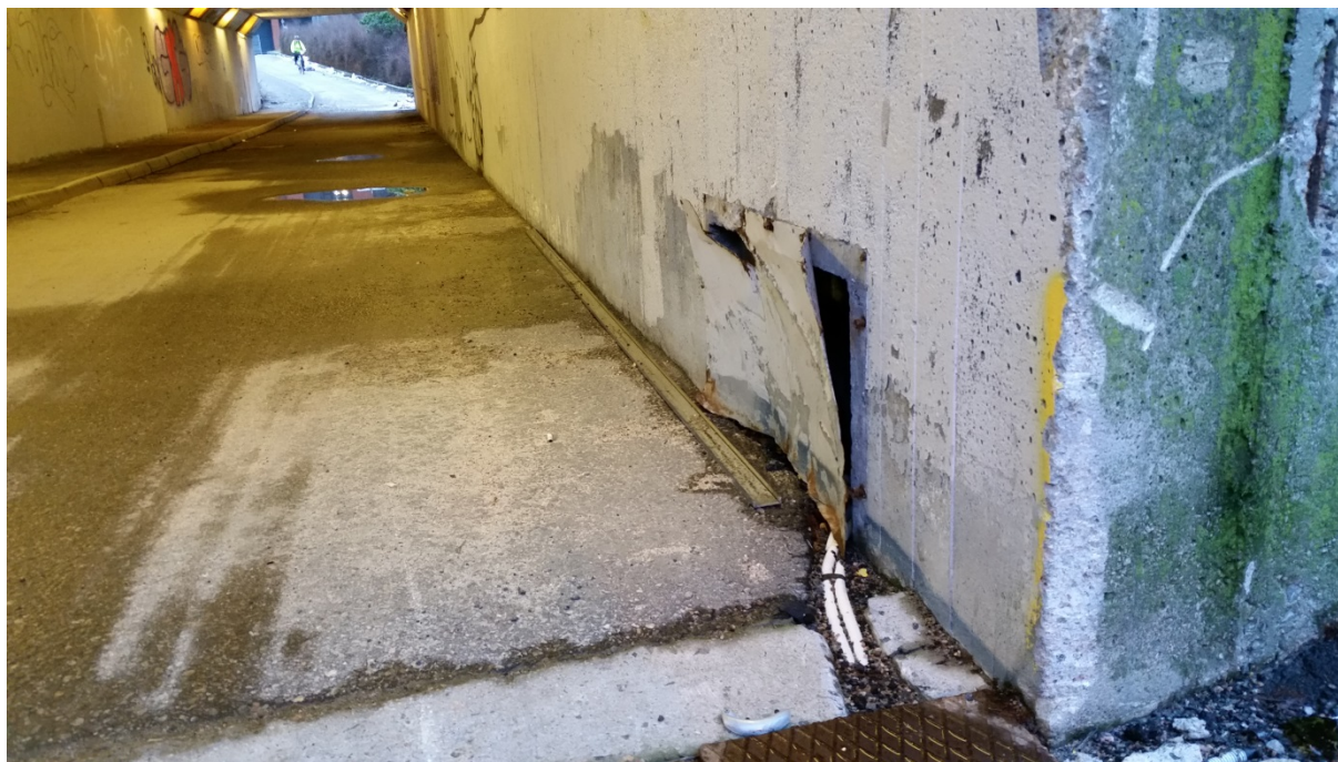
Løst deksel som stikker ut fra veggen inne i kulverten.
