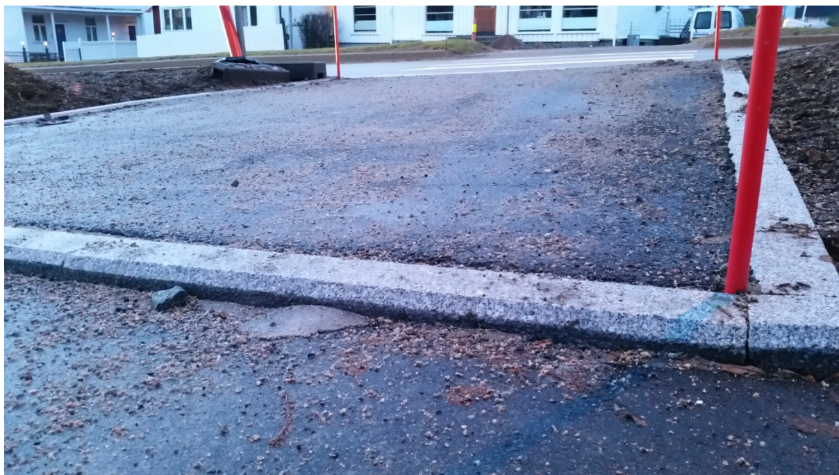
Bildet er tatt ved det nye anlegget. Avstand mellom topp kantstein og asfalt kan være problematisk for rullestolbrukere og syklister. Medfører også en snublefare.
