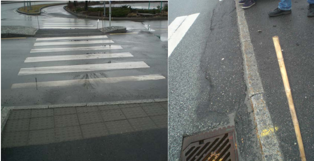
Tilrettelagt krysningspunkt med varselindikator på den ene siden. Bildet til høyre viser andre siden.
