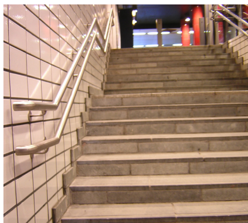
Oslo S. Riktig utformet håndlist i to høyder som begynner før trinnene. Foto: Elin Katrine Nilsen.
