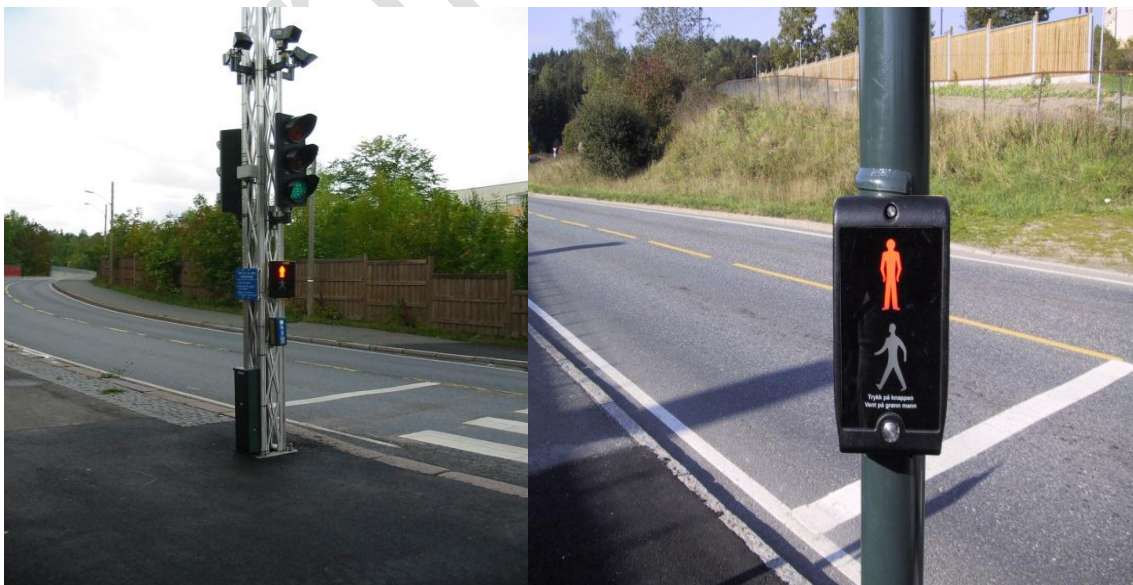
Figur 14. Puffin-anlegg i ????? Foto: Pål Hauge
