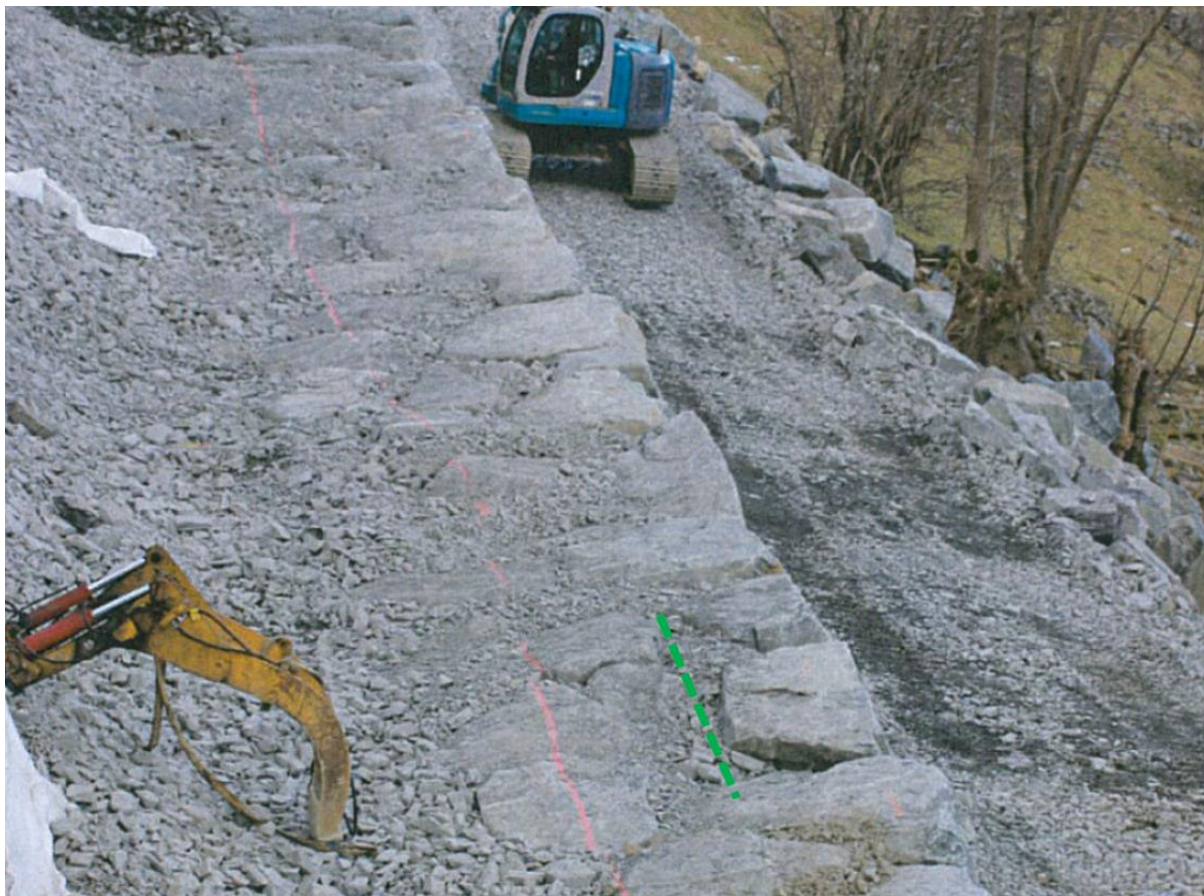
Figur 5 Eksempel fra Mur 12 med tendens til bra forbandmuring i ytre halvdel av muren. Her er store hulrom / fuger fylt opp med singel/pukk som forutsetter grundig rengjøring av steinflater for å unngå risiko for "rullelager effekt". Rød linje markerer dimensjonert bredde. Grønn linje antas å markere gjennomsnittlig bredde for ytre murestein. Det er uklart om fugefyllingen er for å oppnå forutsatt romvekt eller for å bedre steinenes stabilitet når belastet av murende gravemaskin i neste skift.
