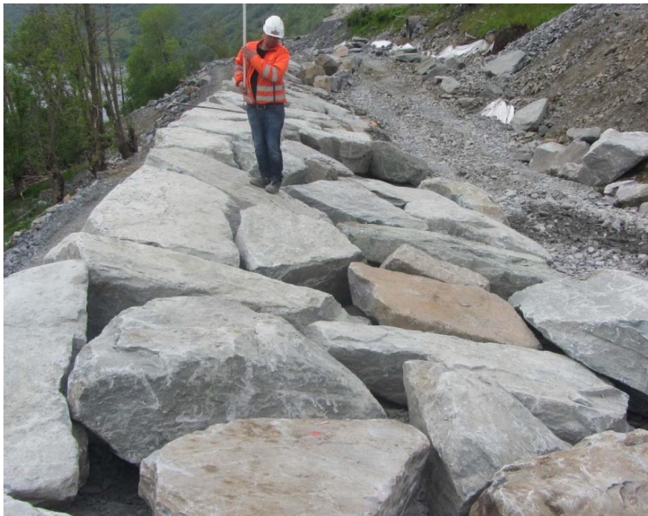
Figur 4 Eksempel på muresteinskiift i Mur 12 med noenlunde oppfylt forband. Legg merke til store åpne rom pga lite rektangulær steinform.
