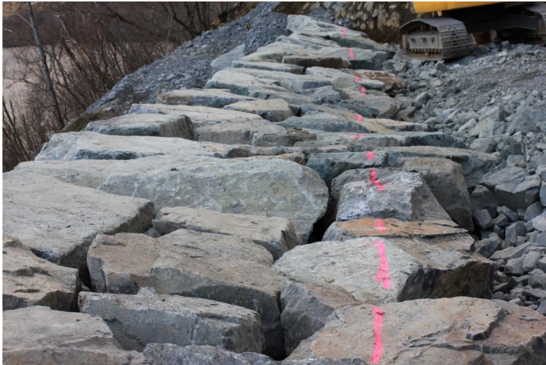
Figur 22 Entreprenørens bildedokumentasjon for å argumentere for korrekt mur løsning med større bredde enn forlangt (rosa strek). I dette tilfellet er mutreteknikken om forband nær tilfredsstillende. Avviket er krevende ujevn sjiktoverflate for plassering av neste steinskift. Hvorfra bilde er tatt er ikke del av dokumentasjon.
