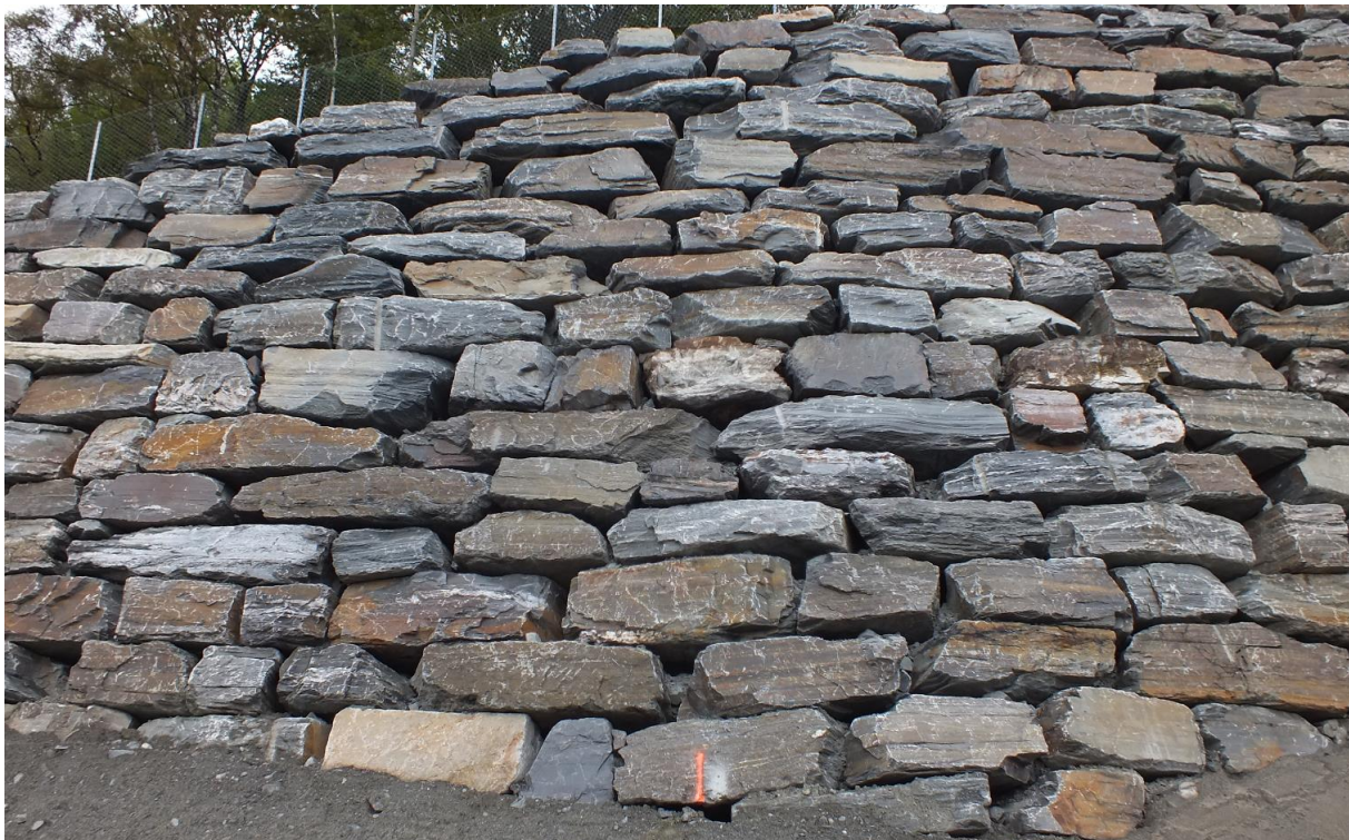
Figur 6 Eksempel fra Stordalen. Inntrykket av mur med godt forband i noe avstand synes å vise en grei og fin mur. Mer detaljert studie viser meget hyppige avvik fra kravet om målsatt forband i lengderetning, dvs med stedvis gjennomgående fuger i vertikalplanet
