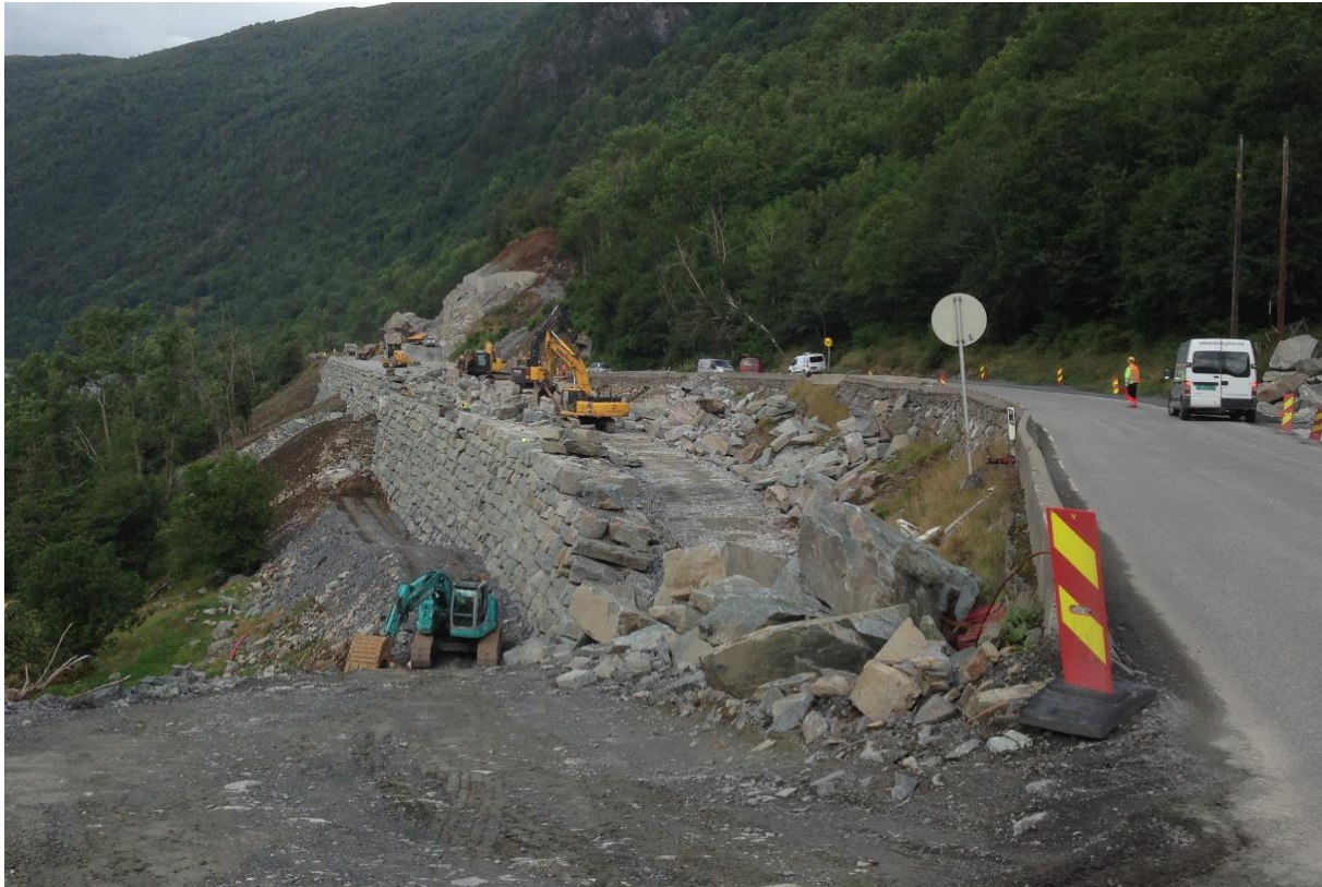
Figur 7 Mur 12. Netto høyde opp til 12 m. Terreng foran mur med helning 3:1 med 5 m bred GS veg og grøft nærmest murkant.
