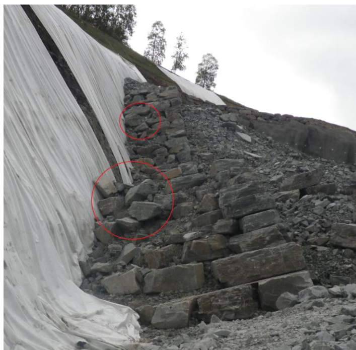
Figur 20 Muring som ble forkastet/vraket i omkring Mur2/3. Her er breddekravet omtrent som avstand mellom bakskråning og murfront. Bakskråning er beskrevet av prosjekterende med helning maksimum 45°.
