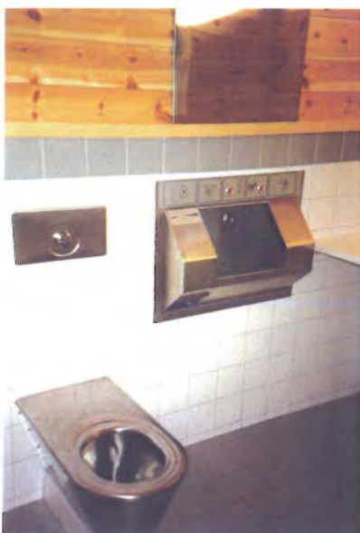
Kolobekken, E6 i Hedmark. Et interiør som både er enkelt å rengjøre og lite hærverksutsatt. Foto: Frode Bakken.
