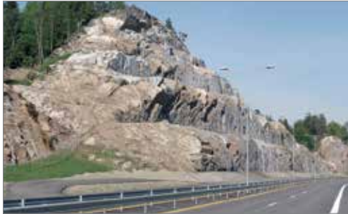
Fjellhyller med dårlig form
