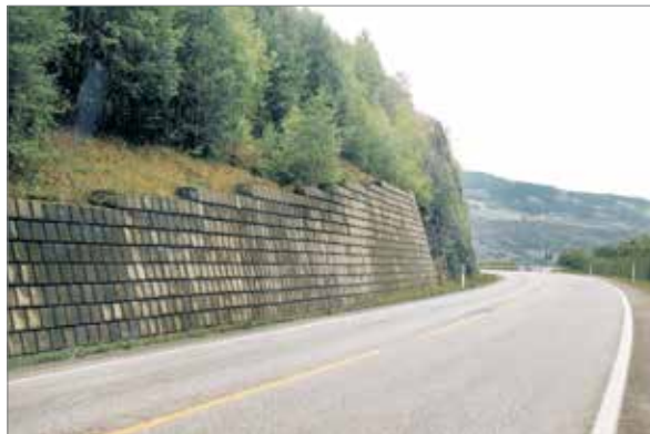
Mur av betongelementer som er dårlig tilpasset terrenget og preget av tidens tann på en uheldig måte
