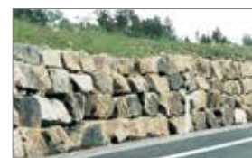
Dårlig håndverk, ujevn overflate
