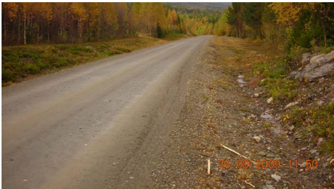
Figur 8 Velfungerende drenering av grusveg
