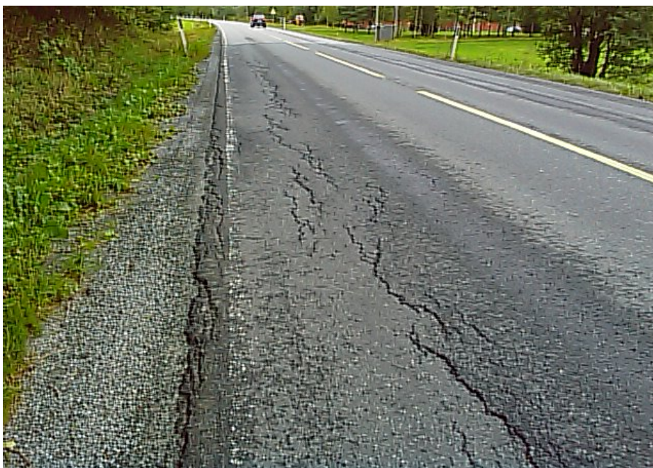
Figur 17 Sprekker og deformasjoner i asfaltdekket, samt grunn sidegrøft [2]
