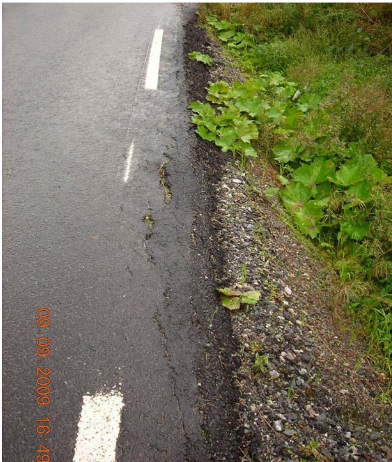
Figur 15 Skade på asfaltert veg med liten innspenning
