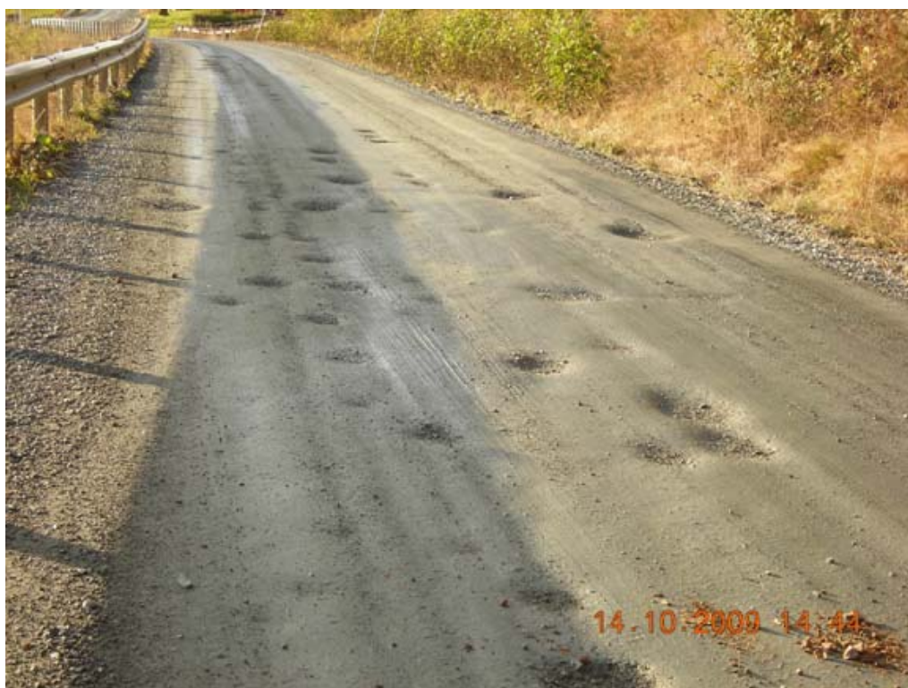
Figur 13 Grusdekke på forsterket veg etter 1 (!) år
